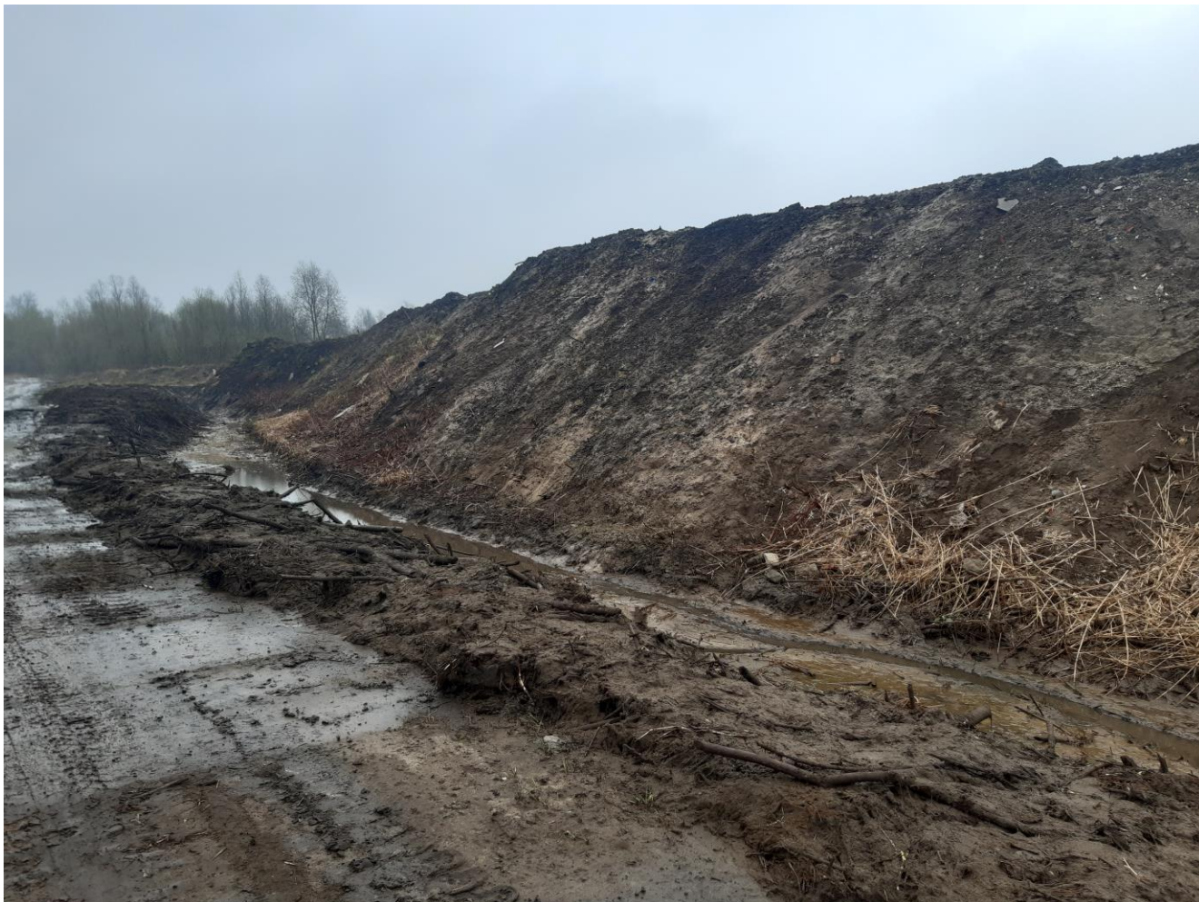
Zdj. 2. Droga istniejąca. Rów odwadniający, ok. 300m na północ od punktu nr 1 planu sytuacyjnego.
