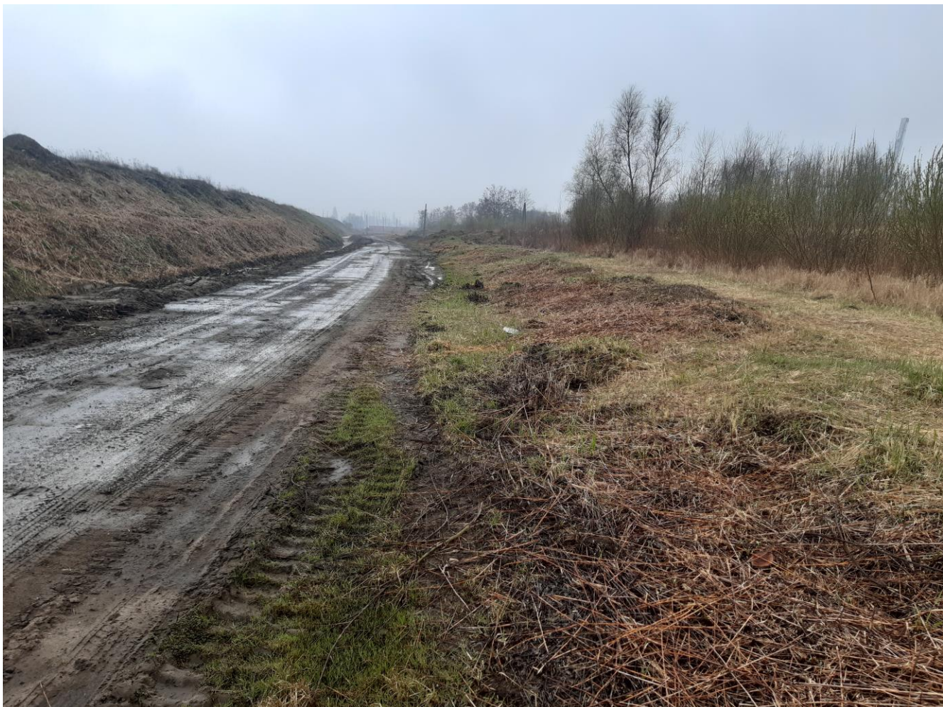
Zdj. 4. Droga istniejąca. Odcinek środkowy, 300 m na północ od punktu nr 1 planu sytuacyjnego.
