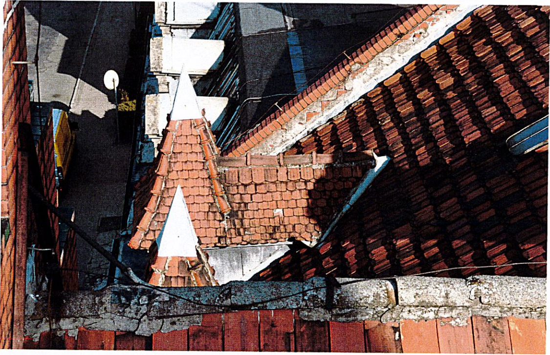
Fot. Nr 11. Lukarny, widok z góry – widocznie nieoryginalne zwieńczenia - brak iglicy. Kalenica wykusza głównego – widoczne nieoryginalne gąsiory (elewacja frontowa).
