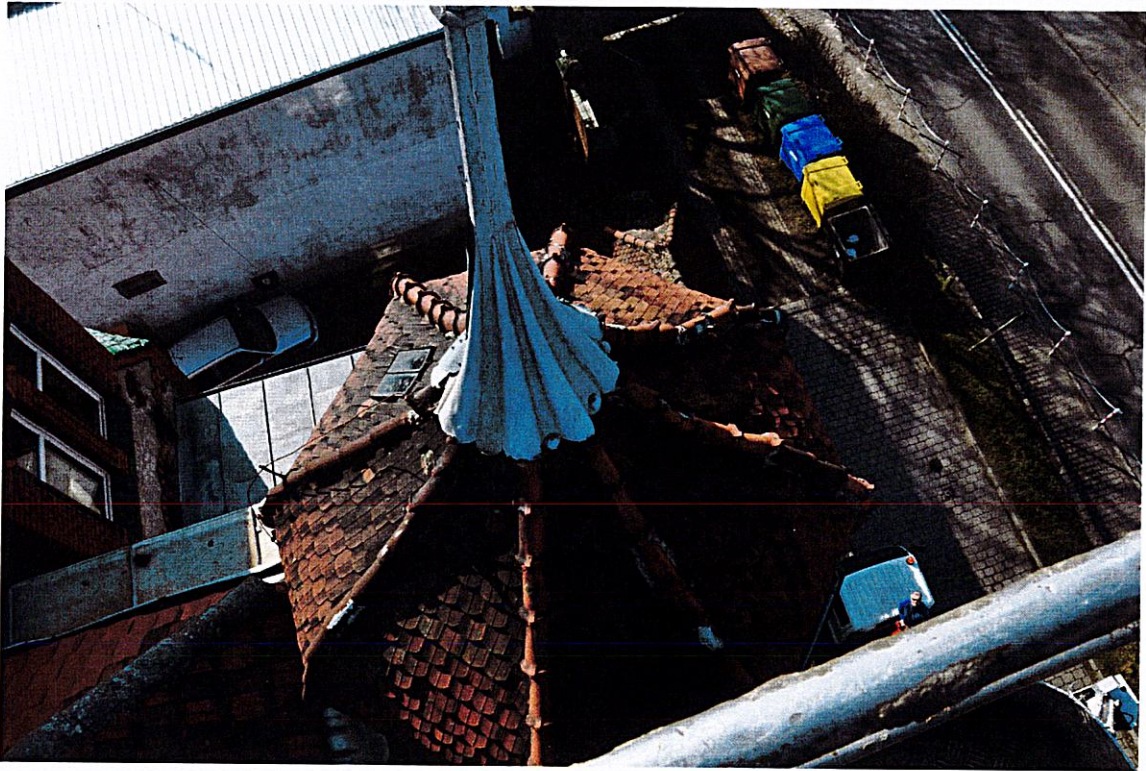
Fot. Nr 15. Hełm wieżyczki z widoczną dachówką giętą układaną w łuskę, gąsiorem wieżowym i gąsiorem kończącym ozdobnym, widoczne nieoryginalne gąsiory wykonane z rur stalowych oraz podstawa iglicy z blachy cynkowej - widok z góry.
