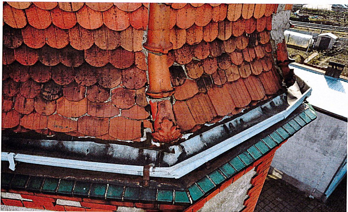
Fot. Nr 16. Hełm wieżyczki z widoczną dachówką giętą układaną w łuskę, gąsiorem wieżowym i gąsiorem kończącym ozdobnym, widoczny skorodowany pas okapowy i zdeformowana rynna - widok od strony elewacji frontowej.
