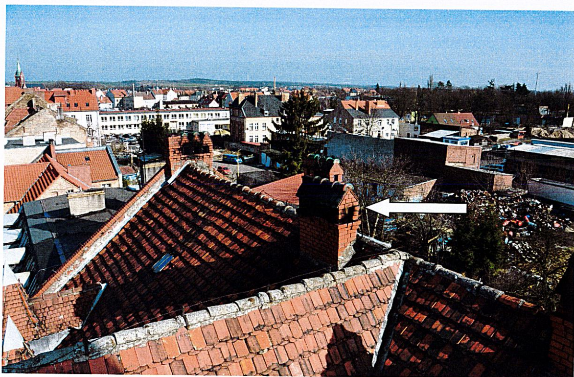
Fot. nr 20. Uszkodzona czapka komina, widok z góry.
