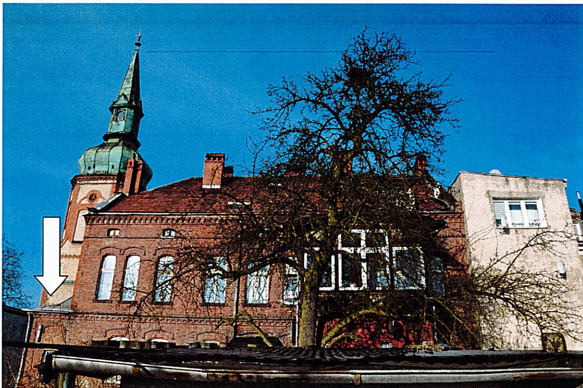
Fot. nr 22. Daszek pokryty blachą tytanowo- cynkową, widok od strony południowo-wschodniego narożnika budynku.
