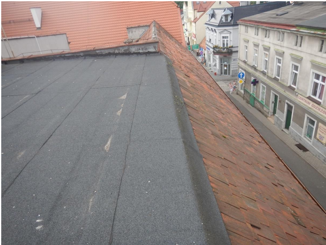
Fot.7 Dach łącznika - łączenie dachu płaskiego z dachem stromym
