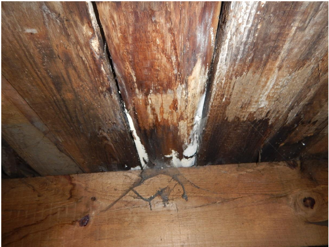
Fot.35 Widok deskowania w miejscu zaciekania dachu
