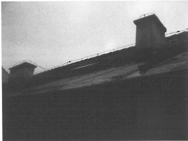
Dach od strony Garncarskiej strona wewnętrzna.
