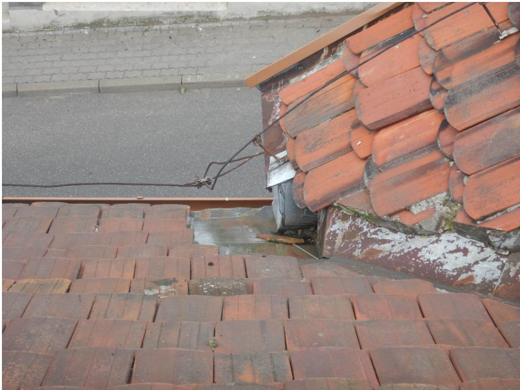
Fot.9 Dach łącznika - obróbka kosza
