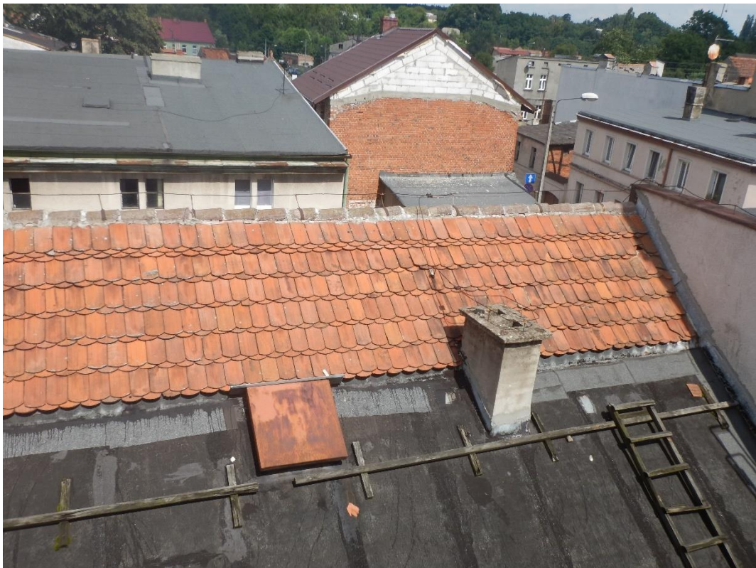
Fot.6 Dach łącznika - atyka przy połączeniu z dachem płaskim
