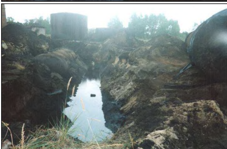
Fot. 12. Zdjęcie archiwalne z lat 2004-2006. Rów wypełniony krezotem po wykopanym zbiorniku. Obok w gruncie widać jeszcze kolejny zbiornik 60 m 3 . W tle znajduje się nadziemny zbiornik stalowy. Ten zbiornik zlikwidowano zupełnie, zaś niższy, ucięty, pozostaje do dziś ze smolą krezotową.
