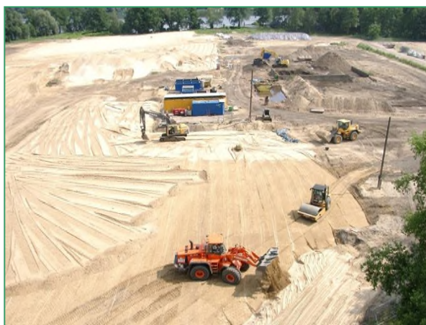
Ryc. 45. Widok z wieży ciśnień na teren w trakcie płukania i redepozycji oczyszczonego gruntu w roku 2008. Fot. GKU GmbH.
