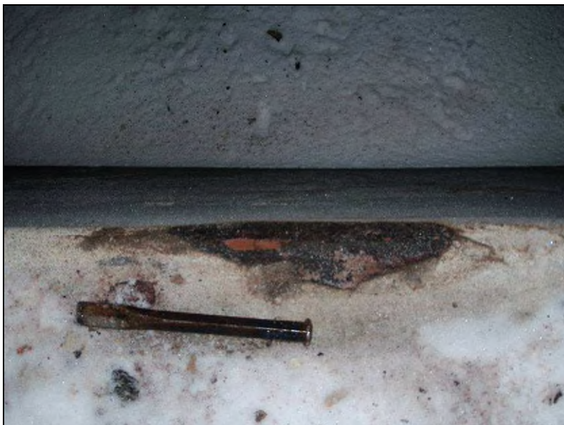
Fot. 25. Zdjęcie wykonane od góry po ścianie zbiornika (w czasie śnieżnej zimy 2009/2010) ujawnia, że gładź cementowa pokrywająca murowane z cegieł ściany jest w całej swej objętości przesiąknięta kreozotem, co potwierdzają wyniki analiz chemicznych.
