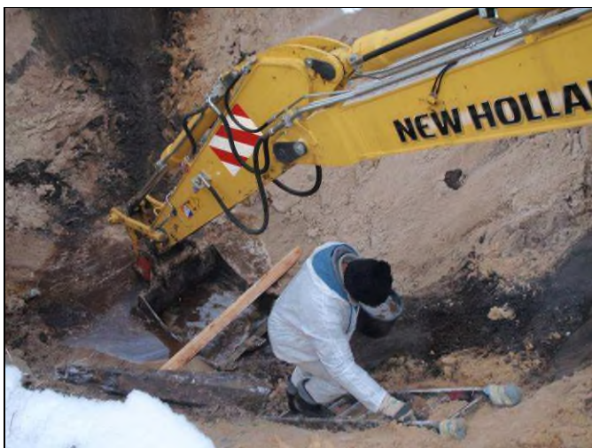
Fot. 21. Pobór próbki wody do badań z szurfu Sol II w dniu 7.01.2010. W wykopie wyraźnie widoczna jest wąska, pionowo przebiegająca strefa zanieczyszczeń.
