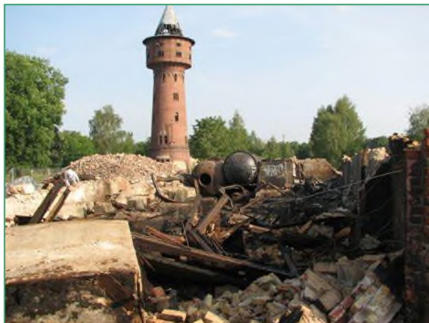
Ryc. 43. Po rozbiórce budynków miała pozostać tylko oryginalna wieża ciśnień, stojąca na gruncie bez zanieczyszczeń. Fot. GKU GmbH
