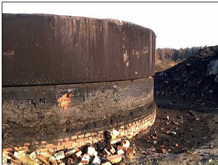
Fot. 23. Odstonięta w wykopie podmurówka cylindrycznego zbiornika na krezot. Po odłupaniu naskorupienia z cegieł fundamentu widoczne są niezanieczyszczone cegły.
