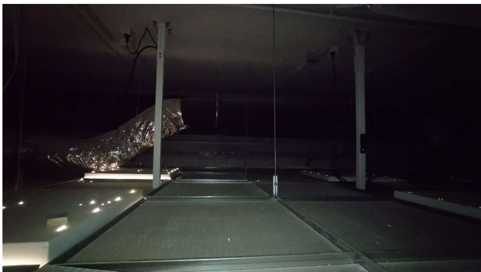
Fot. nr 9: Widok przestrzeni nadsufitowej z instalacjami – część północna
