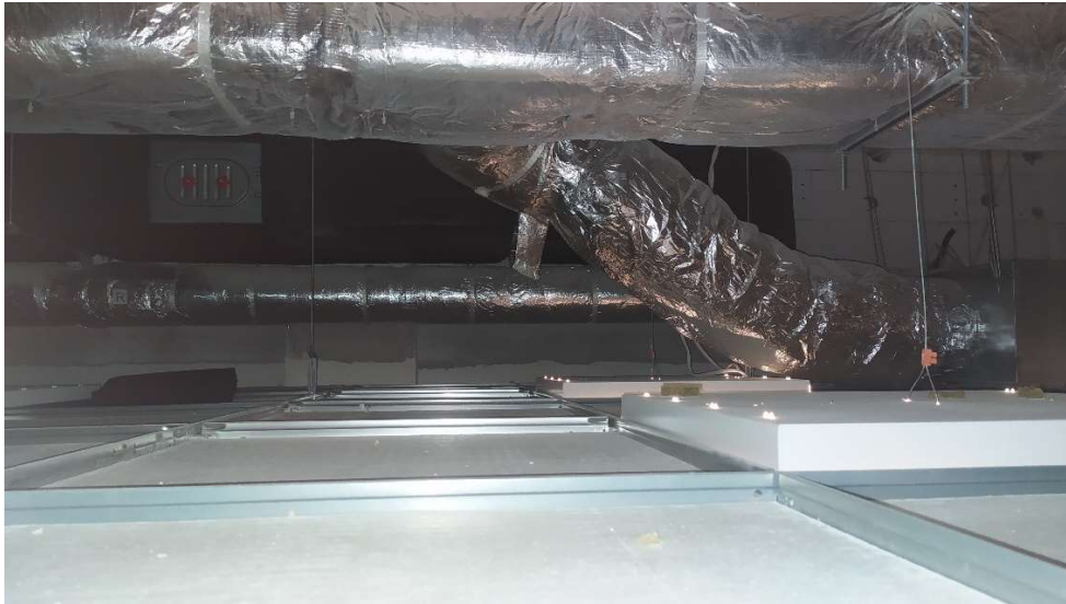
Fot. nr 7: Widok przestrzeni nadsufitowej z instalacjami – część południowa
