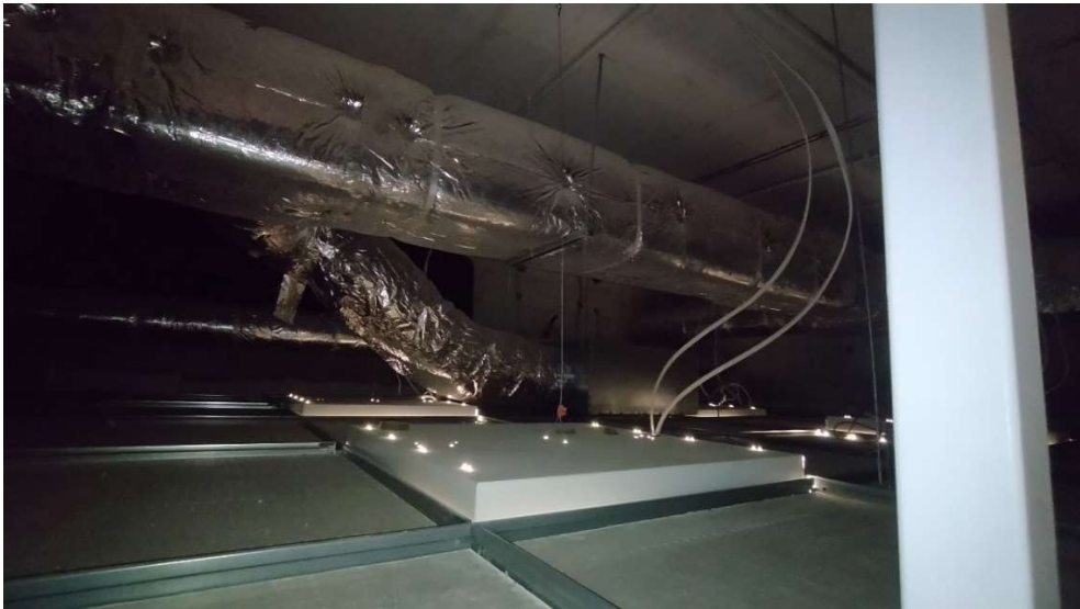
Fot. nr 8: Widok przestrzeni nadsufitowej z instalacjami – część południowa
