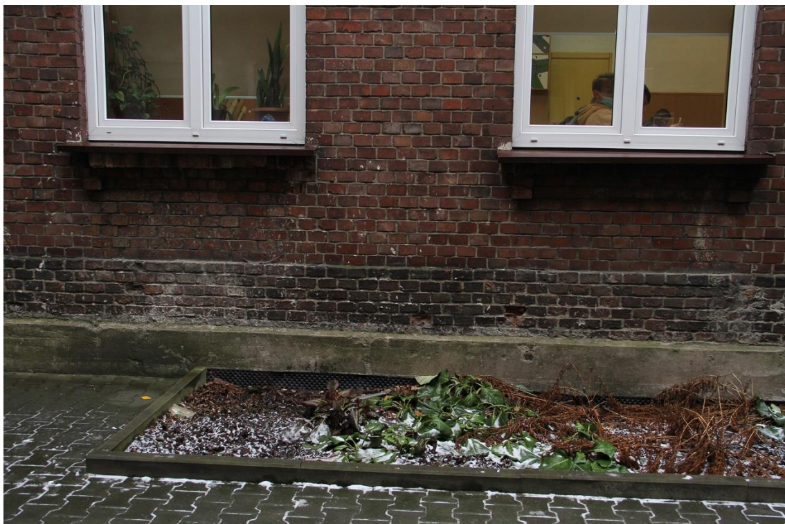
Fot. 10 Zespół Szkół nr 1 im. Stanisława Staszica ul. Górnicza 12 Olkusz. Elewacja tylna, budynku głównego.
