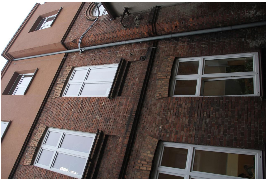
Fot. 2 Zespół Szkół nr 1 im. Stanisława Staszica ul. Górnicza 12 Olkusz. Elewacja tylna, budynku głównego.
