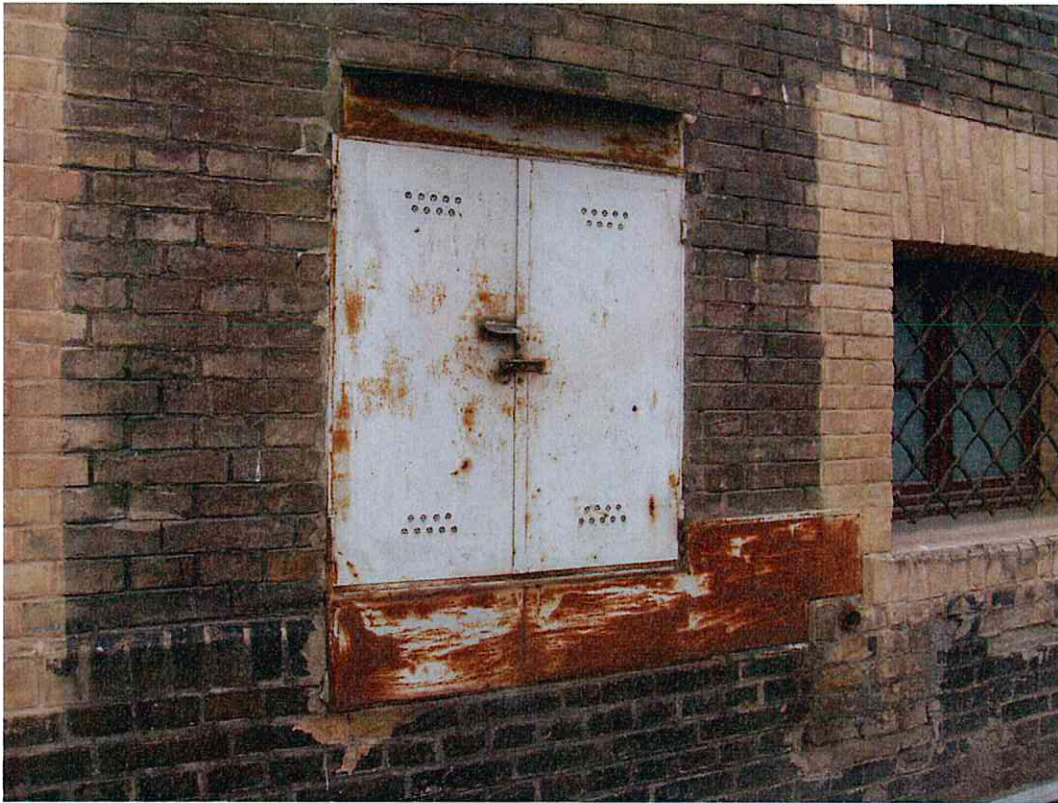
70. Przyłącze energetyczne - do wymiany.
