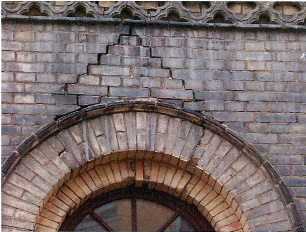
66. Spękania pomiędzy II i III kondygnacją.
