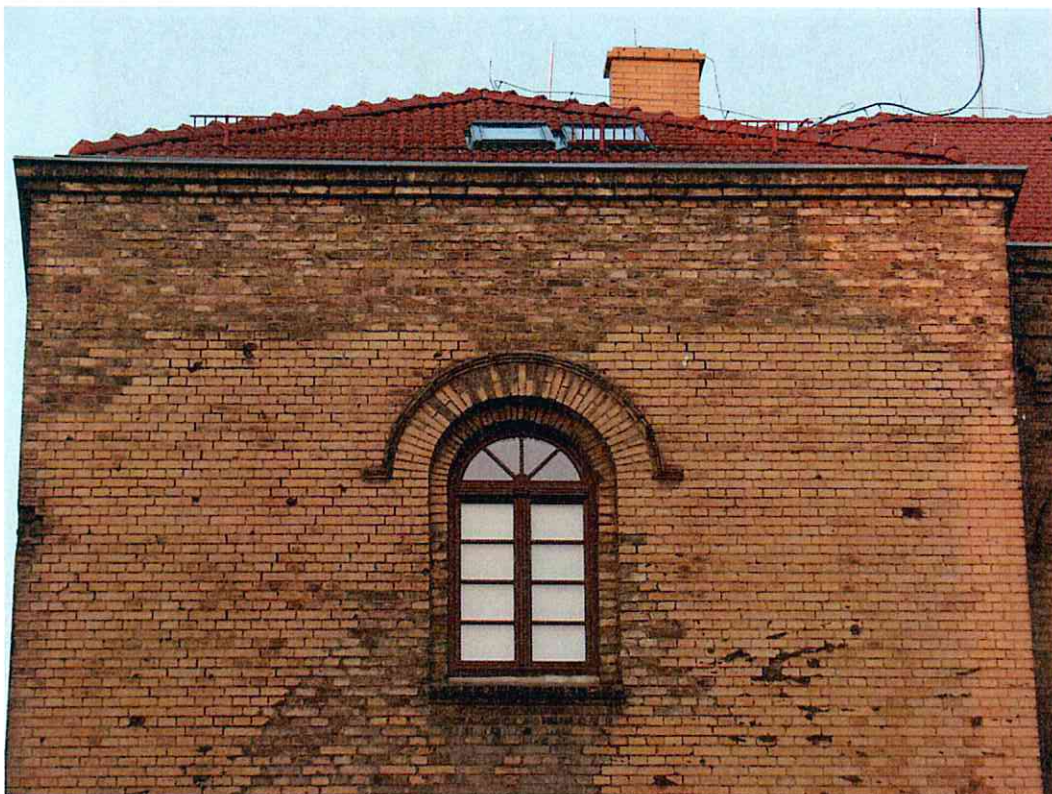
43. Wadliwie wymurowane zwieńczenie ryzalitu zachodniego, bez rekonstrukcji pierwotnej formy.
