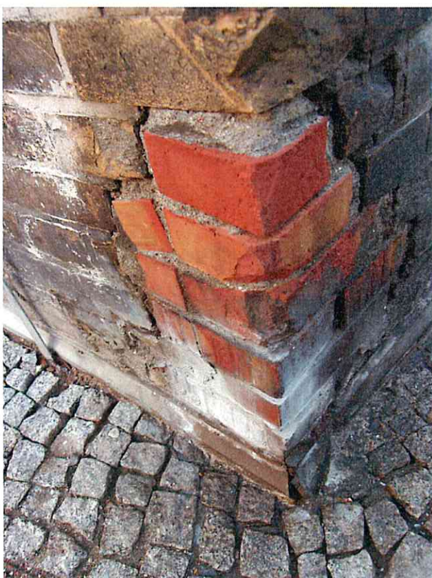
45. Ryzalit wschodni - wadliwie przemurowany narożnik cokołu.
