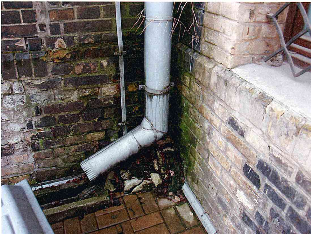
71. Zniszczenia powstałe na skutek nieszczelności opierzeń i złego odprowadzenia wody.
