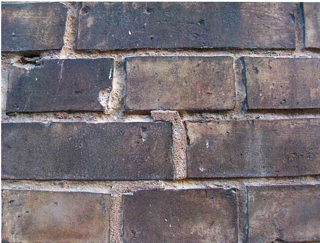
83. Stan zanieczyszczenia lica. Widoczna oryginalna spoina w żółtym kolorze.
