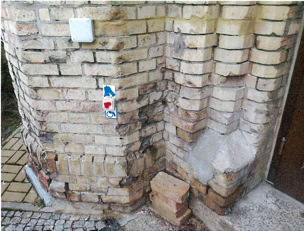
34. Stan zachowania cegieł i spoin w dolnej partii ościeża portalu.
