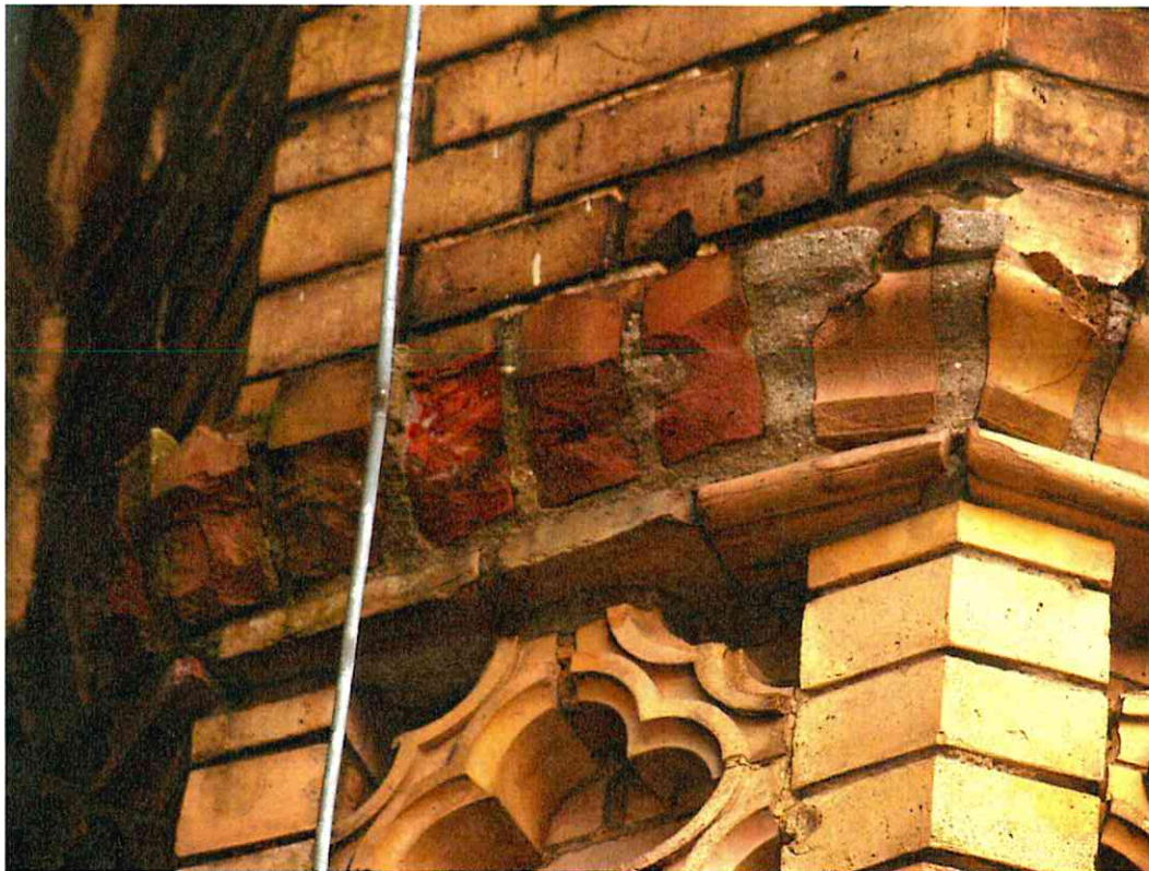
36. Wadliwe uzupełnienia ubytków kształtek we fryzie.
