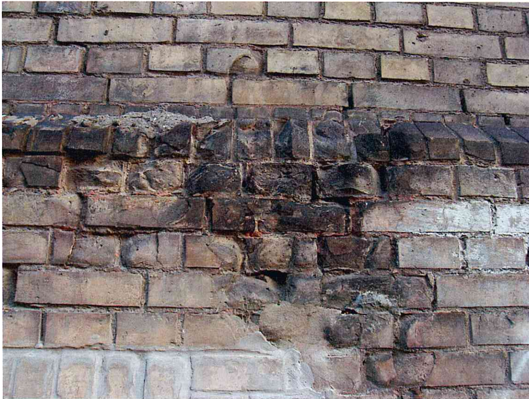
78. Stan zachowania lica w partii cokołowej.
