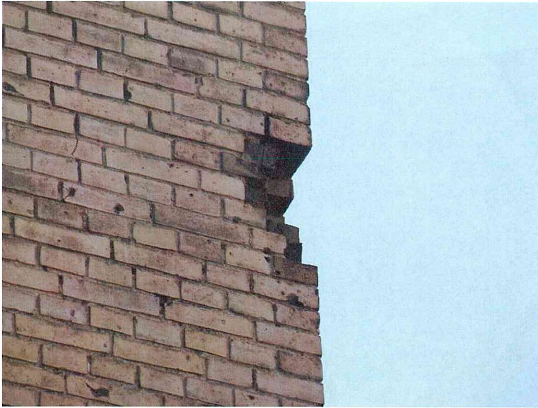
77. Ubytki wstku murowego w narożu z elewacją południową.
