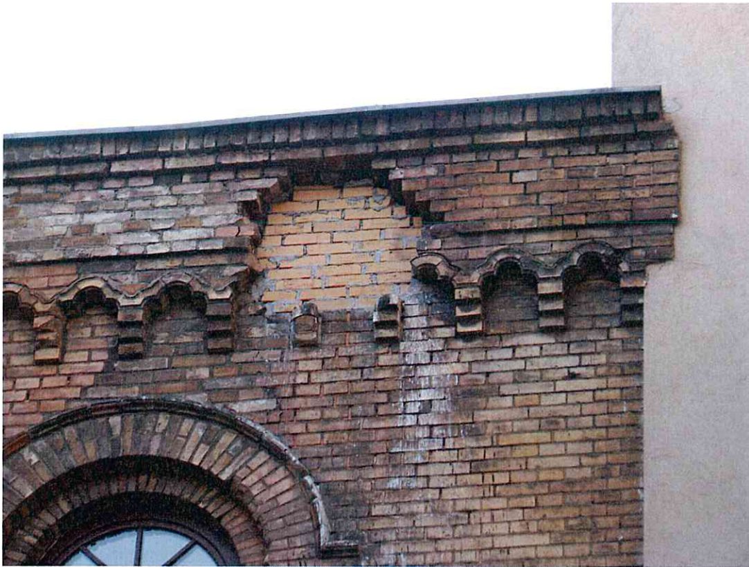
51. Uszkodzenia gzymsu skrzydła zachodniego na styku z Urzędem Skarbowym.
