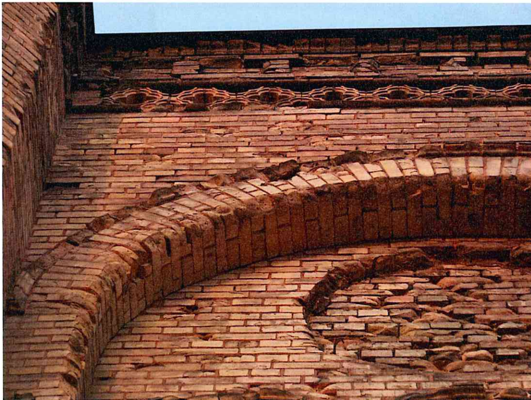
39. Stan zachowania gzymsu wieńczącego ryzalit centralny.
