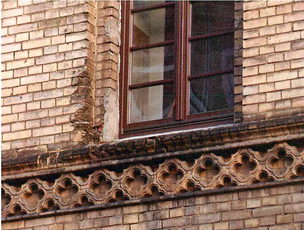
81. Stan fryzu i ościeży okiennych.
