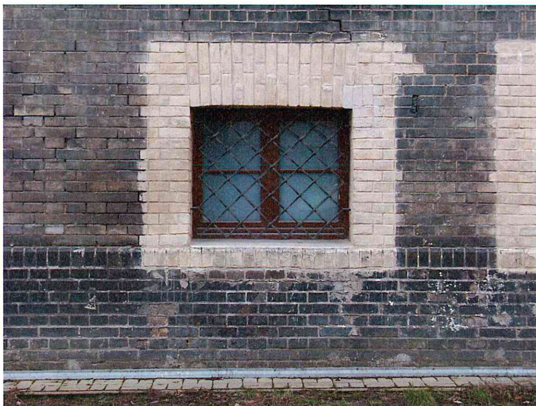
64. Okna w strefie cokołowej, z wtórnym okratowaniem i konserwacją lica wokół otworu.
