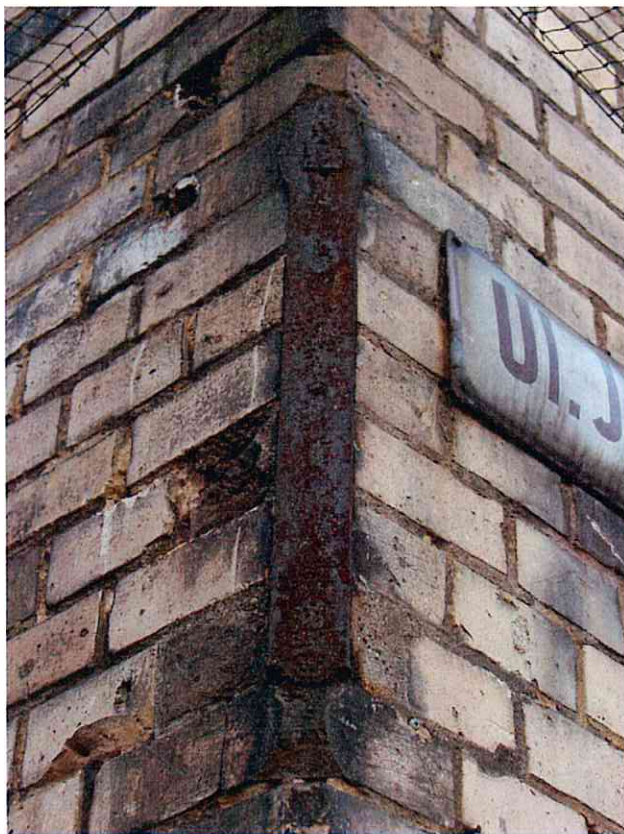
82. W narożu z elewacją południową zachował się fragment wspornika latarni gazowej.
