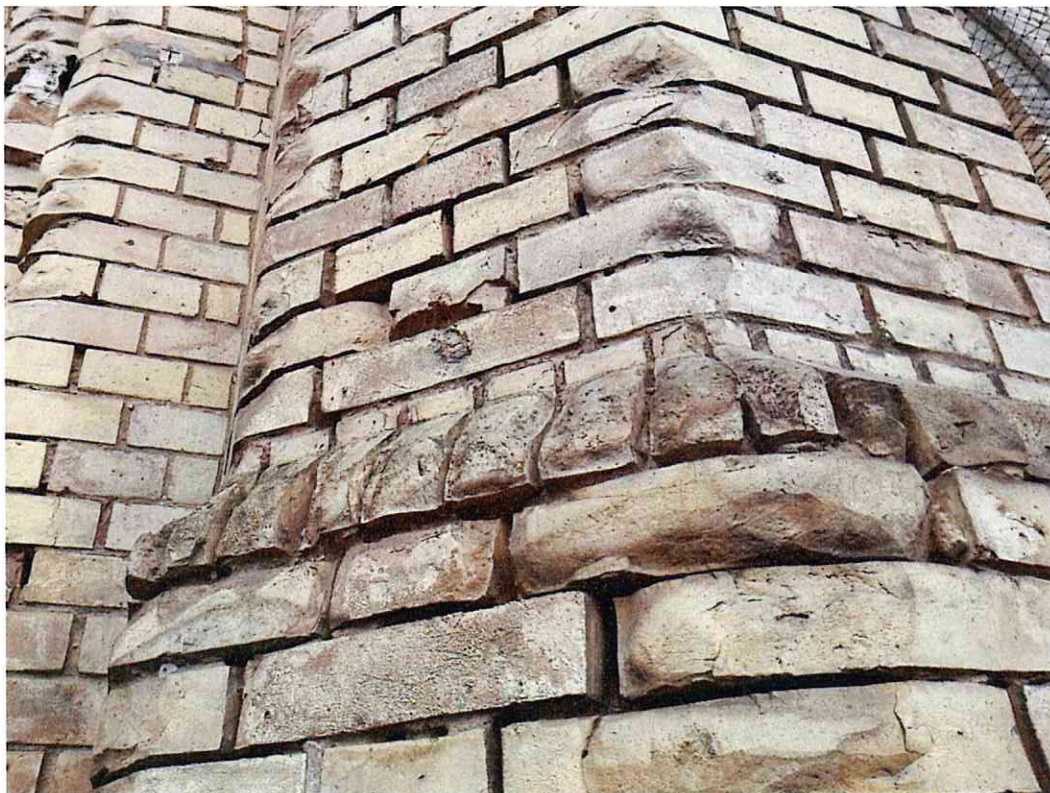
35. Stan zachowania cegieł i spoin w zwieńczeniu partii cokołowej.
