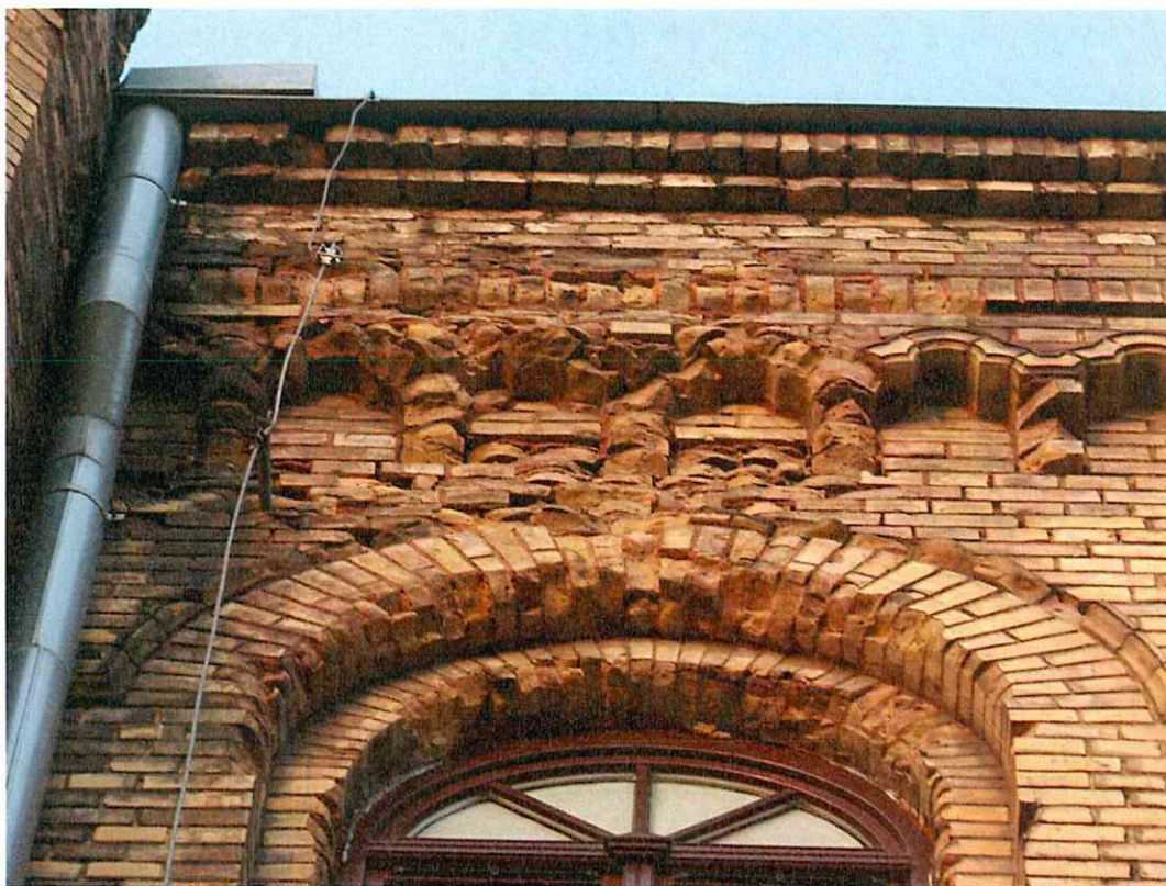
40. Stan zachowania gzymsu kordonowego korpusu głównego.
