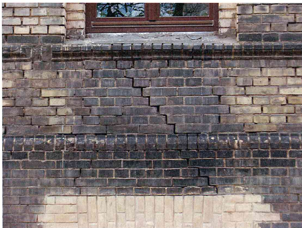
65. Spękania pomiędzy I i II kondygnacją.
