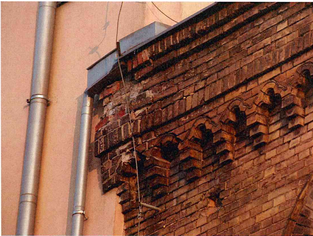
80. Stan gzymsu na styku z budynkiem Urzędu Skarbowego.
