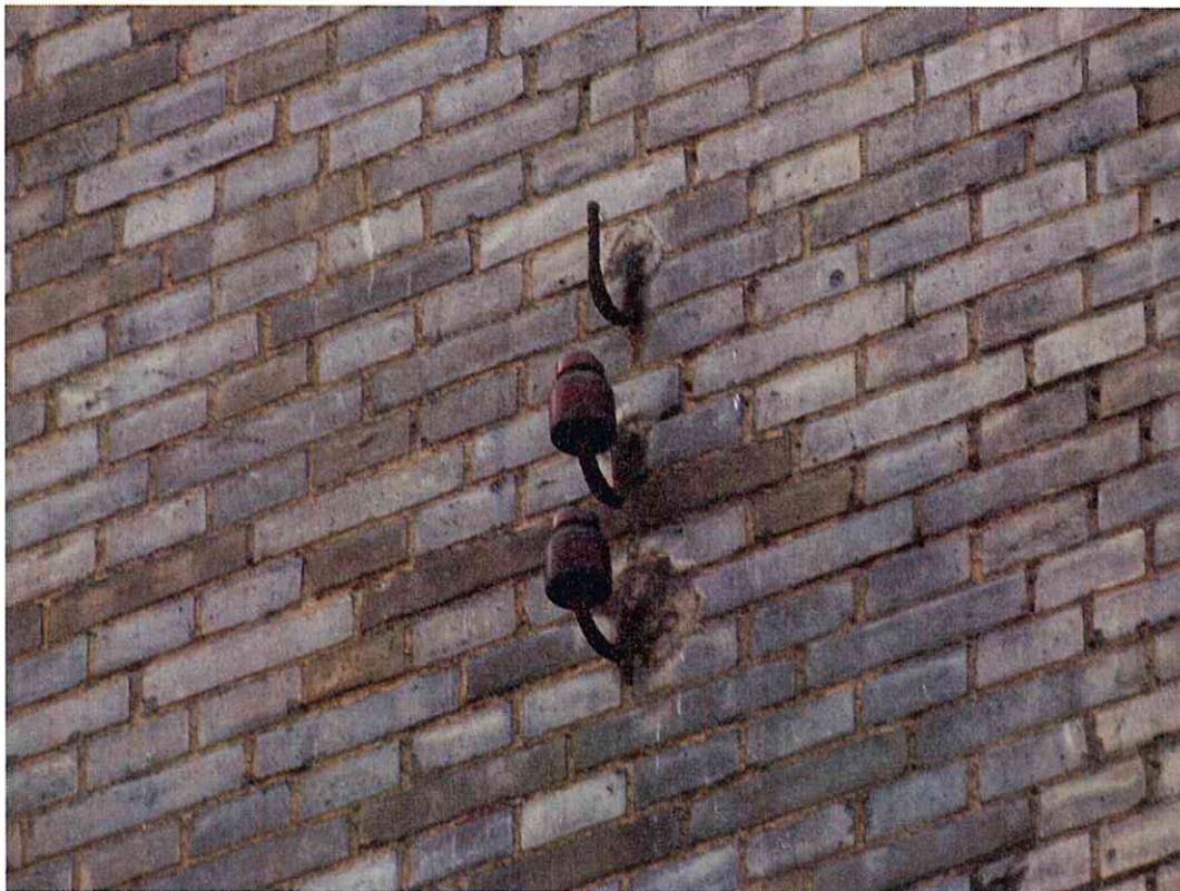
73. Pozostałości instalacji elektrycznych - do konserwacji lub usunięcia.
