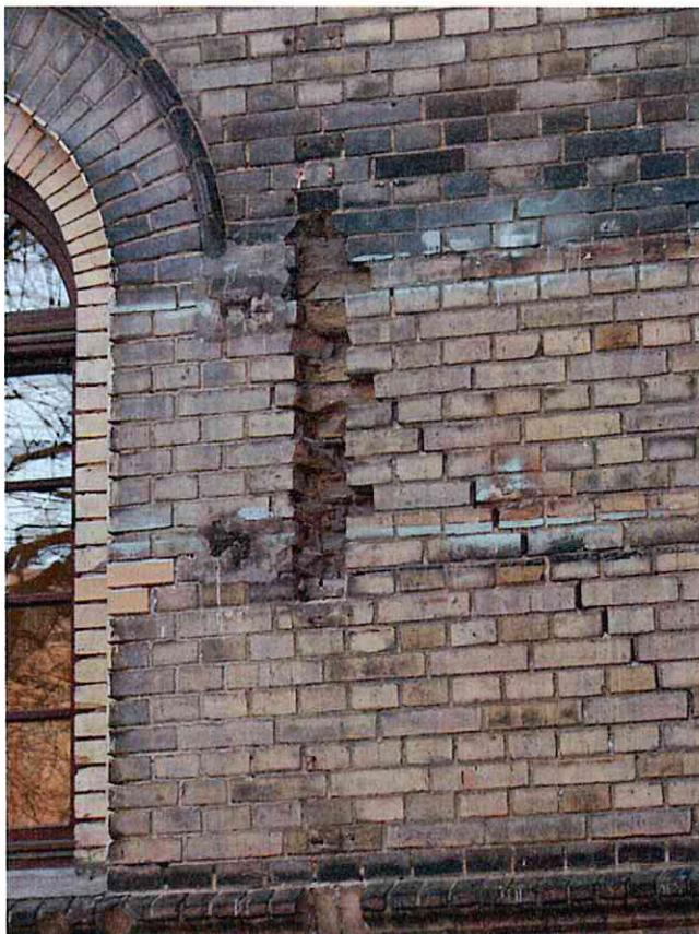
56. Przykładowe uszkodzenia lica korpusu głównego.
