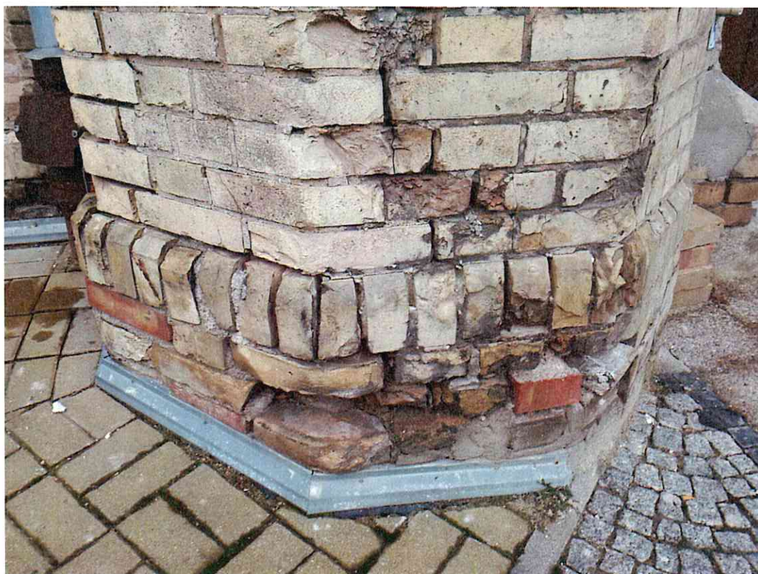
33. Stan zachowania zachodniego filara portalu wejścia.
