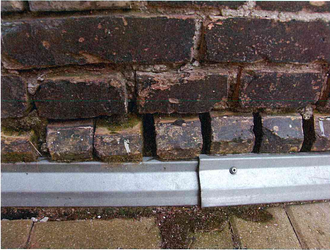
79. Stan zachowania muru na styku z nawierzchnią chodnika.
