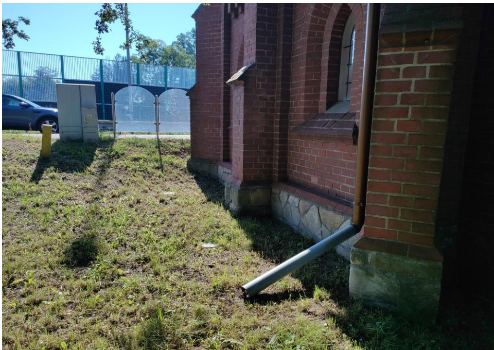
Fot. 3 Rura spustowa do przerobienia (ukierunkowanie sptywu wody opadowej w rabatę)
