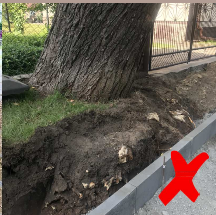
Zniszczenie drzewa na skutek obcięcia korzeni BŁĄD PROJEKTOWY
