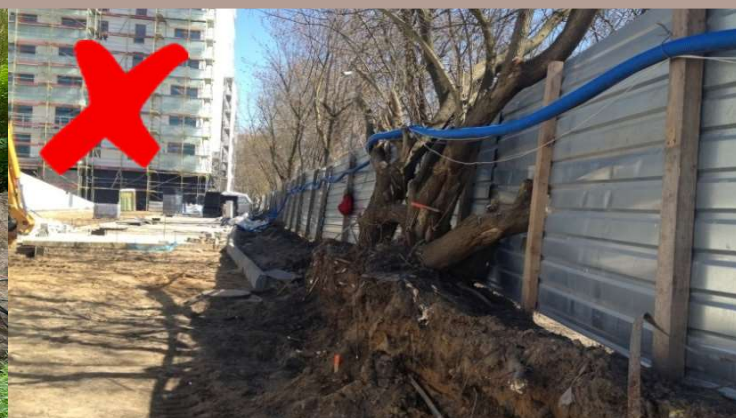
ZDJĘCIEM WIERZCHNIEJ WARSTWY GLEBY, USZKODZENIE KRYTYCZNE – RYZYKO WYKROTU Zabezpieczenie/ ekran ➡ Karta nr 5.
