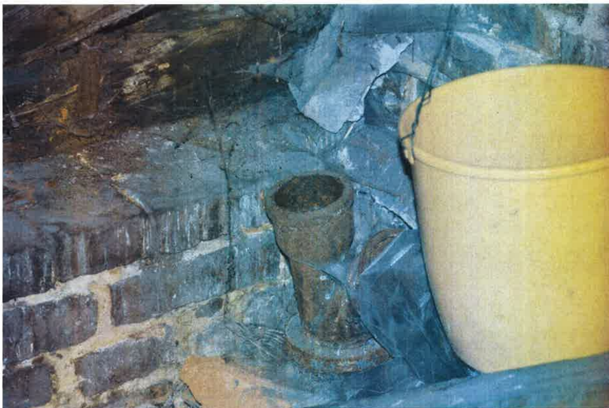
Fot. 33. Wywiewka kanalizacji nie wyprowadzona ponad dach, wiadro zbierające wodę, folia zabezpieczająca polepę, rozpad murłaty
