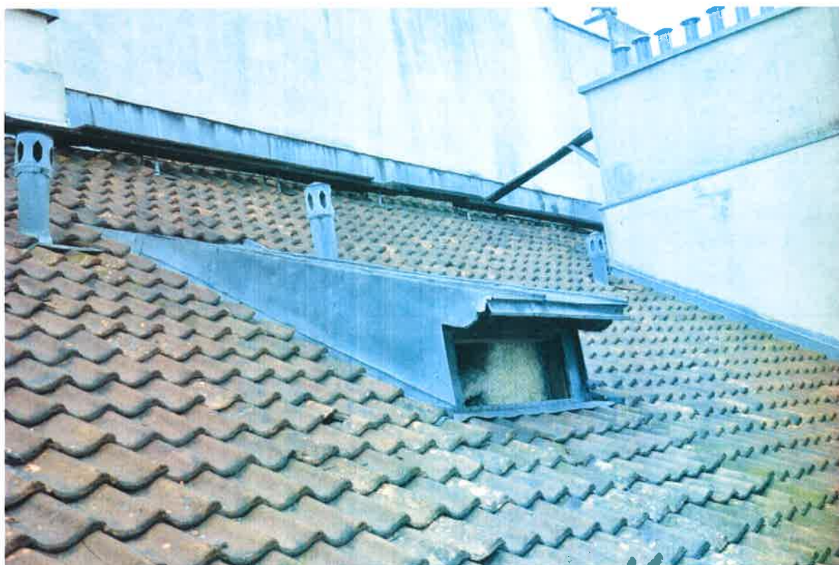
Fot. 54. Destrukcja obróbek blacharskich lukarn
