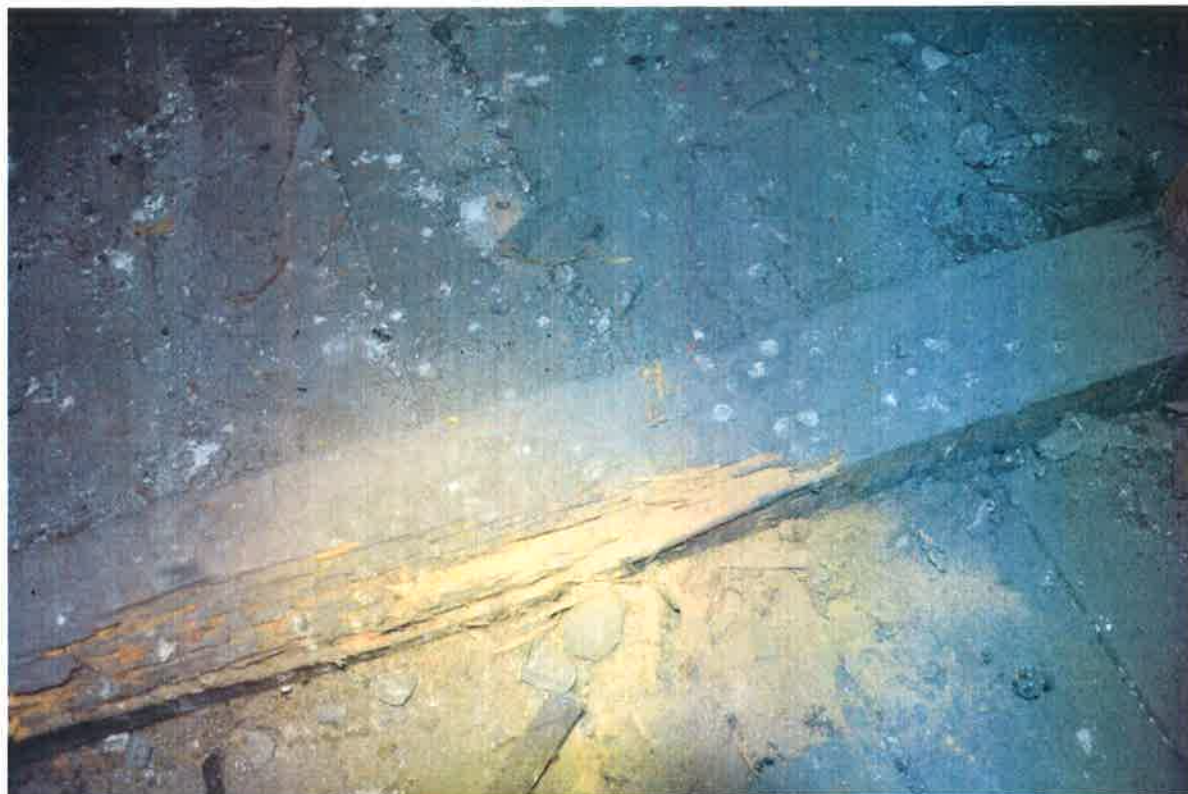
Fot. 23. Rozpad drewna podwaliny
