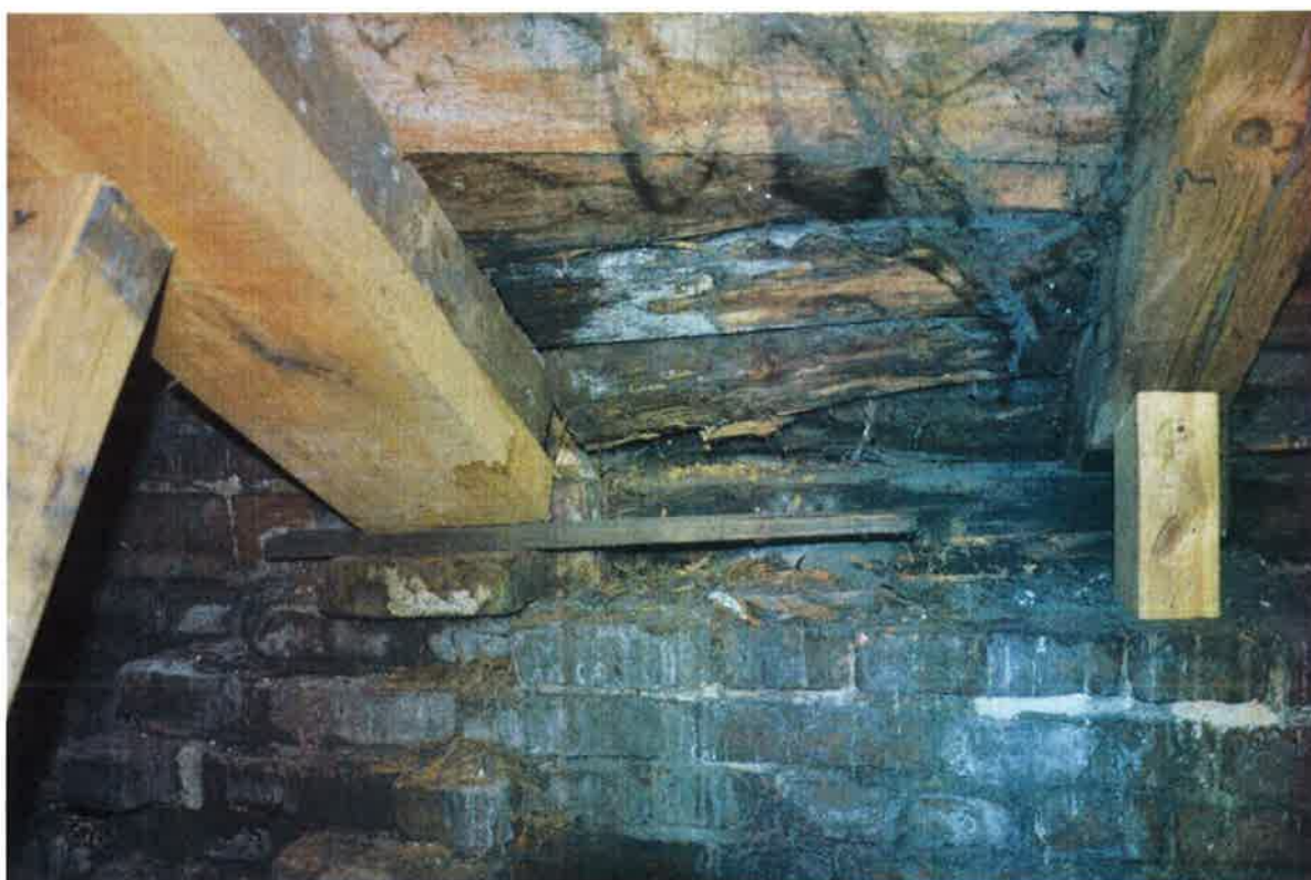
Fot. 22. Zniszczone krokwie, deskowanie od strony ulicy. Zawilgocenie więźby i muru. Tymczasowe zabezpieczenie konstrukcji dachu.
