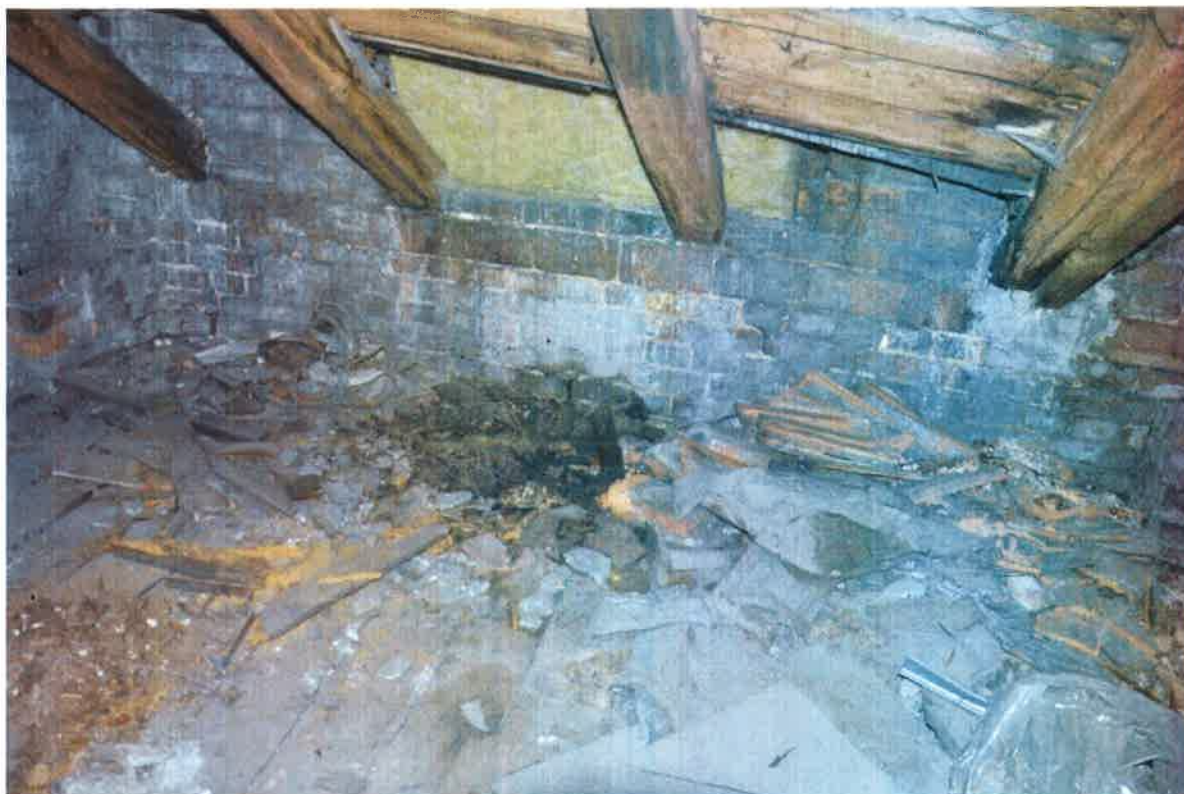
Fot. 21. Zniszczone krokwie od strony ulicy, przeciek wody opadowej przez obróbki kosza
