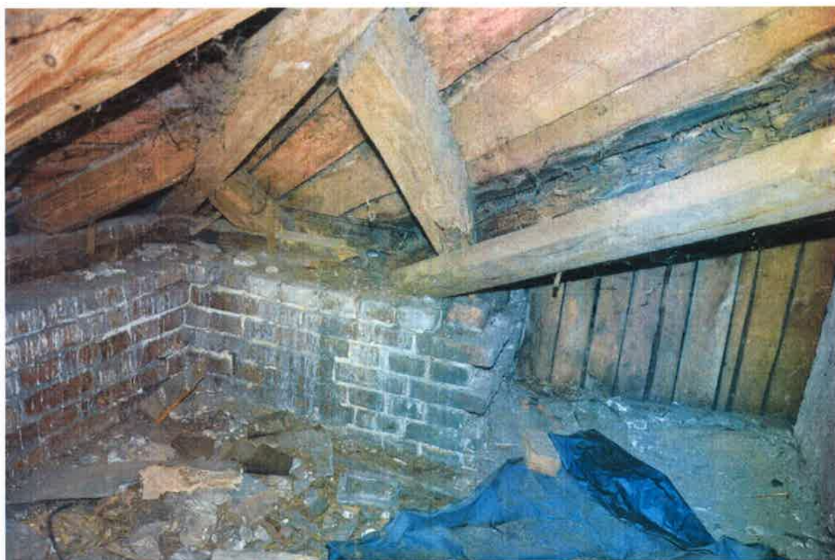
Fot. 26. Zniszczona krokiew koszowa i jej tymczasowe podparcie, przecieki wody opadowej
