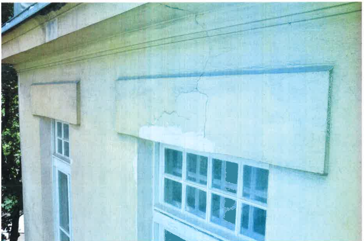
Fot. 68. Zarysowania, odspojenia tynku
