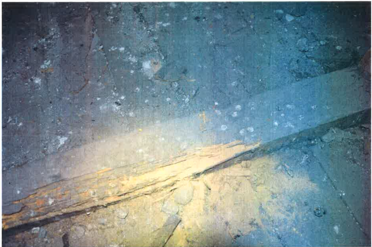
Fot. 23. Rozpad drewna podwaliny
