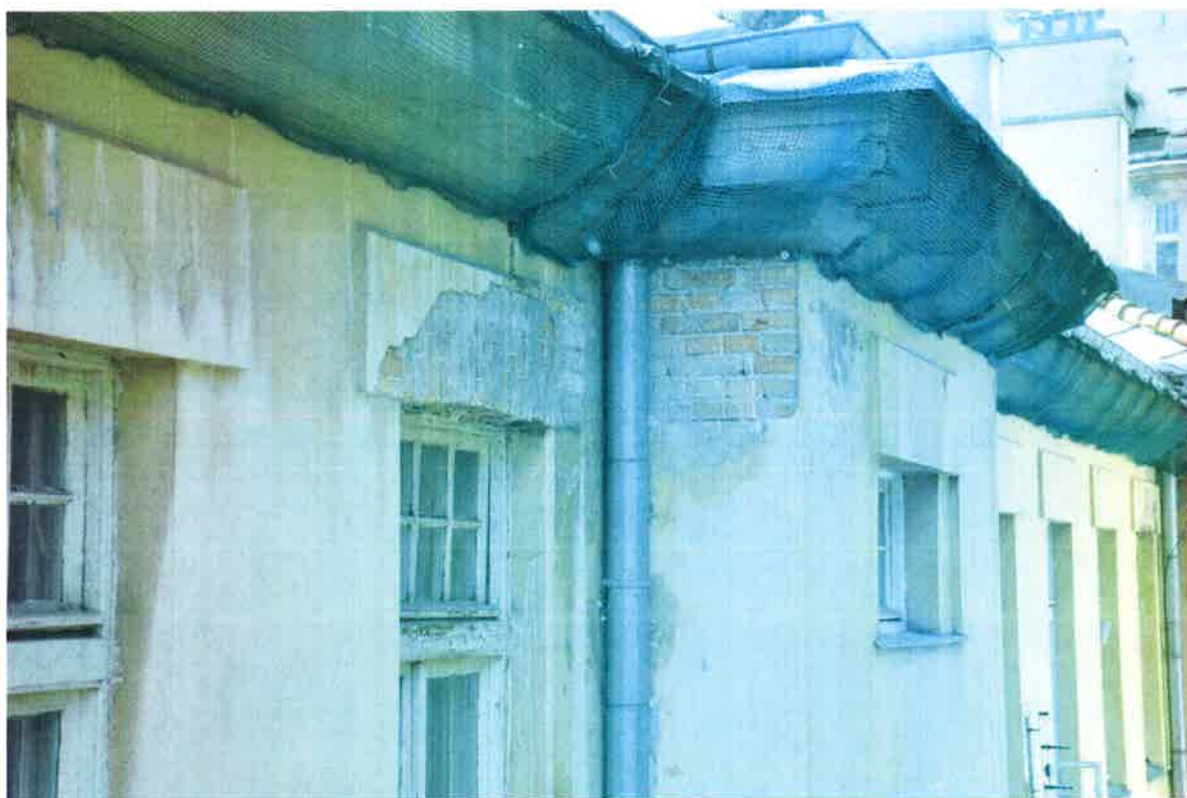
Fot. 70. Zarysowania, odspojenia tynku
