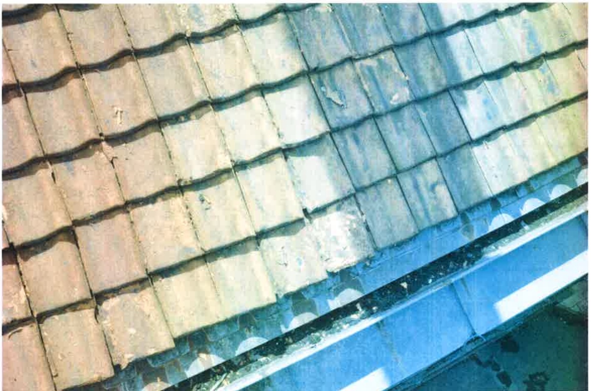
Fot. 58. Zniszczenia dachówek
