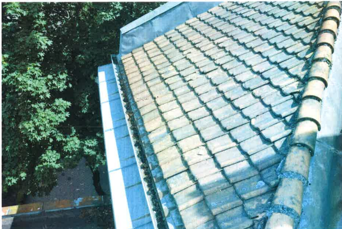
Fot. 53. Korozja obróbek blacharskich pasa nadrynnowego oraz gzymsu, korozja rynien
