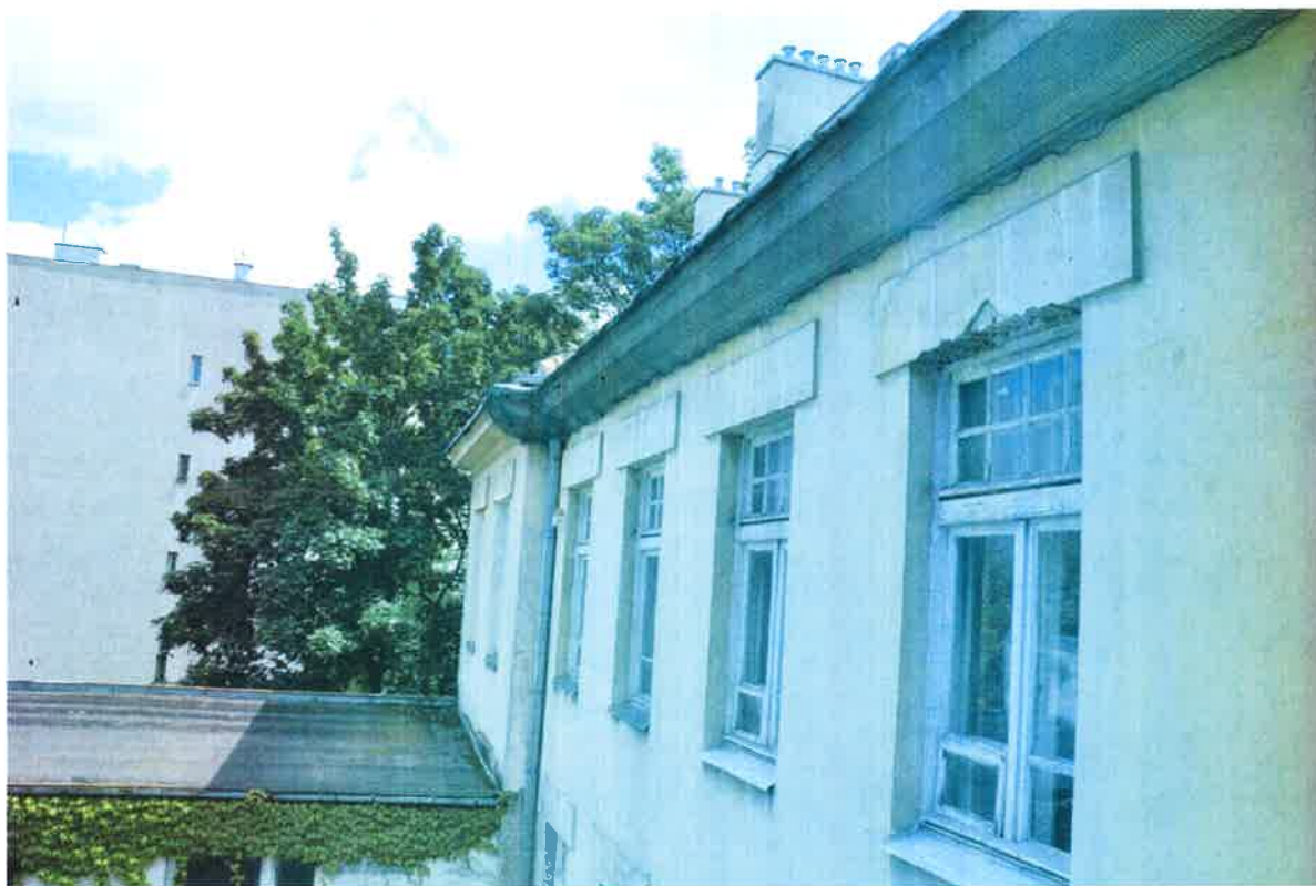
Fot. 69. Zarysowania, odspojenia tynku
