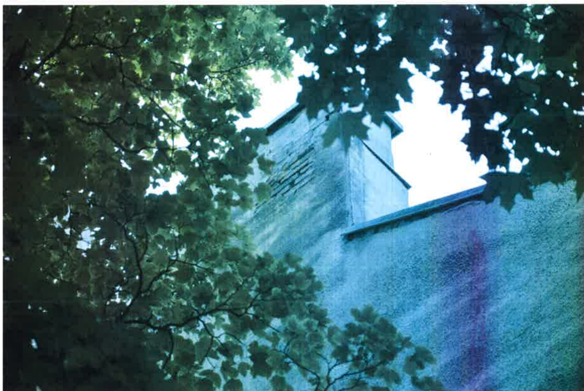
Fot. 74. Odspojenie tynku na kominie ściany szczytowej wschodniej
