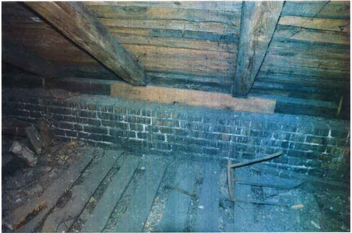
Fot. 39. Wzmocnienie murlaty, zniszczona podłoga
