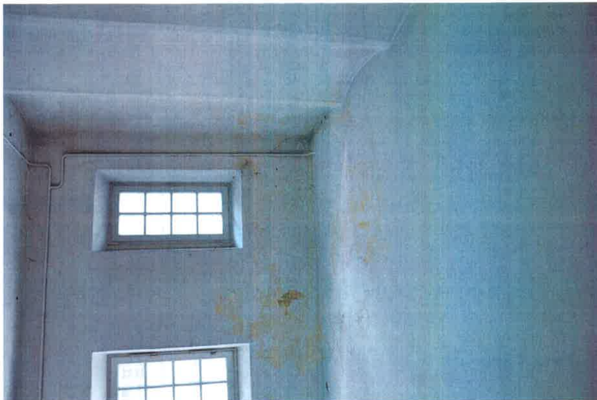
Fot. 11. Zawilgocenie i zagrzybienie stropu oraz ścian na klatce schodowej od ulicy
