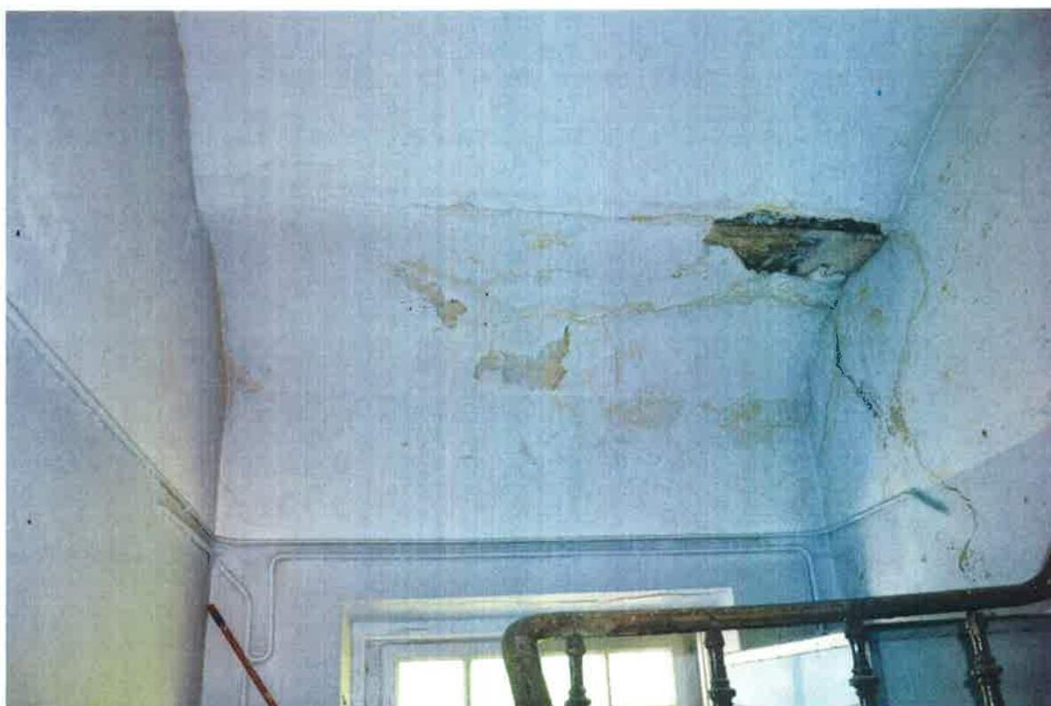
Fot. 17. Zawilgocenie i zagrzybienie stropu oraz ścian na klatce schodowej od dziedzińca, a także zarysowania i odspojenia tynku
