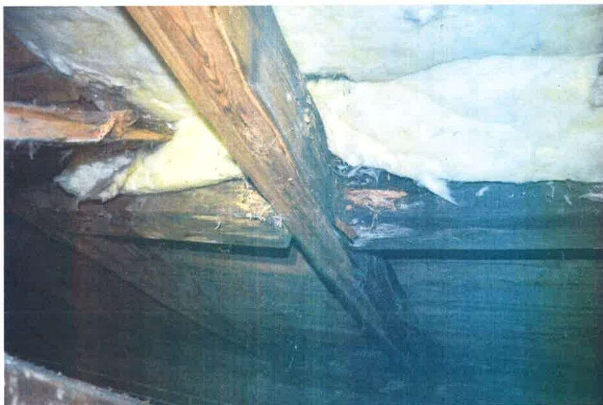
Fot. 38. Zniszczenie i zawilgocenie wymianu pod lukarną
