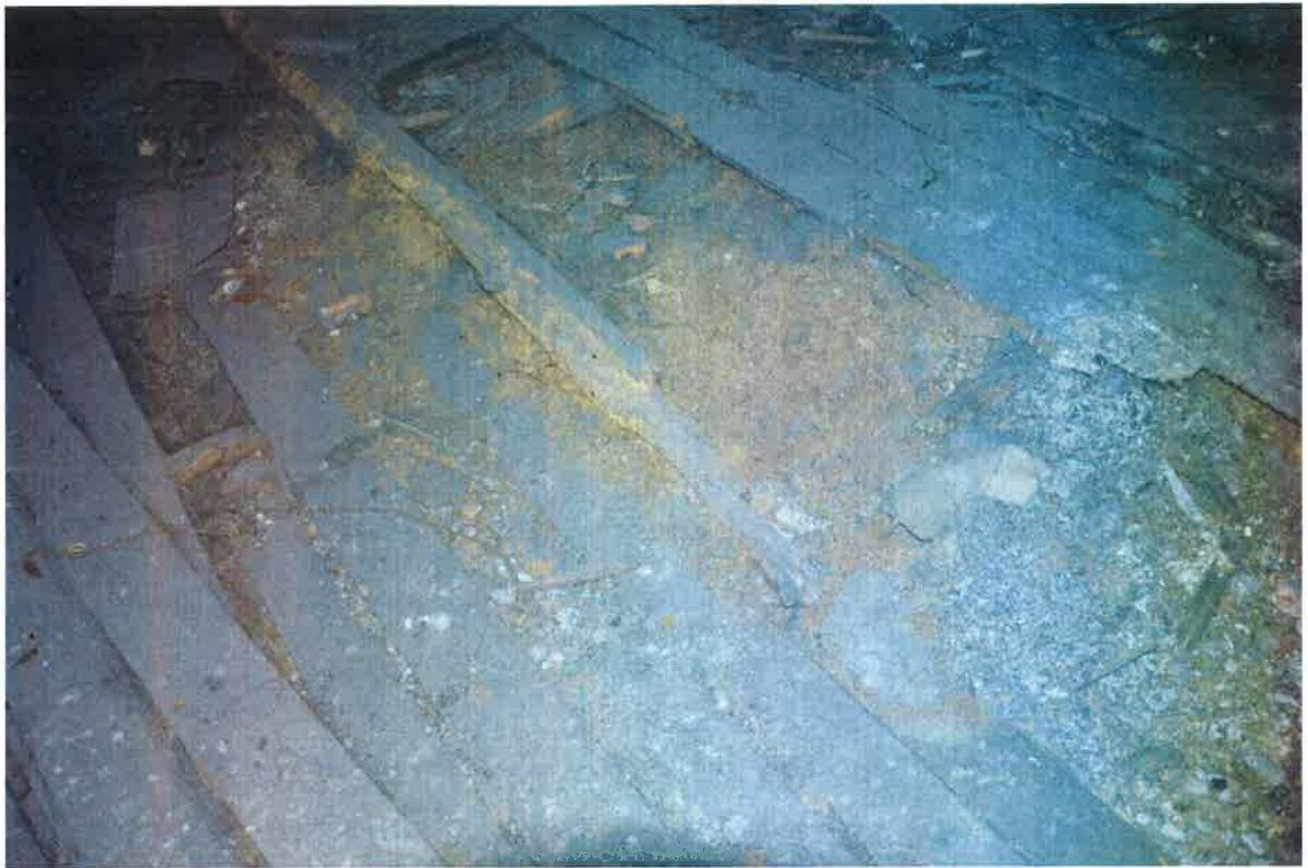
Fot. 31. Rozpad drewna tramu wieszara dachu, ubytki podłogi drewnianej
