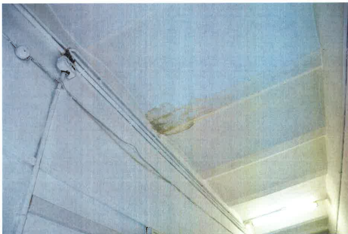
Fot. 16. Zawilgocenie i zagrzybienie stropu ma korytarzu
