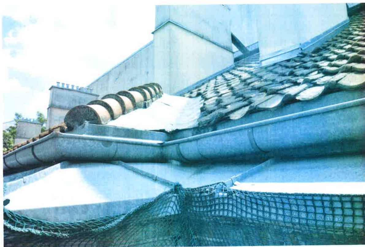
Fot. 60. Brak szczelności obróbek blacharskich koszy
