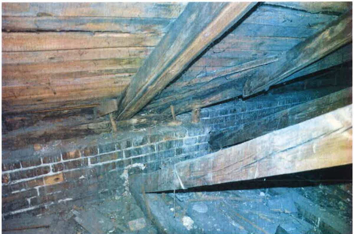
Fot. 40. Zniszczenia murlaty i krokwi koszowej, ślady zawilgoceń
