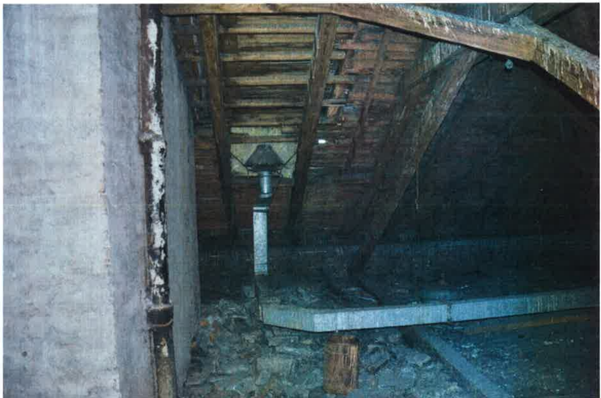
Fot. 24. Przytkana lukarna wełną mineralną, nieczynne przewody wentylacyjne, zanieczyszczenie elementów więźby dachowej odchodami ptaków, gruz zgromadzony na stropie.
