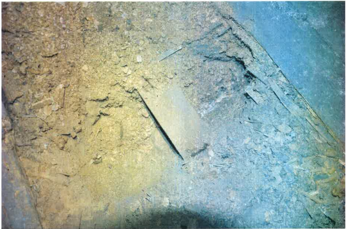
Fot. 45. Odkrywka stropu na styku płyty Hourdisa (z lewej) i sklepienia odcinkowego z prawej - poddasze zachodnie
