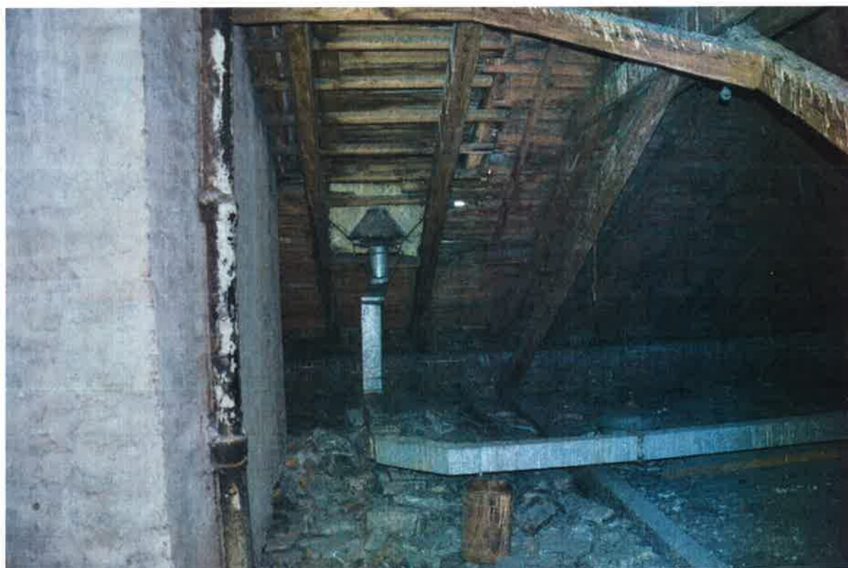
Fot. 24. Przytkana lukarna wełną mineralną, nieczynne przewody wentylacyjne, zanieczyszczenie elementów więźby dachowej odchodami ptaków, gruz zgromadzony na stropie.
