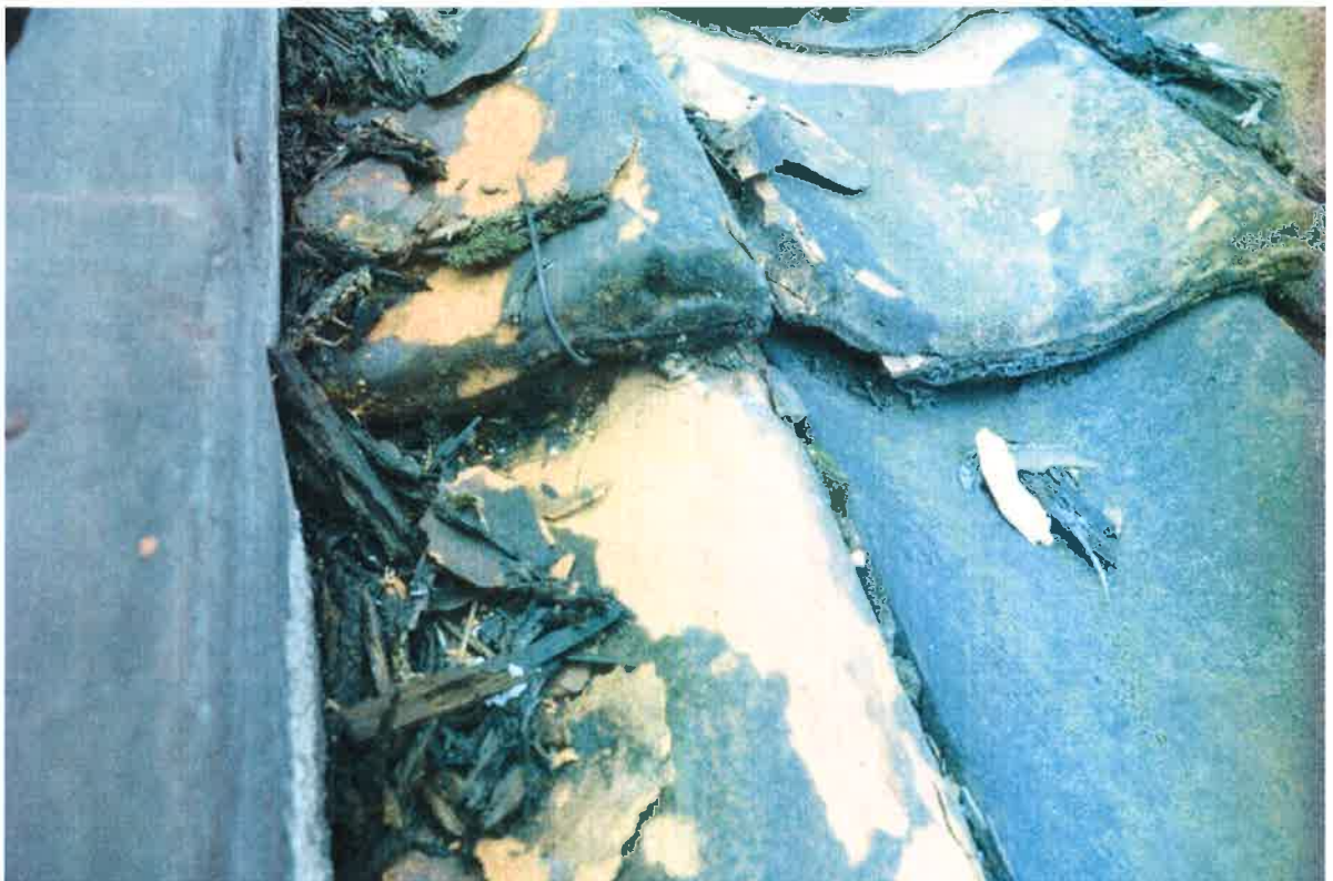
Fot. 56. Zniszczenia dachówek
