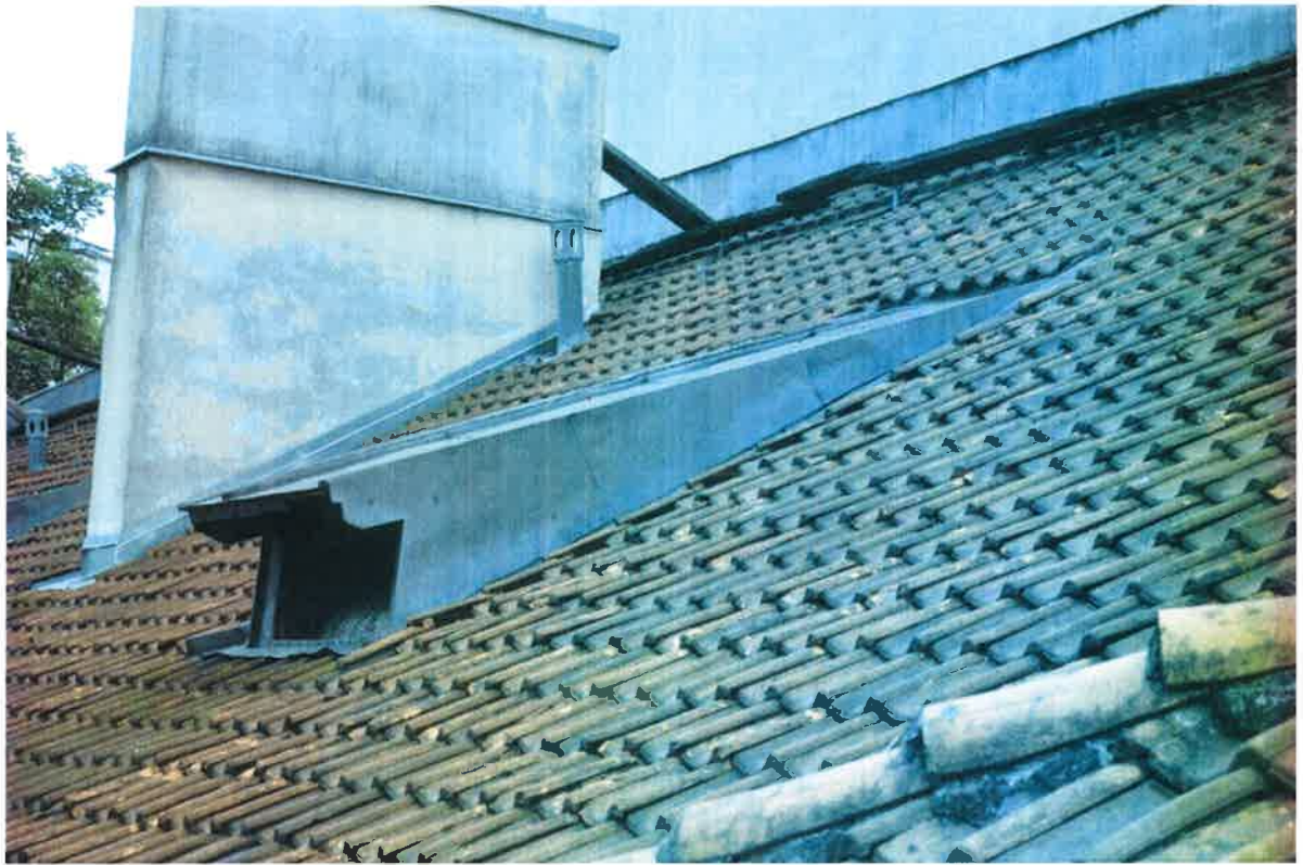
Fot. 55. Destrukcja obróbek blacharskich lukarn
