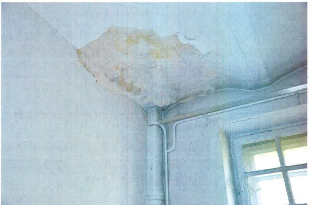
Fot. 14. Zawilgocenie i zagrzybienie stropu oraz ścian, odspojenie i zarywanie tynku na stropie i ścianach w p. 0-215
