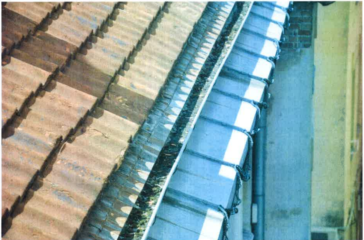
Fot. 52. Korozja obróbek blacharskich pasa nadrynnowego oraz gzymsu, korozja rynien
