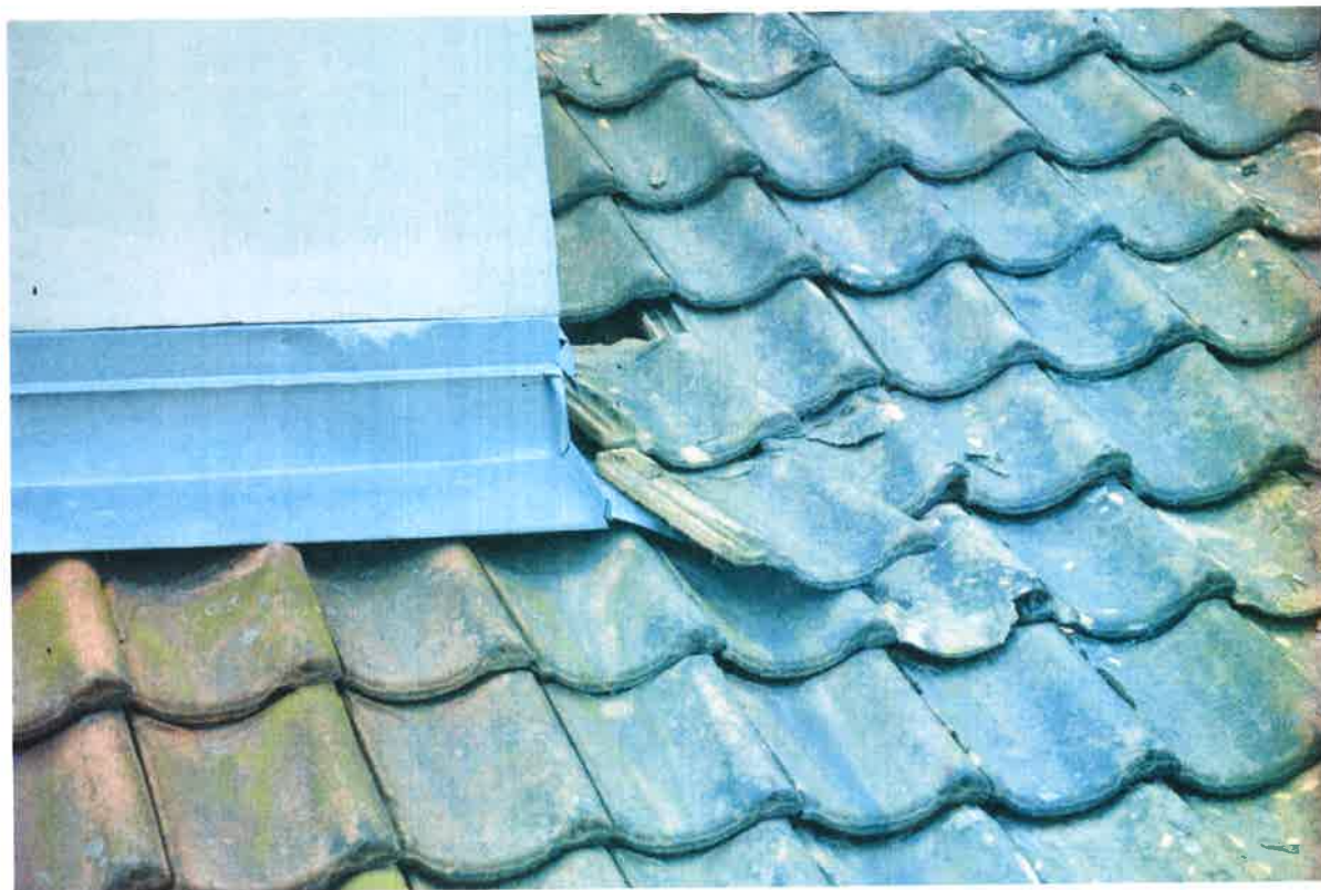
Fot. 59. Przesunięcie dachówek
