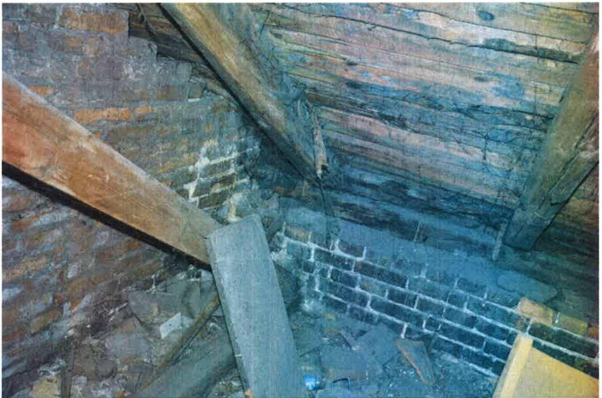
Fot. 36. Zniszczenia krokwi, murlaty, deskowania; zawilgocenia i przecieki wody opadowej
