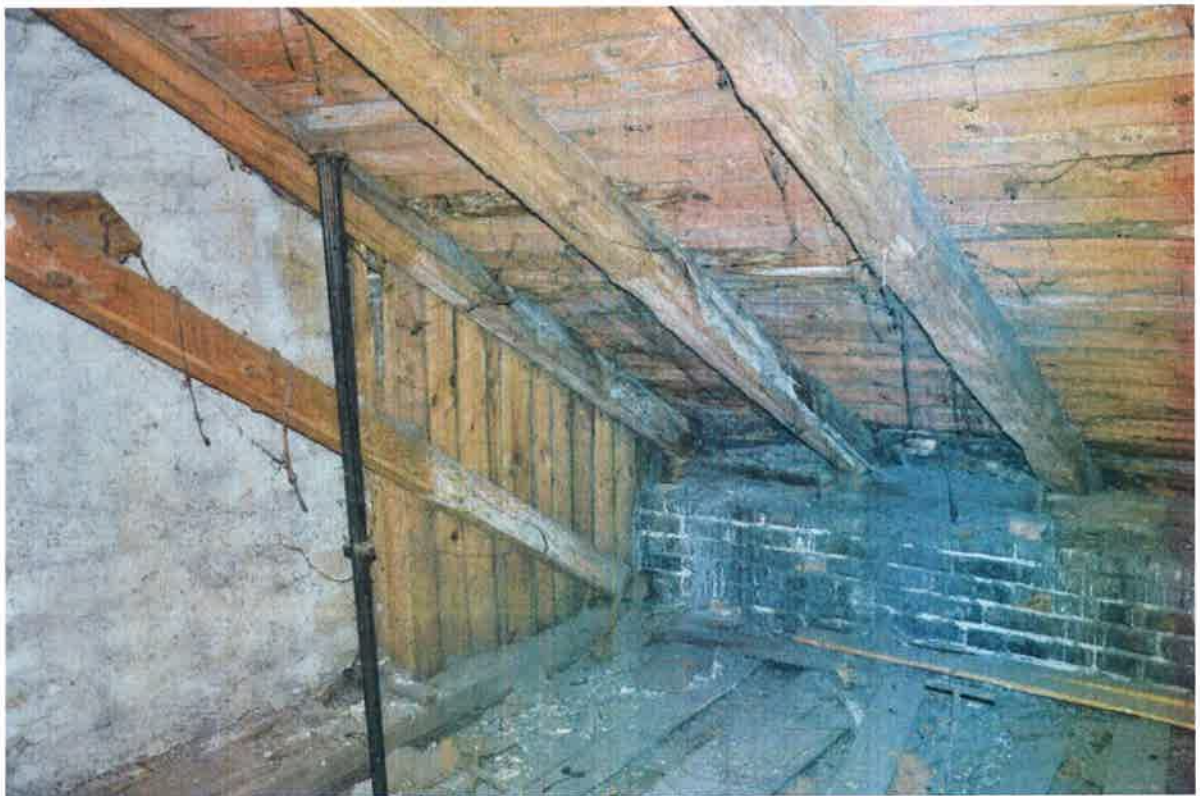
Fot. 28. Ślady zawilgocenia więźby dachowej
