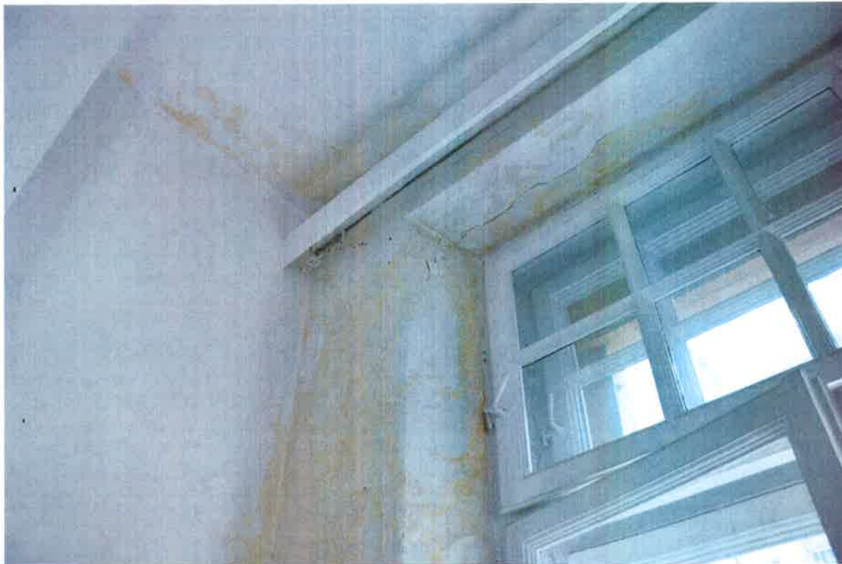
Fot. 9. Zawilgocenie i zagrzybienie stropu oraz ściany w pokoju gościnnym
