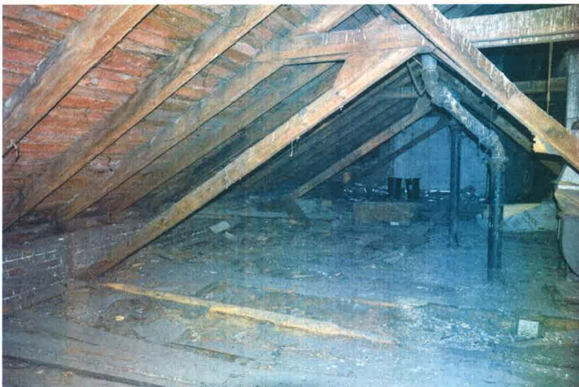
Fot. 34. Poddasze zachodnie - zniszczenia więźby oraz podłogi, nieczynne urządzenia wentylacyjne na poddaszu
