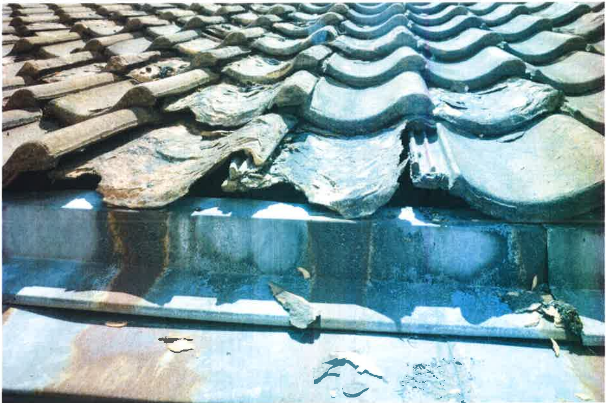
Fot. 57. Zniszczenia dachówek, korozja obróbek blacharskich
