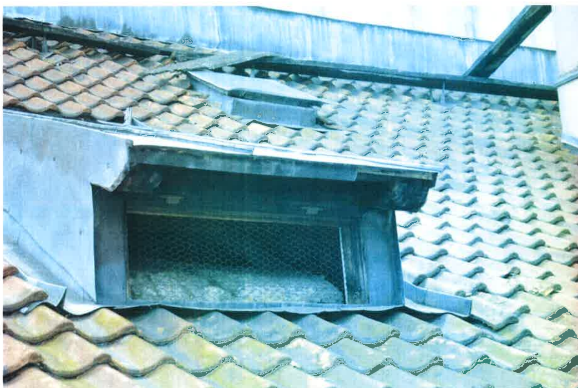
Fot. 66. Zniszczenia ław kominiarskich
