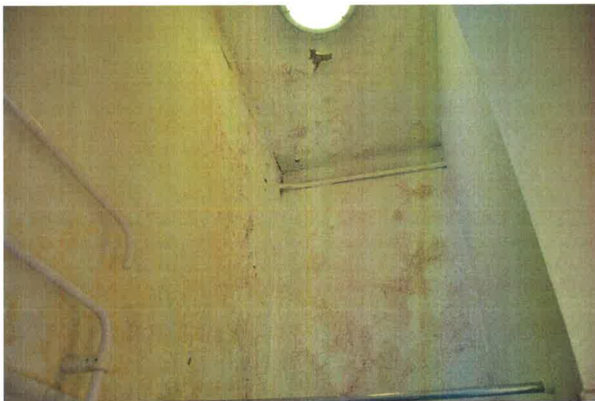
Fot. 10. Zawilgocenie i zagrzybienie stropu oraz ściany w pokoju gościnnym - łazienka
