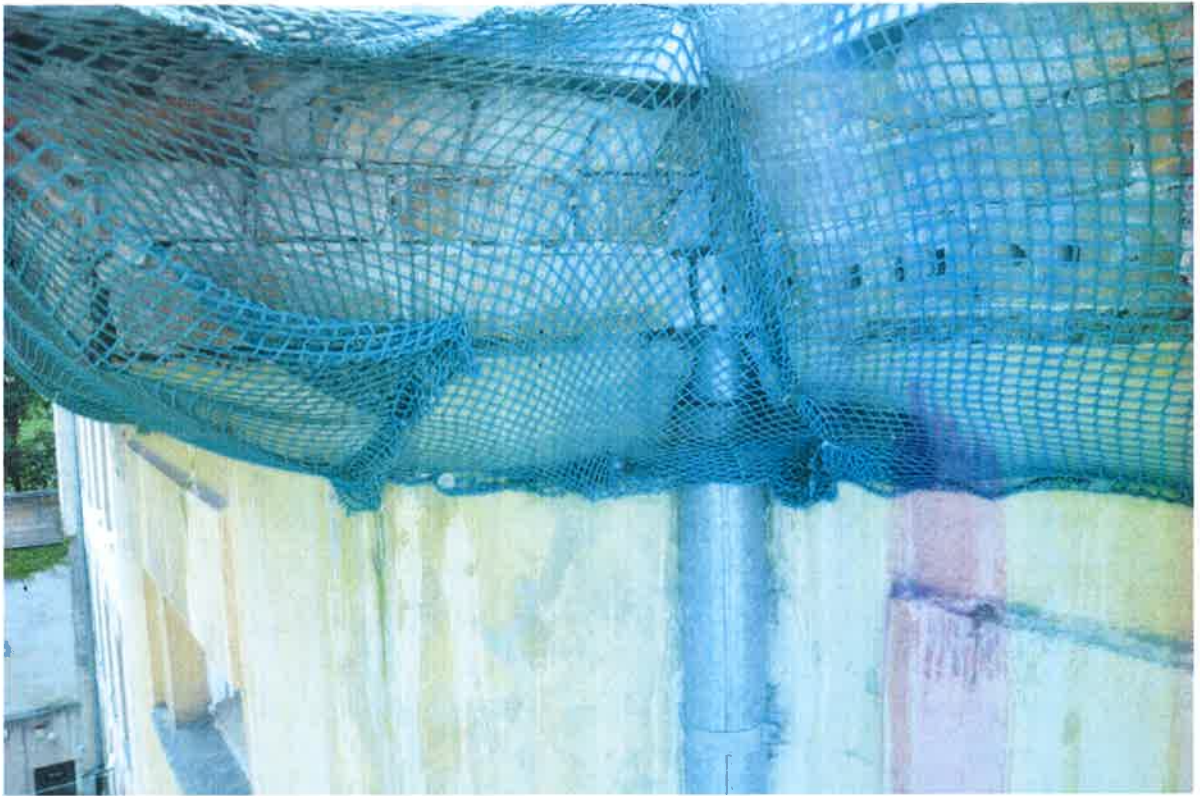
Fot. 71. Zarysowania, odspojenia tynku, korozja belek gzymsu
