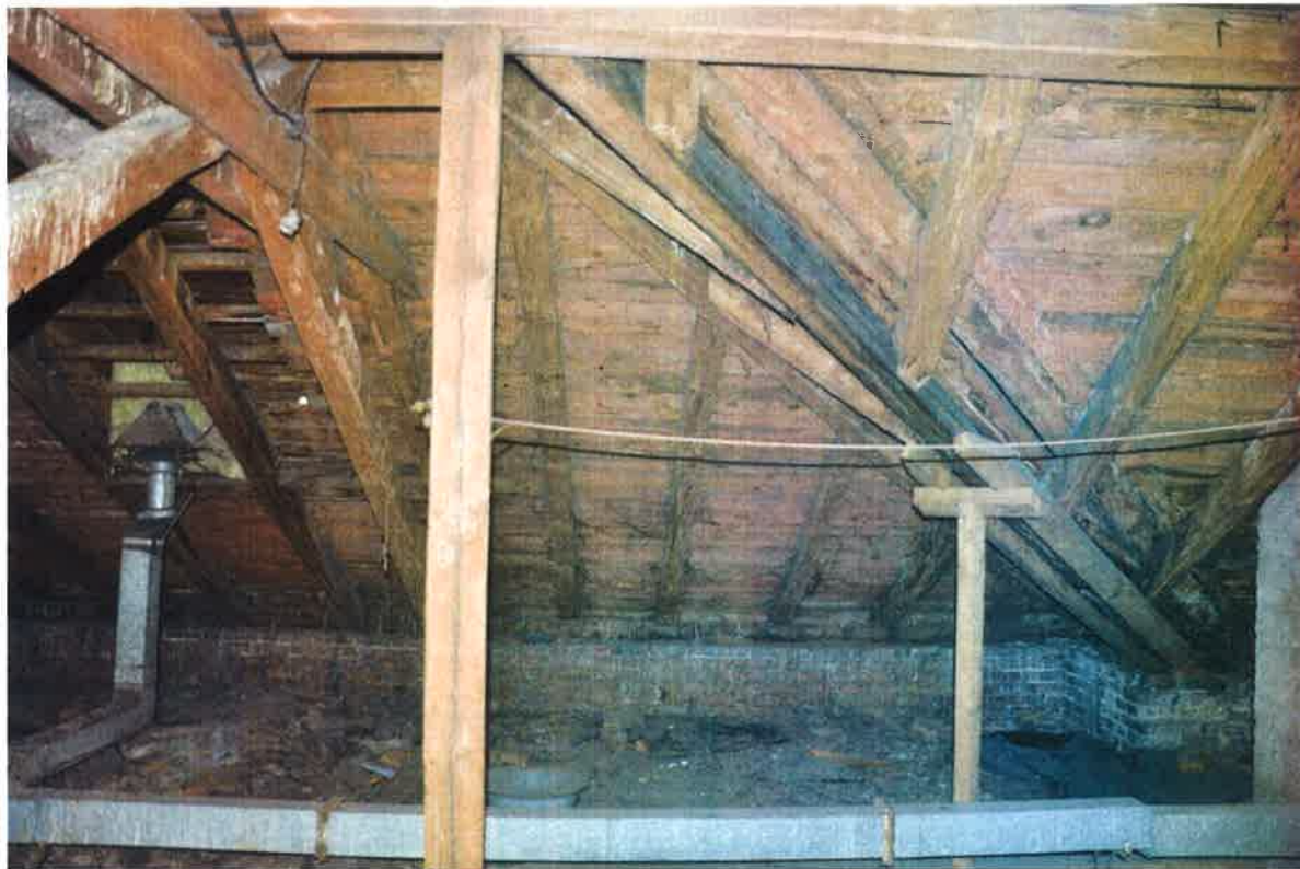
Fot. 25. Zniszczona krokiew koszowa i jej tymczasowe podparcie, przecieki wody opadowej
