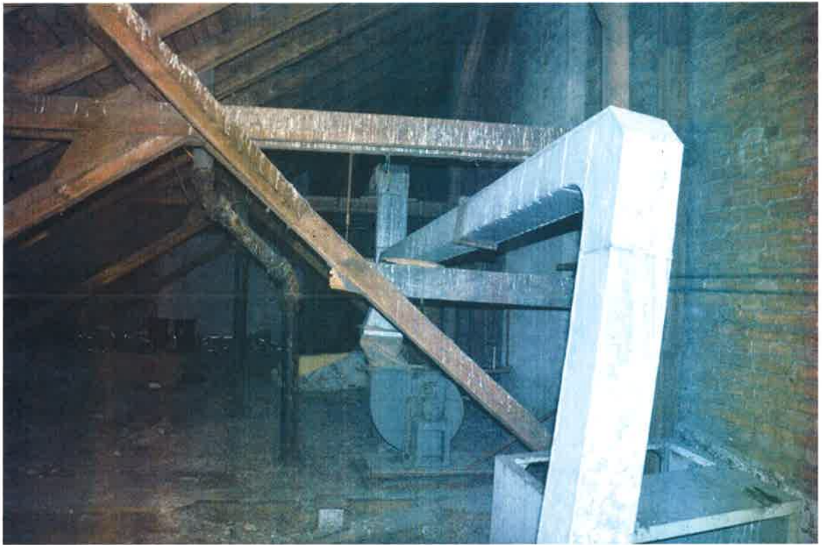
Fot. 35. Poddasze zachodnie - nieczynne urządzenia wentylacyjne na poddaszu, odchody ptaków na elementach więźby
