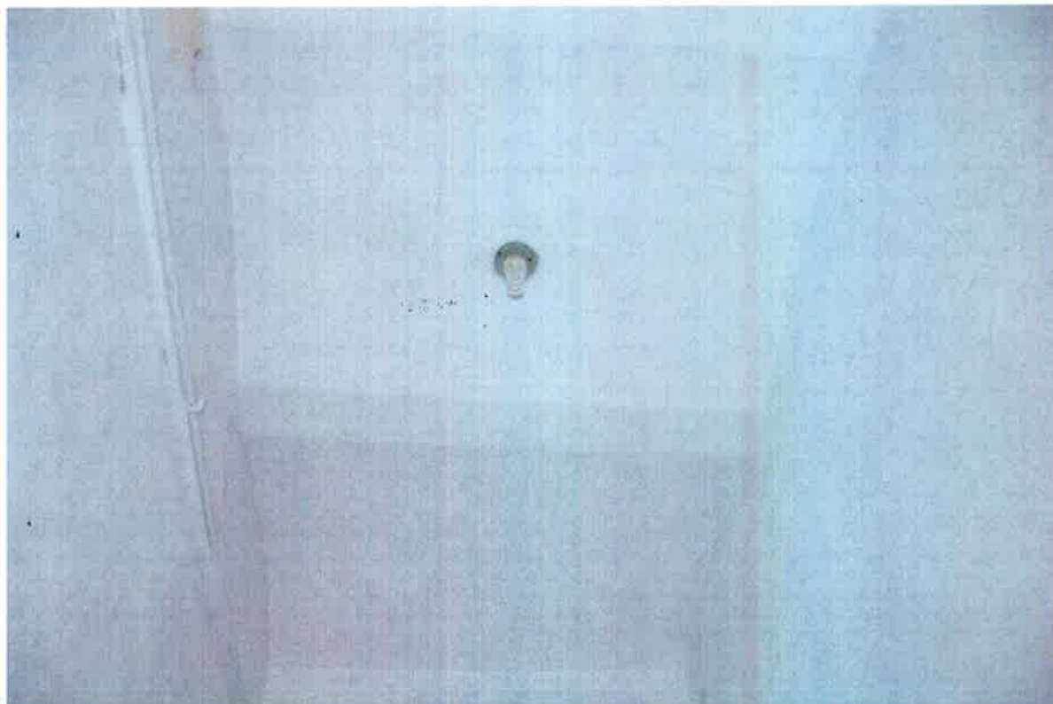
Fot. 7. Przebarwienia tynku na stropie
