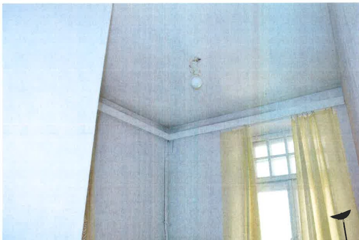
Fot. 8. Zarysowania tynku na stropie pod belkami, przebarwienia
