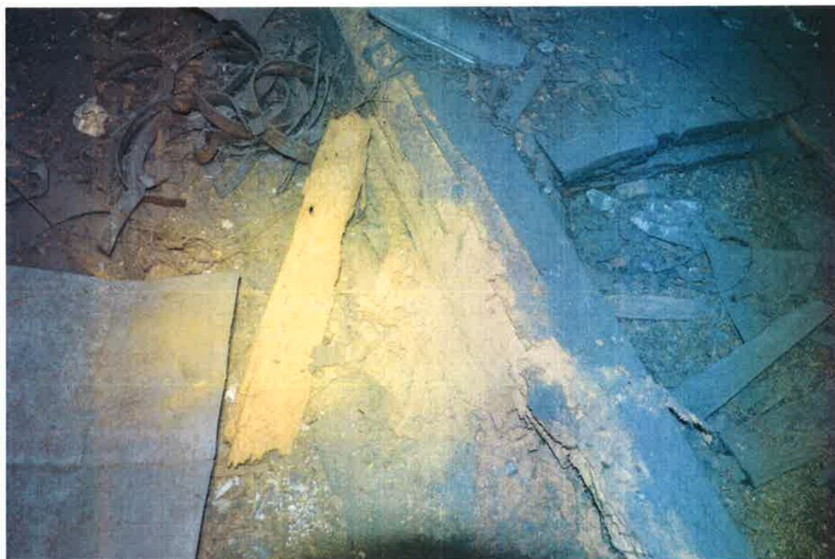
Fot. 30. Rozpad drewna tramu wieszara dachu
