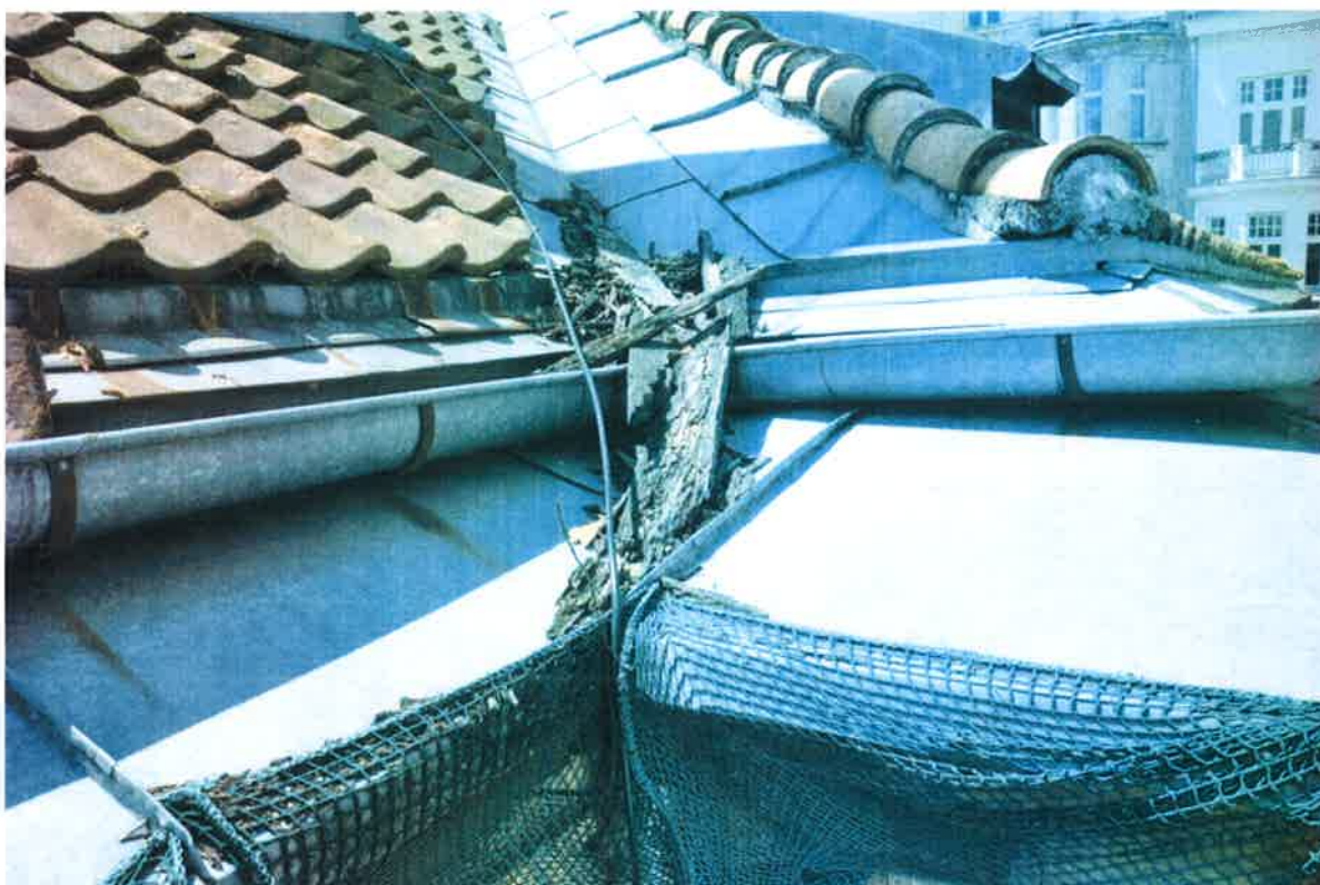
Fot. 64. Zniszczenia łąw kominiarskich
