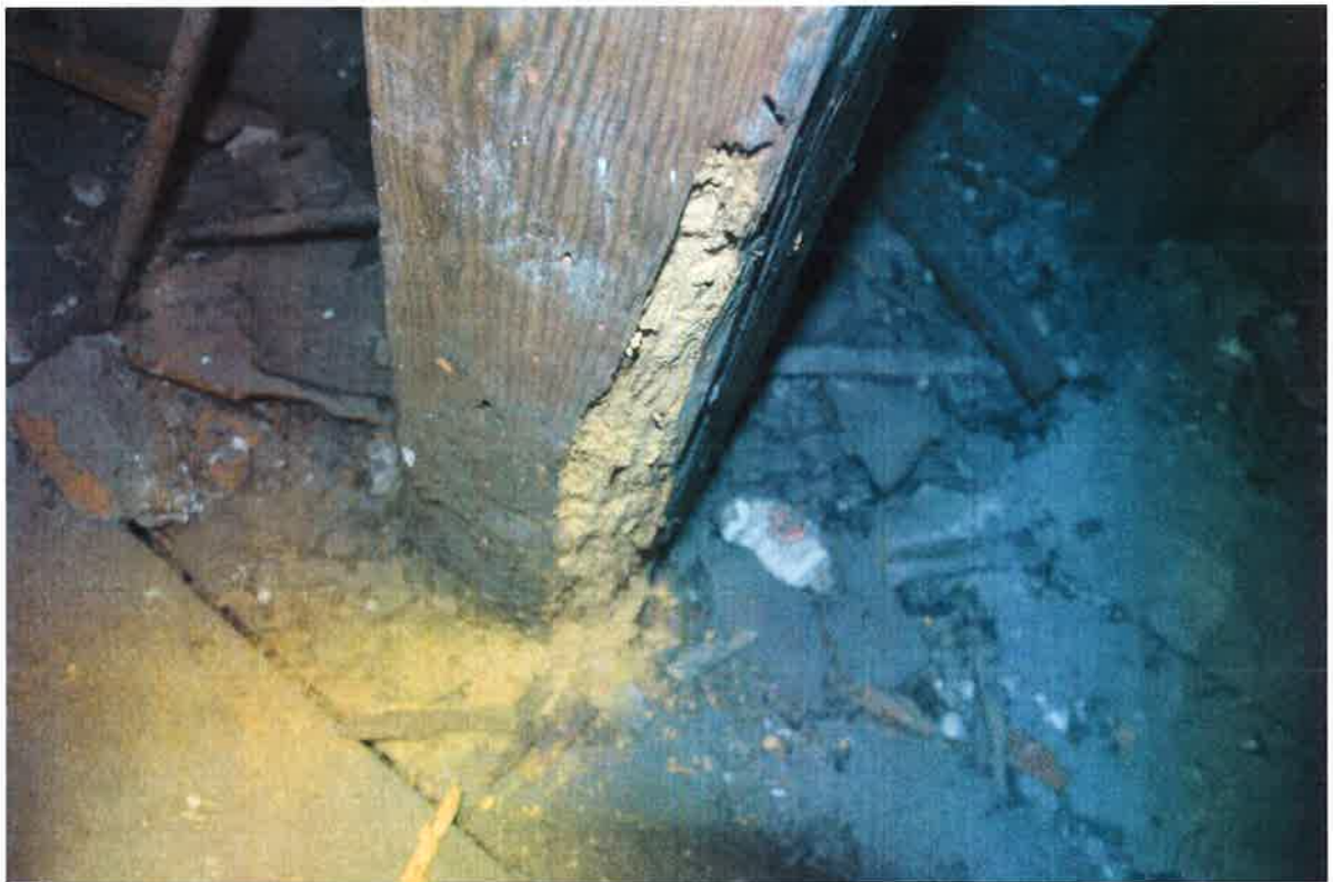
Fot. 32. Rozpad drewna słupka więźby
