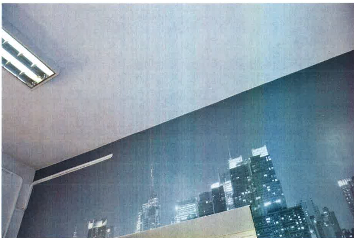
Fot. 6. Zarysowanie tynku pod belką stropu, przebarwienie
