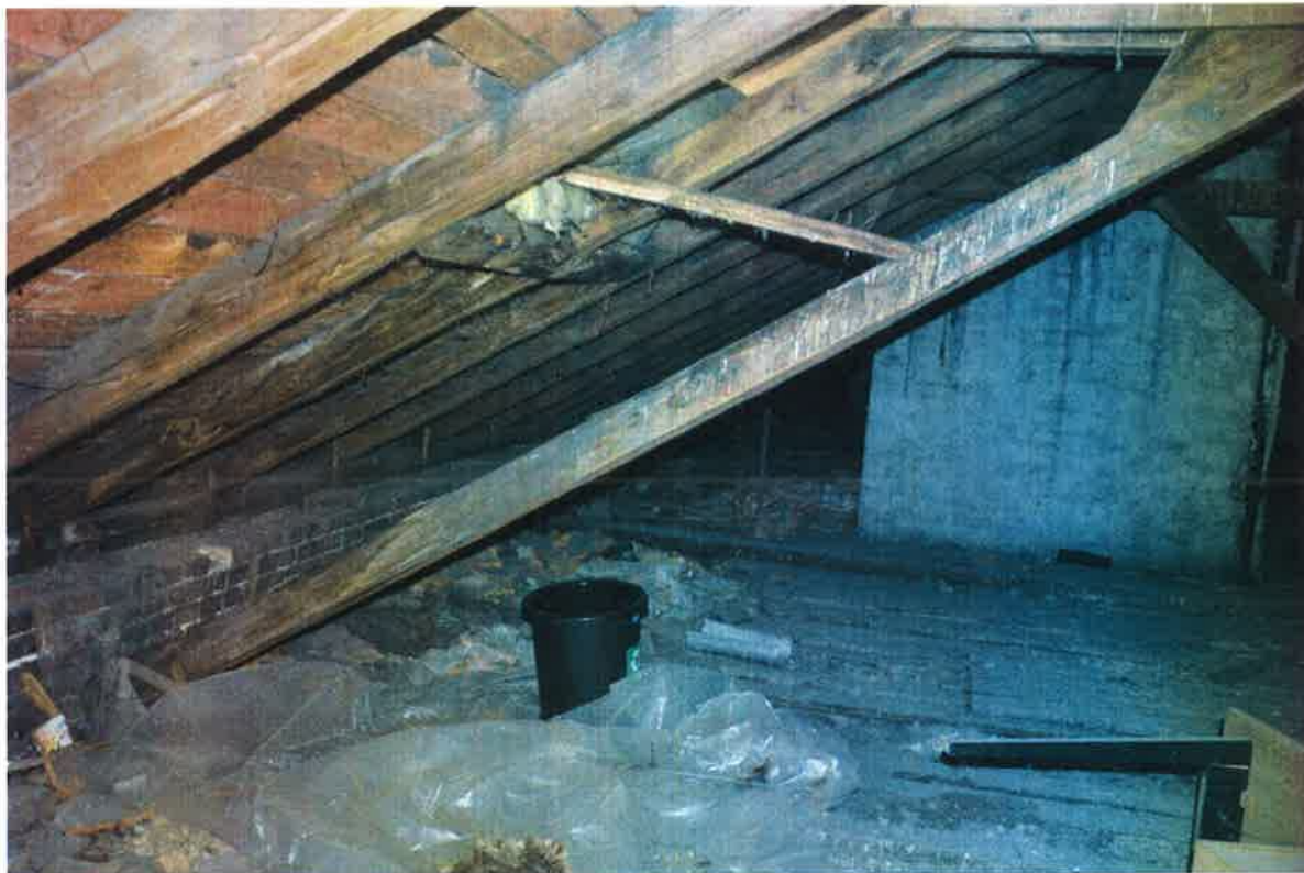
Fot. 37. Zalewanie wodą opadową pod lukarną, wiadro i folia zbierająca wodę
