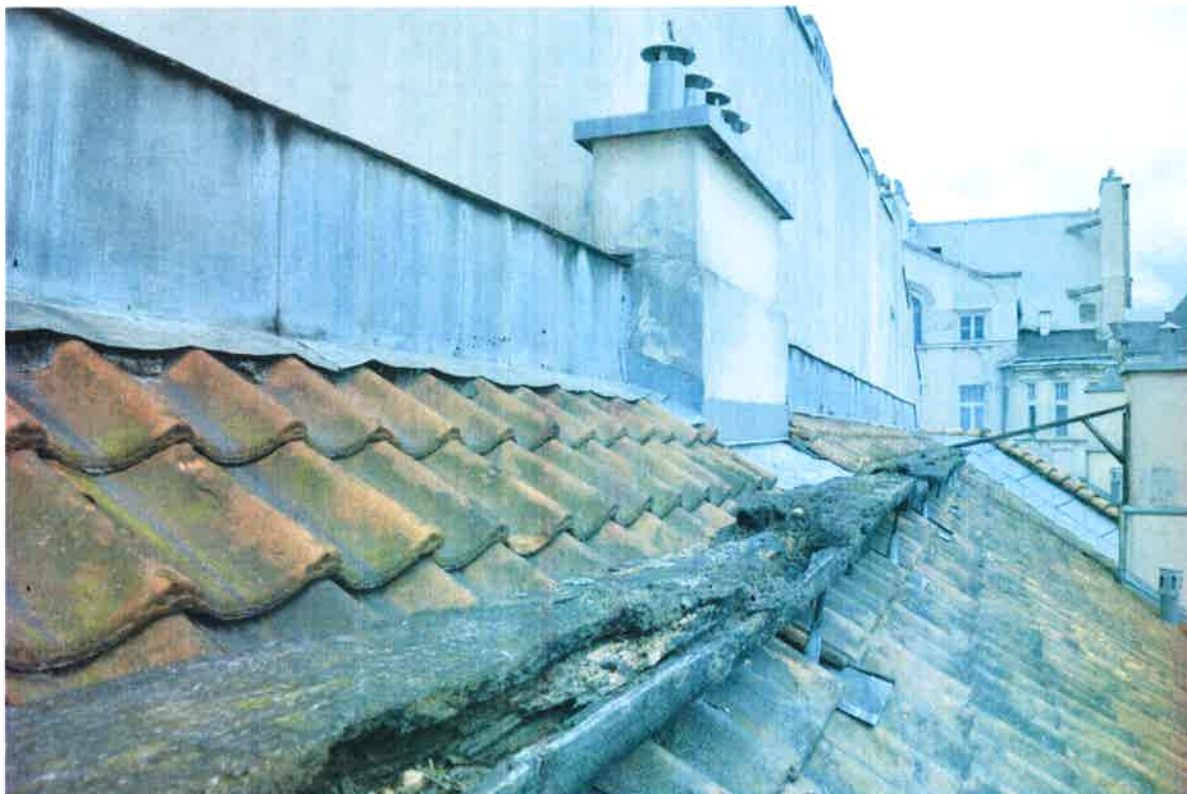
Fot. 63. Zniszczenia łąw kominiarskich
