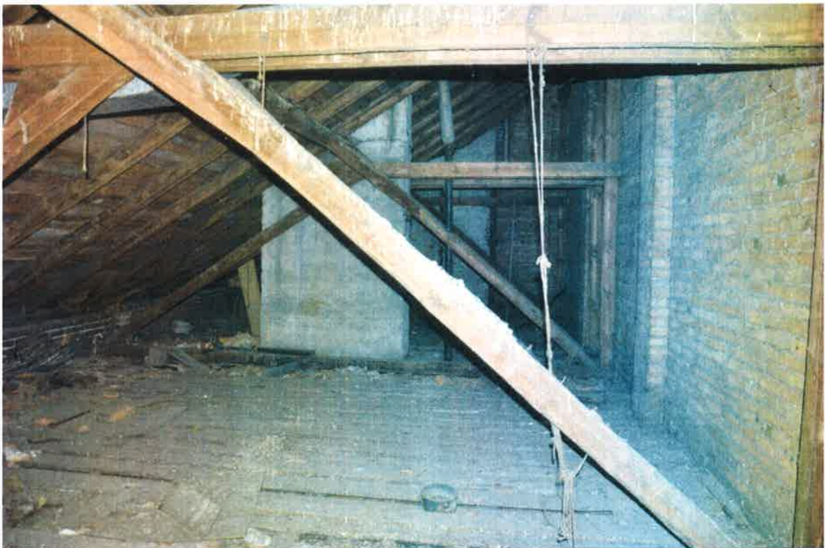
Fot. 42. Poddasze wschodnie, rozpad podłogi z desek, odchody ptasie na elementach więźby
