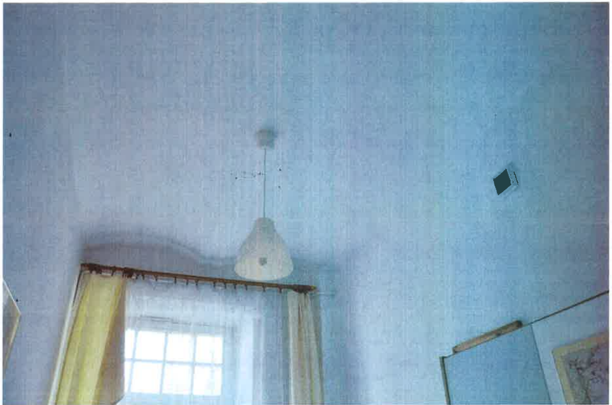
Fot. 13. Przebarwienie tynku na stropie
