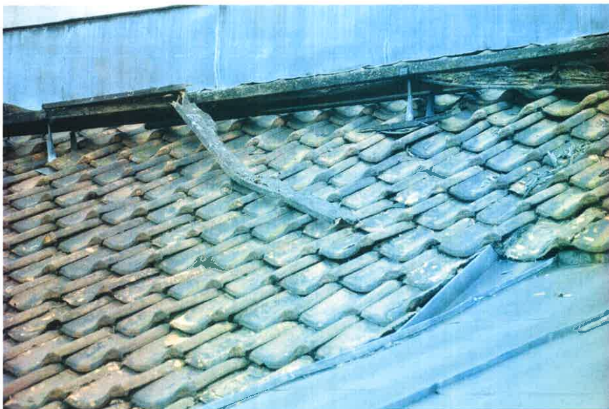
Fot. 65. Zniszczenia ław kominiarskich
