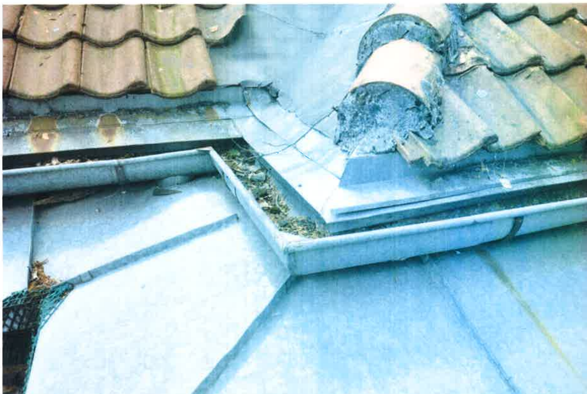
Fot. 61. Brak szczelności obróbek blacharskich koszy
