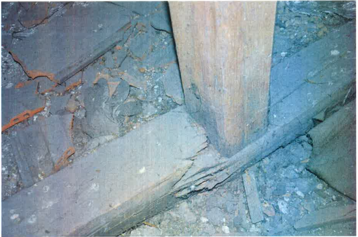
Fot. 27. Uszkodzona podwalina
