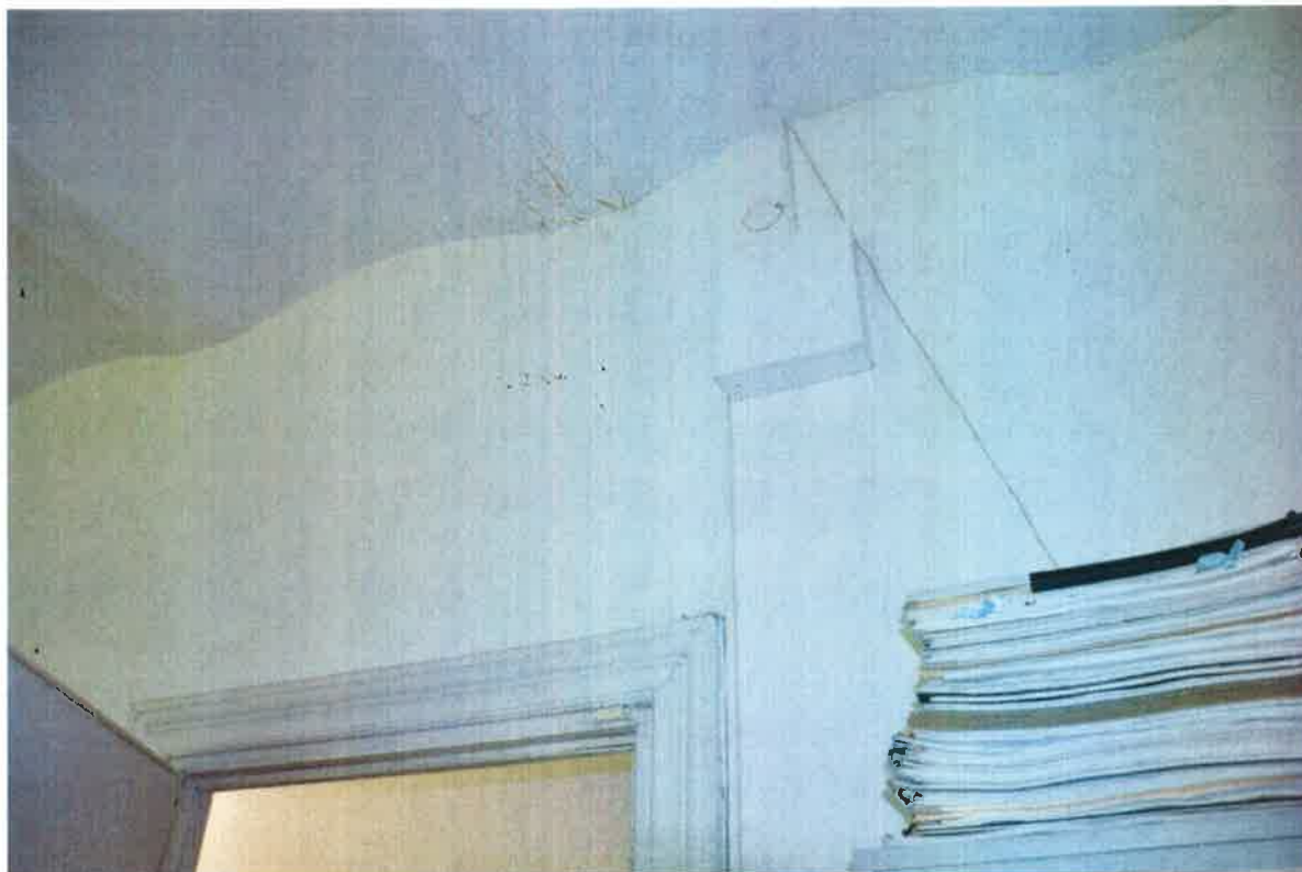
Fot. 15. Zarywanie tynku na stropie w p. 0-215
