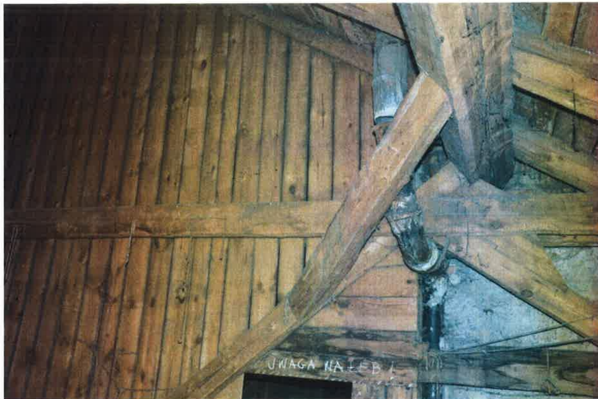
Fot. 29. Rozłączona wywiewka z rury kanalizacyjnej
