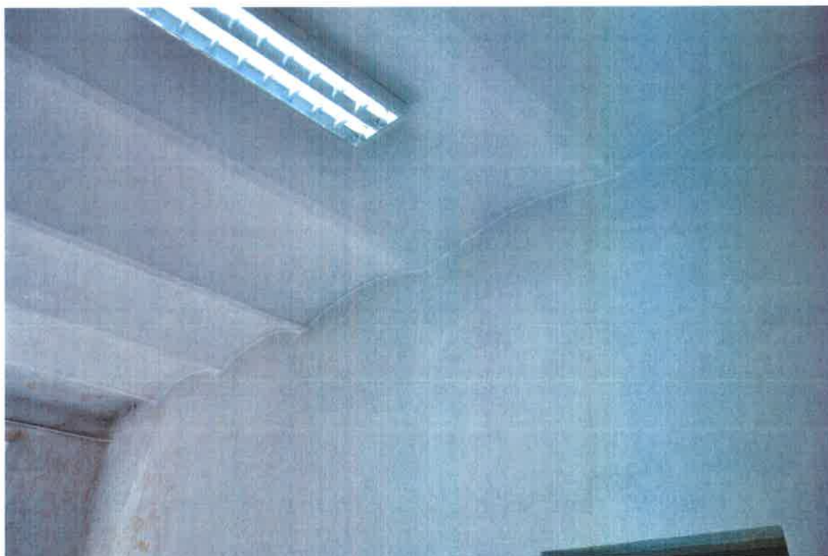
Fot. 12. Zawilgocenie i zagrzybienie stropu oraz ścian na klatce schodowej od ulicy, a także zarysowania i odspojenia tynku na ścianie wewnętrznej
