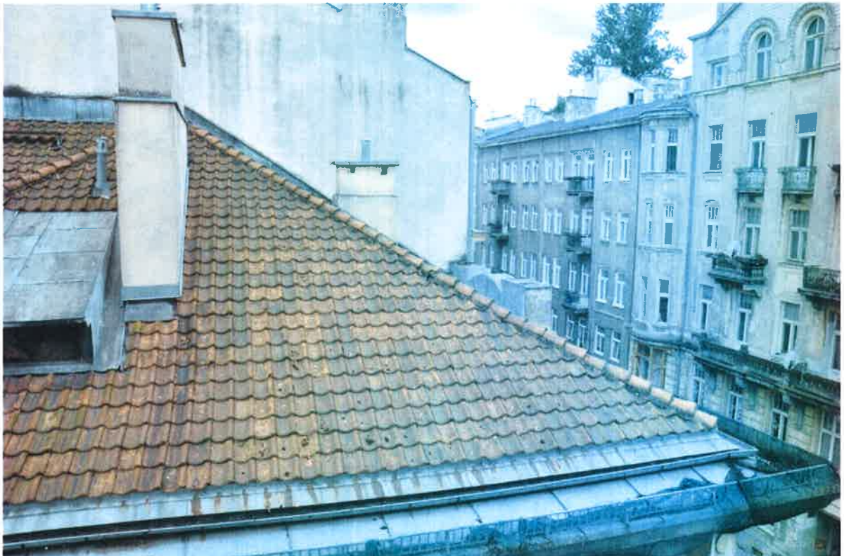
Fot. 48. Dach od strony ulicy. Ubytki dachówek, zniszczenia powierzchni dachówek, korozja obróbek blacharskich
