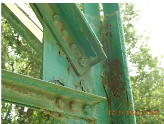
Fot. 117. Korozja wżerowa, zacieki produktami korozji, ubytki powłoki antykorozyjnej
