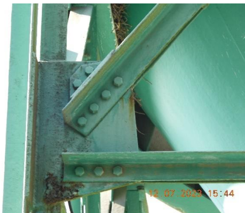
Fot. 19. Korozja na powierzchni, zacieki korozji, złuszczenie powłoki antykorozyjnej, zanieczyszczenia organiczne
