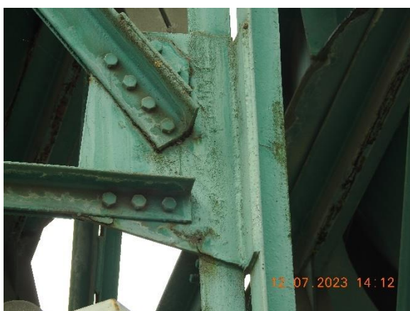
Fot. 87. Korozja wżerowa, uszkodzenie powłoki antykorozyjnej
