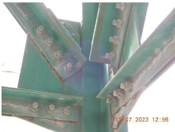
Fot. 115. Korozja wżerowa, zacieki produktów korozji, zanieczyszczenia organiczne
