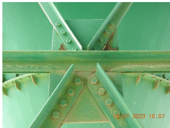
Fot. 54. Korozja wżerowa, uszkodzenie powłoki antykorozyjnej
