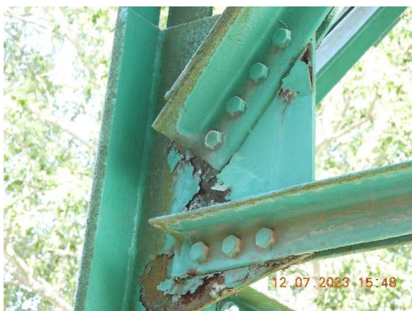
Fot. 23. Złuszczenia powłoki antykorozyjnej, zanieczyszczenie organiczne, korozja powierzchniowa
