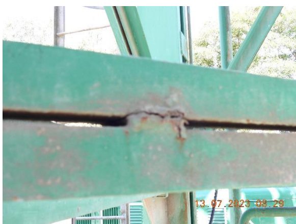
Fot. 153. Korozja wżerowa, pęknięta przewiązka
