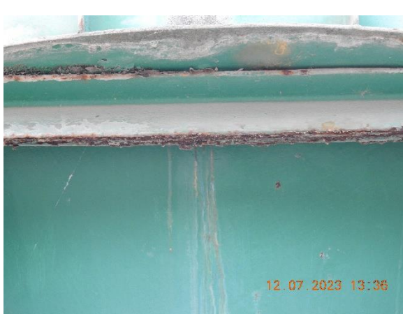
Fot. 105. Korozja wżerowa, zacieki produktami korozji,
