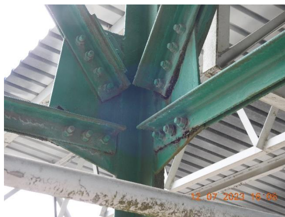
Fot. 52. Korozja wżerowa, uszkodzenie powłoki antykorozyjnej
