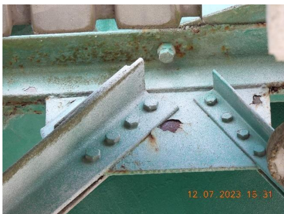
Fot. 33. Złuszczenie powłoki malarskiej, korozja powierzchniowa, korozja wżerowa
