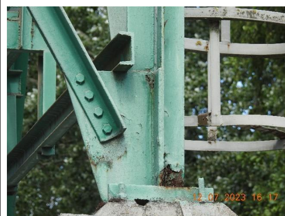
Fot. 42. Zaawansowana korozja wżerowa węzła podporowego
