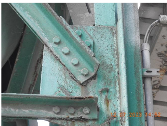
Fot. 73. Korozja wżerowa, złuszczenie powłoki antykorozyjnej, zanieczyszczenie nieorganiczne
