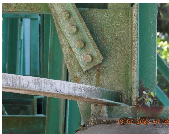
Fot. 8. Korozja węzła podporowego, zanieczyszczenia organiczne, złuszczenie powłoki antykorozyjnej
