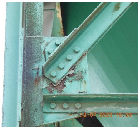
Fot. 27. Złuszczenie powłoki antykorozyjnej, zanieczyszczenia organiczne, korozje lokalne
