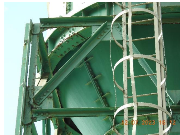
Fot. 40. Korozja wżerow, zanieczyszczenia organiczne, złuszczenie powierzchni antykorozyjnej
