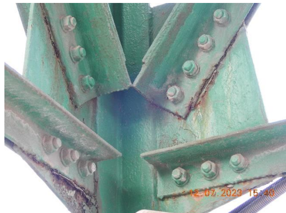
Fot. 72. Korozja wżerowa, ubytki warstwy antykorozyjnej
