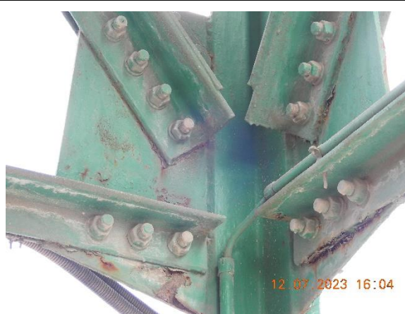
Fot. 50. Korozja wżerowa, uszkodzenie powierzchni antykorozyjnej
