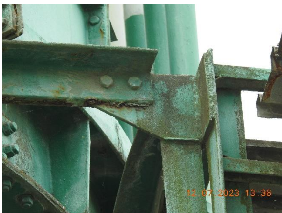
Fot. 103. Korozja wżerowa, zacieki produktów korozji, zanieczyszczenia organiczne
