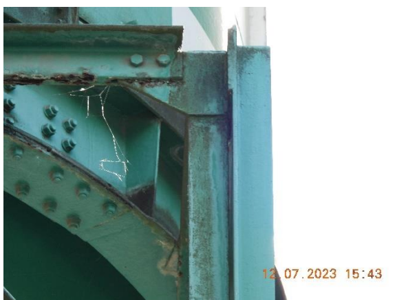
Fot. 17. Uszkodzenia powłok antykorozyjnych, zaawansowana korozja wżerowej, zanieczyszczenia organiczne
