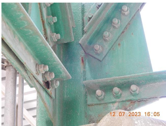
Fot. 51. Korozja wżerowa, uszkodzenie powłoki antykorozyjnej
