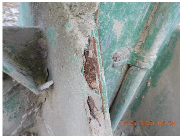
Fot. 134. Korozja wżerowa ,ubytki powłoki lakierniczej
