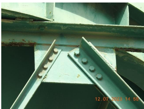
Fot. 79. Korozja wżerowa, zacieki produktów korozji, złuszczenie powłoki antykorozyjnej
