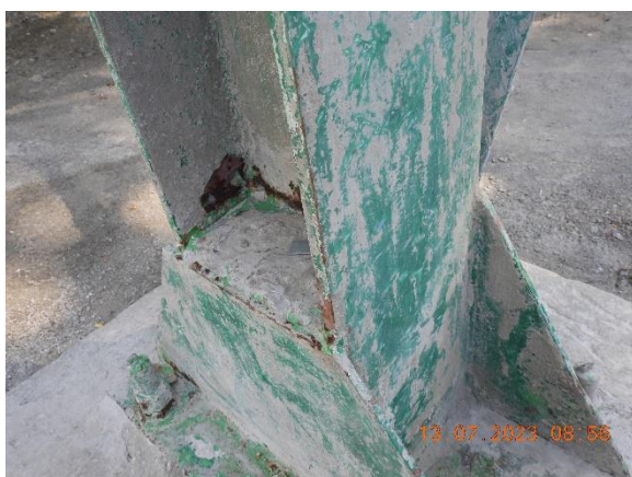
Fot. 125. Korozja powierzchniowa, ubytki powłoki antykorozyjnej
