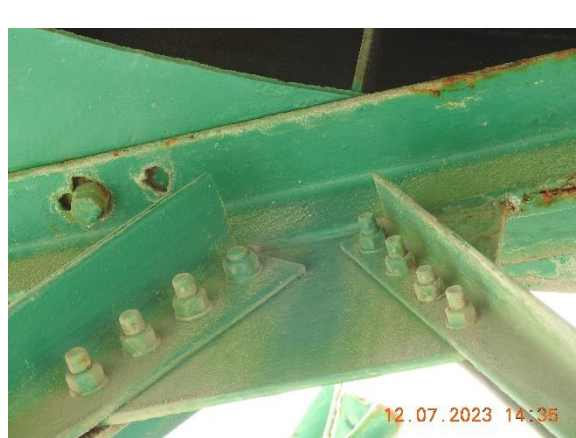
Fot. 94. Nienormalne mocowanie elementu
