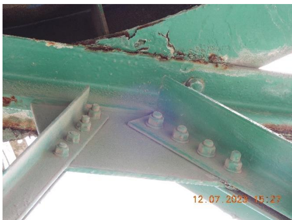
Fot. 47. Zaawansowana korozja wżerowa, ubytki powłoki antykorozyjnej
