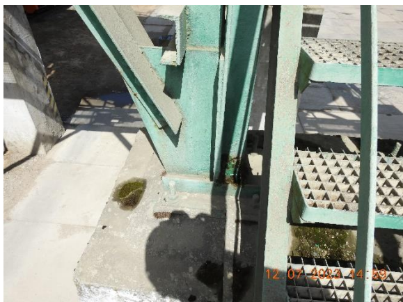
Fot. 83. Korozja wżerowa, zamknięta przestrzeń bez odpływu w podstawie, zanieczyszczenia organiczne
