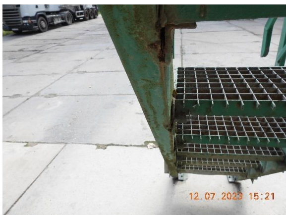
Fot. 43. Korozja wżerowa biegu schodów
