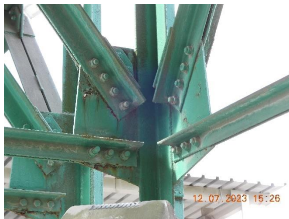
Fot. 46. Korozja wżerowa, zanieczyszczenia organiczne, złuszczenie powłoki antykorozyjnej
