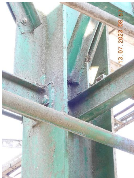
Fot. 123. Korozja wżerowa, zanieczyszczenia organiczne i nie organiczne
