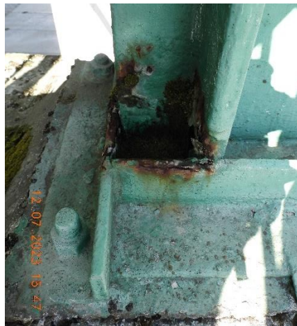
Fot. 22. Zaawansowana korozja wżerowa węzła podporowego
