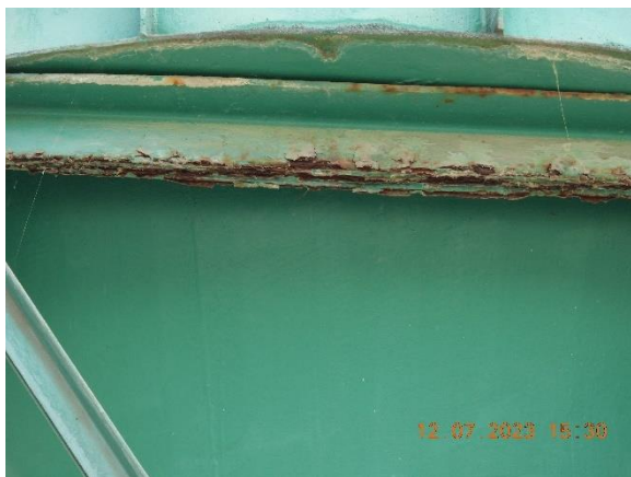
Fot. 25. Zaawansowana korozja wżerowa
