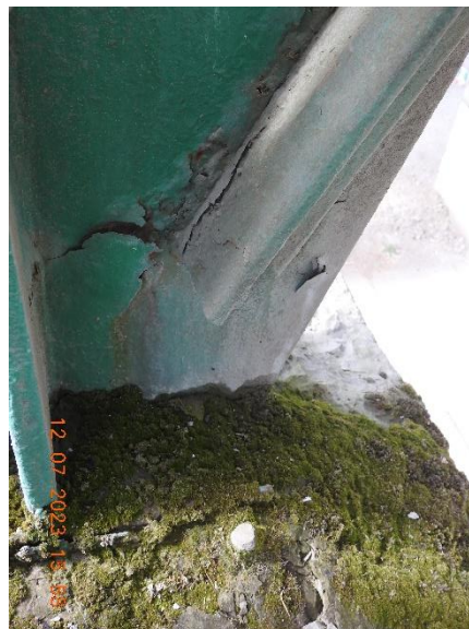
Fot. 60. Korozja wżerowa, ubytki warstwy antykorozyjnej, zanieczyszczenia organiczne
