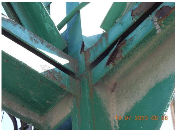
Fot. 151. Korozja wżerowa, zacieki produktami korozji
