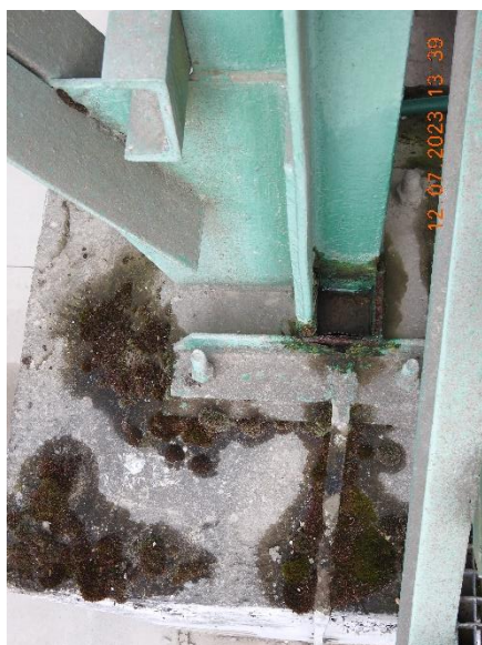
Fot. 107. Korozja wżerowa, zamknięta przestrzeń bez odpływu w podstawie, zanieczyszczenia organiczne
