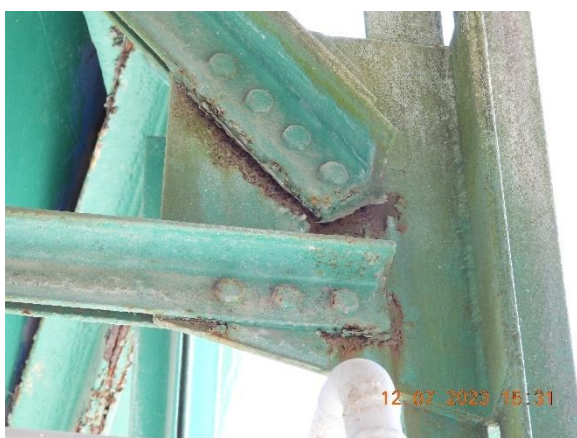
Fot. 35. Zanieczyszczenia organiczne, zaawansowana korozja wżerowa
