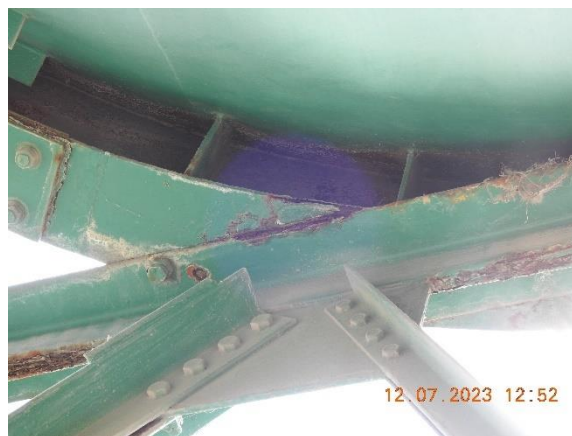
Fot. 114. Korozja wżerowa, zacieki produktem korozji, ubytki powłoki antykorozyjnej
