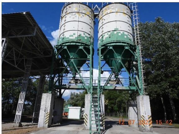
Fot. 13. Widok na silos 1 i 2, korozja silosów
