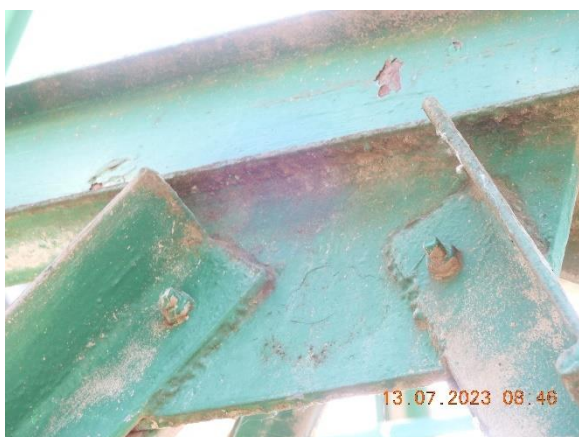
Fot. 139. Korozja wżerowa, zanieczyszczenia organiczne
