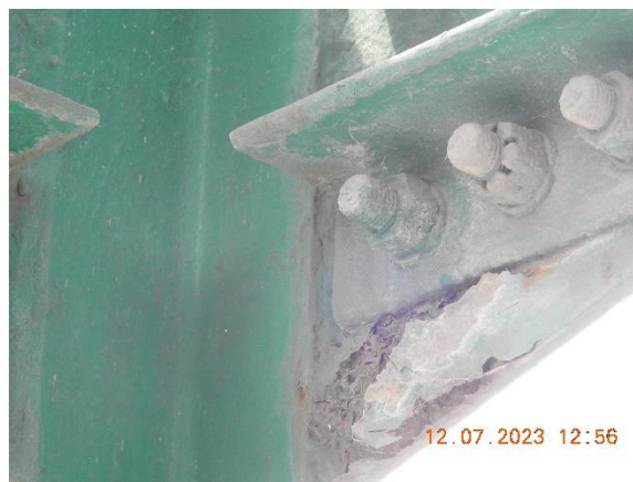
Fot. 116. Korozja wżerowa, uszkodzenie warstwy antykorozyjnej
