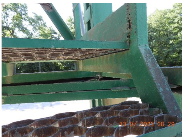
Fot. 155. Korozja wżerowa i powierzchniowa, zanieczyszczenia nieorganiczne
