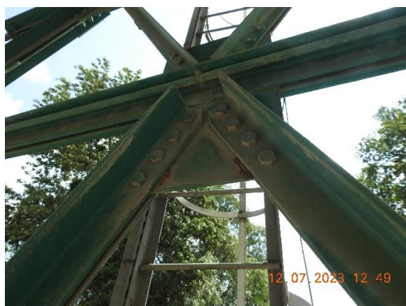
Fot. 111. Korozja wżerowa, uszkodzenie powłoki antykorozyjnej
