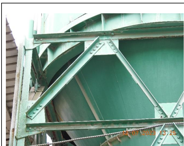
Fot. 97. Zaawansowana korozja wżerowa
