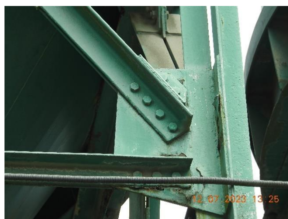
Fot. 98. Korozja wżerowa, ubytki powłoki antykorozyjnej, zanieczyszczenia organiczne
