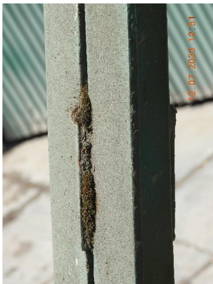
Fot. 113. Zanieczyszczenia organiczne przewiązki
