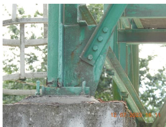
Fot. 38. Zaawansowana korozja wżerowa węzła podporowego, zanieczyszczenia organiczne
