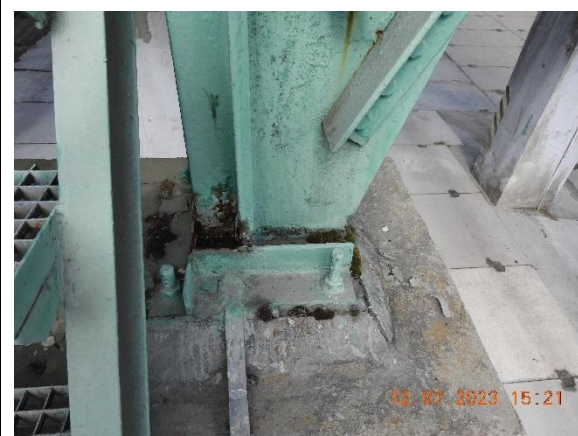
Fot. 44. Korozja wżerowa, zamknięta przestrzeń bez odpływu w podstawie, zanieczyszczenia organiczne
