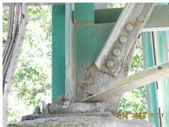
Fot. 34. Zanieczyszczenie organiczne, zaawansowana korozja wżerowa węzła podporowego
