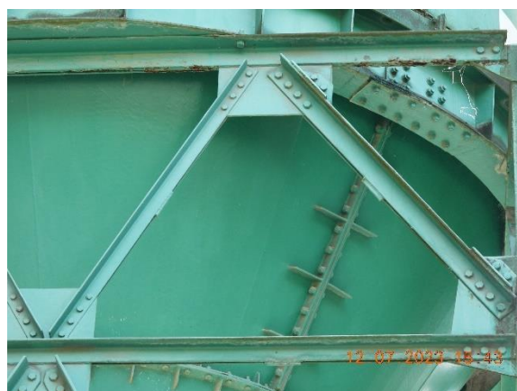
Fot. 14. Złuszczenia powłok antykorozyjnych, korozja powierzchniowa i wżerowa, zanieczyszczenia organiczne
