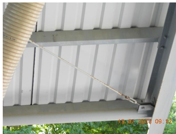
Fot. 132. Korozja wżerowa i powierzchniowa
