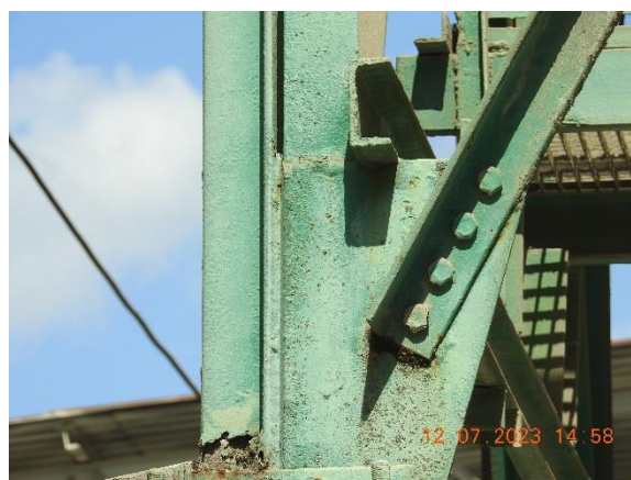
Fot. 80. Korozja wżerowa węzła podporowego, złuszczenie powłoki antykorozyjnej
