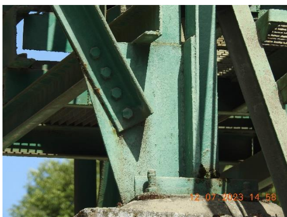
Fot. 81. Korozja wżerowa, zacieki produktami korozji
