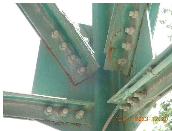
Fot. 112. Korozja wżerowa, uszkodzenie powłoki antykorozyjnej
