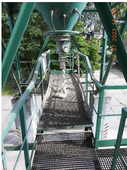
Fot. 45. Deformacja pomostu roboczego
