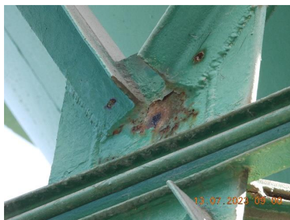
Fot. 126. Korozja powierzchniowa i wżerowa, ubytki powłoki antykorozyjnej
