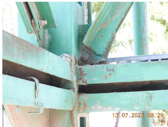
Fot. 152. Korozja wżerowa, zanieczyszczenie organiczne
