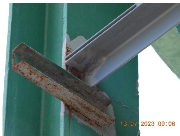
Fot. 128. Korozja wżerowa, uszkodzenie warstwy antykorozyjnej, zacieki produktem korozji
