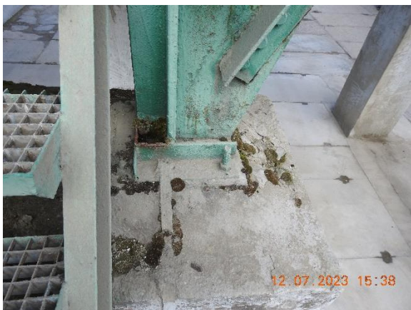
Fot. 71. Korozja wżerowa, zamknięta przestrzeń bez odpływu w podstawie, zanieczyszczenia organiczne
