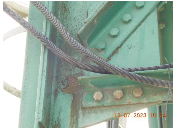
Fot. 70. Ubytki warstwy antykorozyjnej, korozja wżerowa
