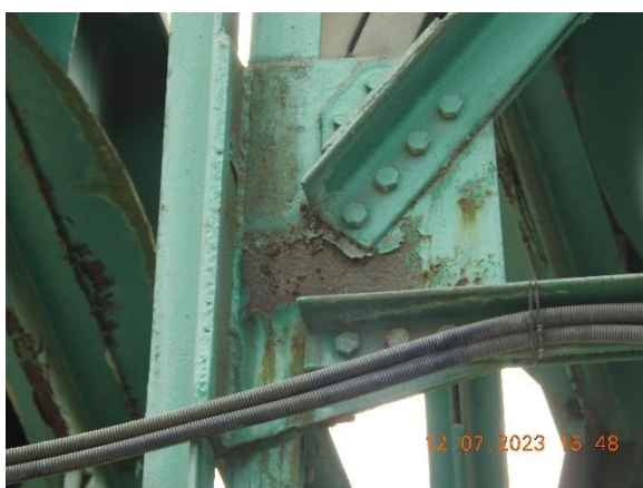
Fot. 55. Korozja, zacieki produktów korozji, ubytki powłoki antykorozyjnej, zanieczyszczenia organiczna
