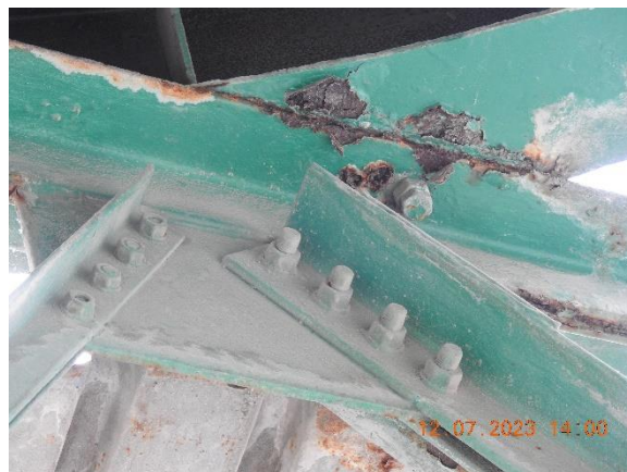
Fot. 108. Korozja wżerowa, złuszczenie warstwy antykorozyjnej, zanieczyszczenie organiczne
