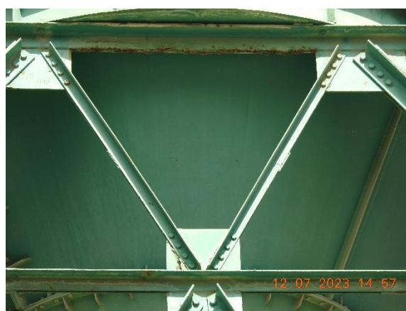
Fot. 76. Korozja wżerowa, uszkodzenie powłoki antykorozyjnej
