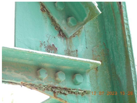
Fot. 48. Korozja wżerowa, zacieki korozji
