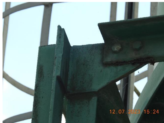
Fot. 62. Korozja wżerowa, zanieczyszczenia organiczne
