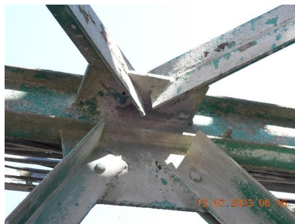
Fot. 140. Korozja wżerowa, ubytki warstwy antykorozyjnej
