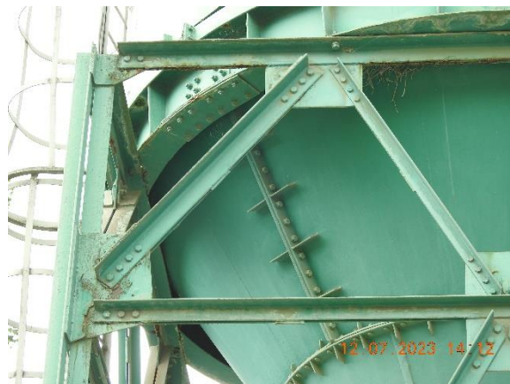
Fot. 86. Korozja wżerowa, ubytki powłoki antykorozyjnej, zanieczyszczenia organiczne
