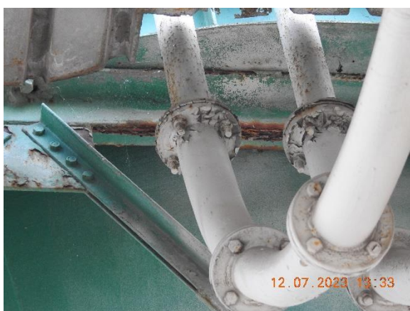
Fot. 101. Korozja wżerowa, uszkodzenie powłoki antykorozyjnej, zanieczyszczenia organiczne
