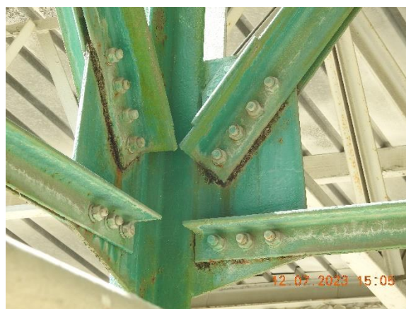
Fot. 82. Korozja wżerowa, zacieki produktem korozji
