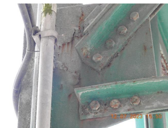
Fot. 57. Korozja wżerowa, zanieczyszczenia
