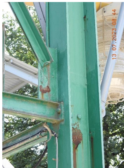
Fot. 136. Korozja wżerowa ,zacieki produktami korozji
