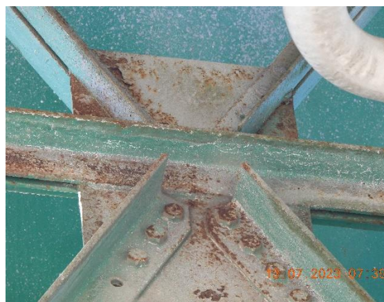
Fot. 10. Korozja powierzchniowa, brak śruby, ubytki powłoki antykorozyjnej
