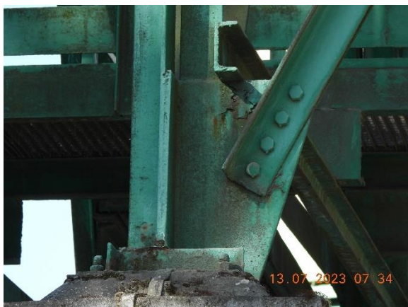
Fot. 5. Złuszczenie powłoki antykorozyjnej, zacieki produktów korozji
