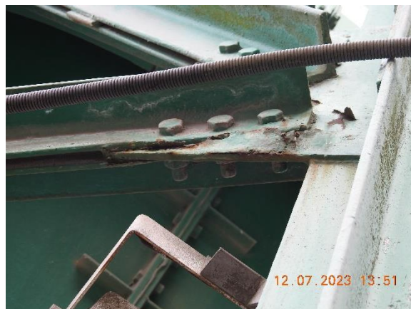
Fot. 106. Korozja wżerna, złuszczenie warstwy antykorozyjnej
