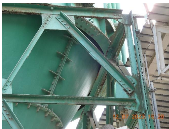
Fot. 26. Brak śruby, złuszczenie powłoki antykorozyjnej, zanieczyszczenia organiczne
