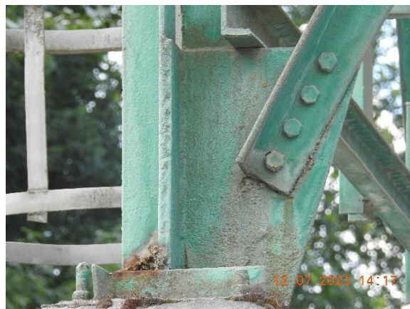
Fot. 92. Korozja wżerowa węzła podporowego, złuszczenie powłoki antykorozyjnej
