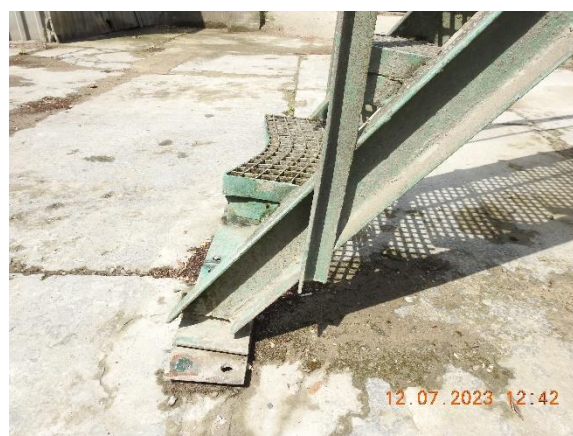
Fot. 110. Deformacja stopnia, brak śrub mocujących konstrukcję biegu
