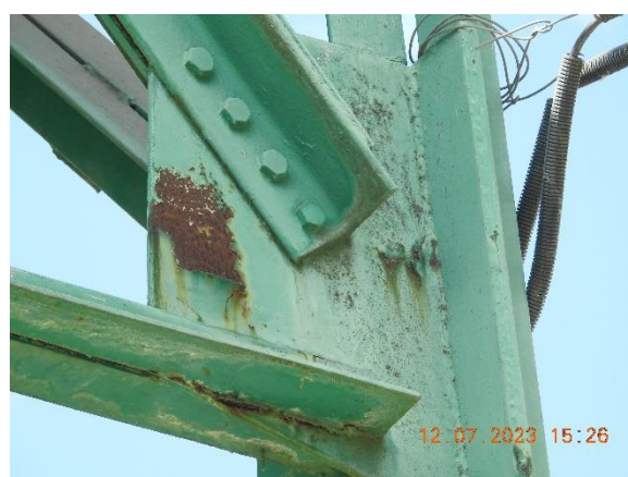
Fot. 64. Korozja wżerowa, uszkodzenie powłoki antykorozyjnej
