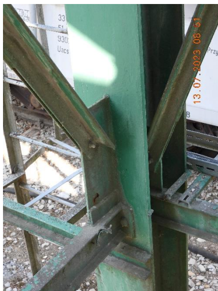
Fot. 143. Korozja wżerowa, zanieczyszczenia nieorganiczne
