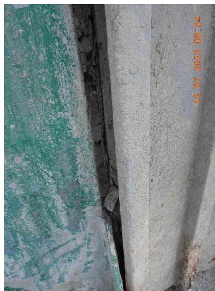
Fot. 122. Zanieczyszczenia nieorganiczne słupa podstawy
