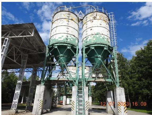
Fot. 37. Widok na silos nr 3 i 4, korozja silosów
