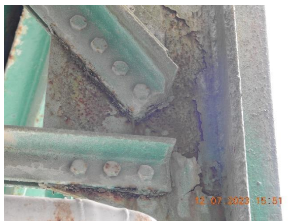
Fot. 58. Ubytki warstwy antykorozyjnej, korozja wżerowa
