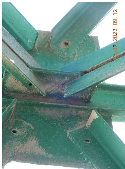
Fot. 130. Korozja wżerowa, pęknięcie podłużne spoiny
