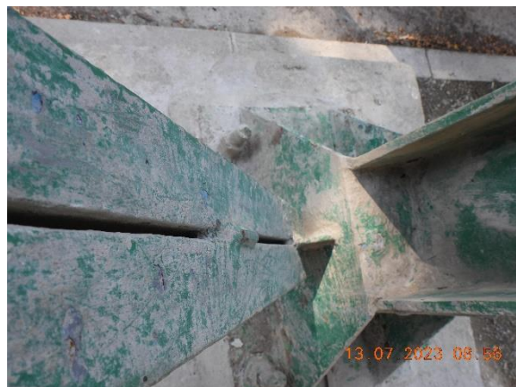
Fot. 124. Ubytki powłoki malarskiej, zanieczyszczenia nieorganiczne
