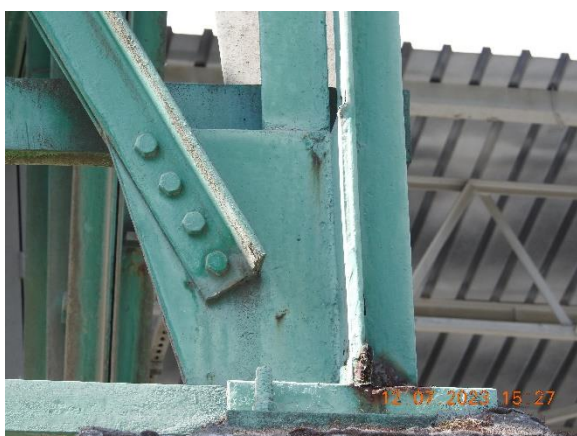
Fot. 65. Korozja wżerowa, uszkodzenie powłoki antykorozyjnej
