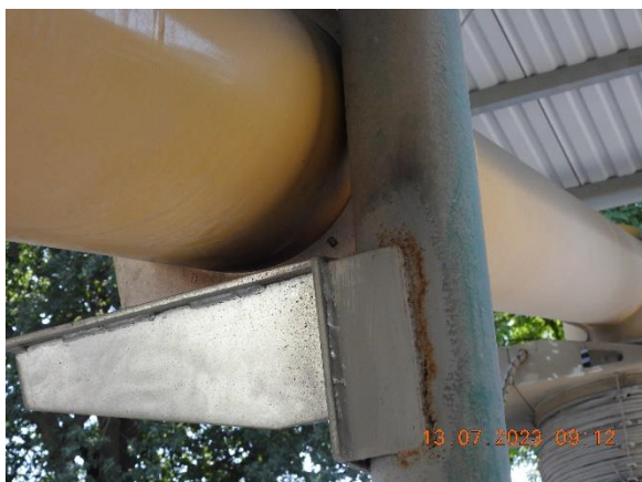
Fot. 131. Korozja wżerowa, zanieczyszczenia nieorganiczne
