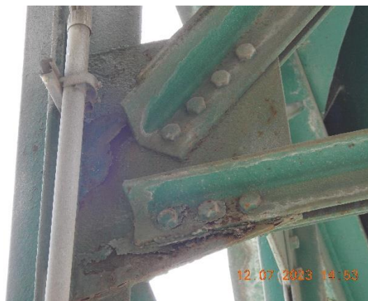
Fot. 74. Korozja wżerowa, ubytki powłoki antykorozyjnej
