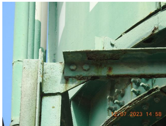
Fot. 78. Korozja wżerowa, uszkodzenie powłoki antykorozyjnej, zacieki produktem korozji
