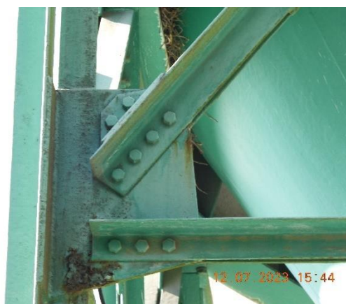
Fot. 16. Uszkodzenia powłok antykorozyjnych, ogniska korozji powierzchniowej, zanieczyszczenia organiczne
