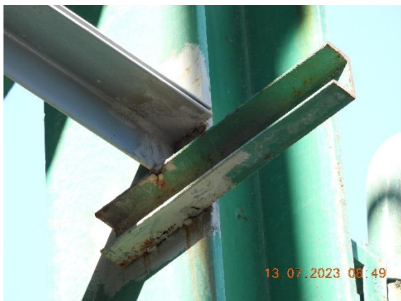
Fot. 141. Korozja wżerowa, zacieki produktów korozji
