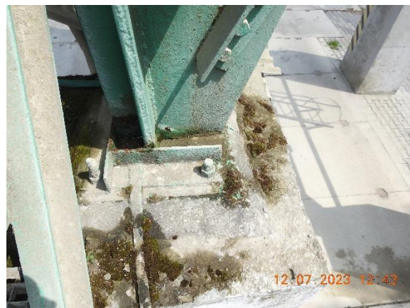
Fot. 120. Korozja wżerowa, zamknięta przestrzeń bez odpływu w podstawie, zanieczyszczenia organiczne
