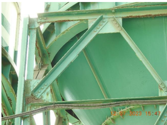
Fot. 53. Korozja wżerowa, uszkodzenie powłoki antykorozyjnej
