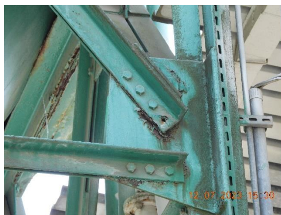
Fot. 30. Korozja wżerowa, brak śruby, zanieczyszczenia organiczne
