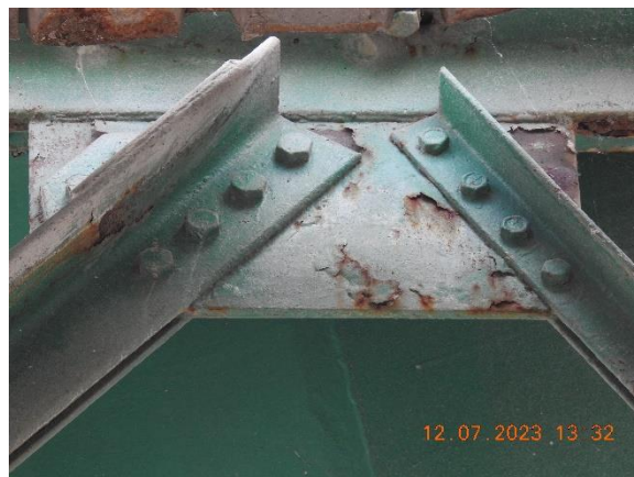
Fot. 100. Korozja wżerowa, uszkodzenie powłoki antykorozyjnej
