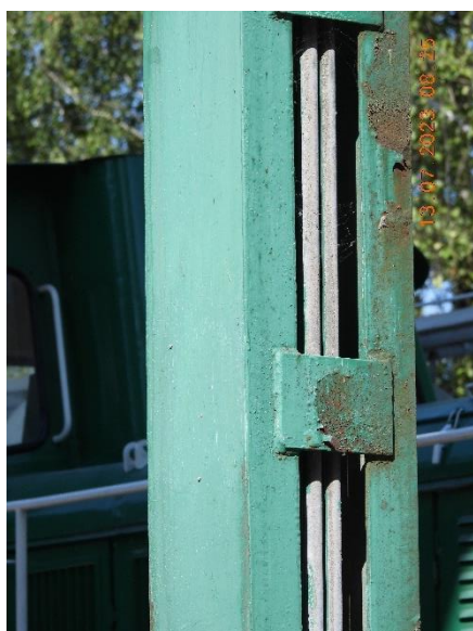
Fot. 149. Korozja wżerowa, złuszczenie powłoki antykorozyjnej, zacieki produktami korozji
