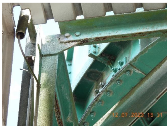
Fot. 32. Zaawansowana korozja wżerowa, zanieczyszczenia organiczne
