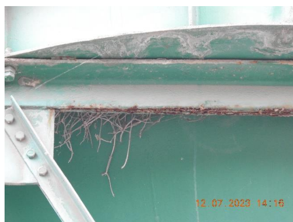
Fot. 90. Korozja wżerowa, zacieki produktem korozji
