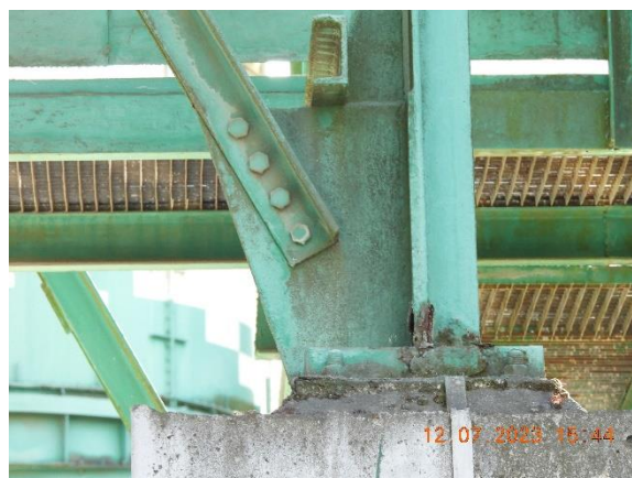
Fot. 18. Korozja wżerowa węzła podporowego, zanieczyszczenia organiczne
