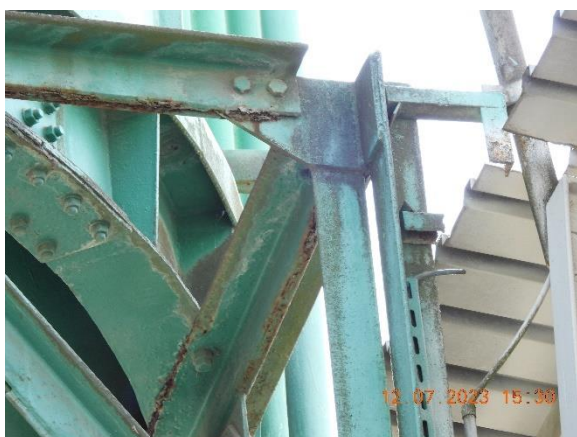
Fot. 29. Zaawansowana korozja wżerowa, zanieczyszczenia organiczne
