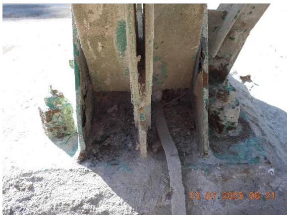
Fot. 147. Korozja wżerowa, zanieczyszczenia organiczne, ubytki powłoki antykorozyjnej
