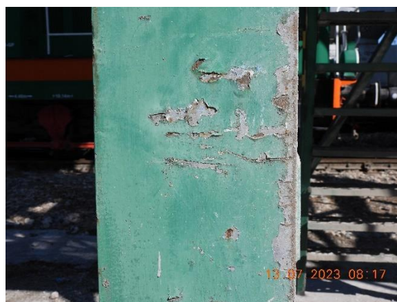
Fot. 146. Ubytki powłoki lakierniczej, złuszczenia powłoki antykorozyjnej
