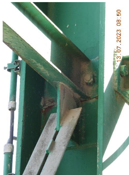
Fot. 142. Zanieczyszczenia organiczne, zacieki produktami korozji
