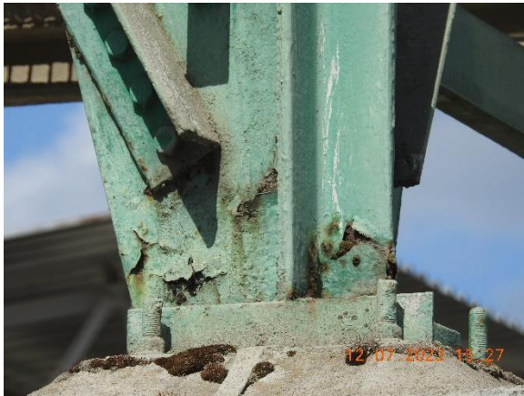
Fot. 67. Korozja, zacieki produktów korozji, złuszczenie powłoki antykorozyjnej, zanieczyszczenia organiczne
