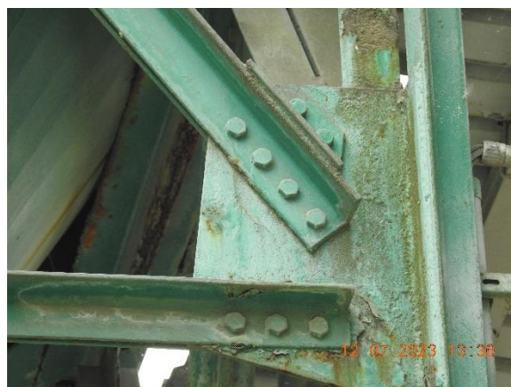
Fot. 104. Korozja wżerowa, zacieki produktem korozji, zanieczyszczenia organiczne
