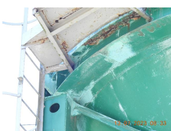
Fot. 156. Korozja wżerowa, zacieki produktami korozji
