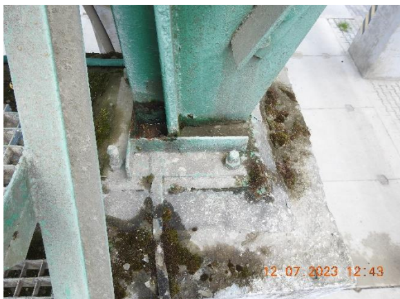
Fot. 119. Korozja wżerowa, zamknięta przestrzeń bez odpływu w podstawie, zanieczyszczenia organiczne
