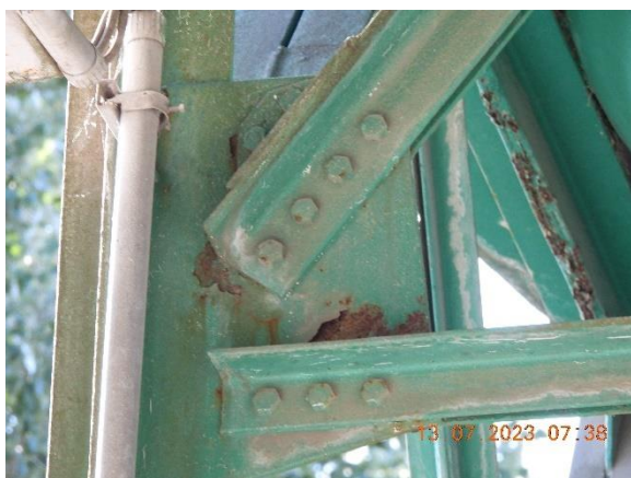
Fot. 7. Ubytki powłok antykorozyjnych, korozja
