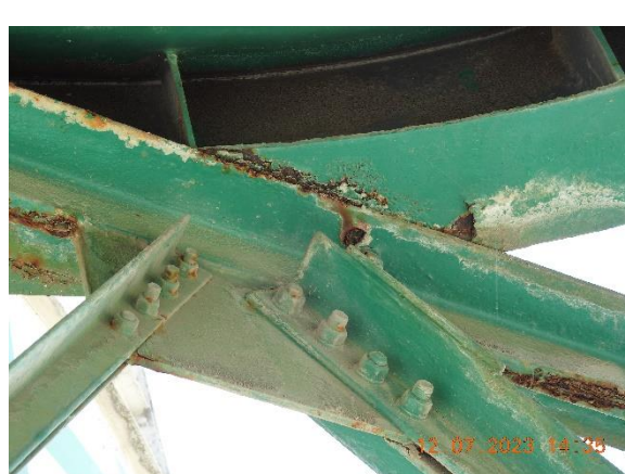
Fot. 96. Korozja wżerowa, złuszczenie warstwy antykorozyjnej
