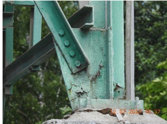
Fot. 68. Korozja wżerowa węzła podporowego, złuszczenie powłoki antykorozyjnej
