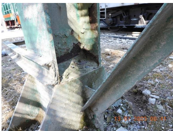
Fot. 135. Zaawansowana korozja wżerowa, zanieczyszczenia organiczne, ubytki powłoki antykorozyjnej
