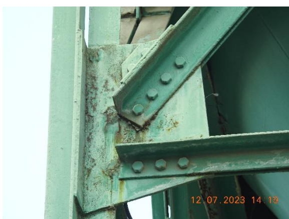
Fot. 93. Korozja wżerowa, zacieki produktami korozji, złuszczenie warstwy antykorozyjnej
