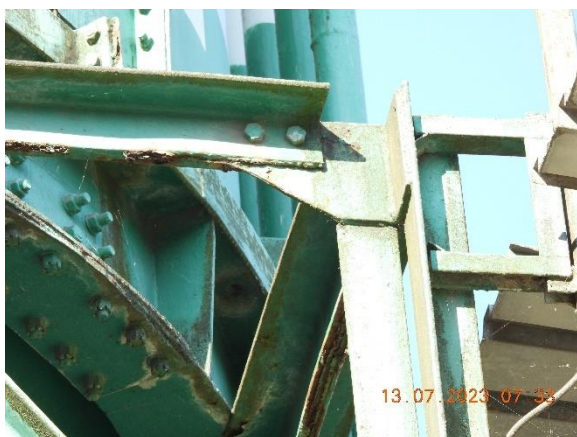
Fot. 3. Ogniska korozji powierzchniowej i wżerowej, zacieki produktów korozji
