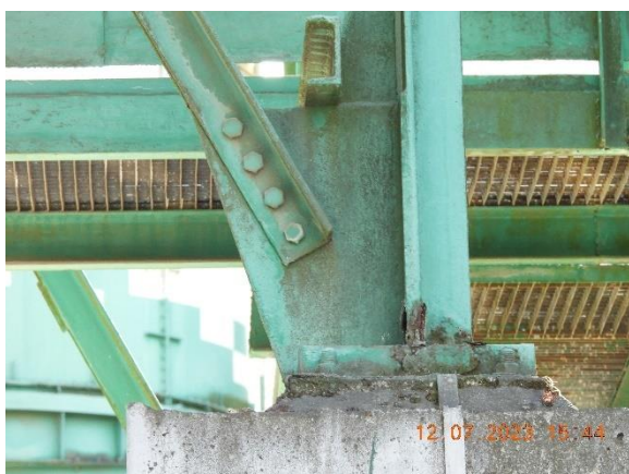
Fot. 15. Zanieczyszczenia organiczne konstrukcji, zaawansowana korozja wżerowa węzła podporowego
