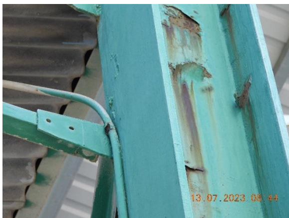
Fot. 137. Zaawansowana korozja wżerowa, złuszczenie powłoki antykorozyjnej, zacieki produktami korozji
