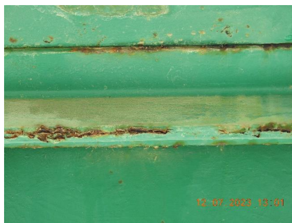
Fot. 118. Korozja wżerowa, złuszczenie warstwy antykorozyjnej
