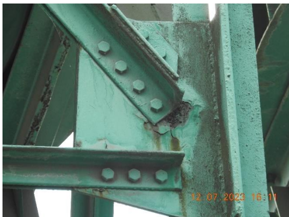
Fot. 39. Złuszczenie powierzchni antykorozyjnej, zanieczyszczenie organiczne
