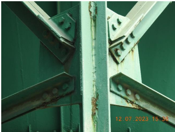
Fot. 69. Korozja wżerowa, zacieki produktami korozji
