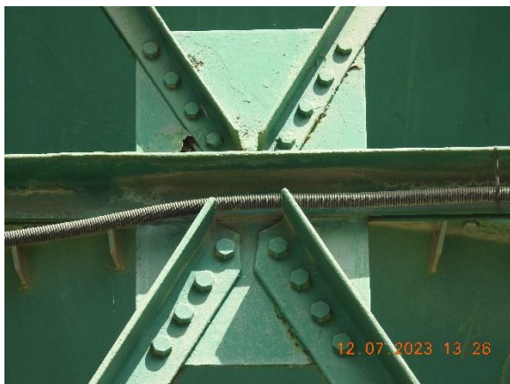
Fot. 99. Korozja wżerowa, uszkodzenie powłoki antykorozyjnej
