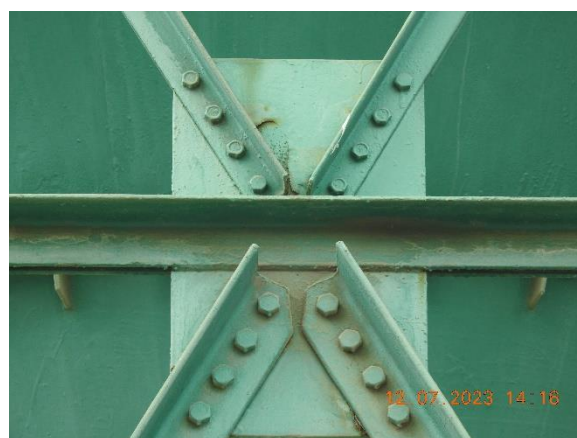
Fot. 88. Korozja wżerowa, uszkodzenie powłoki antykorozyjnej
