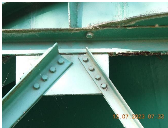
Fot. 4. Ubytki powłok malarskich, korozja kątowników
