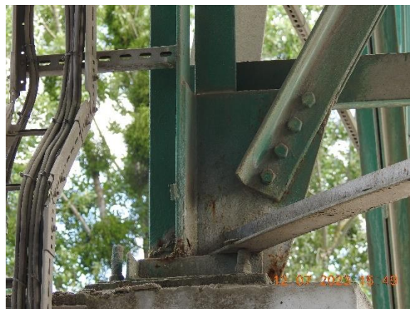
Fot. 56. Korozja wżerowa węzła podporowego
