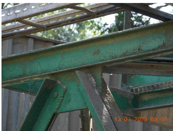
Fot. 127. Korozja wżerowa, zacieki produktów korozji, zanieczyszczenia organiczne
