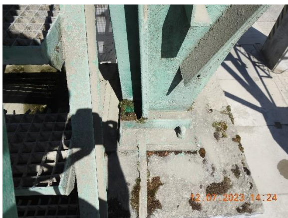
Fot. 95. Korozja wżerowa, zamknięta przestrzeń bez odpływu w podstawie, zanieczyszczenia organiczne
