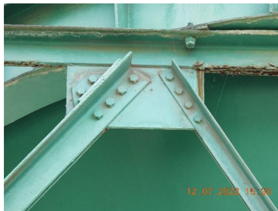
Fot. 28. Zaawansowana korozja wżerowa, zanieczyszczenia organiczne, zacieki produkcji korozji
