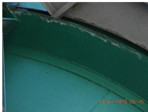
Fot. 138. Korozja powierzchniowa, ubytki powłoki lakierniczej.
