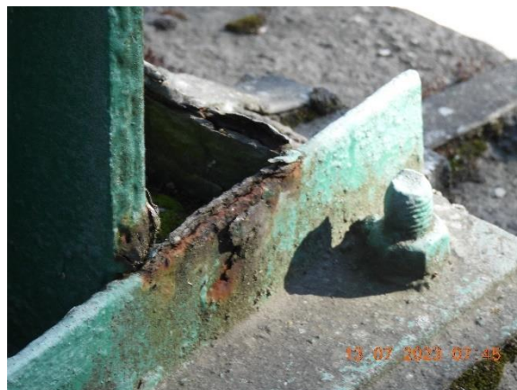
Fot. 12. Zaawansowana korozja wżerowa węzła podporowego
