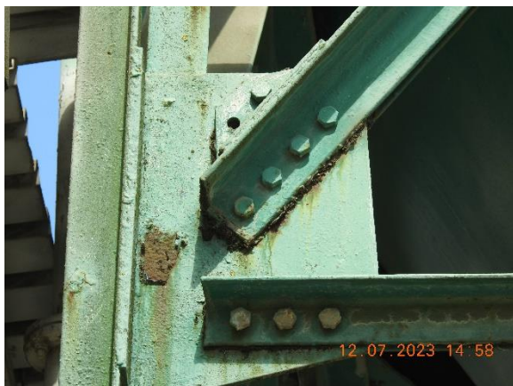
Fot. 77. Korozja wżerowa, uszkodzenie powłoki antykorozyjnej, zacieki produktem korozji, brak śruby
