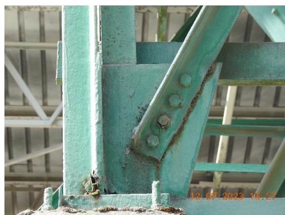
Fot. 66. Korozja wżerowa, uszkodzenie powłoki antykorozyjnej, zanieczyszczenia organiczne
