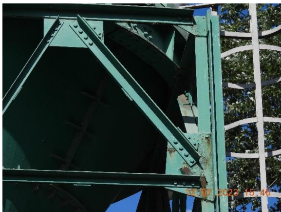
Fot. 21. Korozja powierzchniowa blachy węzłowej, zacieki produktem korozji, złuszczenie powłoki antykorozyjnej, zanieczyszczenia organiczne
