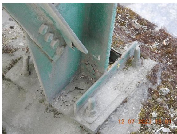
Fot. 84. Korozja wżerowa, złuszczenie warstwy antykorozyjnej
