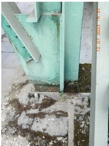
Fot. 59. Korozja wżerowa, zamknięta przestrzeń bez odpływu w podstawie, zanieczyszczenia organiczne
