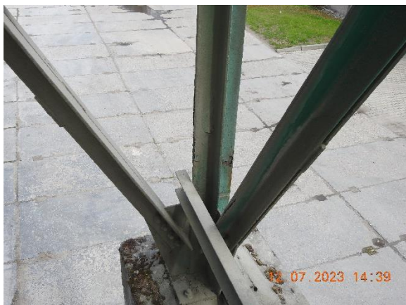
Fot. 91. Korozja wżerowa słupa, zacieki produktów korozji, ubytki powłoki antykorozyjnej
