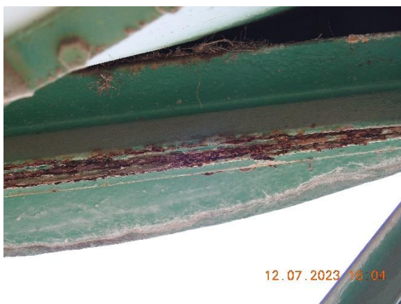
Fot. 49. Zaawansowana korozja wżerowa
