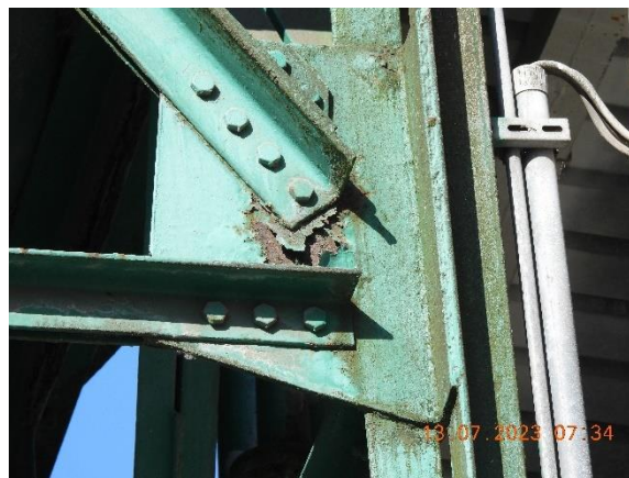
Fot. 2. Złuszczenia powłok antykorozyjnych, korozja powierzchniowa i wżerowa
