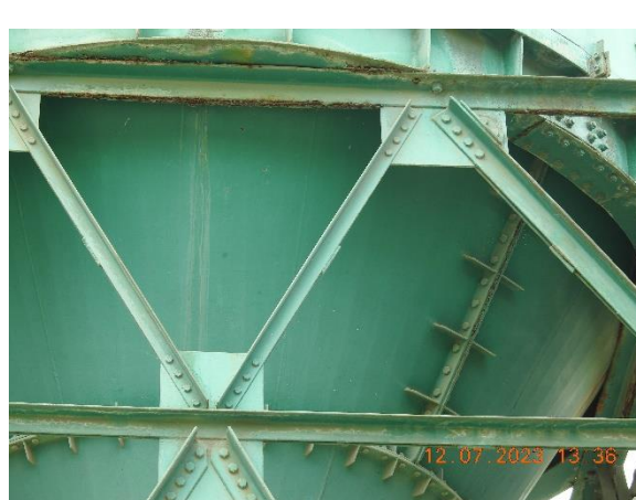
Fot. 102. Korozja wżerowa, zacieki produktem korozji
