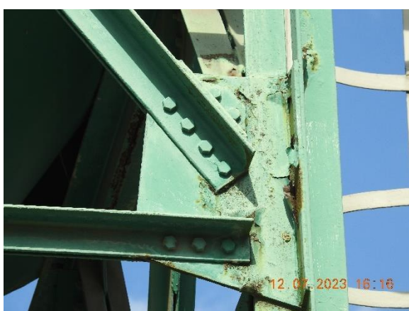
Fot. 41. Złuszczenia powierzchni antykorozyjnej, korozja wżerowa
