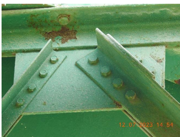
Fot. 75. Korozja wżerowa, uszkodzenie powłoki antykorozyjnej
