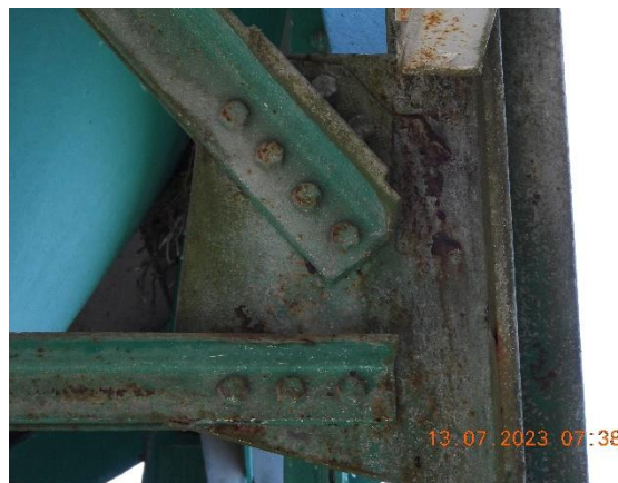
Fot. 6. Ubytki powłok antykorozyjnych, korozja powierzchniowa, zanieczyszczenia organiczne
