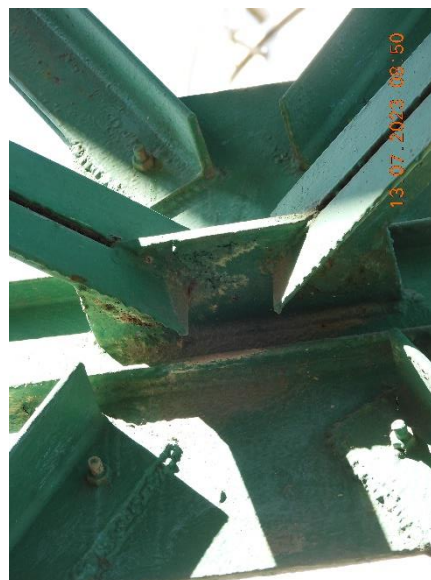
Fot. 144. Korozja wżerowa, złuszczenia powłoki antykorozyjnej
