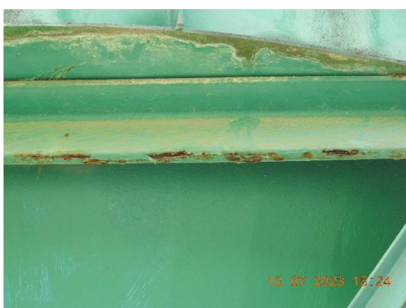
Fot. 63. Korozja wżerowa, uszkodzenie powłoki antykorozyjnej
