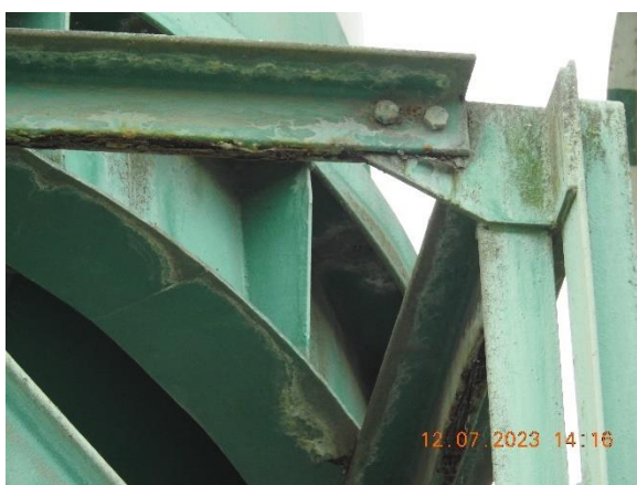
Fot. 89. Korozja wżerowa, uszkodzenie powłoki antykorozyjnej, zanieczyszczenia organiczne
