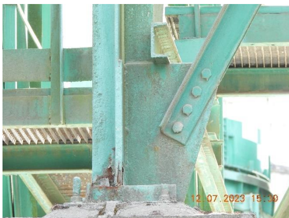
Fot. 31. Zaawansowana korozja wżerowa
