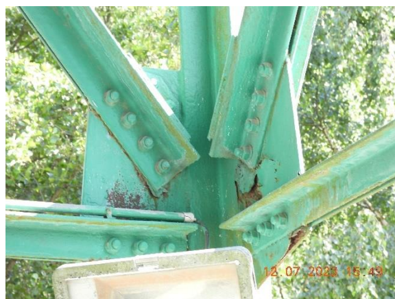
Fot. 24. Złuszczenia powłoki antykorozyjnej, zanieczyszczenia organiczne, korozja powierzchniowa.
