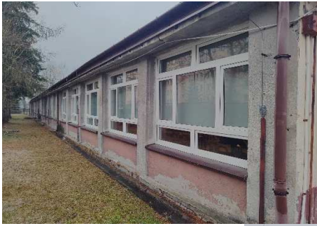
Elewacja zachodnia - stan techniczny ścian zewnętrzny widoczny na zdjęciach.
