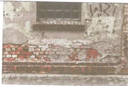
Fot. 6. Detal – zniszczone tynki i cegły na elewacji budynku warsztatów
