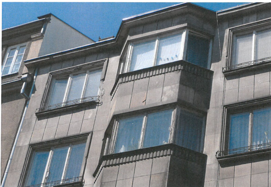
Fot.36. Ubytki piaskowca – elewacja frontowa
