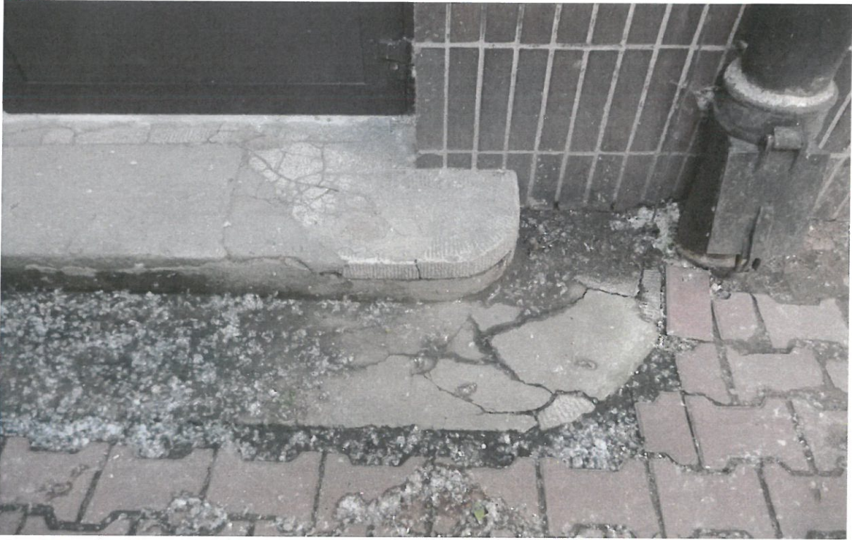
Fot.42. Uszkodzony stopnia zewnętrznego.
