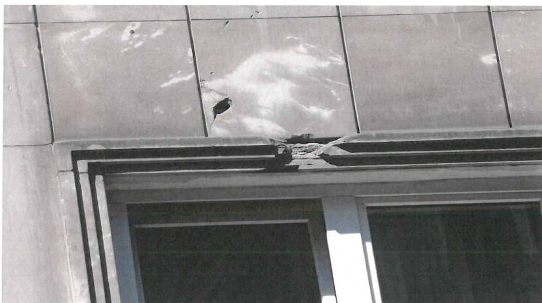
Fot.37. Uszkodzenie opaski okiennej – elewacja frontowa
