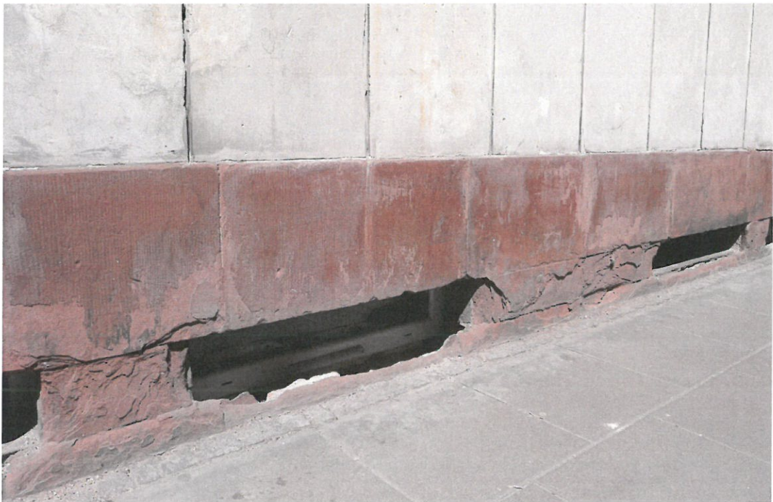
Fot.41. Uszkodzenia cokołu – elewacja frontowa
