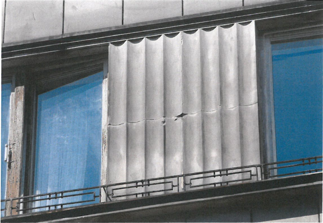
Fot.40. Uszkodzenia filarków międzyokiennych– elewacja frontowa
