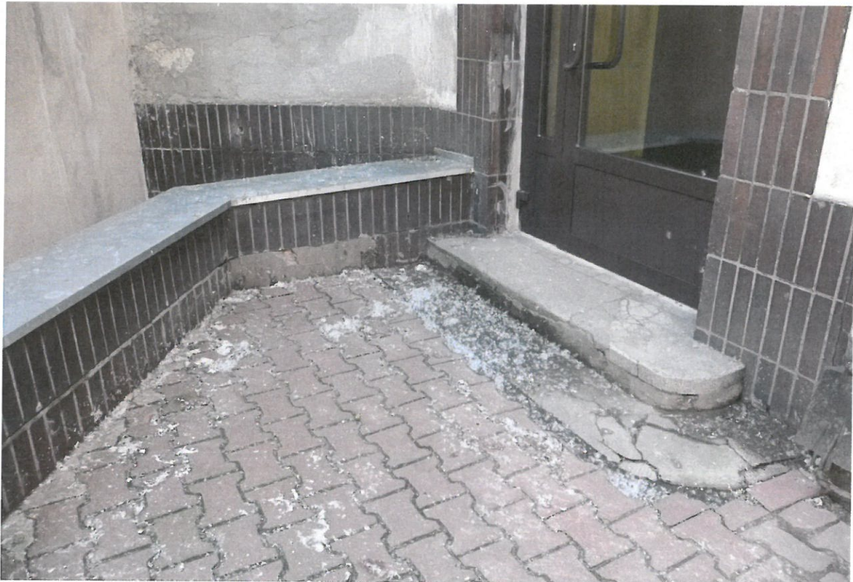
Fot.43. Uszkodzenia okładziny ceramicznej cokołu oraz stopni zewnętrznych
