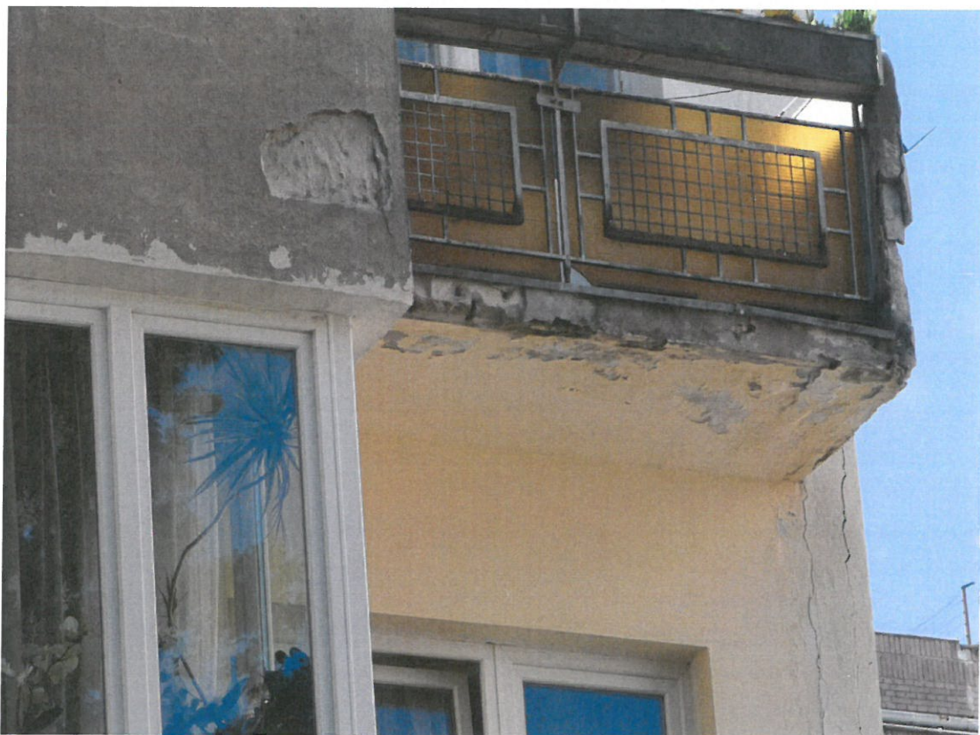
Fot.46. Uszkodzenia balkonów i tynku elewacji dziedzińca.
