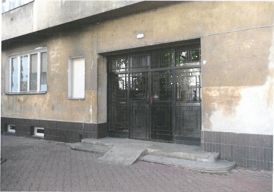
Fot.44. Uszkodzenie stopni wyjściowych na dziedziniec.
