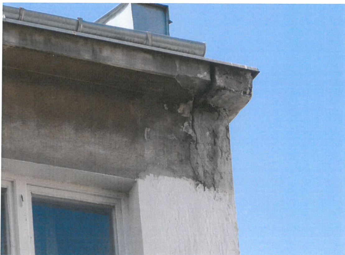
Fot.47. Wtórne naprawy gzymsu.
