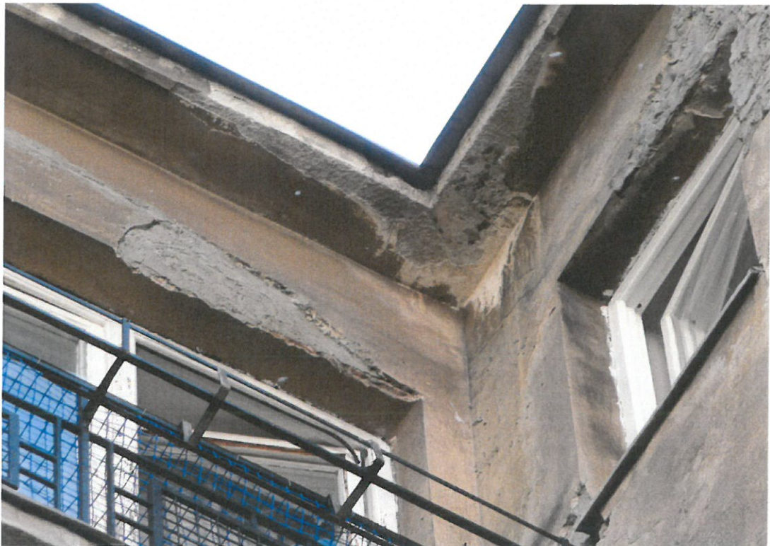
Fot.45. Uszkodzenie gzymsu wieńczącego oraz tynku.
