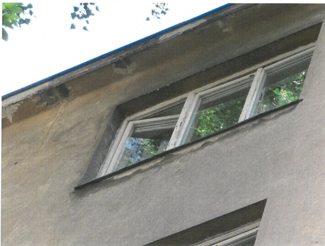
Fot.49. Uszkodzenia gzymsu.
