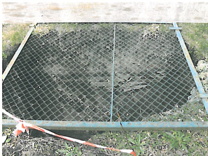
Fragment ściany widoczny w zapadlisku
