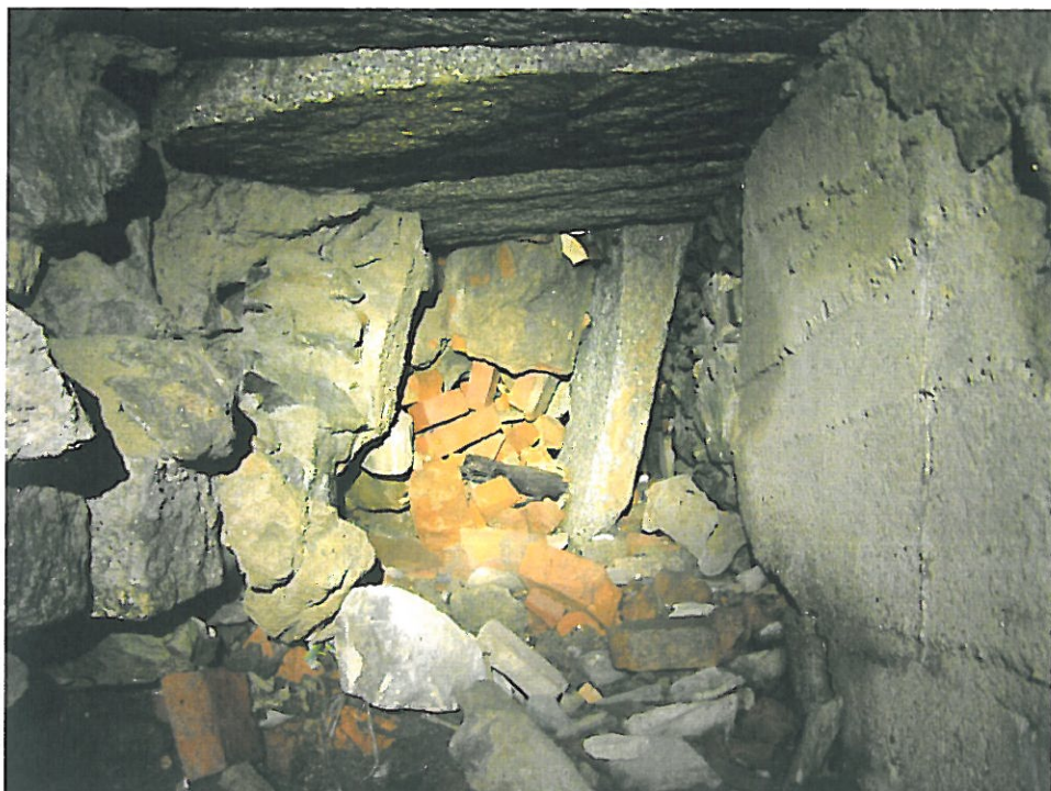
Zawalenie się lewej ściany i utrata podparcia spowodowały zawalenie się płyt stropowych
