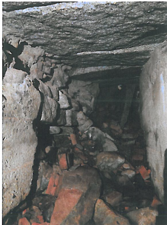
Ściana wymagająca odbudowy (lewa strona kanału, patrząc od strony rzeki)
