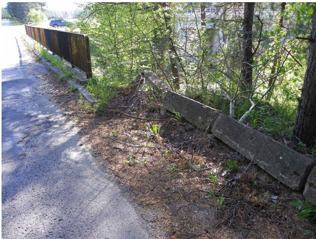
Fot. 4. Wegetacja roślinności przy krawężniku na kapie chodnikowej. Zdeformowany krawężnik. Korozja balustrady. Zniszczona bariera energochłonna przed obiektem.
