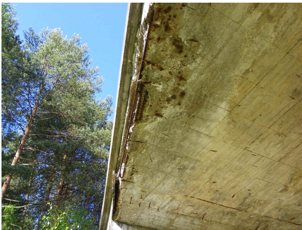
Fot. 3. Degradacja betonu ustroju nośnego. Korozja zbrojenia. Pęknięcia i osady na gzymsie.
