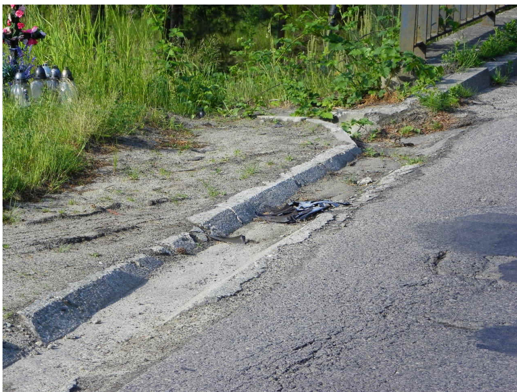
Fot. 5. Zamulone koryta odwodnieniowe zlokalizowane przed obiektem. Brak prawidłowego odprowadzenia wody po skarpach stożków.
