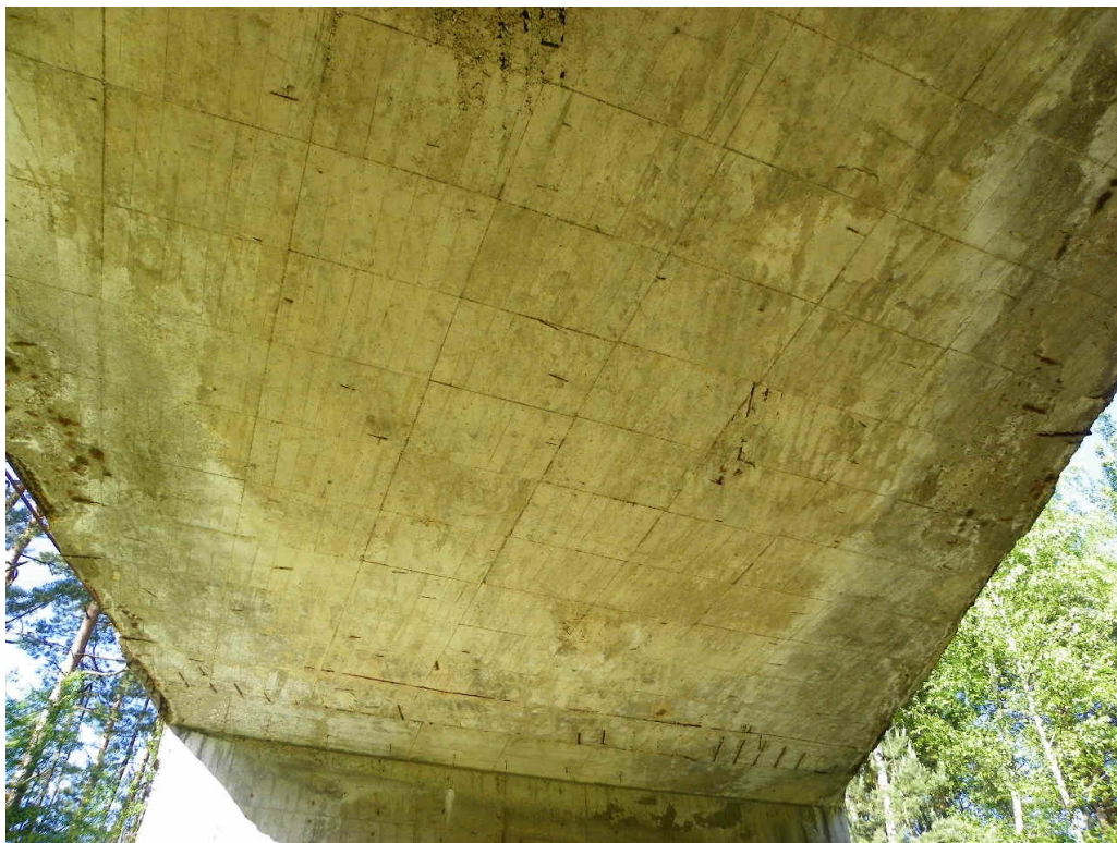
Fot. 3. Widok na ustrój nośny. Widoczna korozja zbrojenia płyty.
