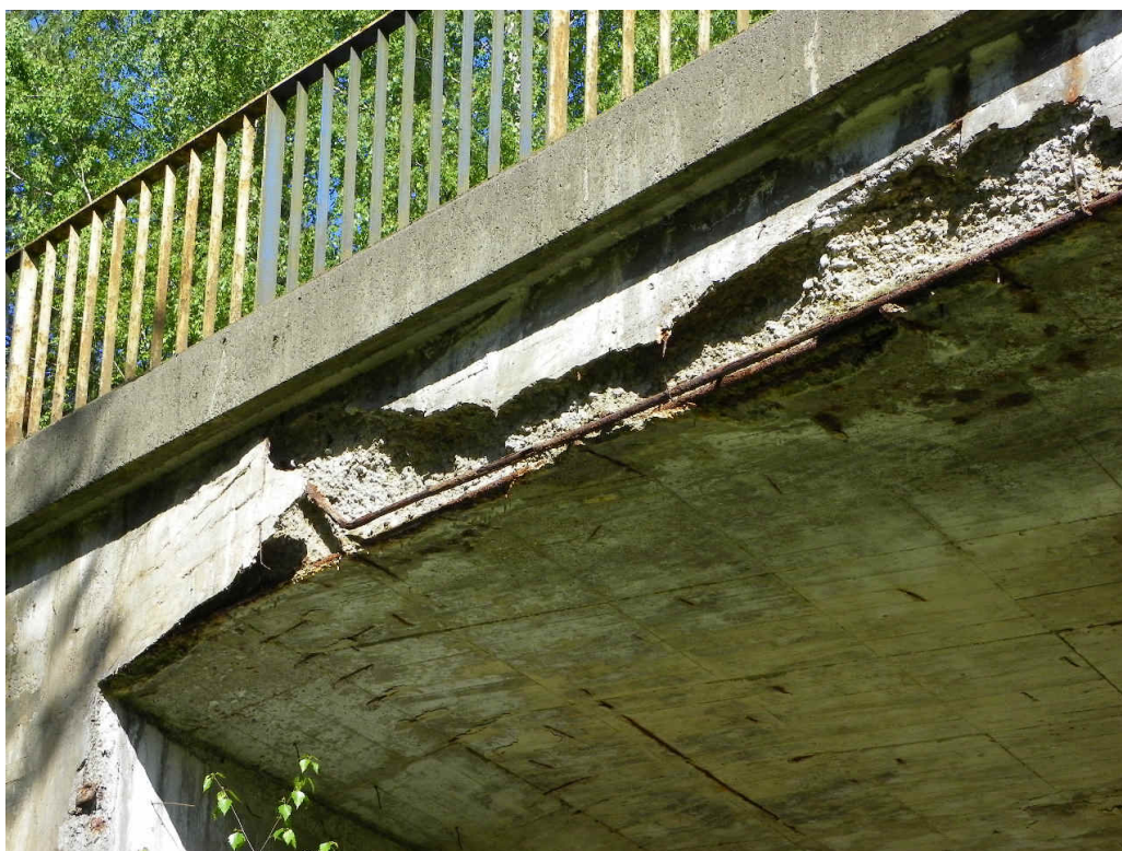
Fot. 1. Degradacja betonu ustroju nośnego. Korozja zbrojenia.
