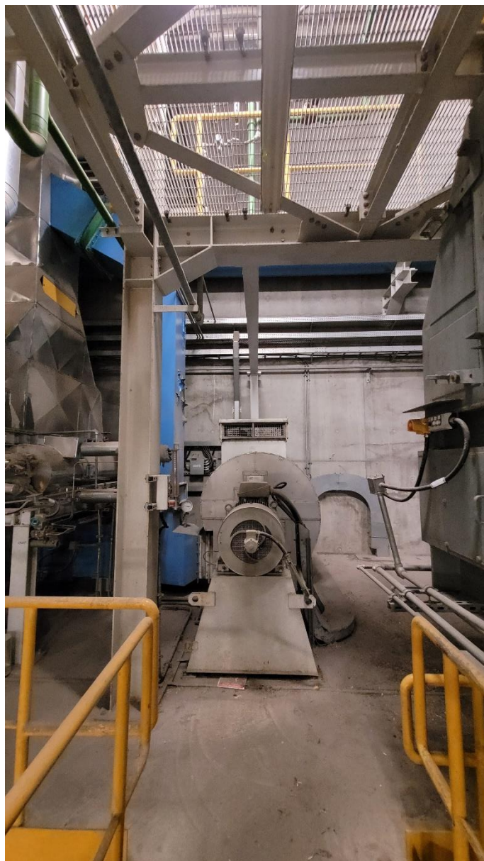
Fot. 2 Wentylator promieniowy powietrza wtórnego na linii L2
