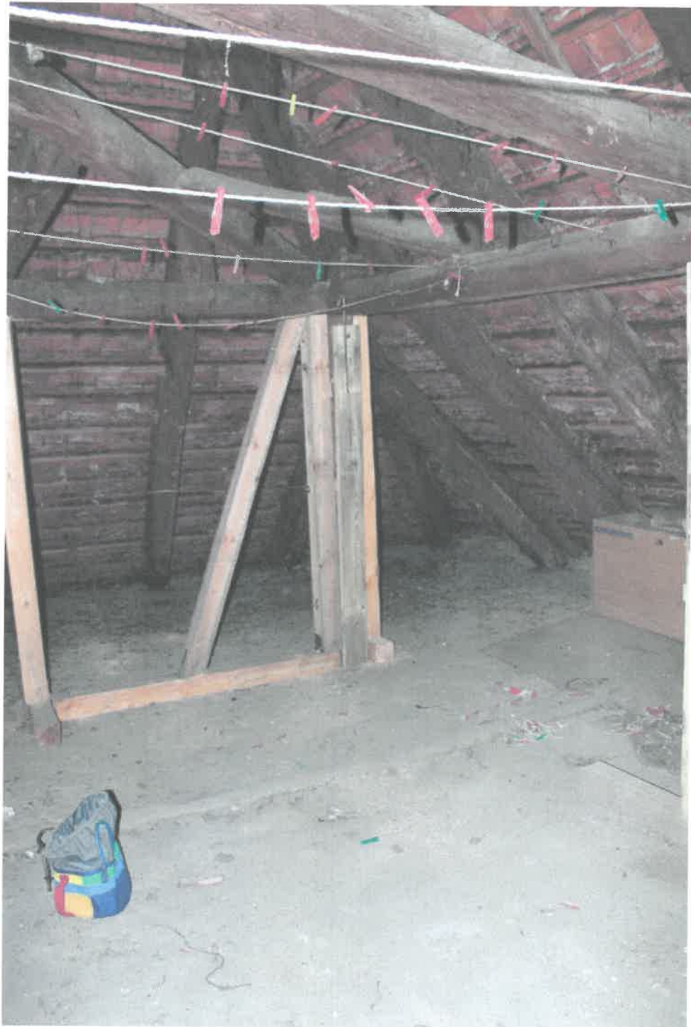
Wzmocniony słup narożny z zastrzałem w części B
