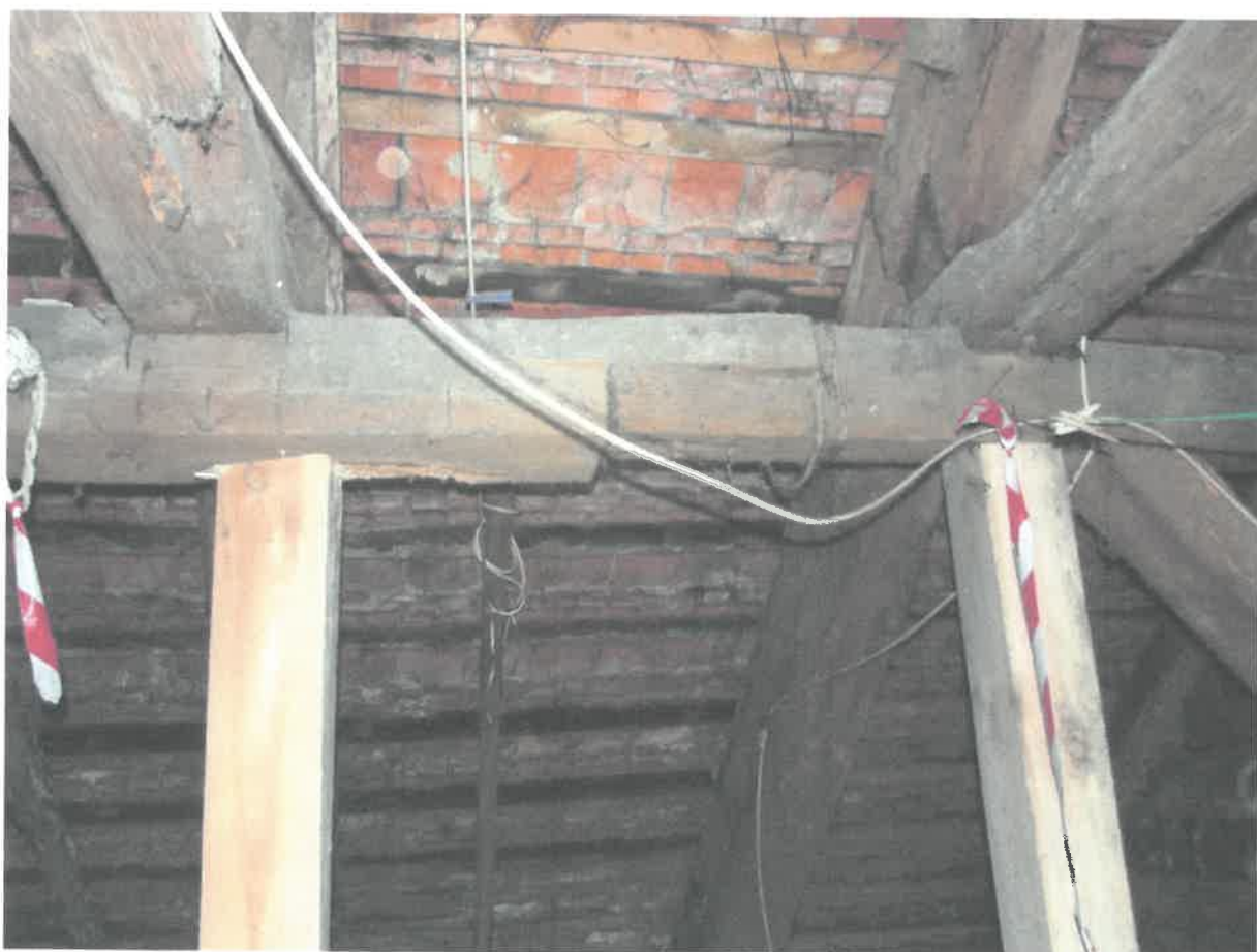
Podparcie płatwi pod krokwią przy łączeniu zakładkowym – kierunek podłużny w części A
