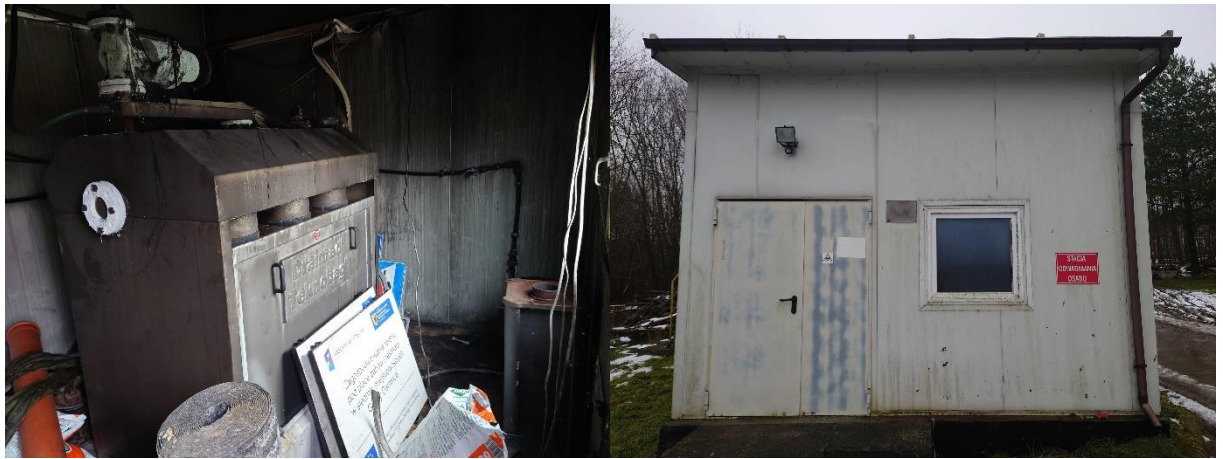
Fot. 10 Stacja odwadniania osadu.
