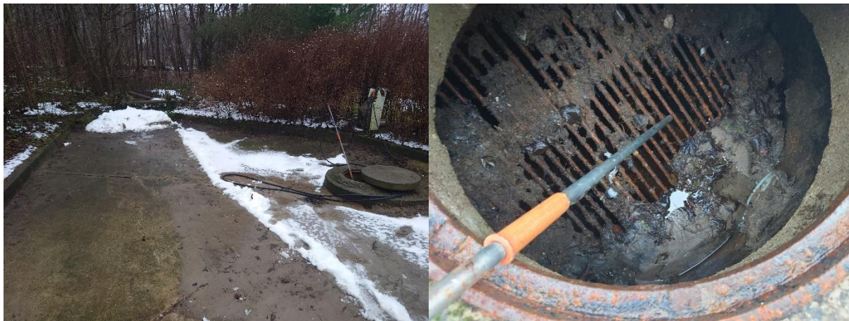
Fot. 1 Punkt zlewny ścieków dowożonych.
