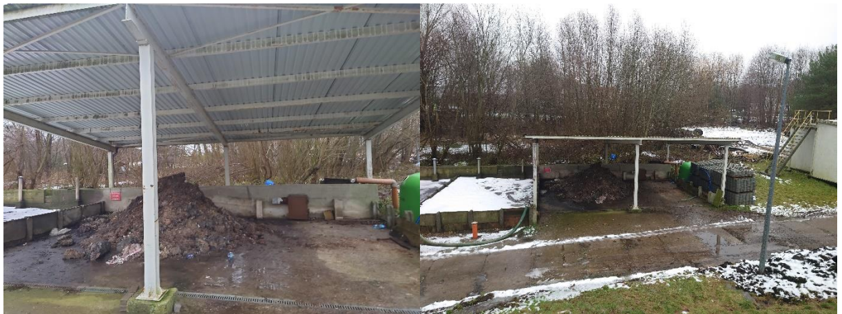
Fot. 11 Wiata na odpady.
