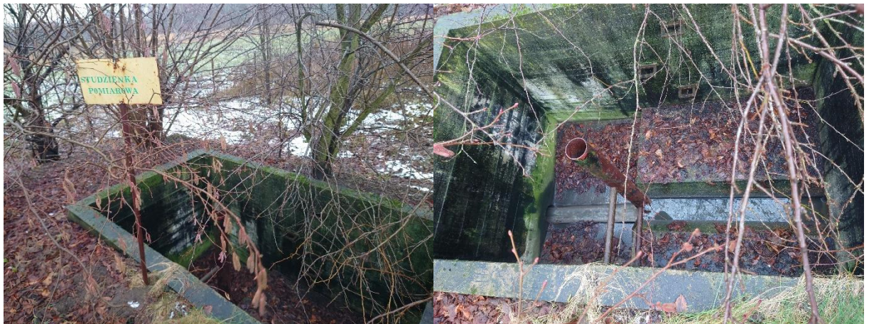
Fot. 6 Komora pomiarowa.
