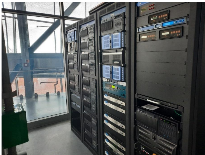
szafy rackowe w górnej serwerowni
