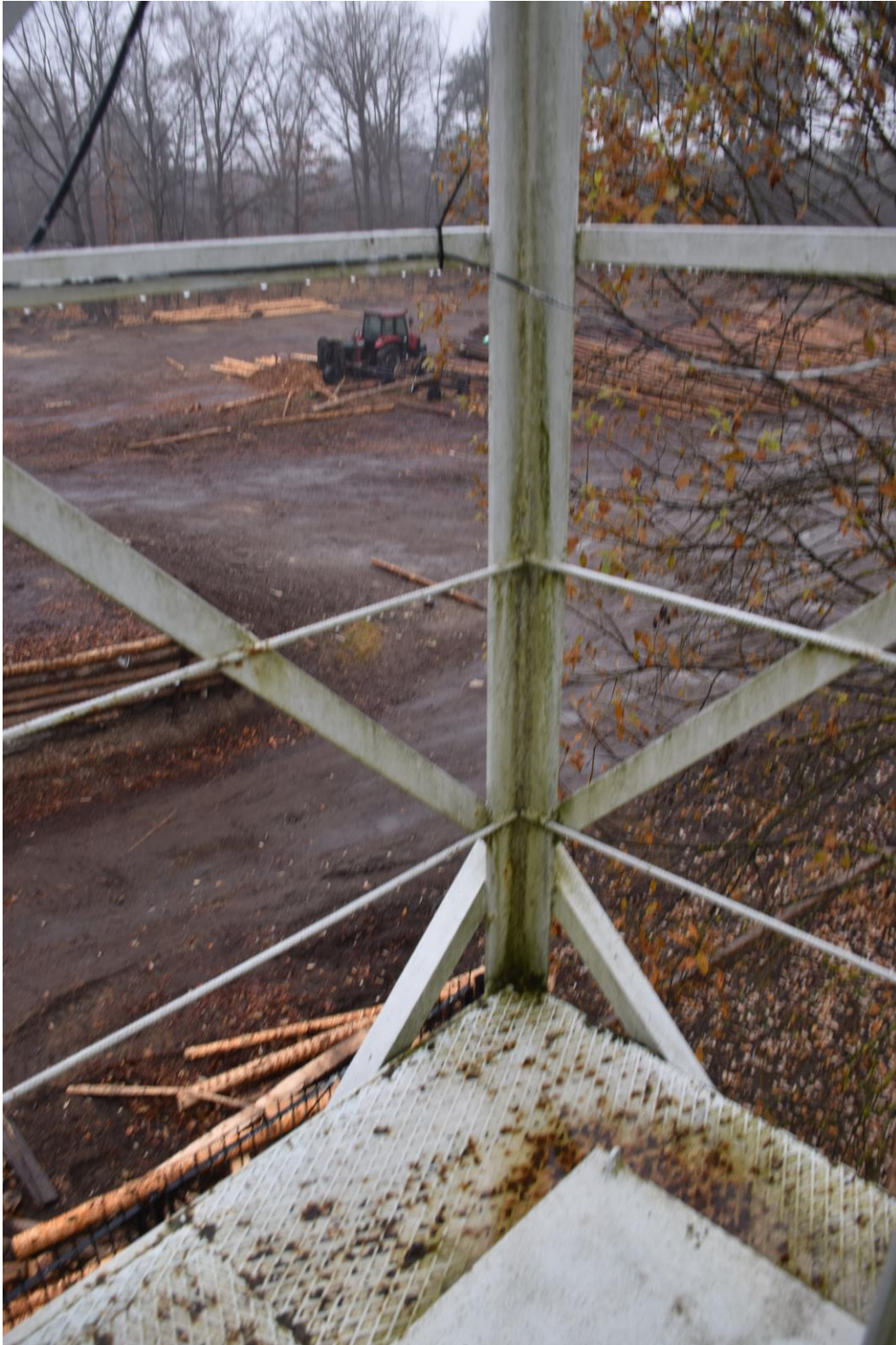
Rys.4b. Widok aktualnego stanu zabezpieczenia antykorozyjnego łączników śrubowych na wieży. Stwierdzono występowanie lokalnych punktowych ognisk korozji na wieży i większą ilość punktów korozyjnych na poziomych blachach podestów).
