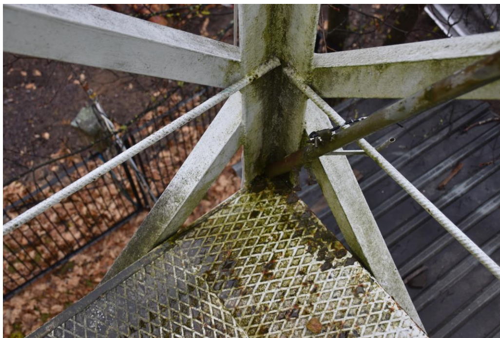
Rys.4a. Istotnych objawów korozji nie stwierdzono (nie licząc punktowych ognisk korozji na elementach wieży i podestach).
