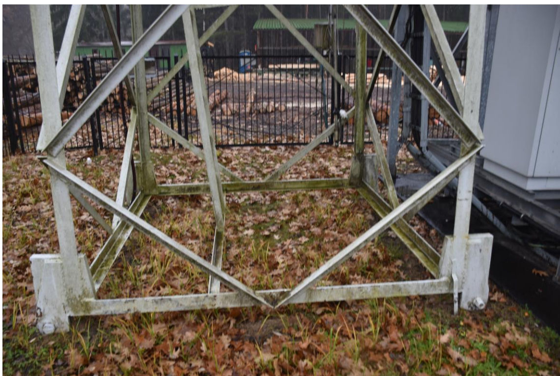
Rys.4e. Brak oczyszczenia i izolacji naziemnych części fundamentów.
