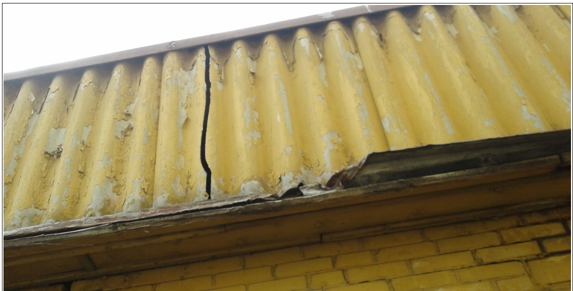
zdjęcie nr 4 – popękane azbestowo-cementowe płyty osłonowe części dachowej budynku
