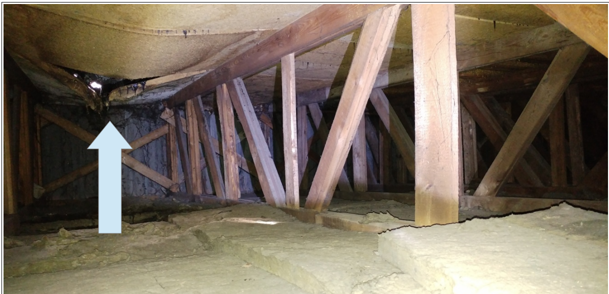
zdjęcie nr 6 – drewniana, kratownicowa konstrukcja dachowa z widocznymi zarwaniami pokrycia z płyt paździerzowych
