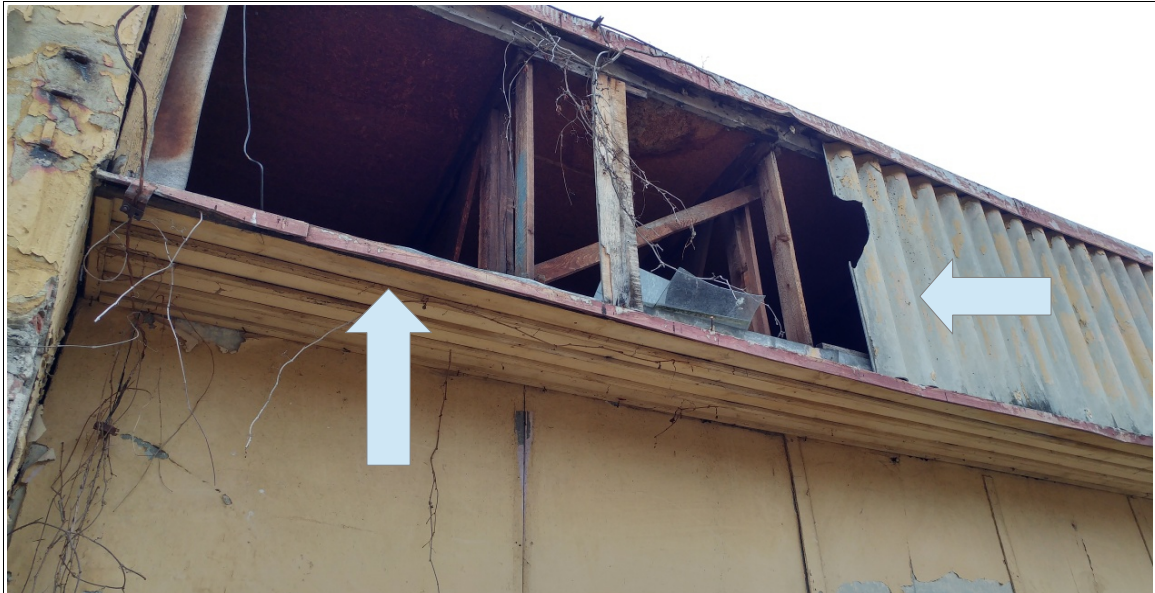
zdjęcie nr 5 – popękane i powyrywane azbestowo-cementowe płyty osłonowe części dachowej budynku
