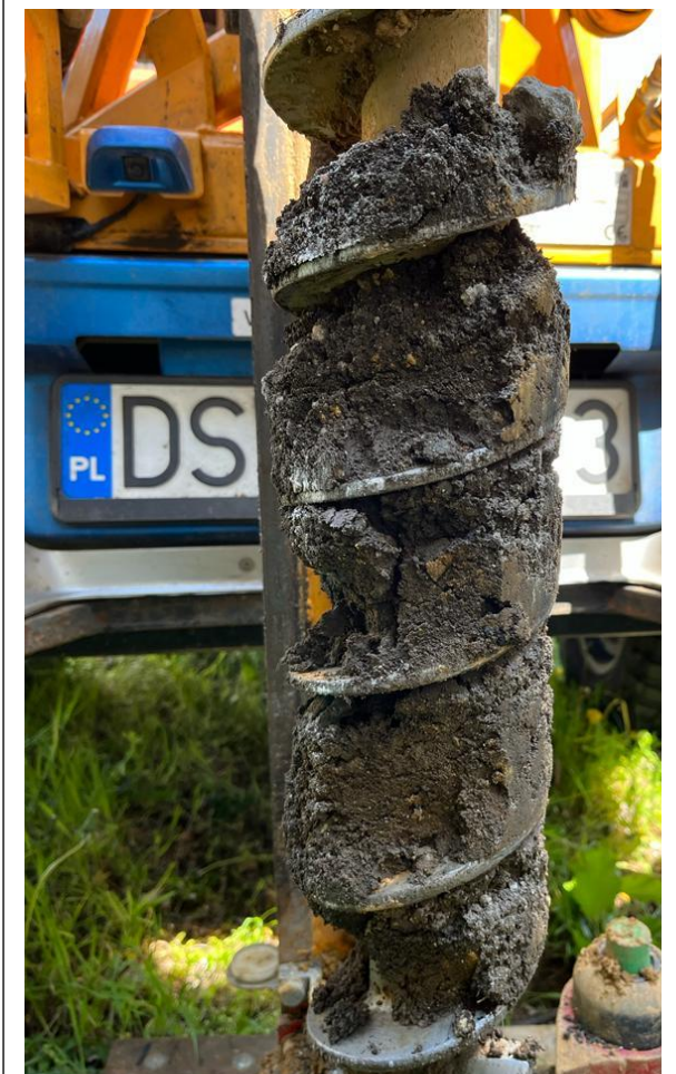
Przykład próby gruntu OW2 głębokość 0,05-1,7 m p.p.t. – nasyp niekontrolowany w składzie: glina piaszczysta z domieszką żwiru przewarstwiona pospółką zaglinioną, humus, szlaka, fragmenty cegła i szczątek roślin
