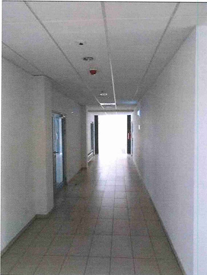
Fot. 5. Widok na korytarz na kondygnacji poniżej pomieszczenia do adaptacji, przez który mają być prowadzone instalacje
