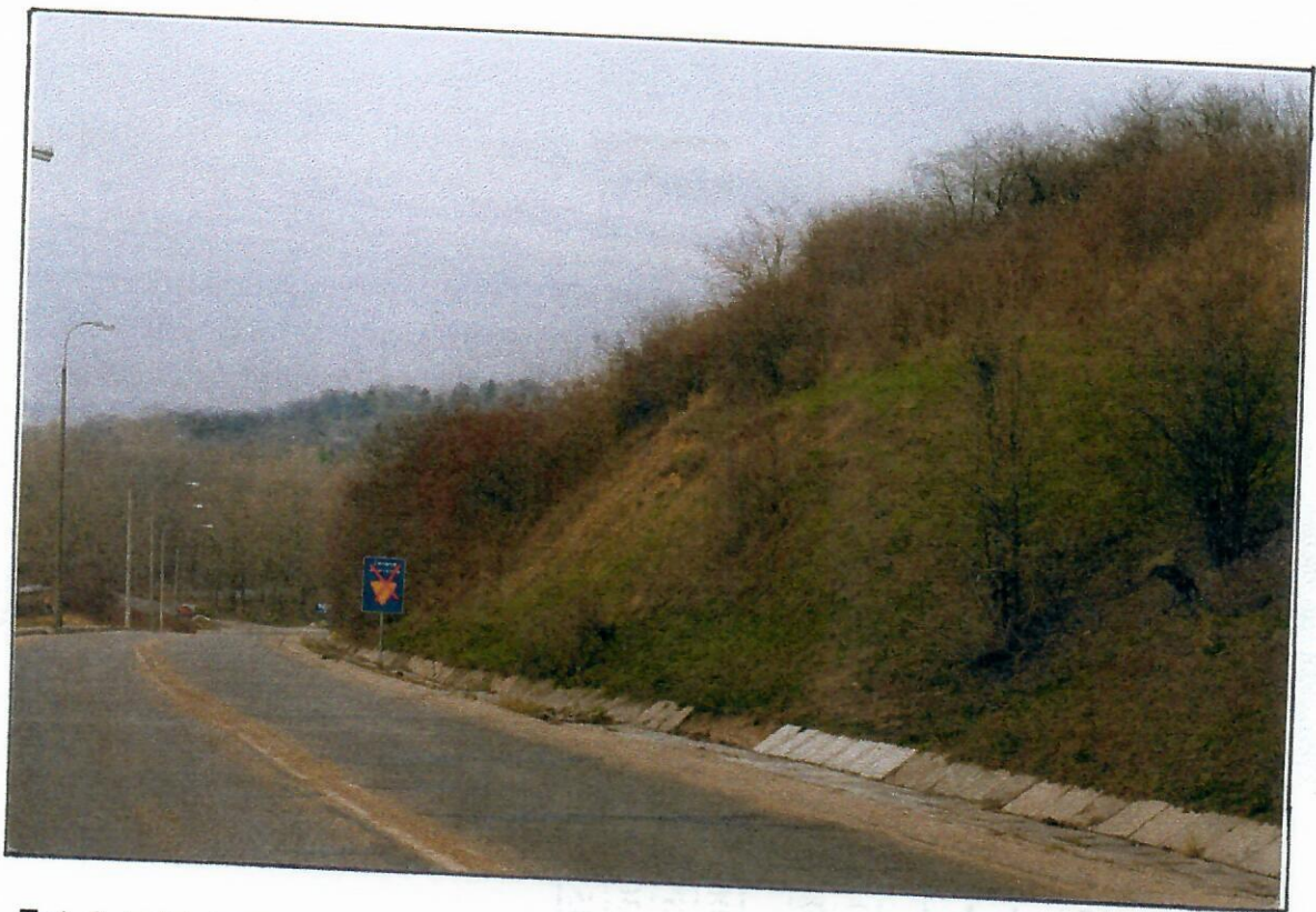
Fot. 2. Widok na osuwisko i ul. Kazimierza Wielkiego od strony wschodniej
