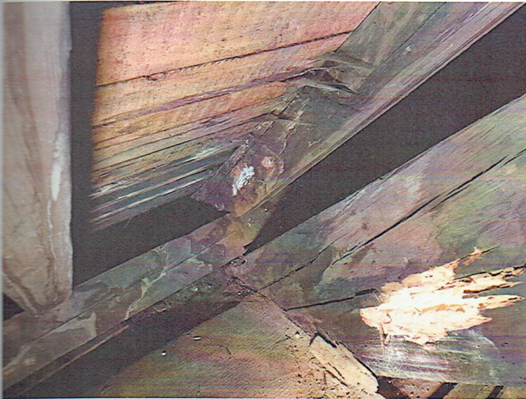
Fot. 12. Uszkodzenia korozyjnie elementów konstrukcji przy okapie: ślady przecieków i zniszczenia przez owady
