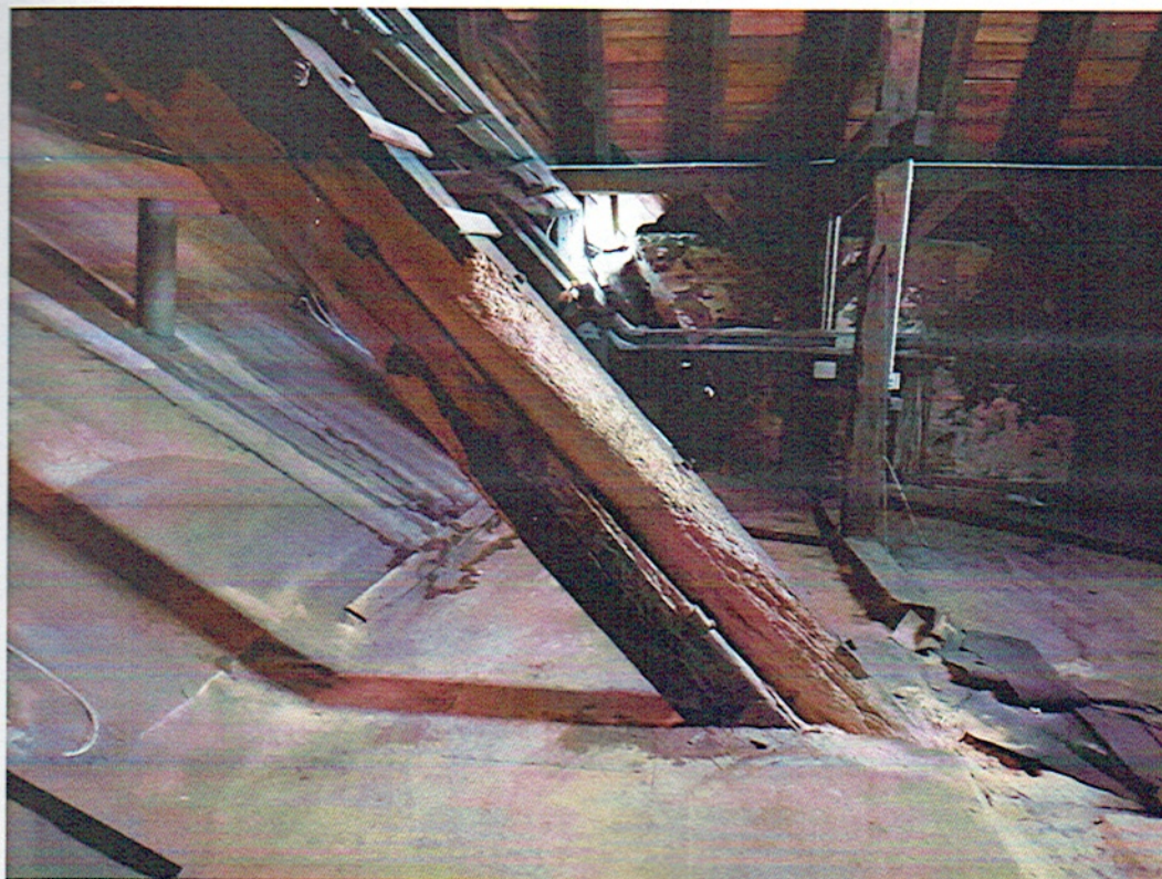
Fot. 4. Uszkodzona przez owady strefa podporowa wiązara nad transeptem
