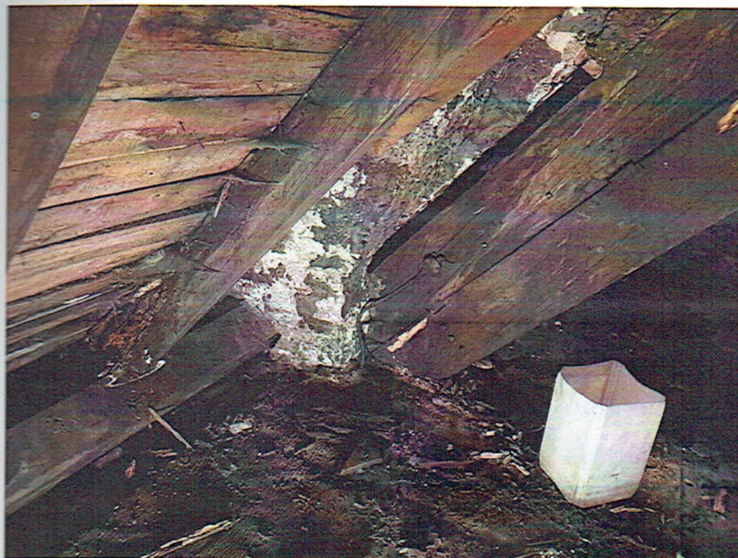
Fot. 8. Zbutwiała końcówka krokwi na połaci południowej
