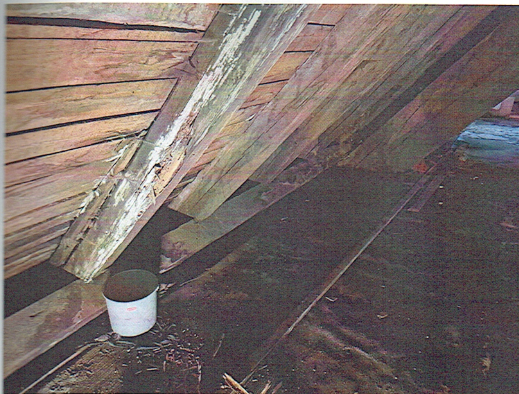
Fot. 7. Zbutwiała końcówka krokwi na połaci północnej
