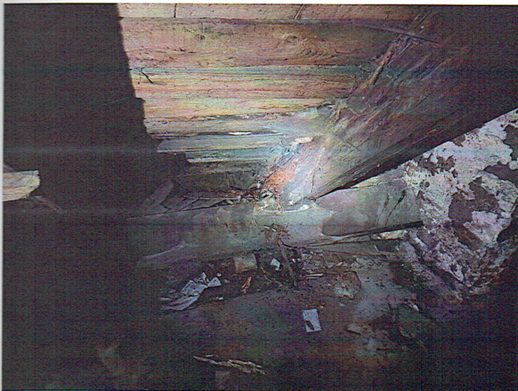
Fot. 6. Zbutwiała końcówka krokwi na połaci północnej
