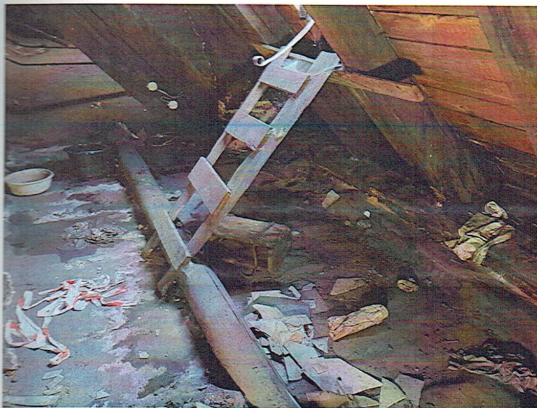
Fot. 9. Zbutwiała płatew, zbutwiałe końcówki krokwi i uszkodzona podłoga przy okapie pod wyłazem dachowym na połaci południowej; przecieki przez pokrycie
