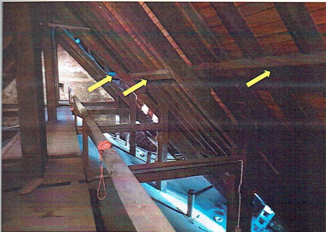
Fot. 13. Widoczne ugięcia płatwi
