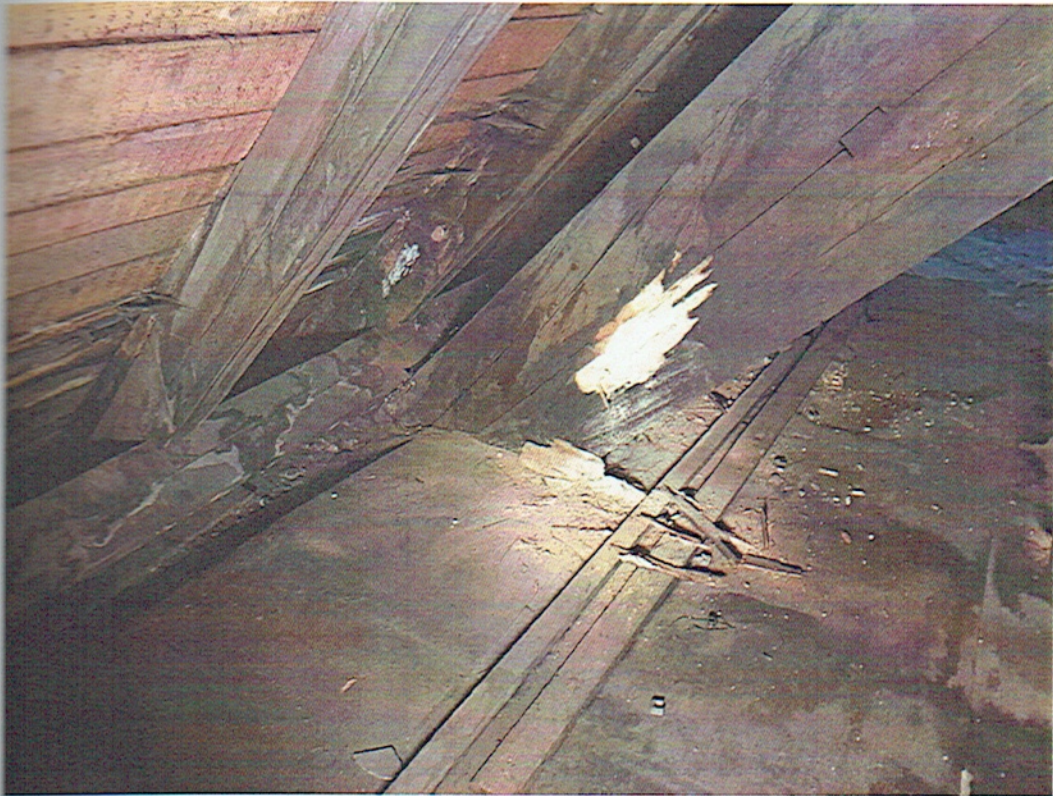
Fot. 10. Uszkodzone korozyjnie elementy konstrukcji przy okapie: krokwie płatew i strefa podporowa wiązara
