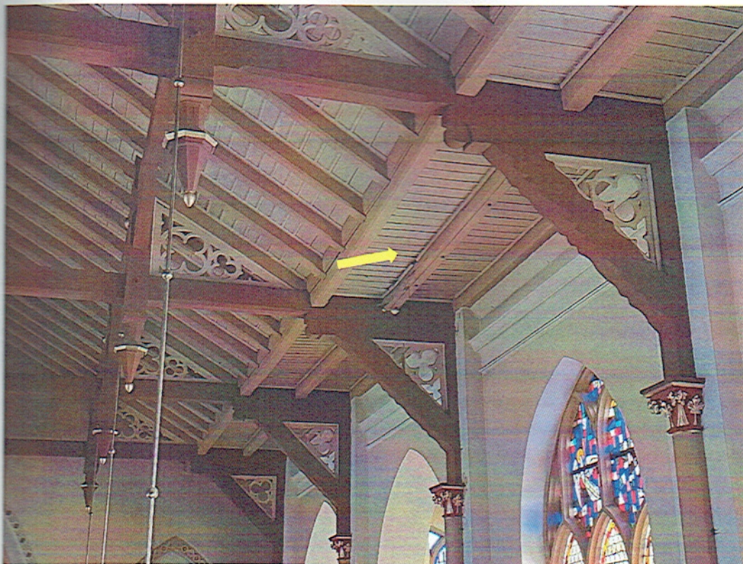
Fot. 3. Uszkodzona korozyjnie belka stropowa
