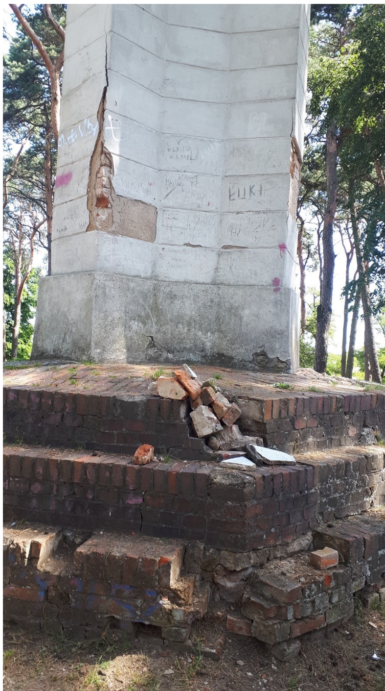
Fot. 41. Stan zachowania dolnej części trzonu kolumny oraz jej ceglanoego cokołu 68
