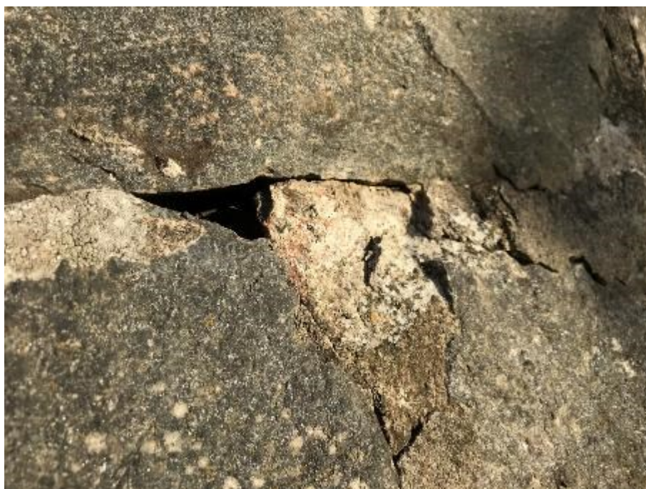
Fot. 28. Spękania i ubytki zapraw spoinujących umożliwiające wnikanie wody w głębsze partie muru
