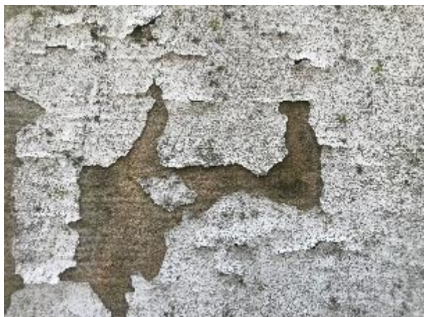
Fot. 61. Ubytki w tynku, spękania i odspojenia
