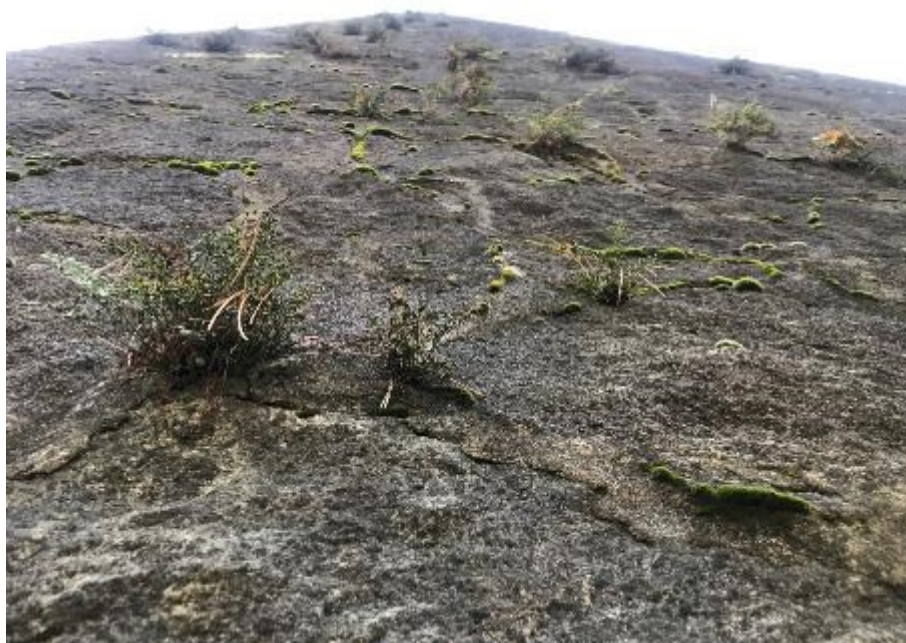
Fot. 46. Kamienna ściana piramidy grobowej poprzestana roślinnością w miejscach zdeintegrowanych fug i spękań kamieni
