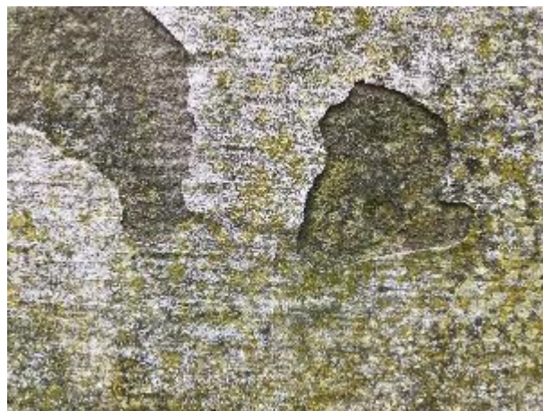
Fot. 62. Glony i porosty na powierzchni tynku i w jego ubytkach
