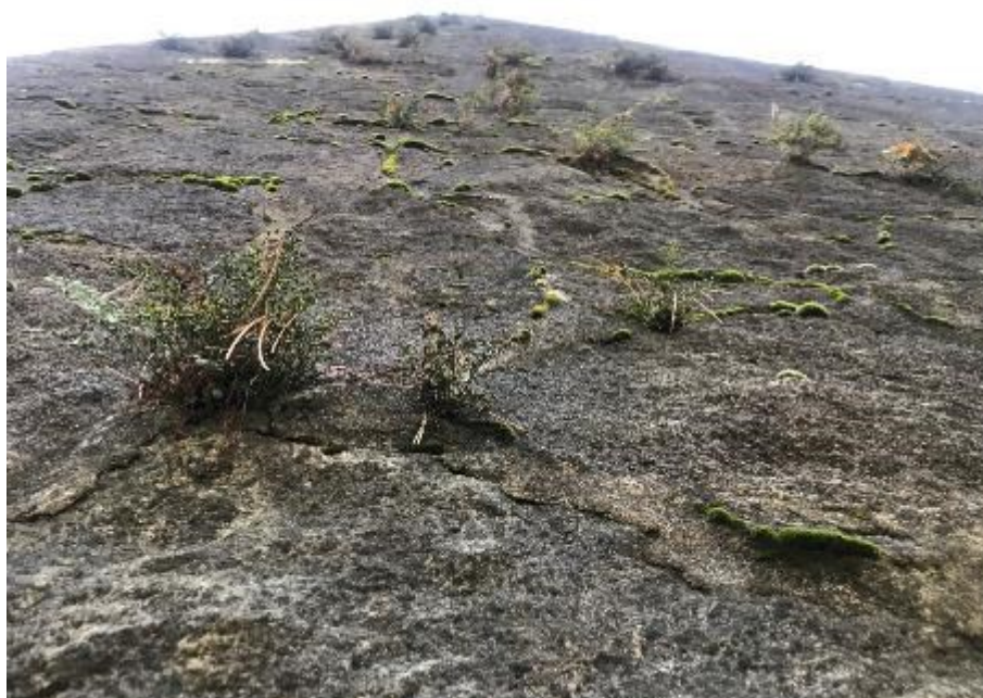
Fot. 45. Kamienna ściana piramidy grobowej poprzerastana roślinnością w miejscach zdeintegrowanych fug i spękań kamieni
