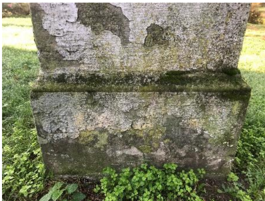
Fot. 65. Przyziemna zawilgocona część filara, porośnięta mchami, glonami, widoczne ubytki w odspajającym się tynku
