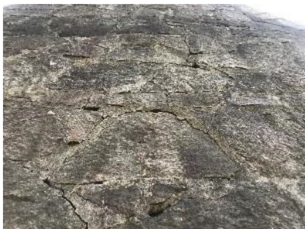
Fot. 51. Spękania i odspojenia zapraw spoinujących umożliwiające wnikanie wody do wnętrza muru
