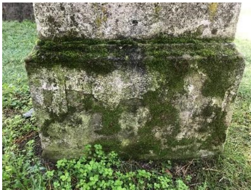
Fot. 40. Dolna część filara silnie zawilgocona i porośnięta mchami i porostami oraz odspojenia i ubytki w tynku
