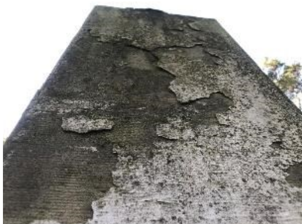
Fot. 37. Górna część filara, widoczne uszkodzenia i ubytki tynku oraz silne zabrudzenia powierzchni odstłoniętego trzonu
