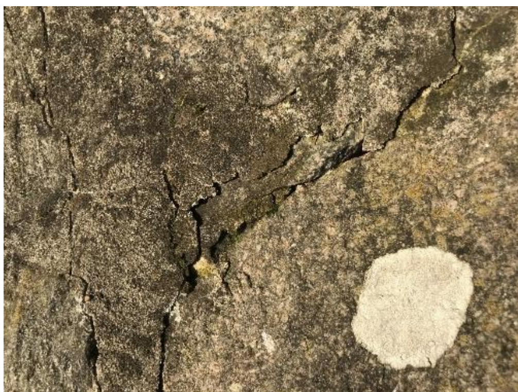
Fot. 47. Spękania w obrębie muru i zniszczenia zapraw spoinujących
