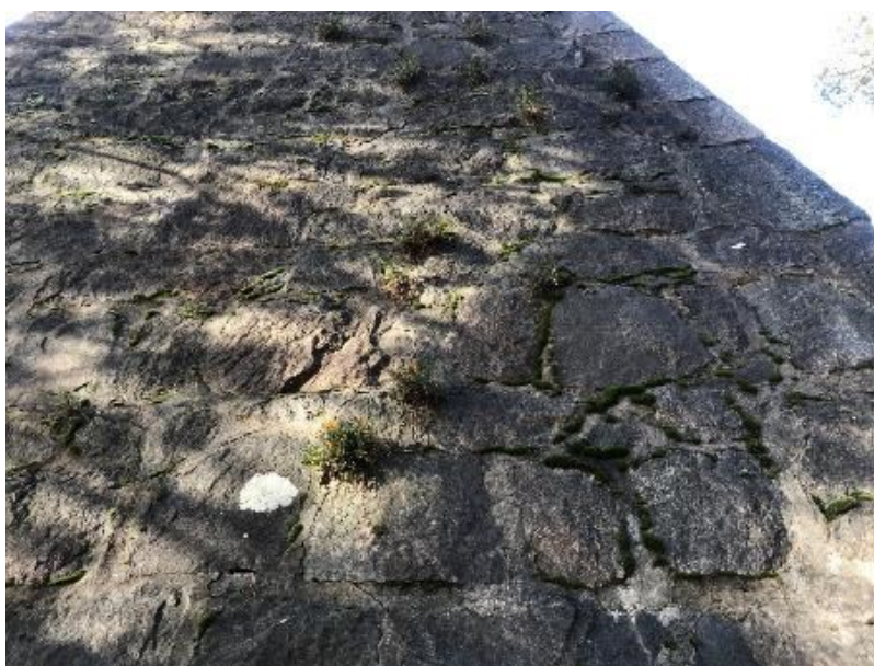
Fot. 29. Ściana piramidy grobowej porośnięta machami, porostami oraz drobną roślinnością zakorzenioną w ubytkach zapraw spoinujących
