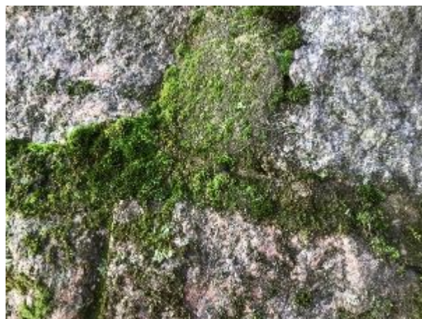
Fot. 49. Mchy porastające powierzchnie kamiennych ścian piramidy
