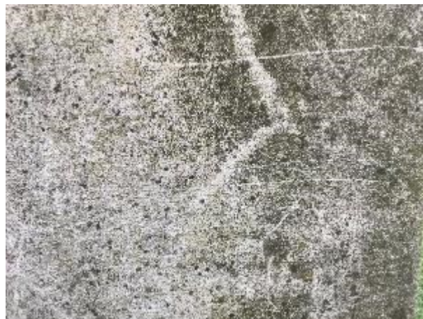
Fot. 38. Uszkodzenia tynku w obrębie filara, widoczne zarysowania ostrym narzędziem oraz glony i porosty pokrywające powierzchnię
