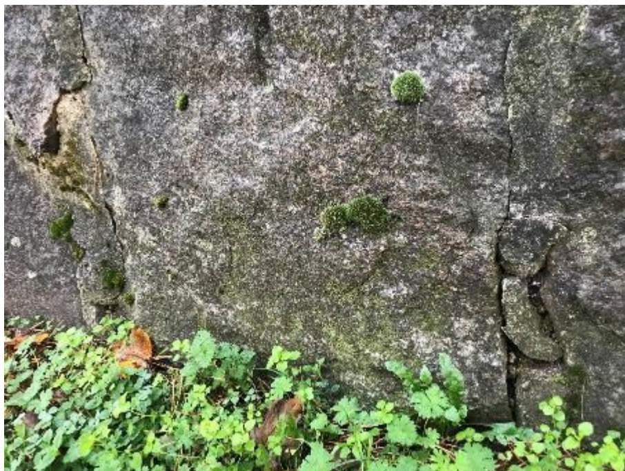
Fot. 56. Pęknięcia muru sięgające przyziemia, tworzące kanały do wnikania wody i porostania roślinności
