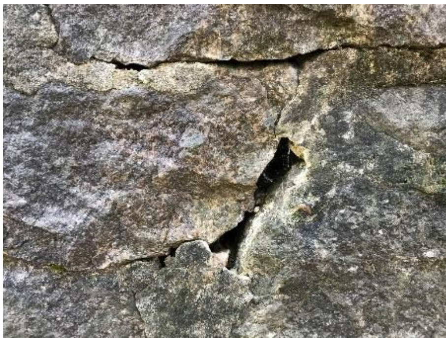
Fot. 27. Przestrzenie pomiędzy kamieniami spowodowane wypłukaniem zapraw spoinujących
