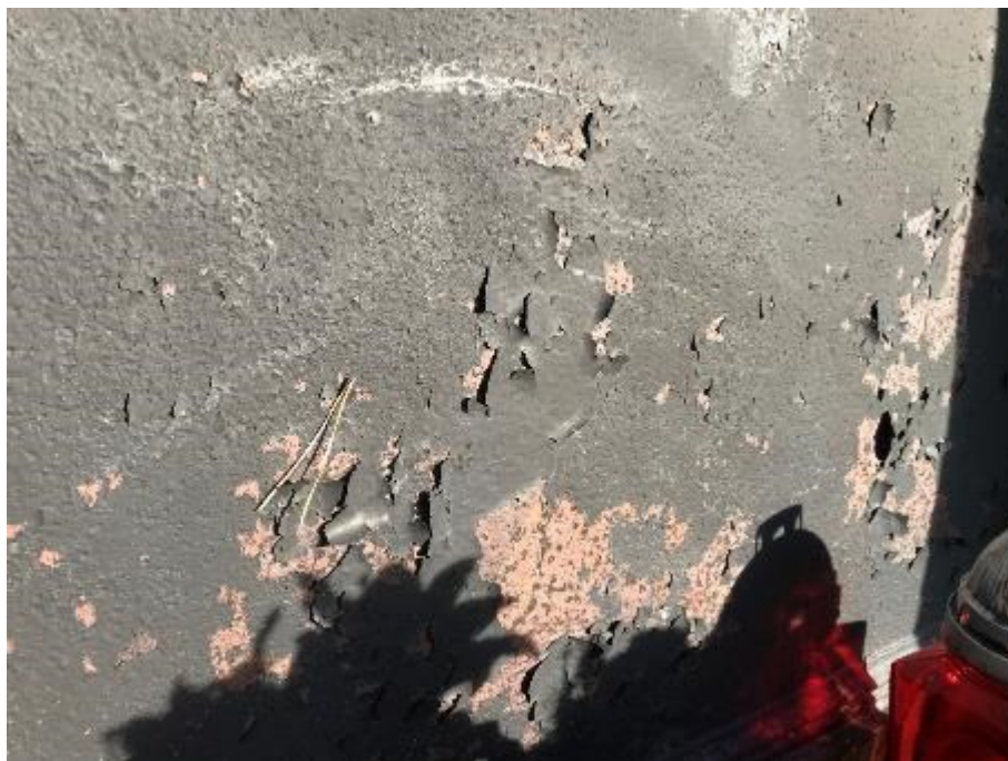
Fot. 58. Żelazne drzwi, zniszczenia warstwy malarskiej, korozja żelaznej powierzchni widoczna w ubytkach warstwy malarskiej
