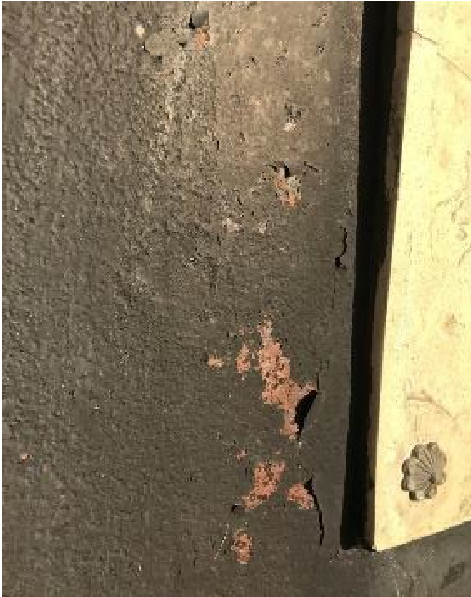
Fot. 33. Stalowe drzwi wejściowe do piramidy z łuszczącą się powłoką malarską oraz odsłoniętą powierzchnią skorodowanego metalu
