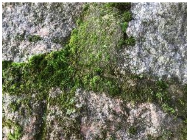
Fot. 30. Mchy i porosty obrastające spoiny i powierzchnię kamieni
