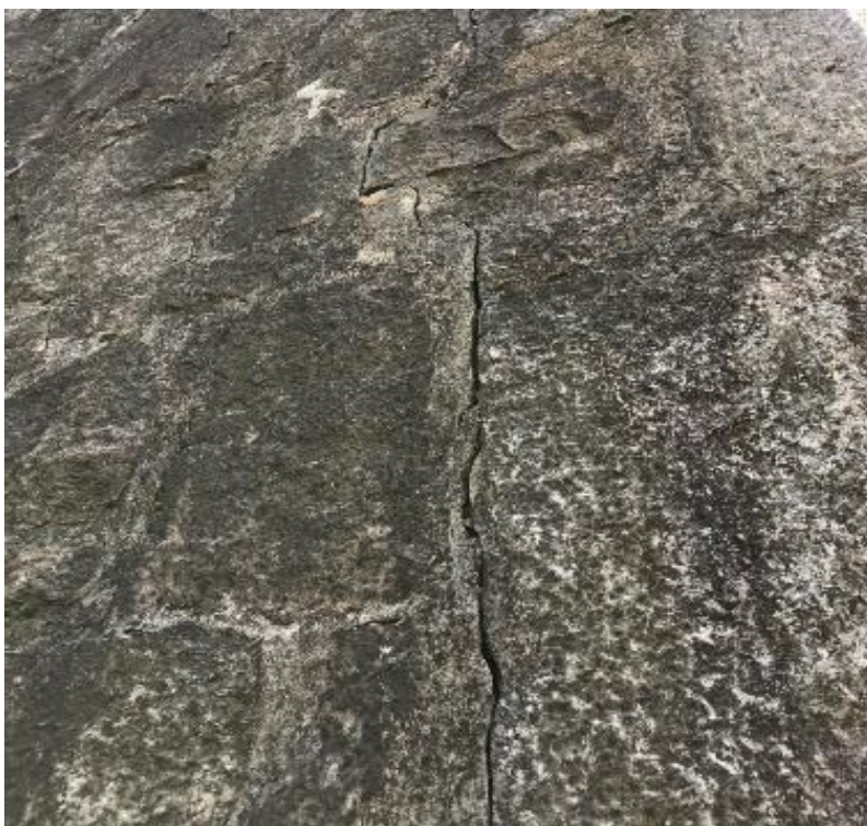
Fot. 26. Pionowe pęknięcie biegnące wzdłuż kamieni tworzących narożnik
