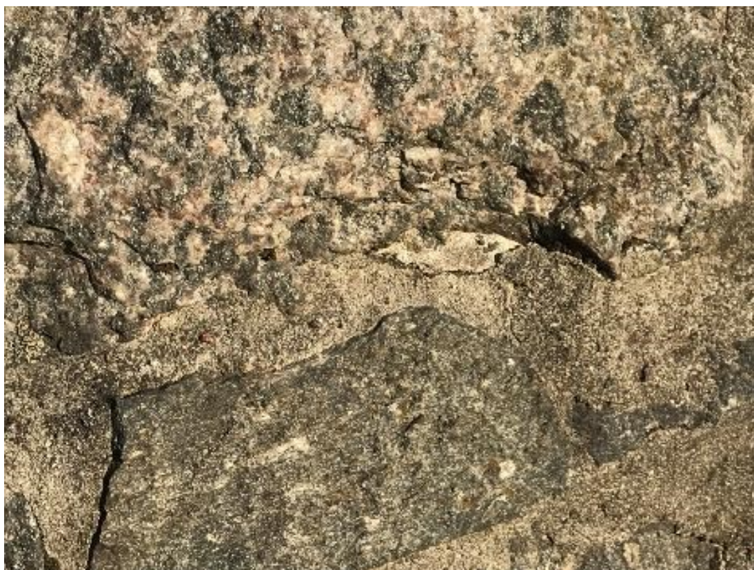
Fot. 53. Stan zachowania zdeintegrowanych zapraw spoinujących oraz pęknięcia w obrębie bloków kamienia
