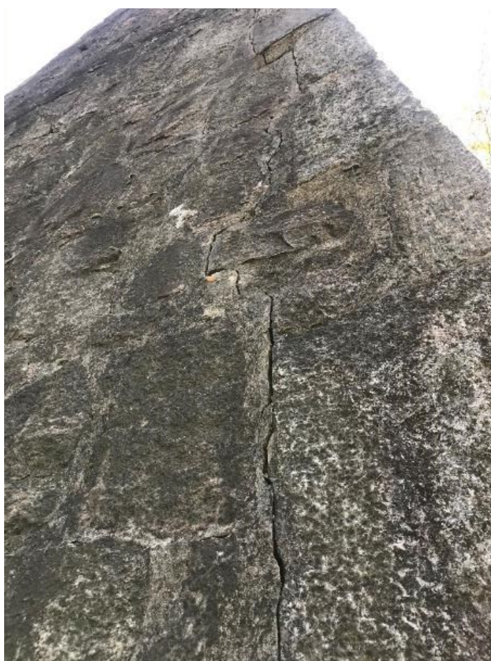
Fot. 55. Pionowe pęknięcie muru i odspojenie narożnika
