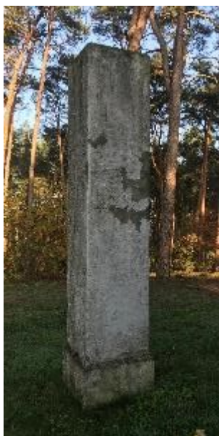
Fot. 39. Jeden z filarów otaczających piramidę, widoczne zniszczenia partii przyziemnych oraz odspajający się od powierzchni tynk
