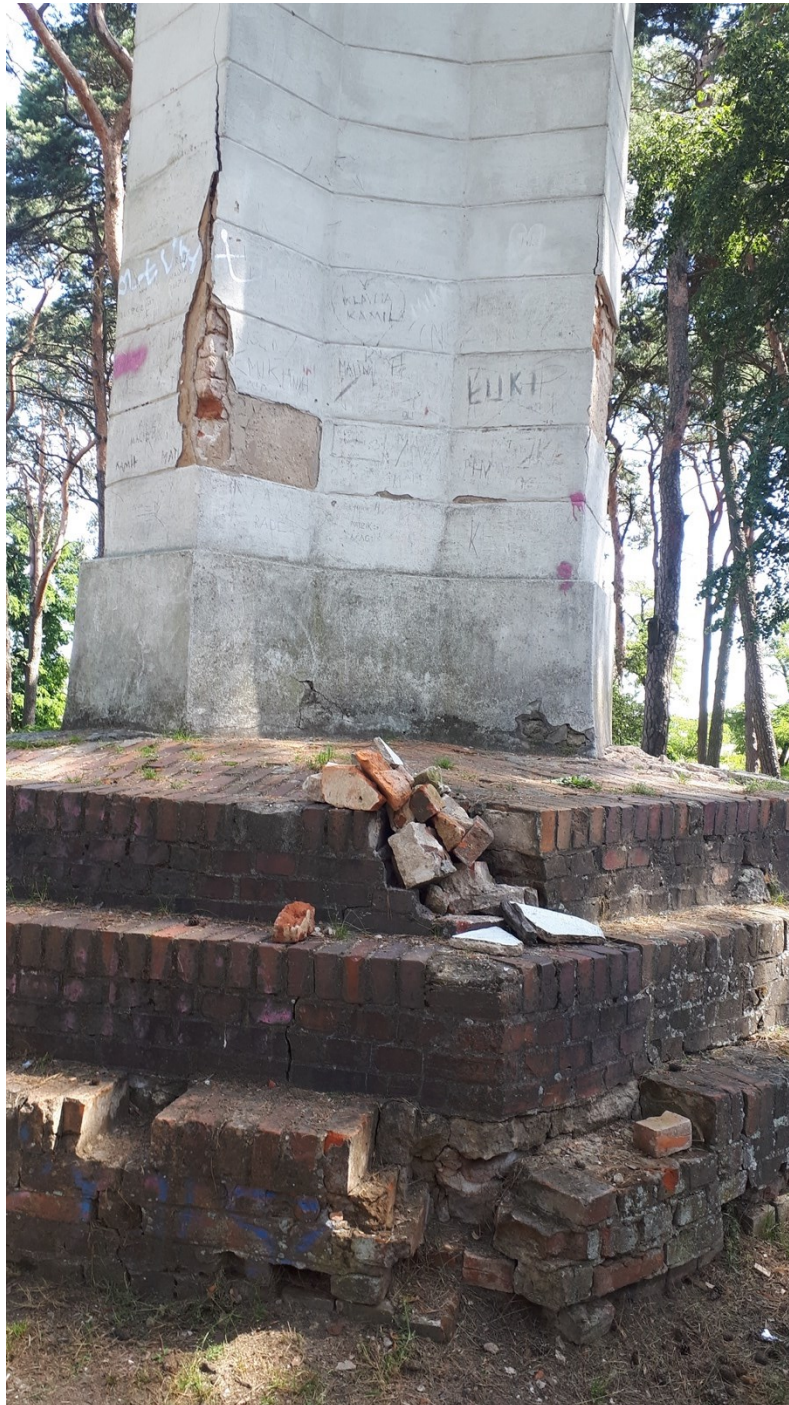
Fot. 70. Stan zachowania dolnej części trzonu kolumny oraz jej ceglanego cokołu 73
