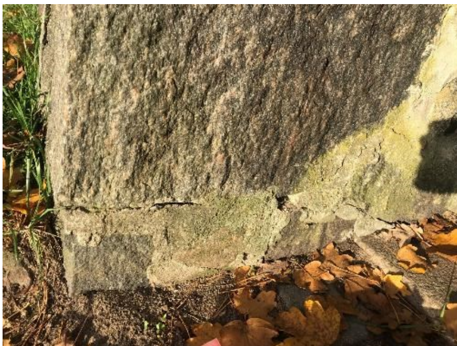
Fot. 54. Uszkodzenia partii przyziemnej muru kamiennego, lokalne naprawy zaprawą cementową oraz spękania i rozszczelnienia łączy kamieni powodujące wnikanie wody do wnętrza muru
