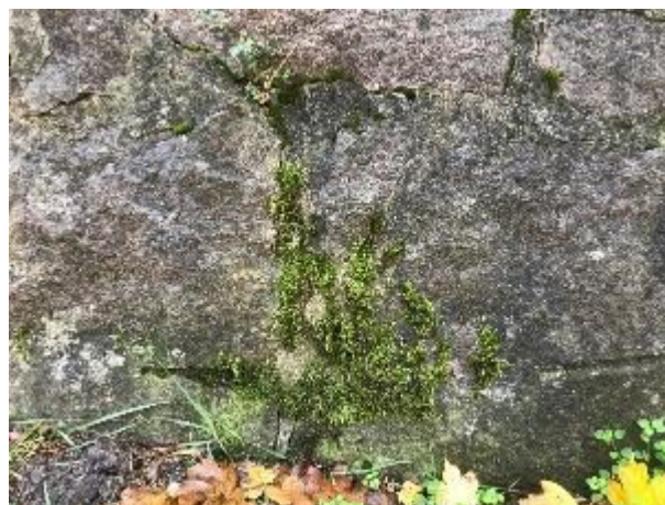
Fot. 52. Roślinność porastająca partie przyziemne kamiennego muru piramidy grobowej
