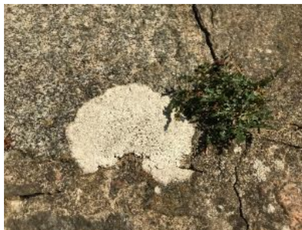
Fot. 31. Rośliny zakorzenione w szczelinie między kamieniami
