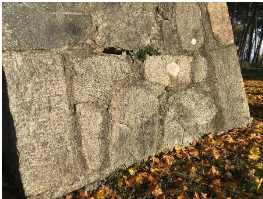
Fot. 32. Partie przyziemna muru piramidy, widoczne spękania i ubytki, będące miejscem gromadzenia się wody opadowej i podciągania wód gruntowych
