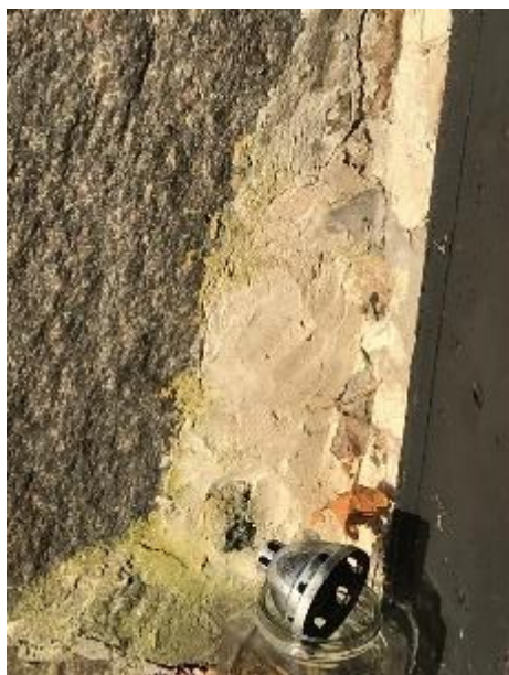
Fot. 34. Nieestetyczne doraźne naprawy mocowania drzwi na zmurowanym wejściu
