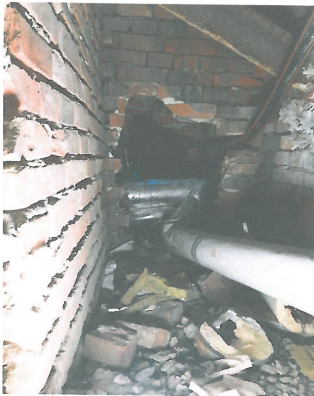
Fot. 6. Kanał murowany z przebiciem do studzienki murowanej. Zagruzowane dno tunelu.
