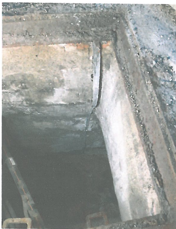
Fot. 7. Właz rewizyjny do studzienki żelbetowej w rozwidleniu: tunel / kanał. Zawilgocone dno tunelu.
