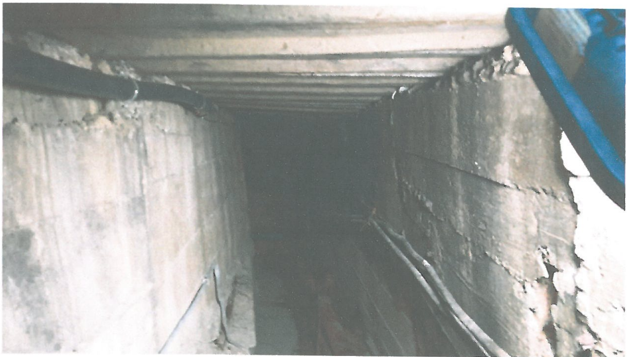
Fot. 9. Kanał żelbetowy - widok z wjazdu inspekcyjnego w kierunku świetlika z luxferów „D”. W głębi widoczne zacieki na ścianach kanału.
