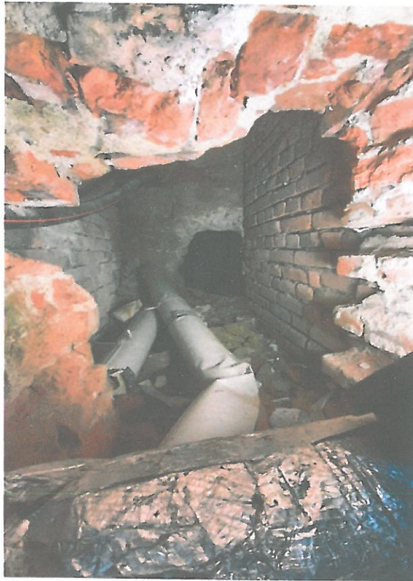
Fot. 8. Kanał murowany w kierunku studzienki żelbetowej. Zagruzowane dno tunelu.
