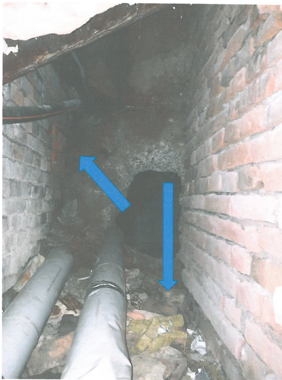
Fot. 5. Kanał murowany z przebiciem do studzienki żelbetowej.
