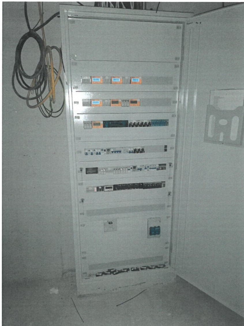
Widok głównej rozdzielni w pomieszczeniu piwnicy
