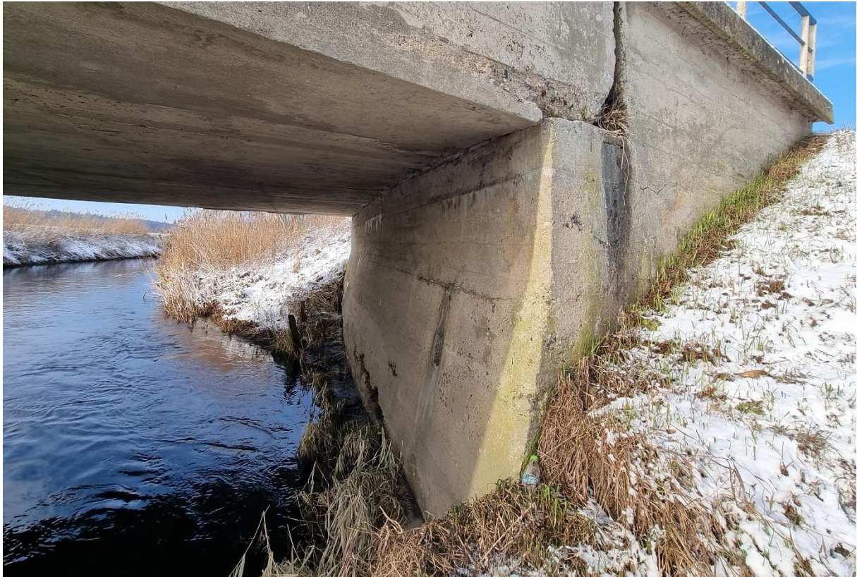
Fot. 10. Podmycie przyczółka od strony północnej, ubytki betonu ustroju nośnego na podparciu
