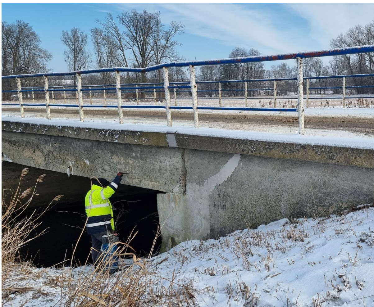
Fot. 23. Zaprawiona rysa wynikła z przeciążeń konstrukcji – zachodnia strona przyczółka północnego
