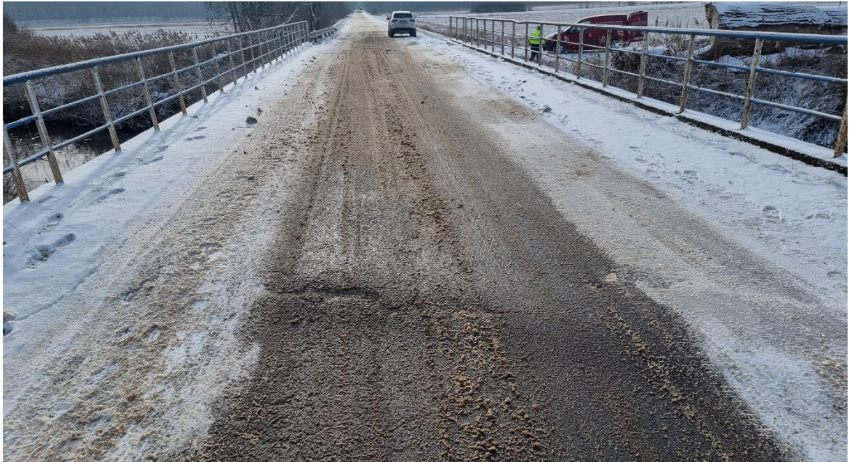
Fot. 4. Pęknięcie warstwy nawierzchni asfaltowej na styku ustroju nośnego i ścianki zapleczonej przyczółka od strony północnej
