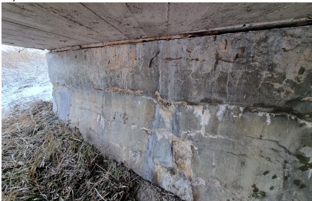
Fot. 16. Przyczółek od strony południowej – zarysowania otuliny i wycieki produktów korozji zbrojenia
