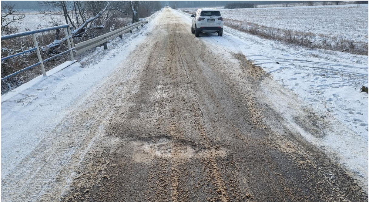
Fot. 6. Ubytek nawierzchni asfaltowej na dojeździe od strony południowej (widoczna warstwa z kostki kamiennej pod spodem)
