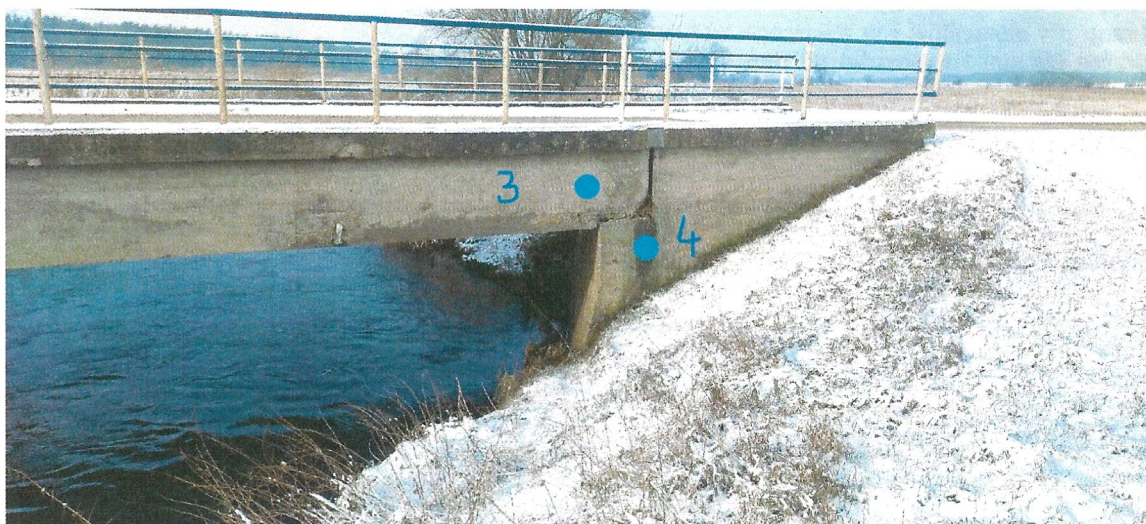
Rys. 2. Most strona wschodnia. Odwierty Nr 3 ustrój nośny strona wschodnia i odwiert Nr 4 przyczółek po stronie północnej. Odwiert Nr 3 pobrano 52 cm od powierzchni dolnej ustroju i 80 cm od końca płyty nośnej ustroju. Odwiert Nr 4 pobrano w odległości 63 cm od przedniej ściany przyczółka i 128 cm od góry.
