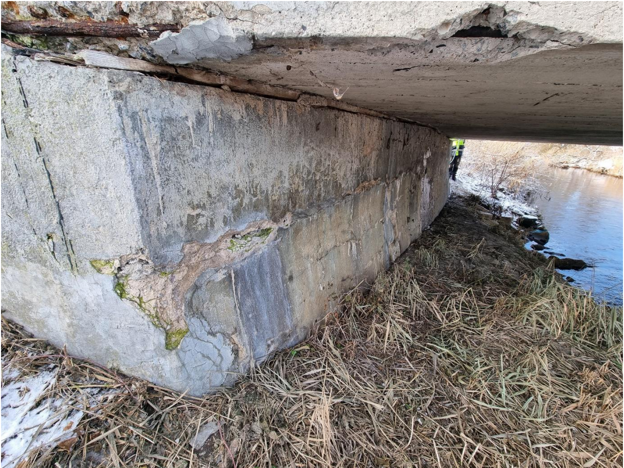
Fot. 8. Kolejne fazy procesu korozyjnej degradacji żelbetowego przyczółka – destrukcja betonowej otuliny ochronnej, ubytki betonu i odsłonięcie zbrojenia, inicjacja korozji prętów, wegetacja roślin przyspieszająca proces degradacji
