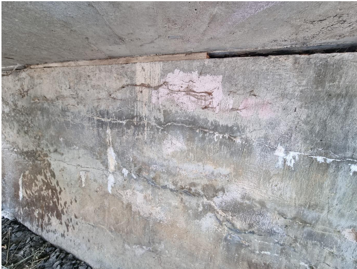
Fot. 20. Wymywanie rozpuszczalnych składników betonu – osady widoczne na powierzchni przyczółka od strony południowej
