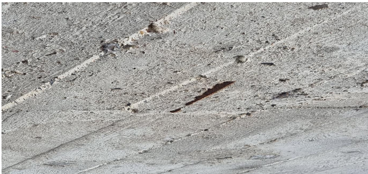
Fot. 12. Odspojenie otuliny i odsłonięcie prętów zbrojenia od spodu płyty nośnej
