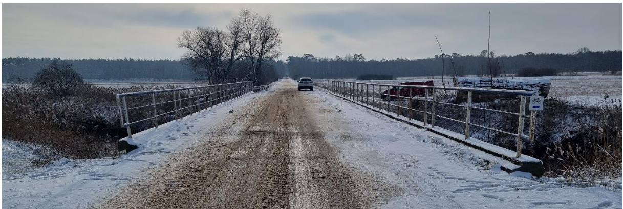
Fot. 5. Nierówność nawierzchni drogowej na styku ustroju nośnego i przyczółka od strony północnej
