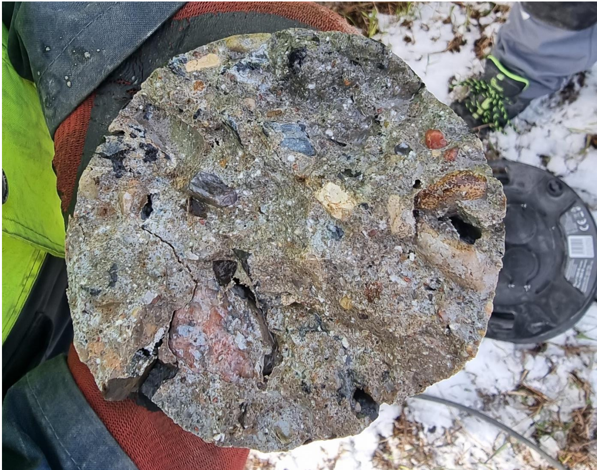
Fot. 27. Widoczne w pobranej próbce wewnętrzne spękania, raki i korozja betonu
