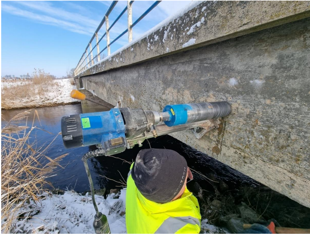
Fot. 25. Pobieranie próbki nr 2 – z ustroju nośnego, od strony dojazdu z miejscowości Przyrownica
