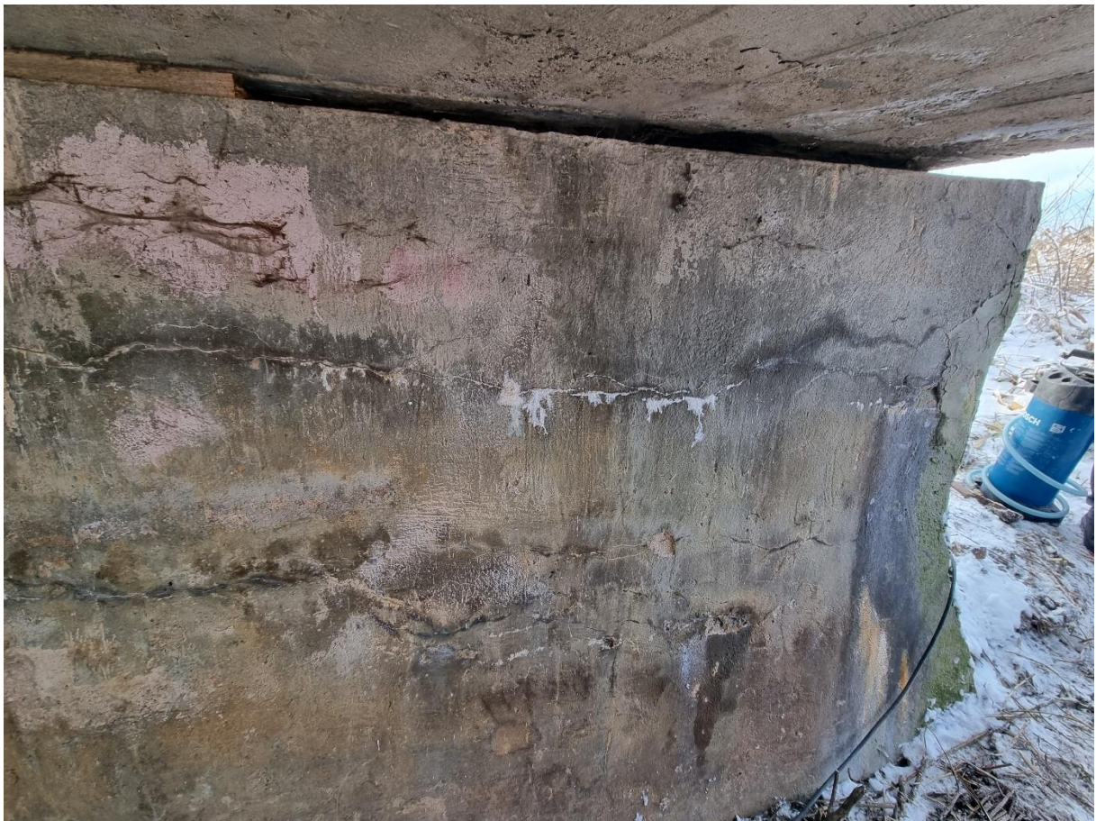
Fot. 7. Charakterystyczne skutki procesu korozyjnej degradacji przyczółka od strony miejscowości Przyrownica
