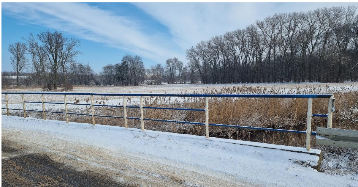
Fot. 3. Utrata ciągłości poręczy balustrad na dojeździe od strony południowej, po prawej stronie
