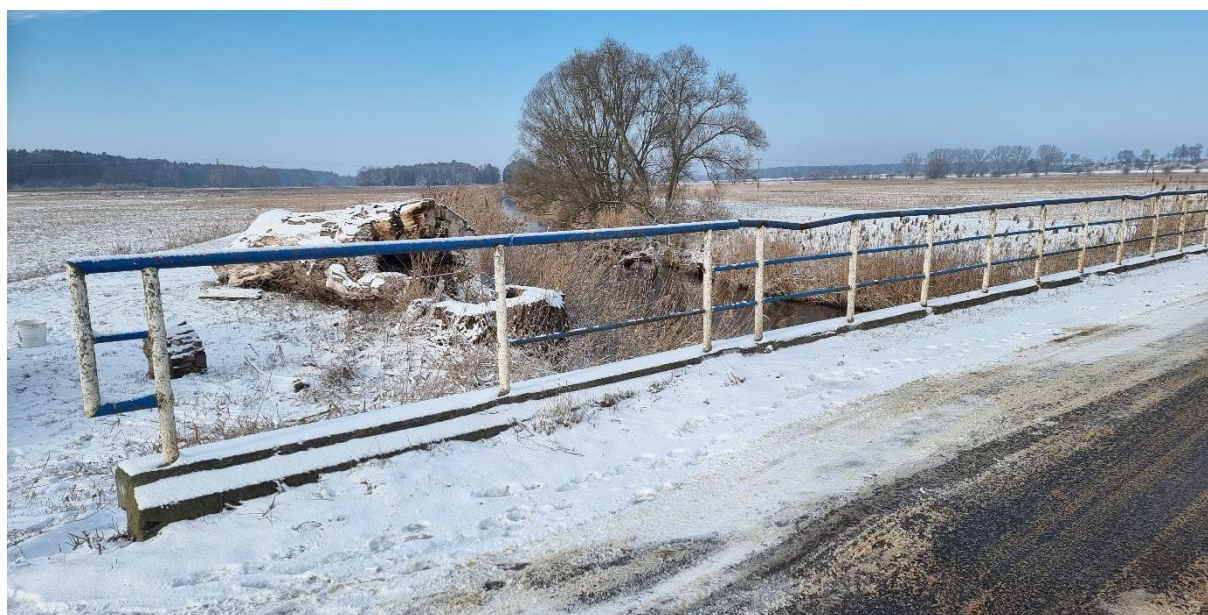
Fot. 1. Utrata ciągłości poręczy balustrad na dojeździe od strony południowej, po lewej stronie
