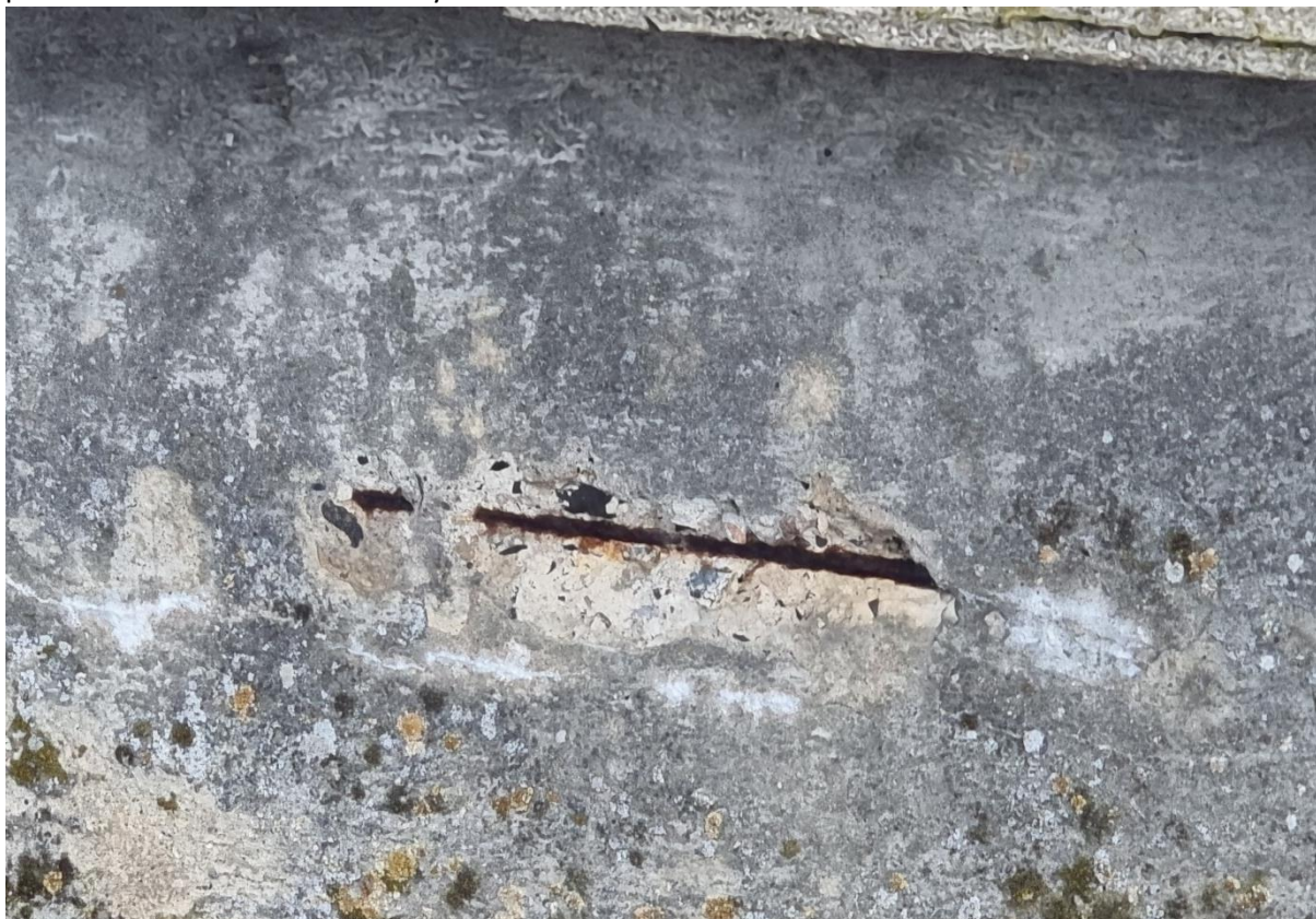
Fot. 17. Pęknięcie i odspojenie otuliny na bocznej powierzchni przęsła od strony południowej
