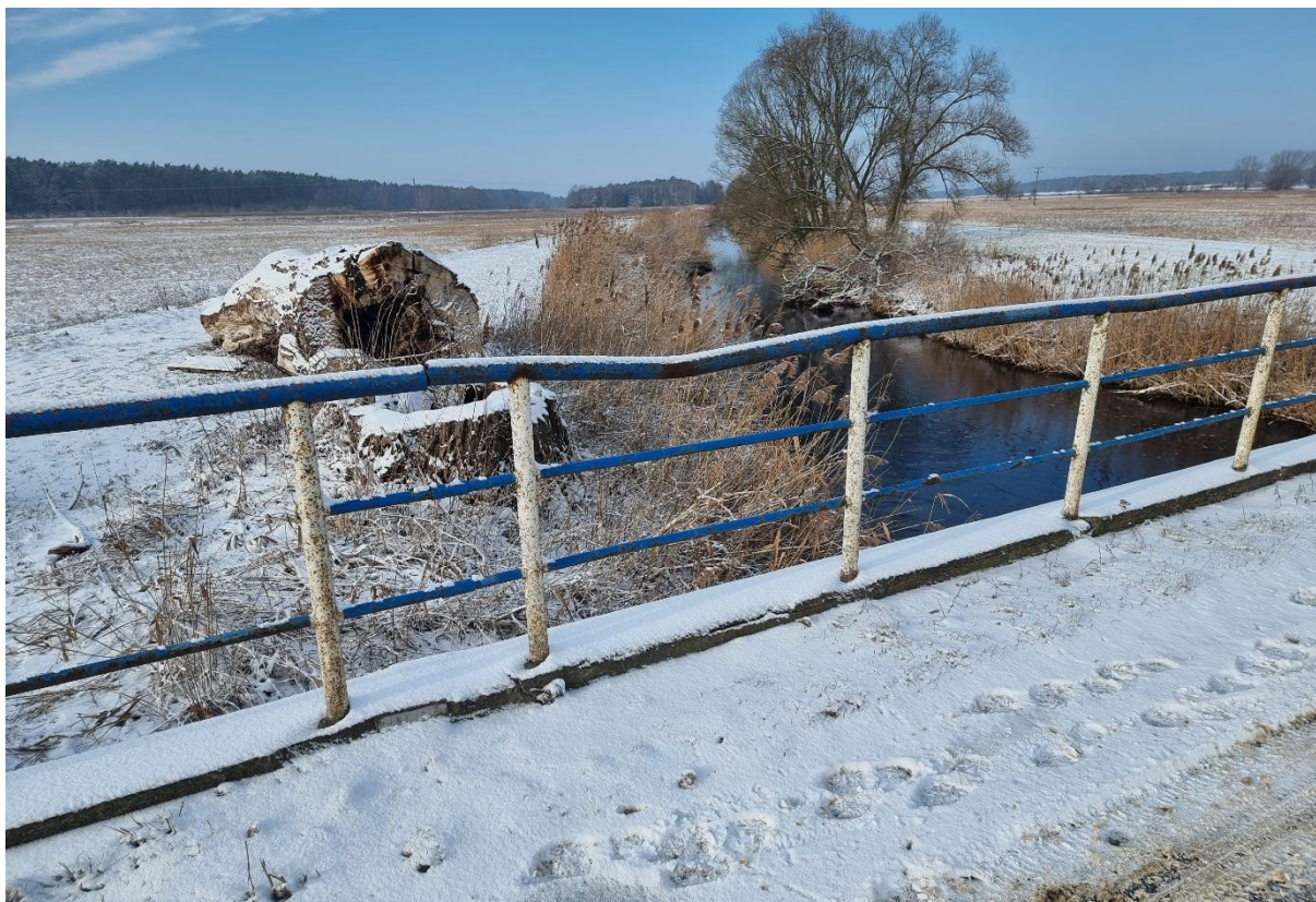
Fot. 2. Pocięty pochwył balustrady na dojeździe od strony południowej
