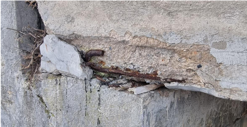
Fot. 18. Podparcie przęsła na przyczółku od strony południowej – odsłonięcie otuliny, odsłonięcie prętów zbrojenia i ubytek materiału prętów zbrojenia
