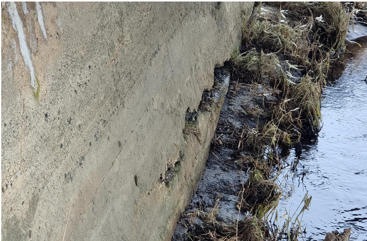
Fot. 11. Zbliżenie na podmycie przyczółka (widok od strony zachodniej)
