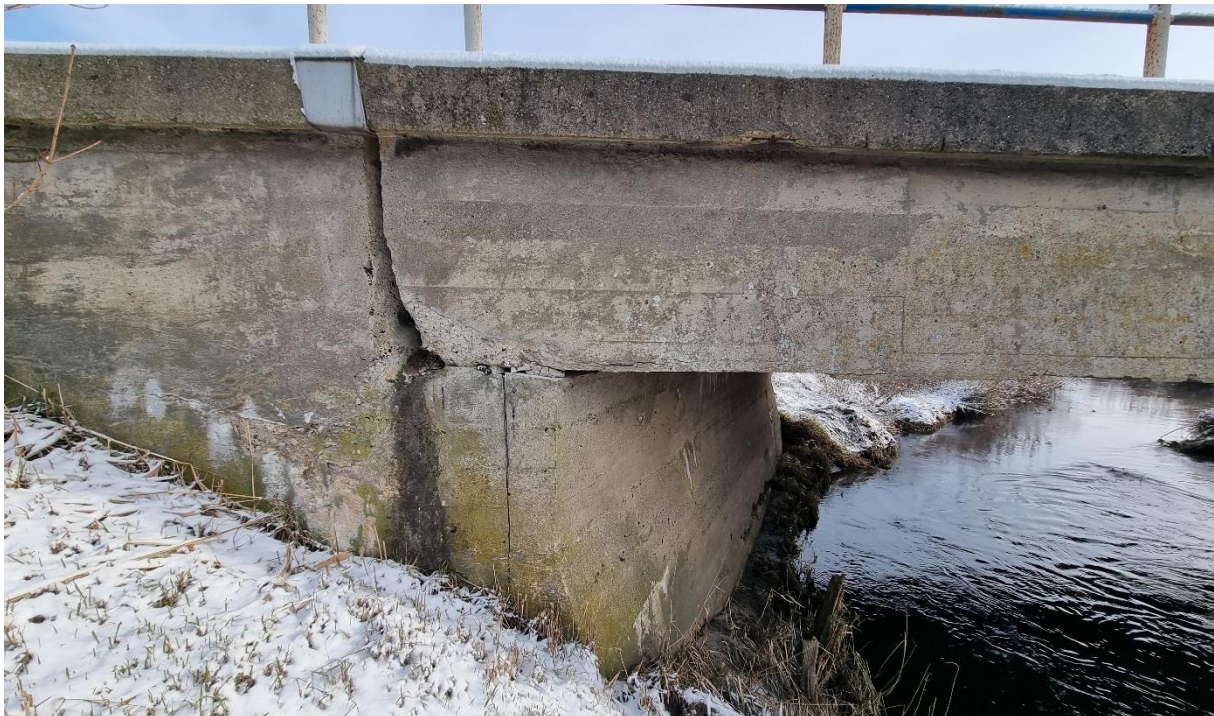
Fot. 19. Destrukcja i ubytek betonu spowodowane cyklicznym zamarzaniem i odmarzaniem wody w strefie styku pomostu z przyczółkiem od strony północnej
