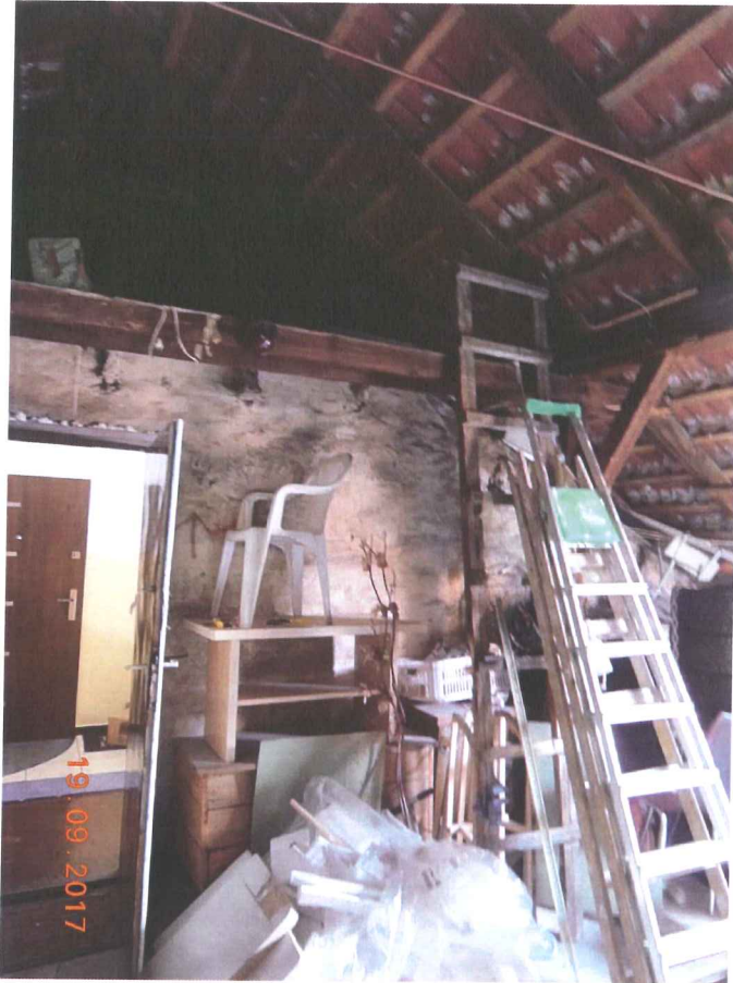
Fot. 12 Widok ściany klatki schodowej poddasza nr 26
