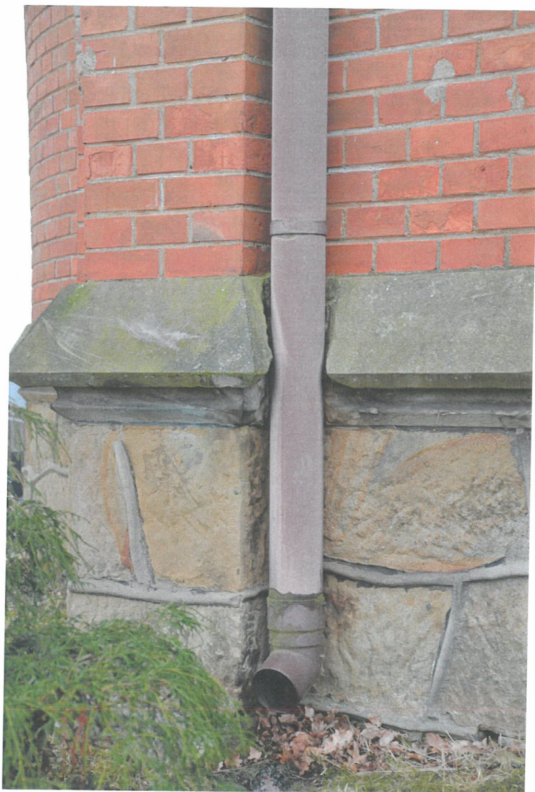
Fot. nr 24. Kaplica grobowa Rodziny Korczak. Widoczne na fotografii uszkodzenie kamiennego gzymsu w skutek wprowadzenia rynny spustowej. Fot. Mariusz Wrona
