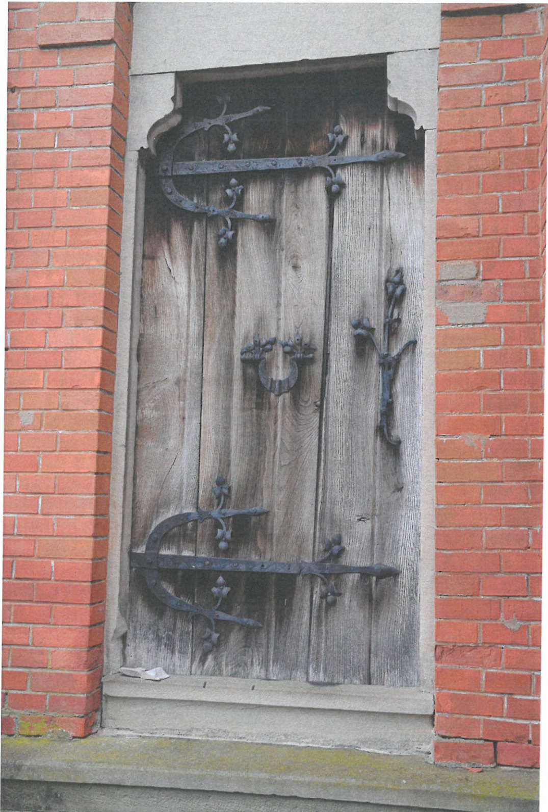
Fot. nr 12. Kaplica grobowa Rodziny Korczak. Widoczne na fotografii drzwi wejściowe do zasadniczej części kaplicy. Korozja elementów stalowych oraz elementów drewnianych. Fot. Mariusz Wrona
