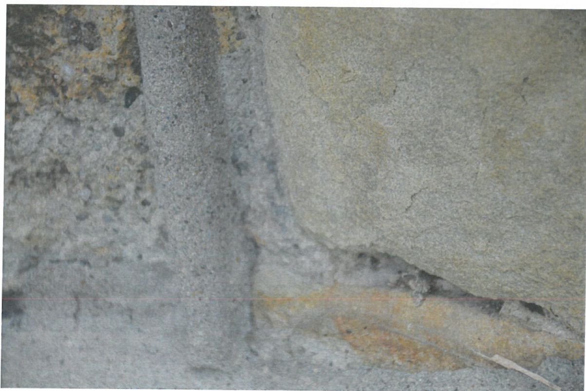
Fot. nr 22, 23. Kaplica grobowa Rodziny Korczak. Widoczne na fotografii dezintegracja i łuszczenie się warstw kamienia, betonowe, wypukłe spoinowanie kamienia.
