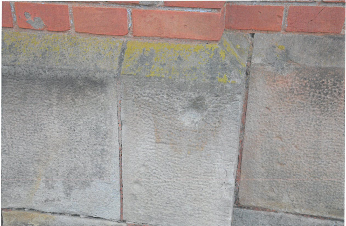
Fot. nr 9, 10. Kaplica grobowa Rodziny Korczak. Widoczne na fotografii nasyp ziemny przesłaniający cokółową część kaplicy, postrzelina na obszarze kamiennego cokołu. Fot. Mariusz Wrona
