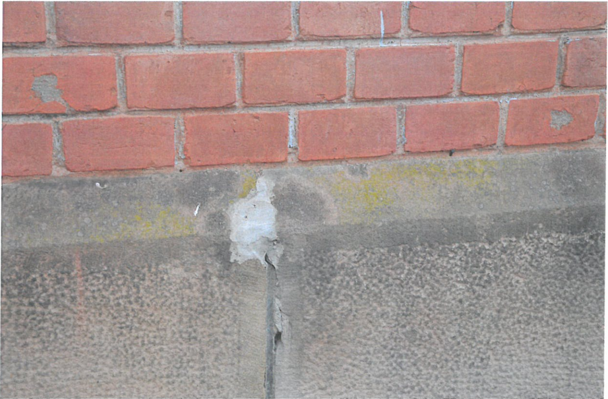
Fot. nr 11. Kaplica grobowa Rodziny Korczak. Widoczne na fotografii betonowe uzupełnienie ubytku kamienia na obszarze cokotu.
