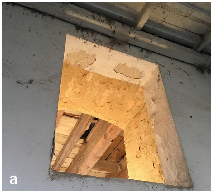
Fot. 34. Jak wyżej, otwory otwarte na przestrzeń nad krusztą
