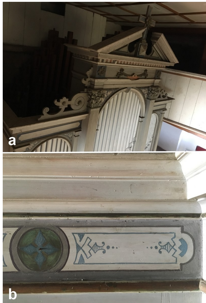
Fot. 31. a) Zwieńczenie organów z brakującym elementem drewnianym, wtórnie utrąconym b) Zachowana w dobrym stanie, bez przemalowań, dekoracja malarska zdobiąca organy
