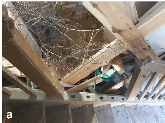
Fot. 35. a) Ślady po wykonanych jako ruchome elementach balustrady schodów, wejście do pomieszczenia nad krusztą b) Posadzka na przy schodach jak wyżej, na poziomie środkowej empyry
