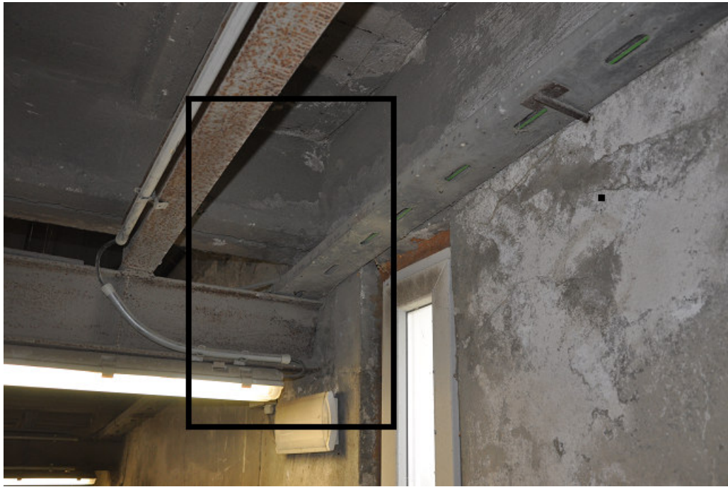
Fot.5 filarek przykienny z gazobetonu obciążony przez belki stropodachu i podkonstrukcji nadbudówki sterowni
