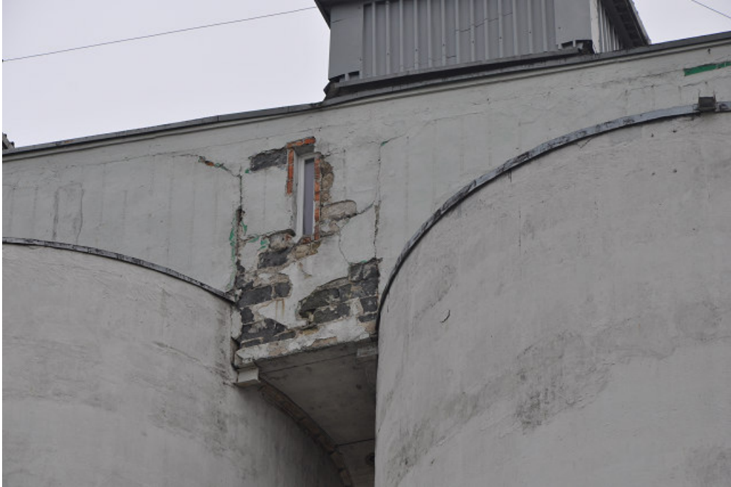
Fot.1 spękania ściany , zniszczenia tynku od strony zewnętrznej pomiędzy silosami 1i 2 (strona zachodnia)
