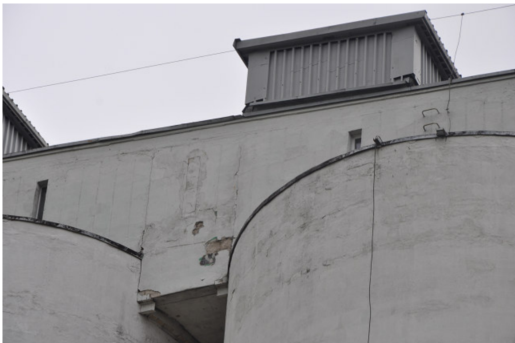
Fot.4 spękania ściany , zniszczenia tynku od strony zewnętrznej pomiędzy silosami 2 i 3 (strona zachodnia)
