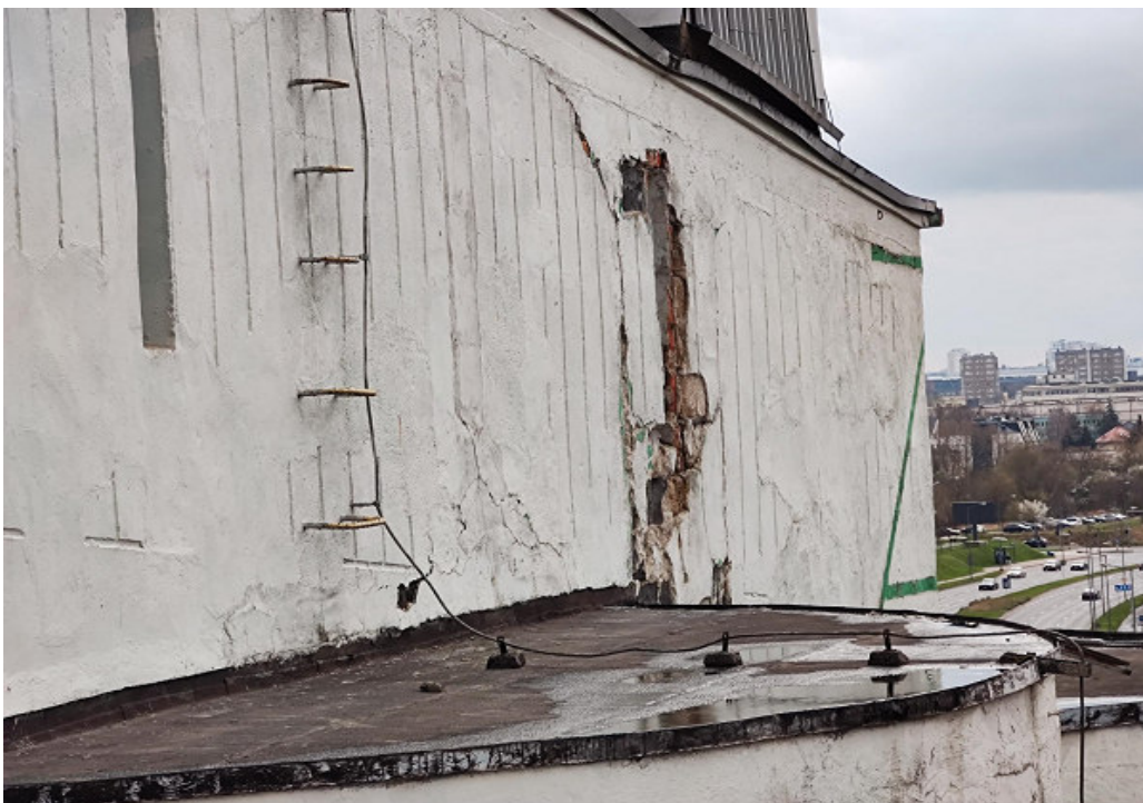
Fot.2 spękania ściany , zniszczenia tynku od strony zewnętrznej pomiędzy silosami 1i 2 (strona zachodnia)
