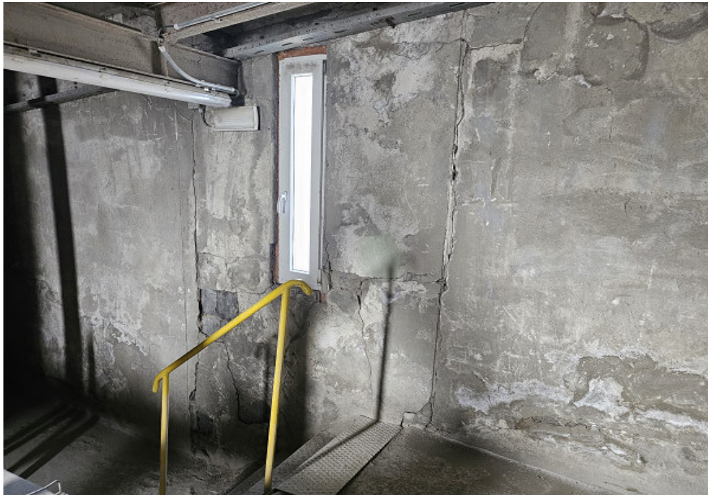
Fot.3 spękania ściany , zniszczenia tynku od strony wewnętrznej pomiędzy silosami 1i 2 (strona zachodnia)
