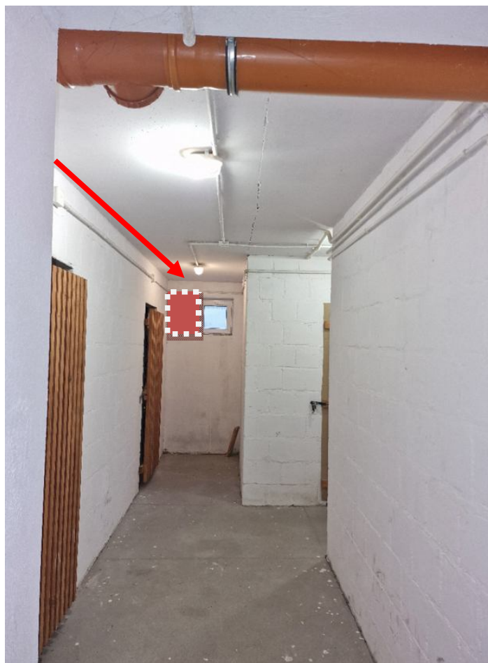
Zdjęcie. Trasa kablowa instalacji PV po stronie AC w budynku Wilanowska 2. Miejsce montażu RPV AC na zewnątrz budynku.
