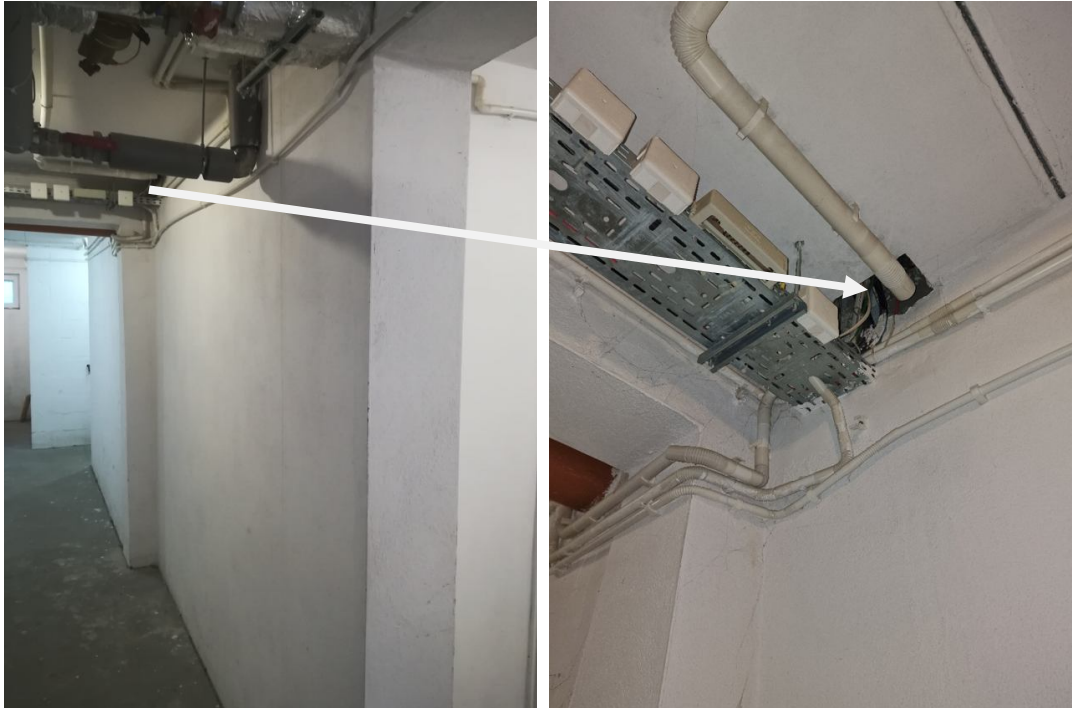
Zdjęcie. Okablowanie DC -Wejście do pomieszczenia technicznego.
