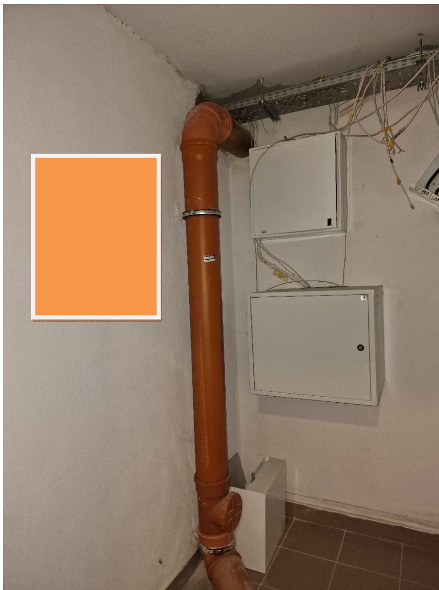
Zdjęcie. Miejsce montażu falownika. Pomieszczenie techniczne nr 013.
