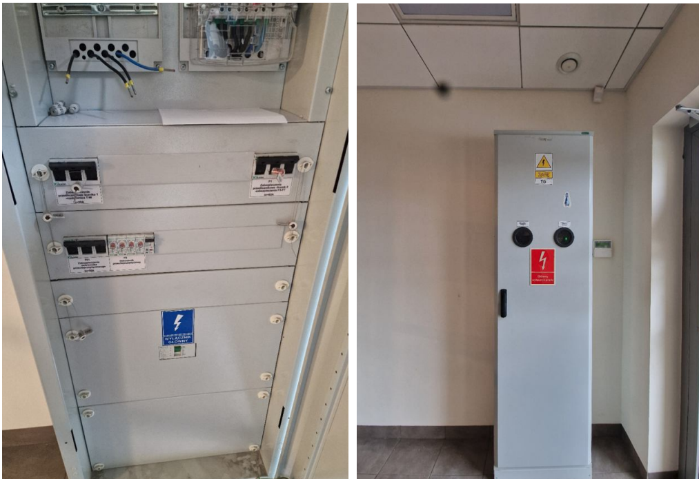
Zdjęcie. Widok miejsca wpięcia instalacji PV po stronie AC w budynku Wilanowska 2A
