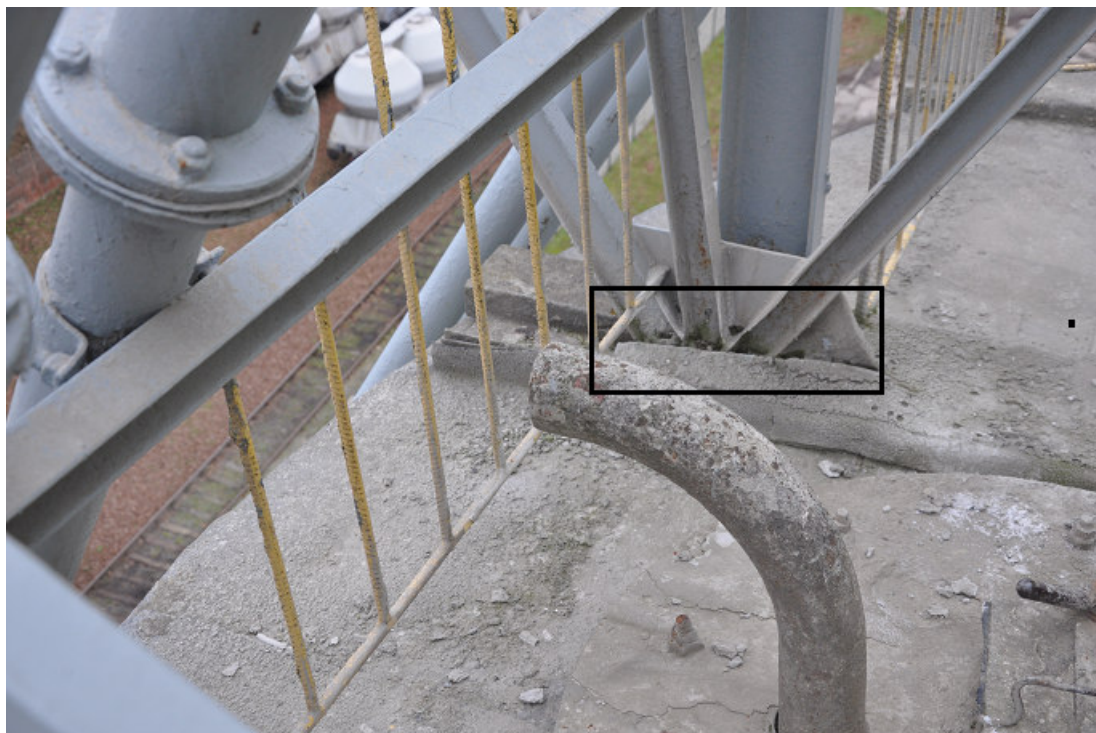
Fot.3 skorodowany obszar węzła nr2
