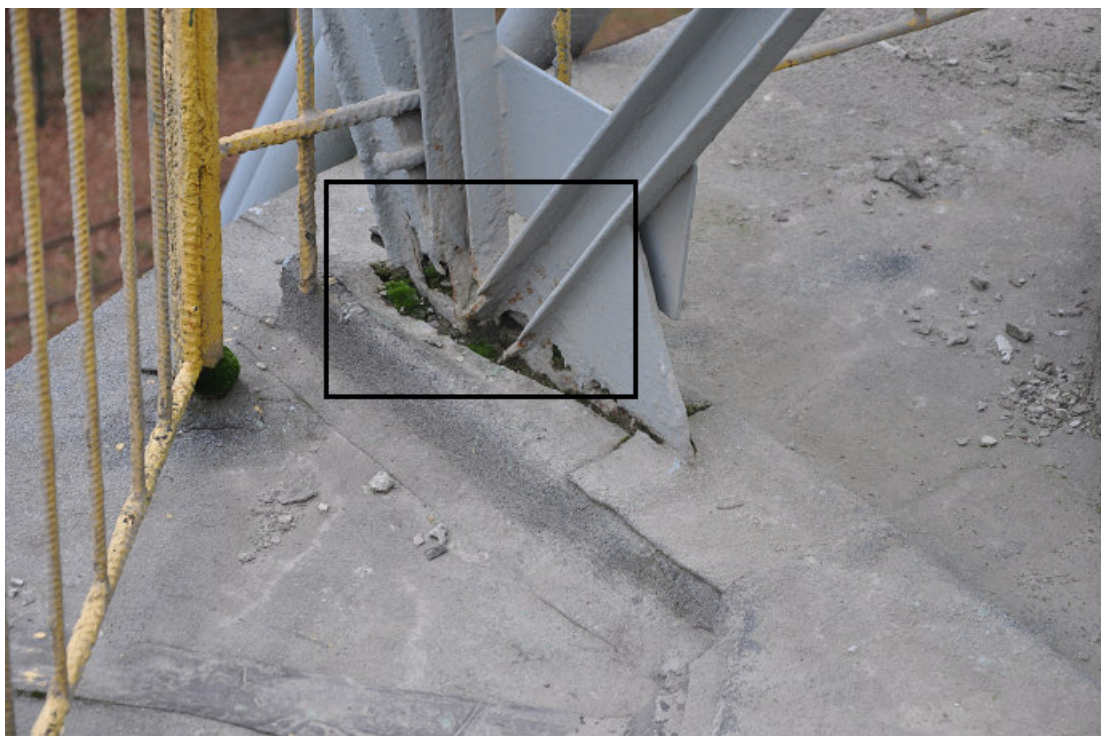
Fot.2 skorodowany obszar węzła nr1
