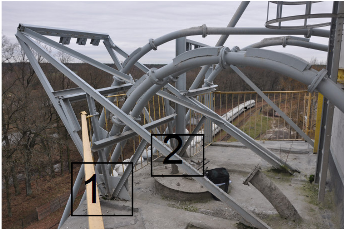
Fot.1 skorodowane węzły podporowe
