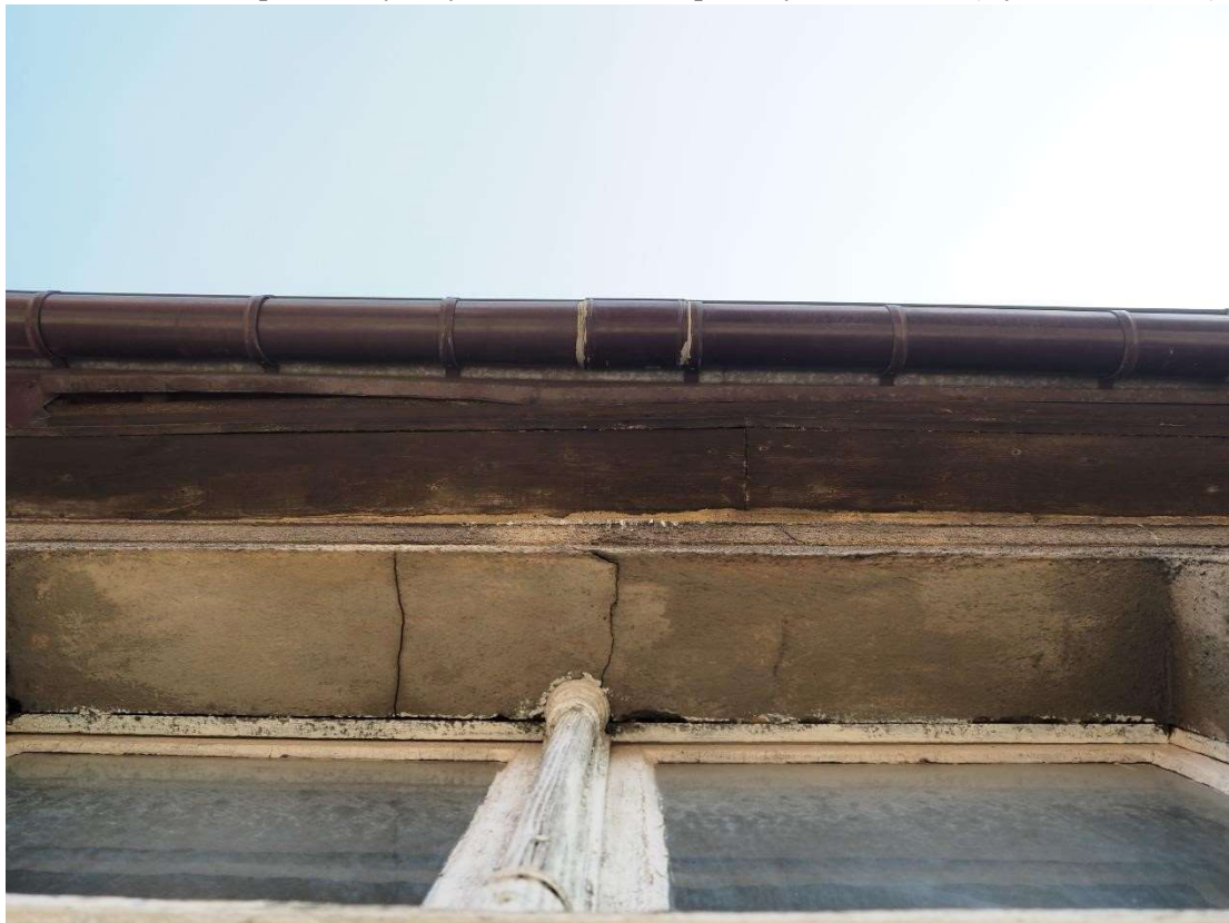
Fot. 8. Gorzów Wlkp. ul. Drzymały 28, fasada, drewniana podbudówka dachu, pęknięcia i fragment oryginalnej stolarki okiennej (wyk. P. Antoniuk).
