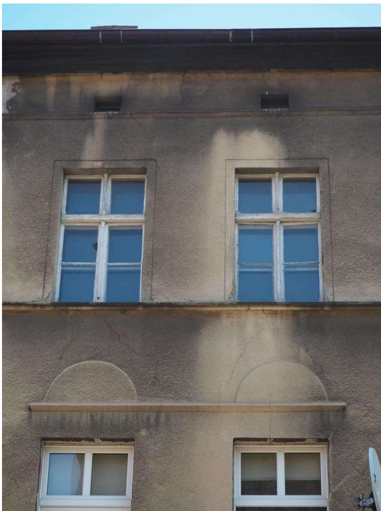
Fot. 9. Gorzów Wlkp. ul. Drzymały 28, fasada, połączone naczółki i półkoliste obrysy nad nimi, pęknięcia ściany (wyk. P. Antoniuk).
