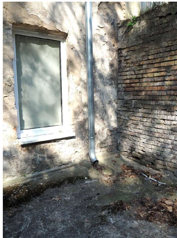
Fot. 24. Gorzów Wlkp. ul. Drzymały 28, elewacja od podwórza, rura z odprowadzeniem wody na podwórze (wyk. P. Antoniuk).
