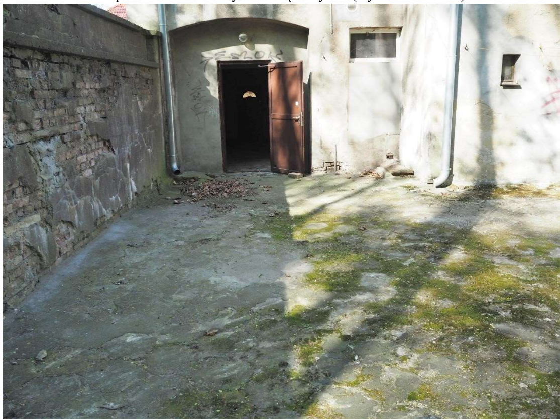
Fot. 28. Gorzów Wlkp. ul. Drzymały 28, elewacja od podwórza, brak odprowadzenia wody, zmieniona wielkość okna na parterze, współczesne drzwi (wyk. P. Antoniuk).
