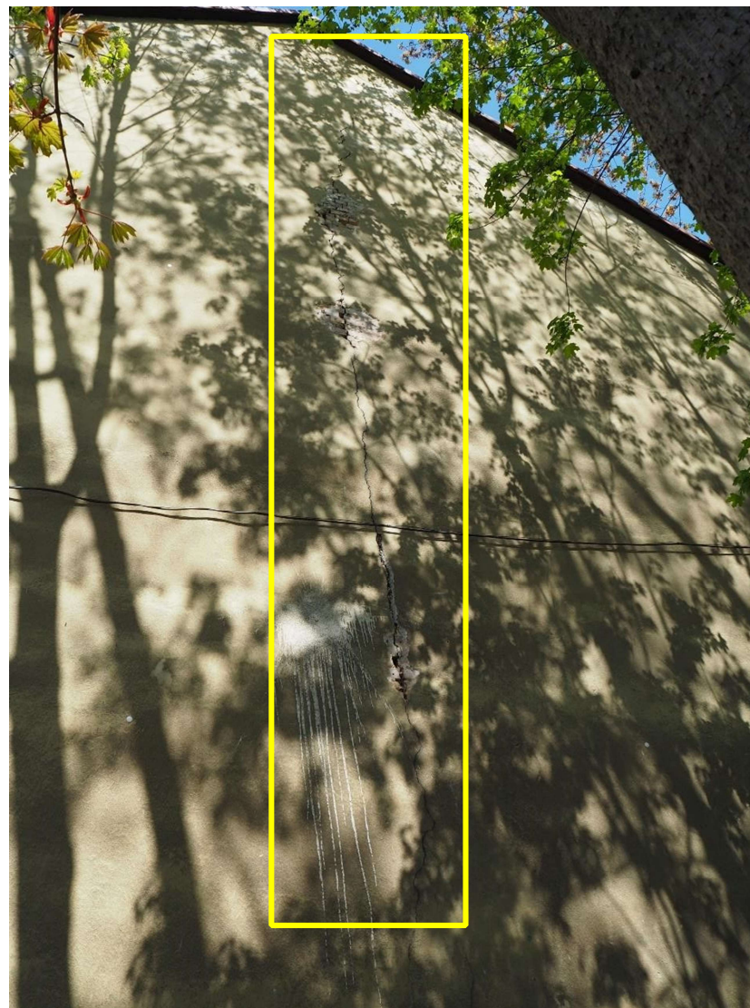
Fot. 20. Gorzów Wlkp. ul. Drzymały 28, ściana szczytowa, pęknięcie (wyk. P. Antoniuk).
