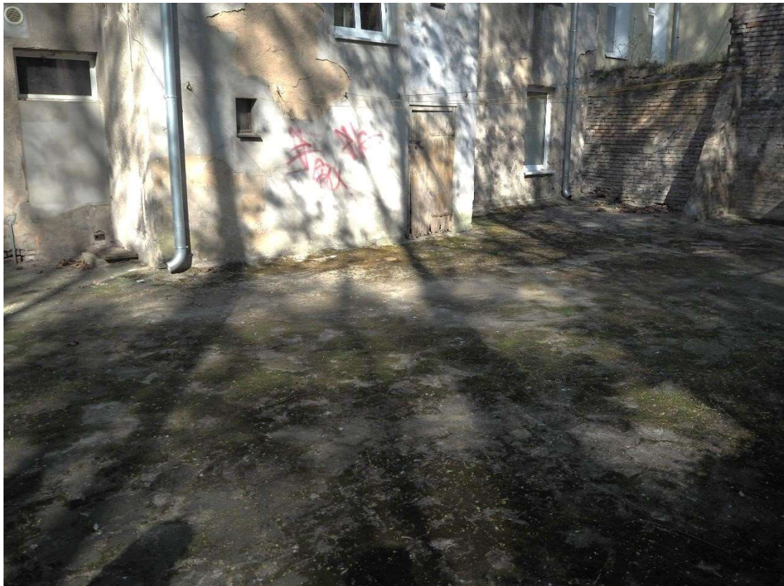
Fot. 27. Gorzów Wlkp. ul. Drzymały 28, elewacja od podwórza, wybetonowany dziedziniec, rura z odprowadzeniem wody w stronę budynku (wyk. P. Antoniuk).
