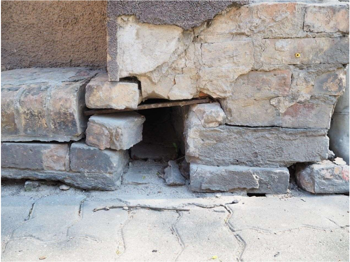
Fot. 13. Gorzów Wlkp. ul. Drzymały 28, fasada, otwór kanału wodnego (wyk. P. Antoniuk).
