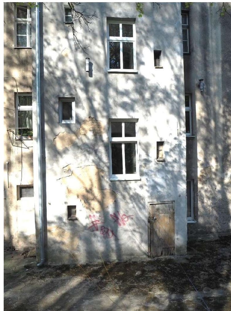
Fot. 22. Gorzów Wlkp. ul. Drzymały 28, elewacja od podwórza, część centralna, łuszcząca się farba i tynki, różne wielkości otworów okiennych (wyk. P. Antoniuk).
