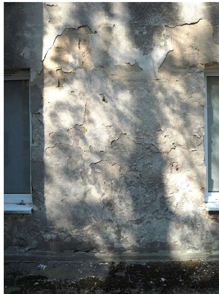
Fot. 26. Gorzów Wlkp. ul. Drzymały 28, elewacja od podwórza, stan tynków na prawej części elewacji (wyk. P. Antoniuk).
