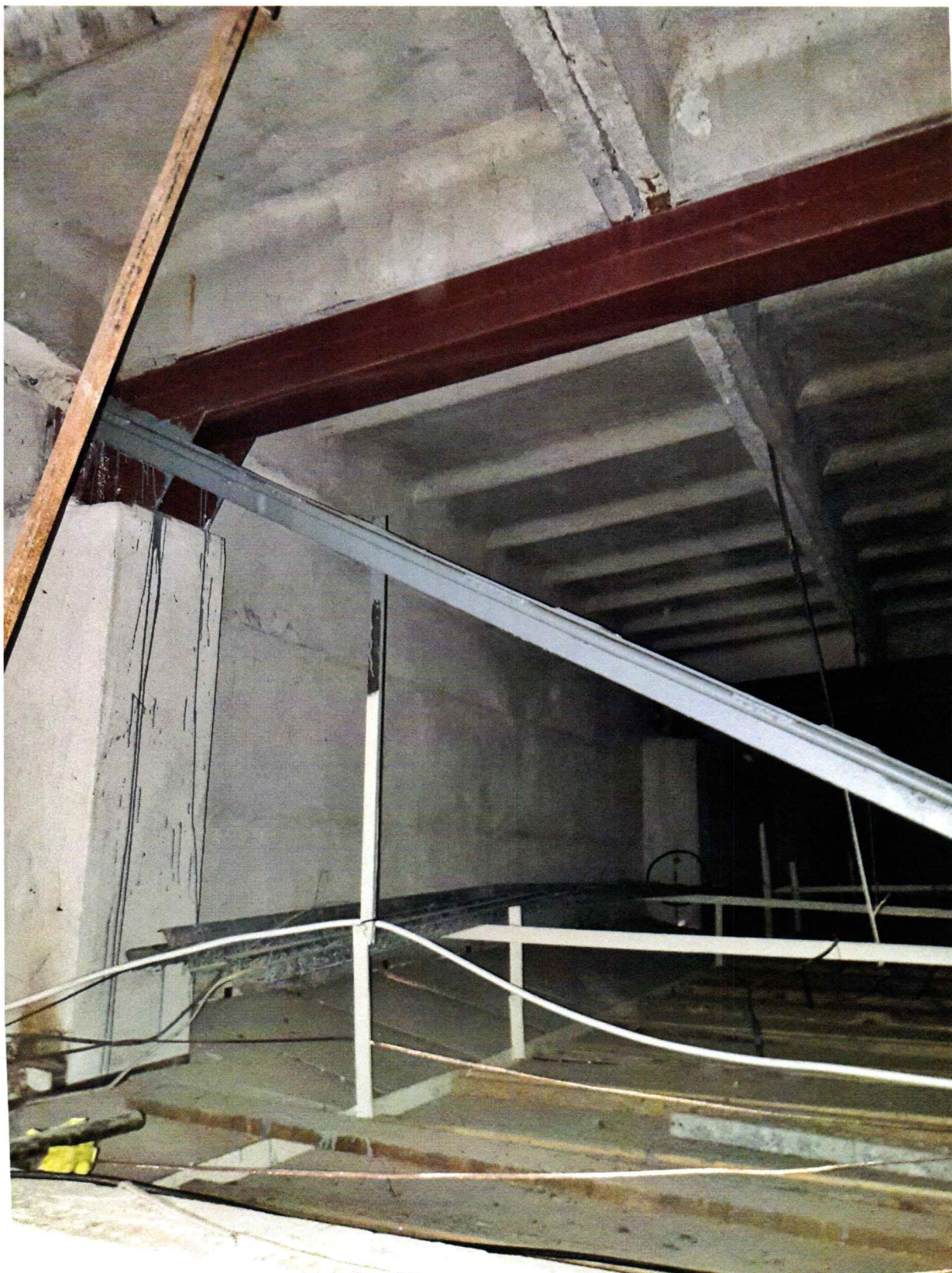
Fot. 7 – Fragment strychu przy podporze dźwigarów - widoczne słupy żelbetowe, ściana osłonowa murowana z lekkimi poziomymi rysami nad słupami, stelaż sufitu podwieszono, charakterystyczne podniesiony przy nadprożach okiennych sufit podwieszony wzmocniony od góry deskami z litego drewna, wyżej pas górny dźwigara z 2 C 200 zespalanych w rurę oraz wyraźnie widoczne przekrycie ułożone na pasach górnych z prefabrykowanych płyt panwiowych o wymiarach 149x597x30 cm.
