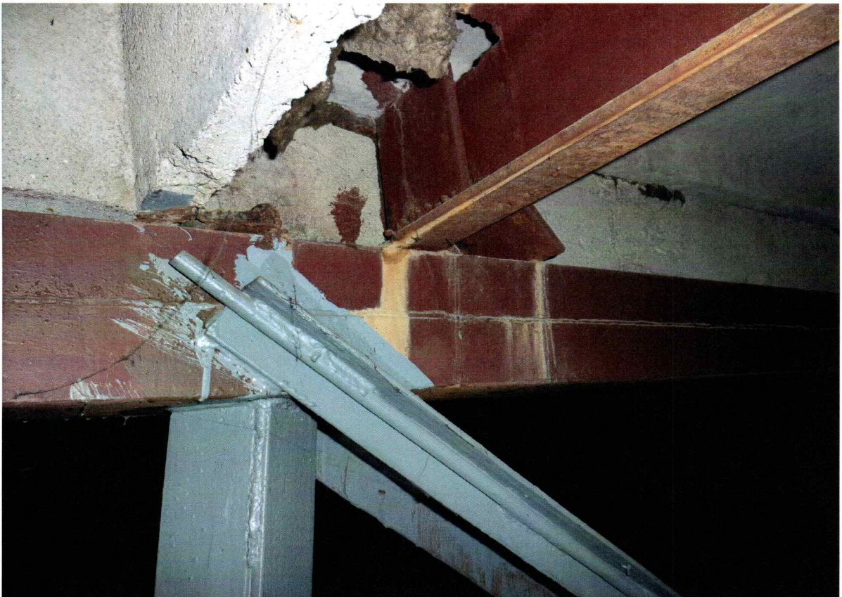
Fot. 9 – Węzeł – detal połączenia wzmocnianych elementów z pasem górnym z 2x C 200
