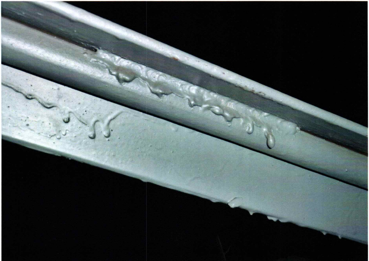
Fot. 6 – Krzyżulec z 2 x L80x80x6 wzmocnianych prętami Ø24 – prawdopodobnie podczas montażu lub później ze względu na niedbale wykonane spoiny
