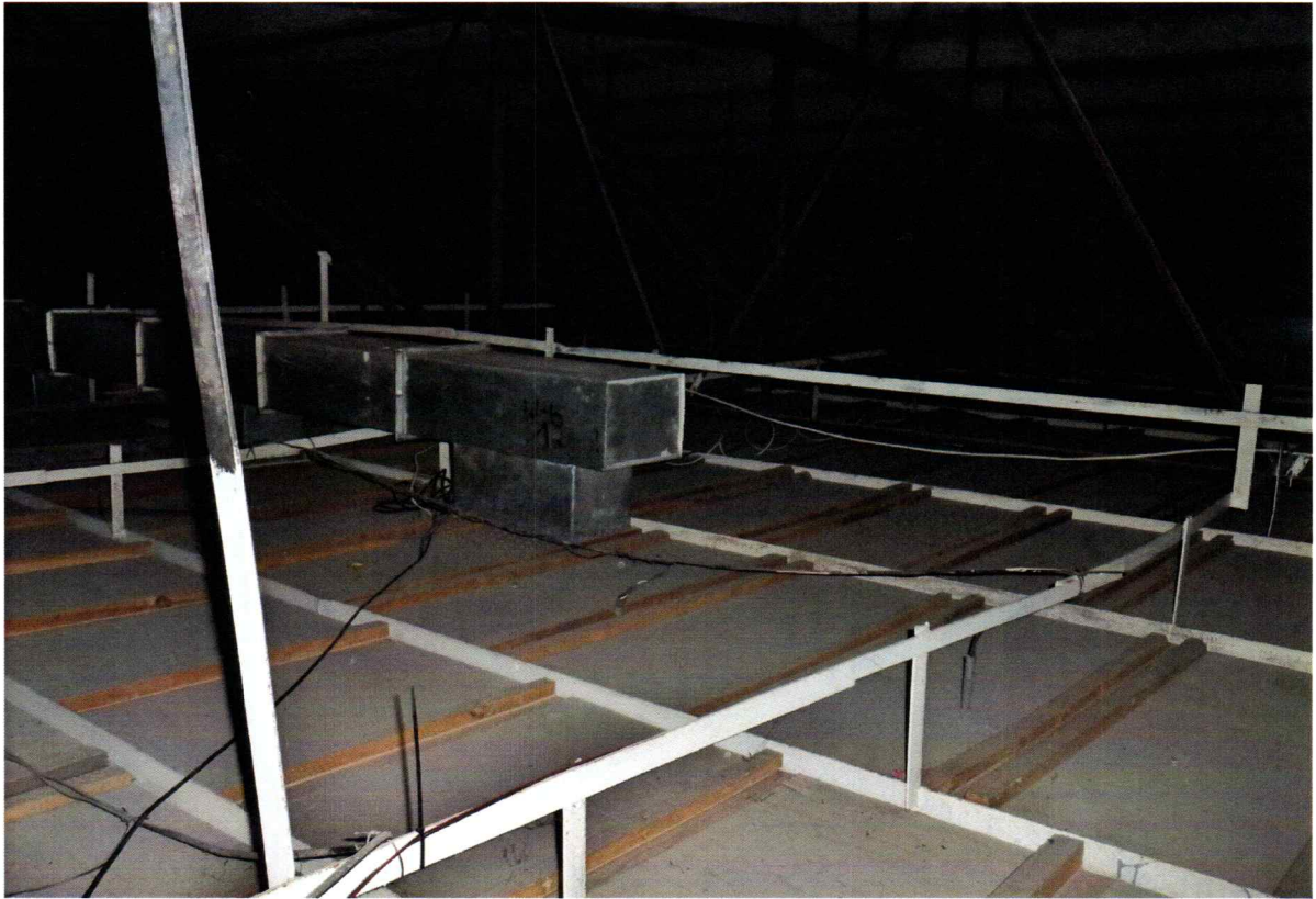
Fot. 12, 13 i 14 – Fragmenty dźwigara przy stężeniu pionowym w kształcie litery „W” oraz w kalenicy – widoczne stelaż stalowy sufitu podwieszonego i wypełnienie z płyt wiórowych, a także instalacja wentylacyjna
