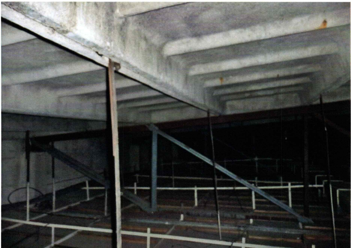
Fot. 11 – Większy fragment dźwigara do strony podpory – widoczne stelaż stalowy sufitu podwieszanego oraz przekrycie z prefabrykowanych płyt panwiowych
