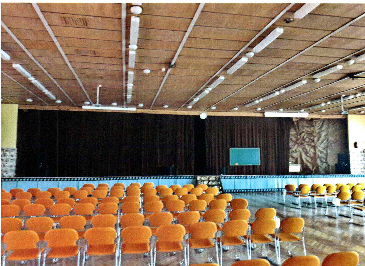
Fot. 2 – Widok ogólny sceny auli – widoczne instalacje elektryczna i wentylacyjna oraz sufit podwieszony z płyt wiórowych z naturalną okleiną na stelażu stalowym z T80
