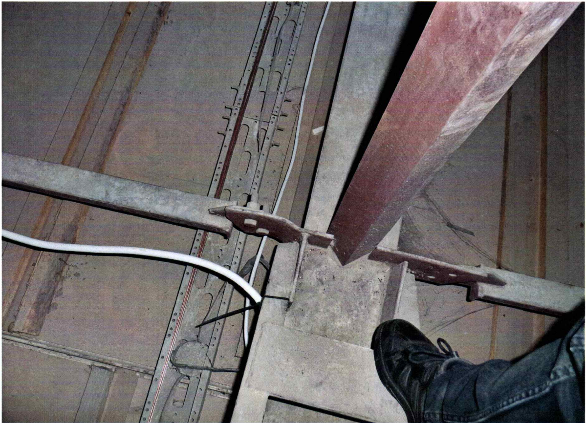
Fot. 18 – Połączenie stężenia pionowego z pasem dolnym na śruby, w wyniku niedokładnego wykonania lub montażu blachy węzłowe z prawej nie skrzycono, ale zespawano na montażu
