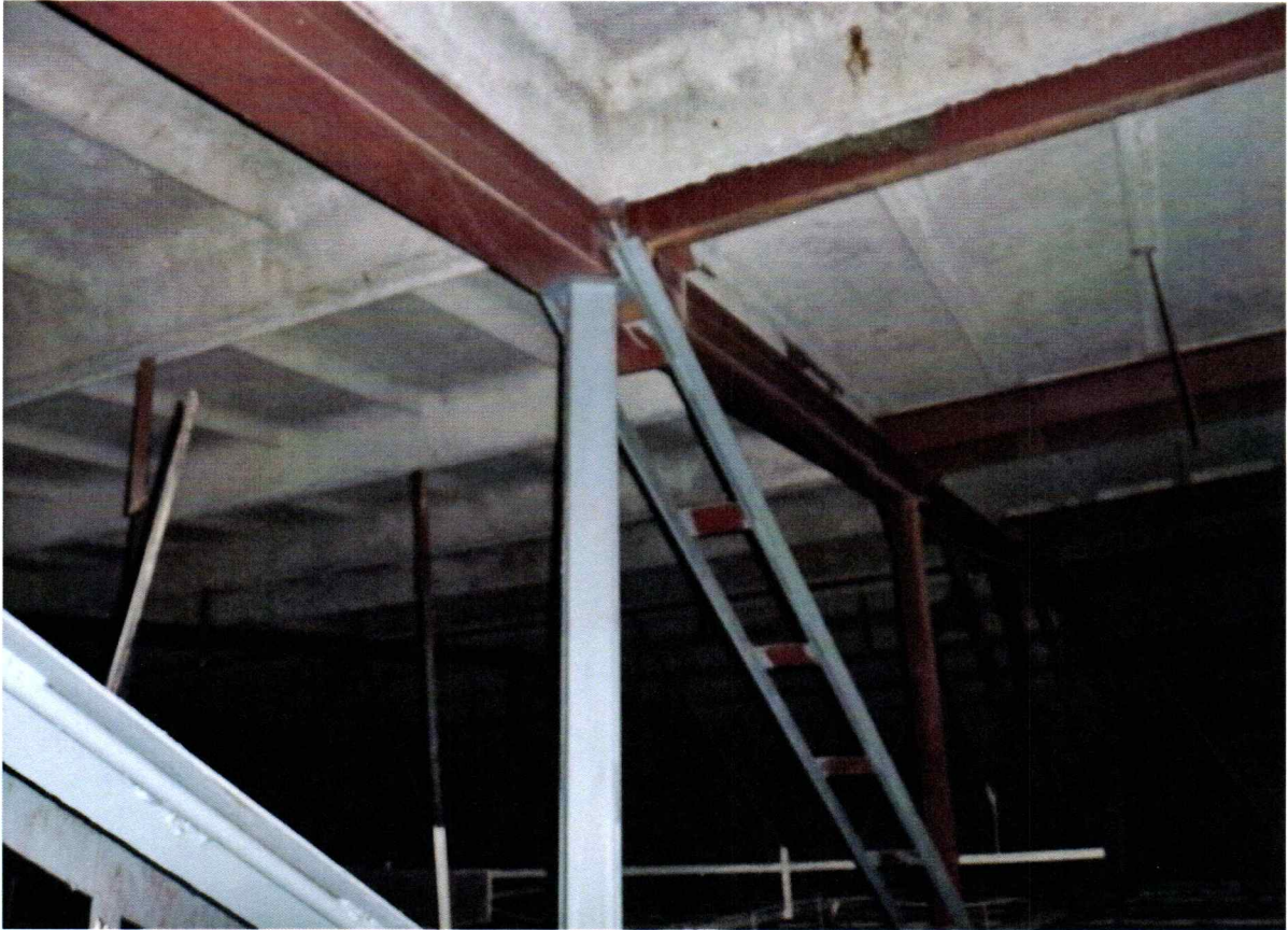
Fot. 8 – Fragment dźwigara – widoczny słupek środkowy z 2 L100x100x10 i kolejny krzyżulec z 2 x L50x50x6 + \varnothing 16 – prawdopodobnie obydwie elementy wzmocnione podczas montażu lub w czasie eksploatacji
