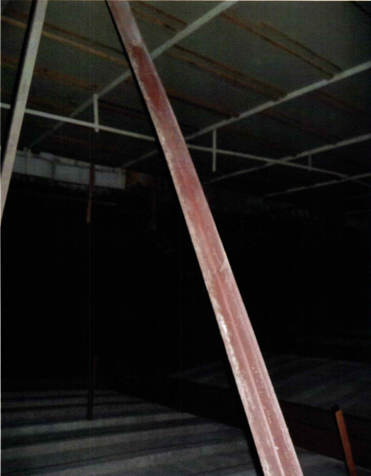
Fot. 22 – Krzyżulec stężenia pionowego z L 40x40x5 – widoczne wyraźne wyboczenie kształownika powstałe prawdopodobnie przy j próbie skręcenia stężenia z blachą wężową pasa dolnego – efekt nieudanej próby na Fot 18
