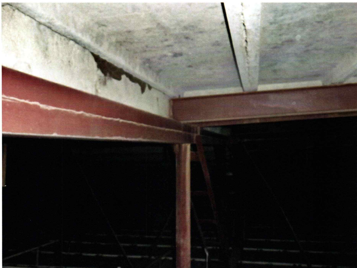
Fot. 15, 16 i 17 – Fragmenty dachu w przęśle nad sceną – widoczna inna konstrukcja przekrycia płyty panwiowe zastąpione w tym przęśle są płatwiami stalowymi z dwuteowników I 220 i płytami korytkowymi 60x300x10 – przyczyny zamiany konstrukcji nie są znane
