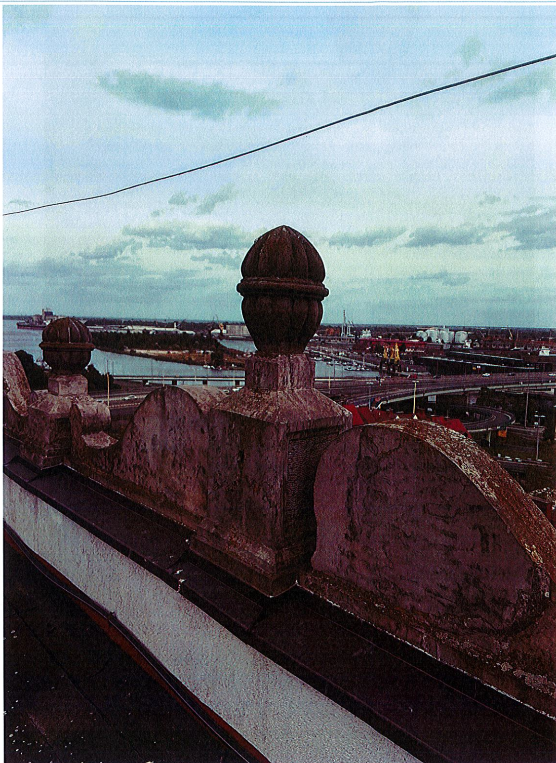
Fot. 1. Fragment kamiennej attyki wieńczącej skrzydło wschodnie – widoczne nawarstwienia mikrobiologiczne, silne zanieczyszczenia powierzchniowe oraz wtórne materiały zastosowane w pracach remontowych przy obiekcie
