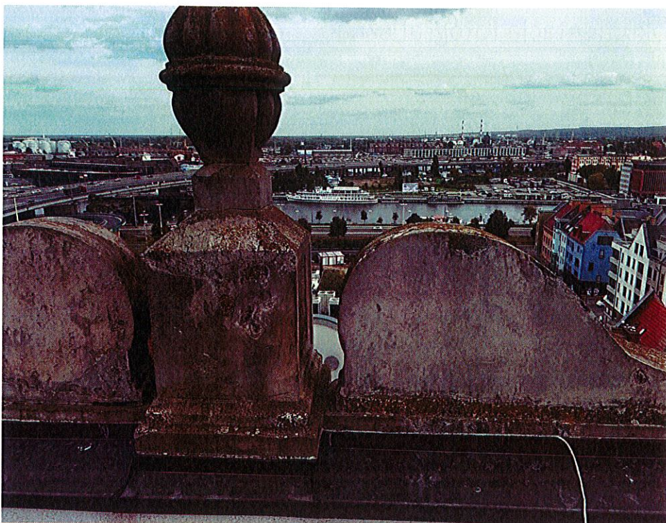
Rys. 2. Fragment kamiennej attyki wieńczącej skrzydło wschodnie – widoczne nawarstwienia mikrobiologiczne, silne zanieczyszczenia powierzchniowe, a także zniszczenia warstw powierzchniowych i ubytki kamienia
