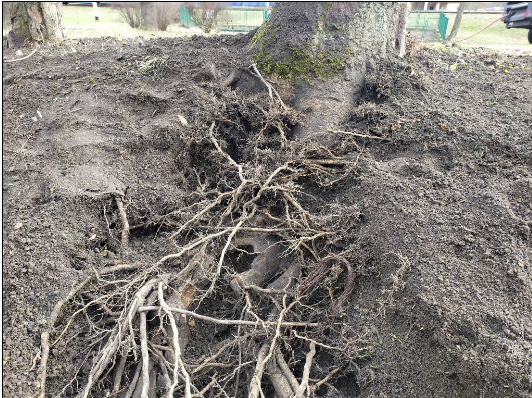
Fot. 3. Drzewo o nr inw. 16: odkryta część systemu korzeniowego od strony torowiska. Widoczny wypróchniały korzeń
