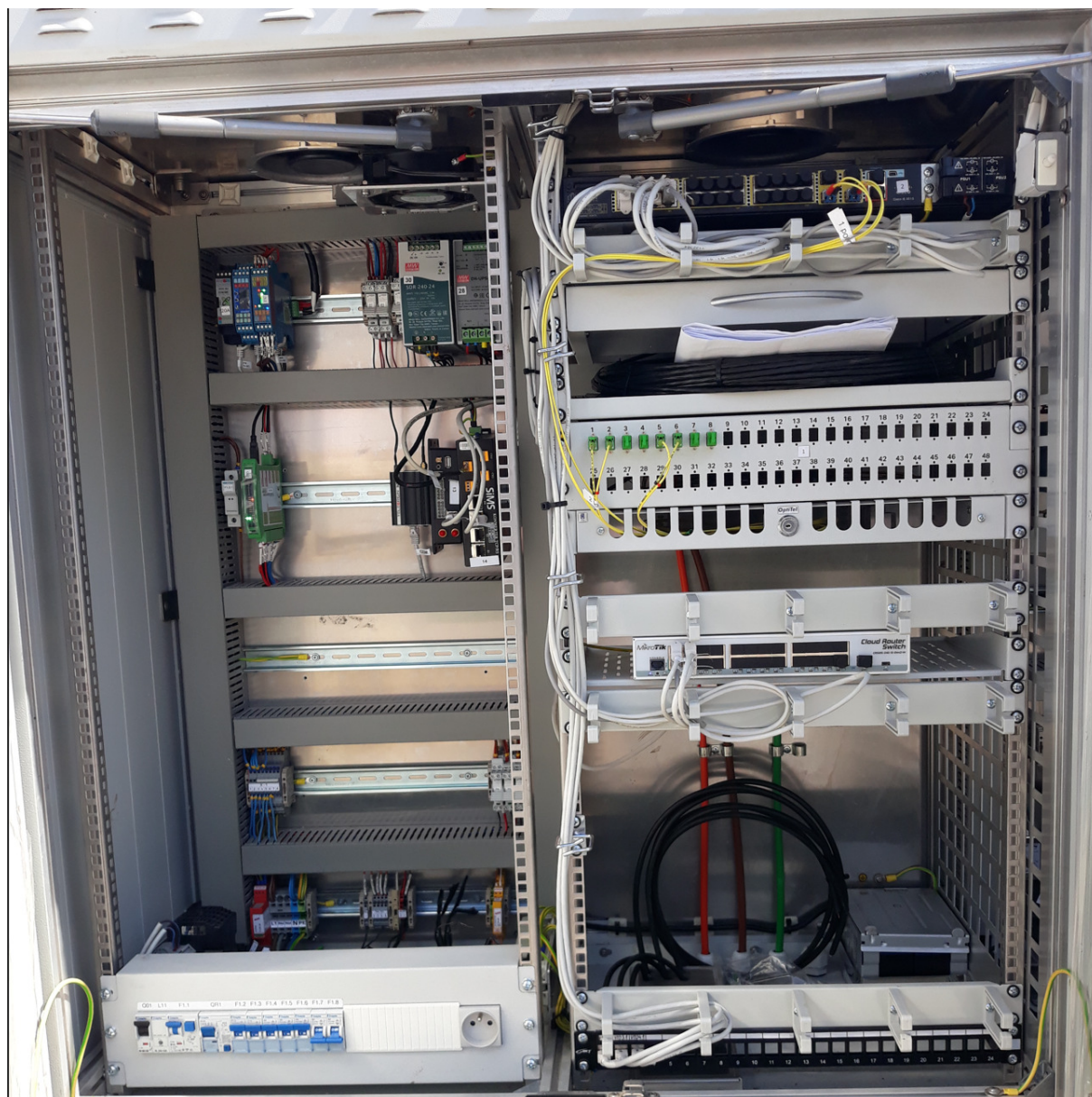
Istniejące wyposażenie szafy ITS 1294
