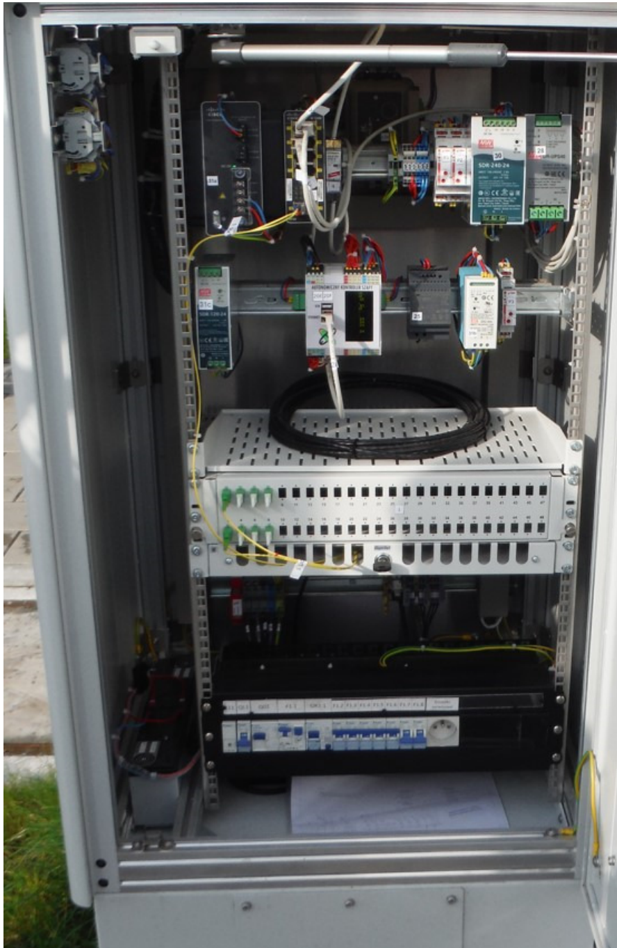
Istniejące wyposażenie szafy ITS I243.1
