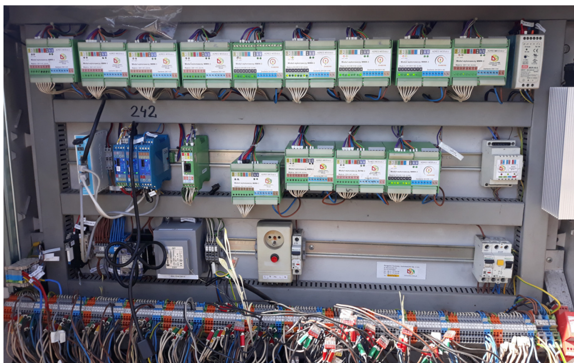
Istniejące wyposażenie szafy sterownika sygnalizacji ST242
