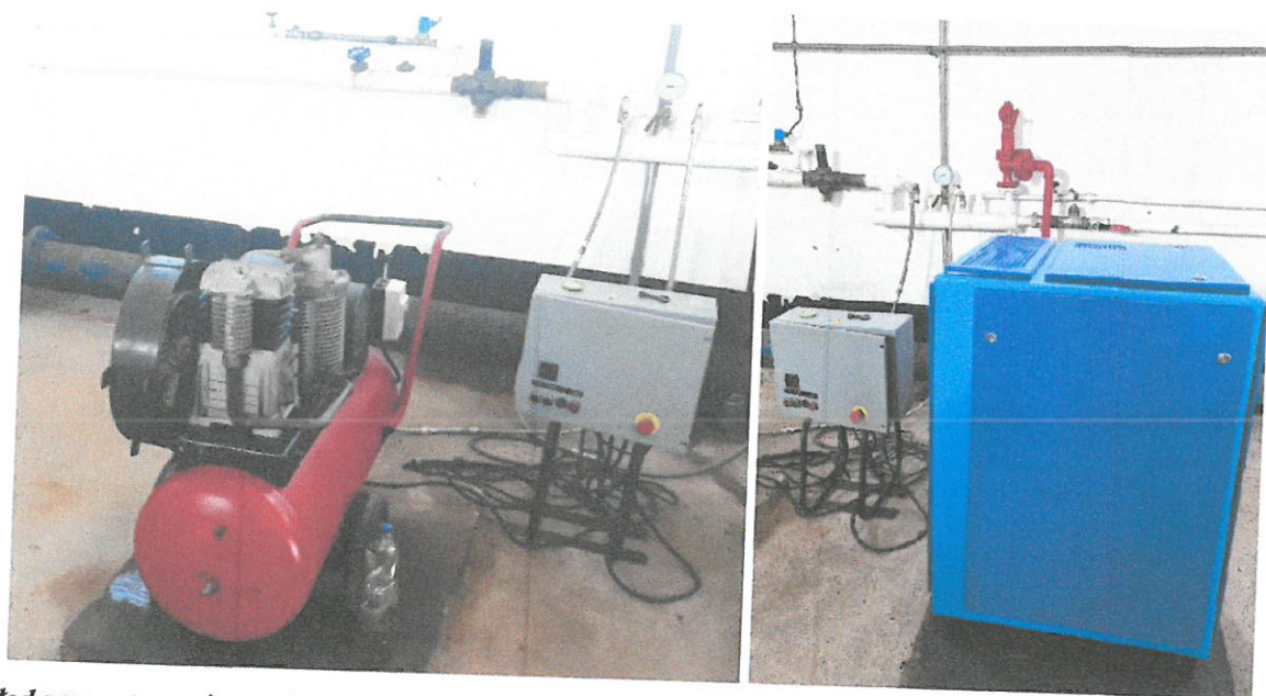
Układ przygotowania powietrza technologicznego (po lewej stara sprężarka do wymiany, po prawej nowa sprężarka)
