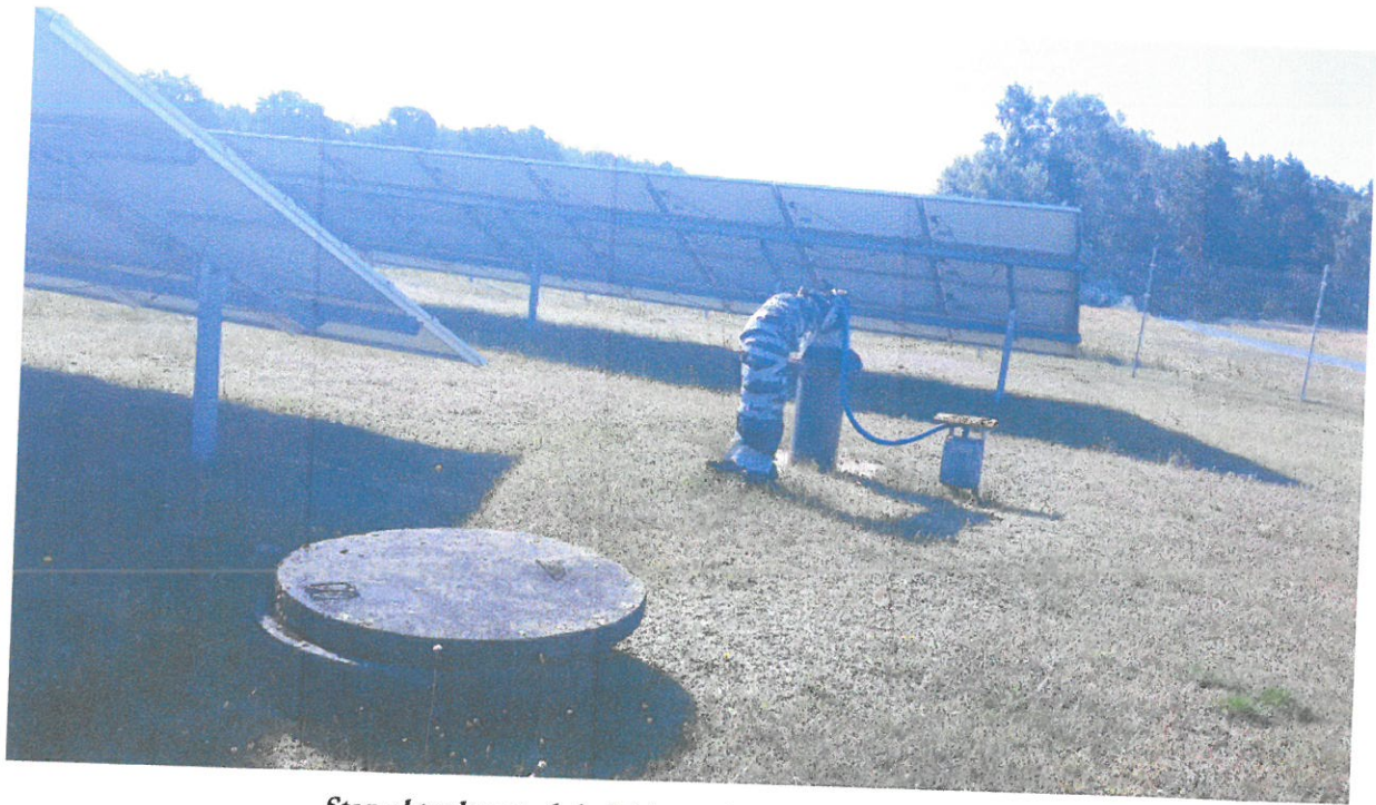
Stan aktualny studni głębinowej – podlega modernizacji
