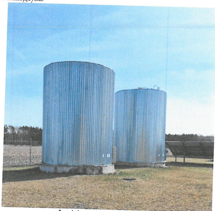
Istniejące zbiorniki retencyjne
