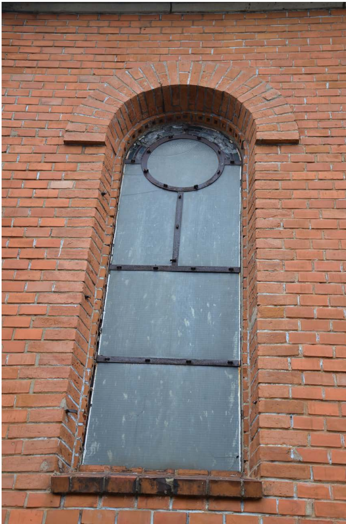
Fot. nr 19. Kaplica grobowa Rodziny Korczak. Widoczne na fotografii korozja elementów stalowych okna kaplicy, wtórne szklenie okien, zachowany witraż w zwieńczeniu okna.
