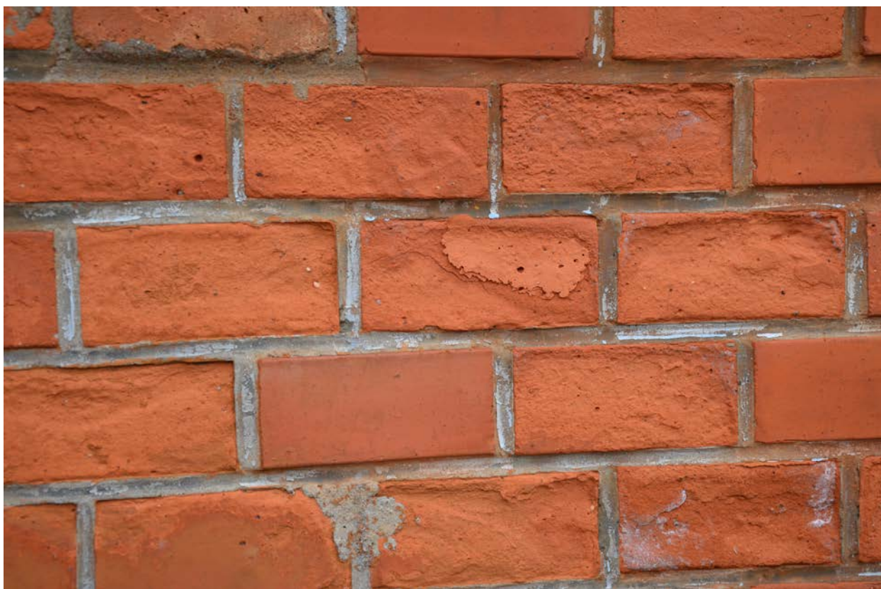
Fot. nr 13, 14. Kaplica grobowa Rodziny Korczak. Widoczne na fotografii dezintegracja strukturalna wybranych cegieł oraz ubytki z tego wynikające.
