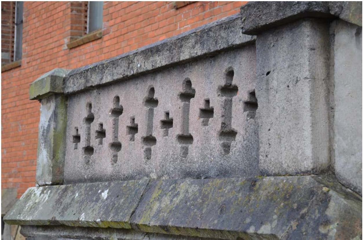
Fot. nr 7, 8. Kaplica grobowa Rodziny Korczak. Widoczne na fotografii silna destabilizacja stopnic schodowych, zabrudzenia powierzchni kamienia, liczne kolonie mikroorganizmów, złamany stopień schodowy, stopień schodowy wykonany w technologii lastryko, wtórny element balustrady wykonany z betonu cementowego. Fot. Mariusz Wrona grudzień 2020 r.
