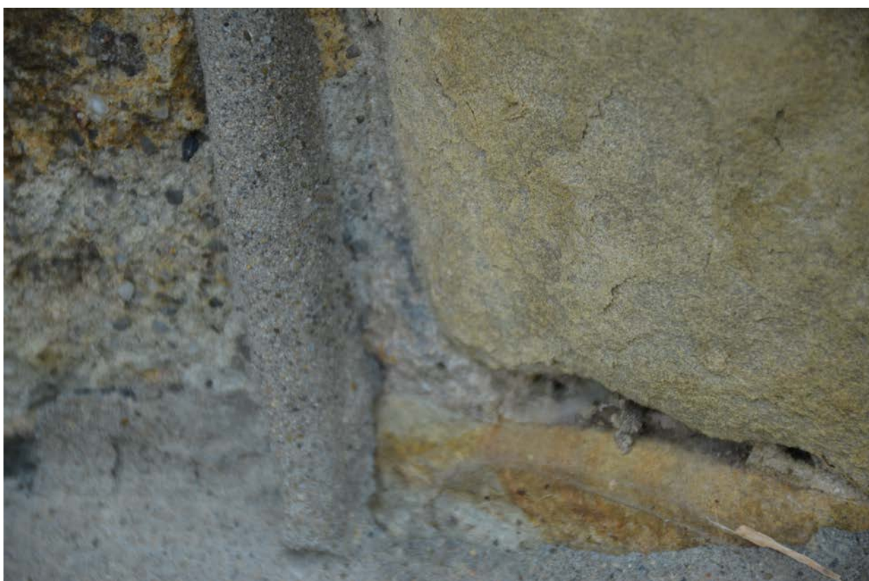
Fot. nr 22, 23. Kaplica grobowa Rodziny Korczak. Widoczne na fotografii dezintegracja i łuszczenie się warstw kamienia, betonowe, wypukłe spoinowanie kamienia. Fot. Mariusz Wrona
