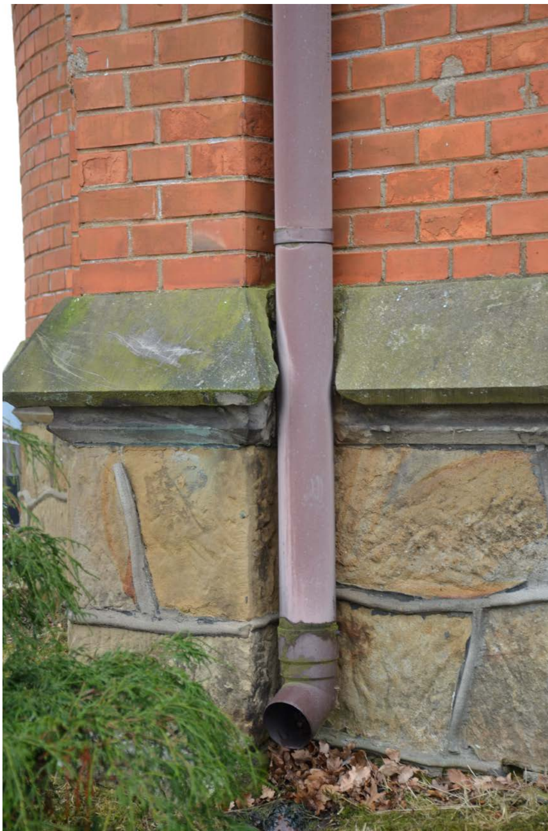
Fot. nr 24. Kaplica grobowa Rodziny Korczak. Widoczne na fotografii uszkodzenie kamiennego gzymsu w skutek wprowadzenia rynny spustowej.
