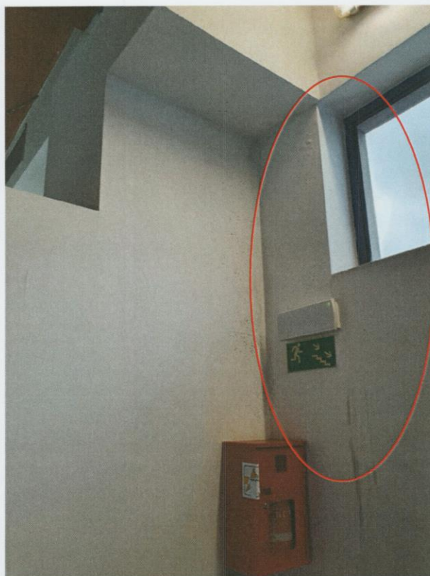
Wykwity pleśni w narożniku hali basenowej spowodowane mostkiem
