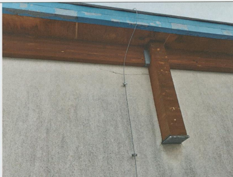
Uszkodzona powłoka malarska obróbki okapu.
