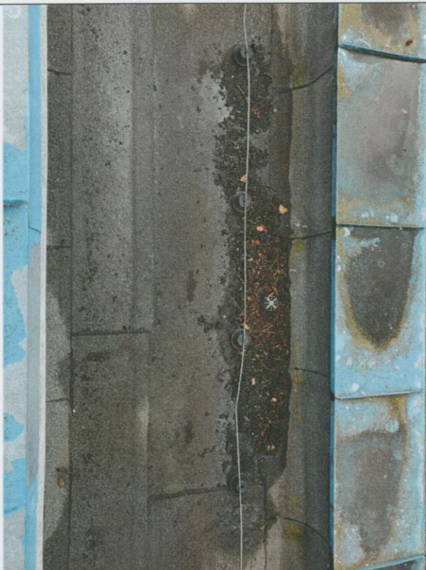
Uszkodzona obróbka attyki.
