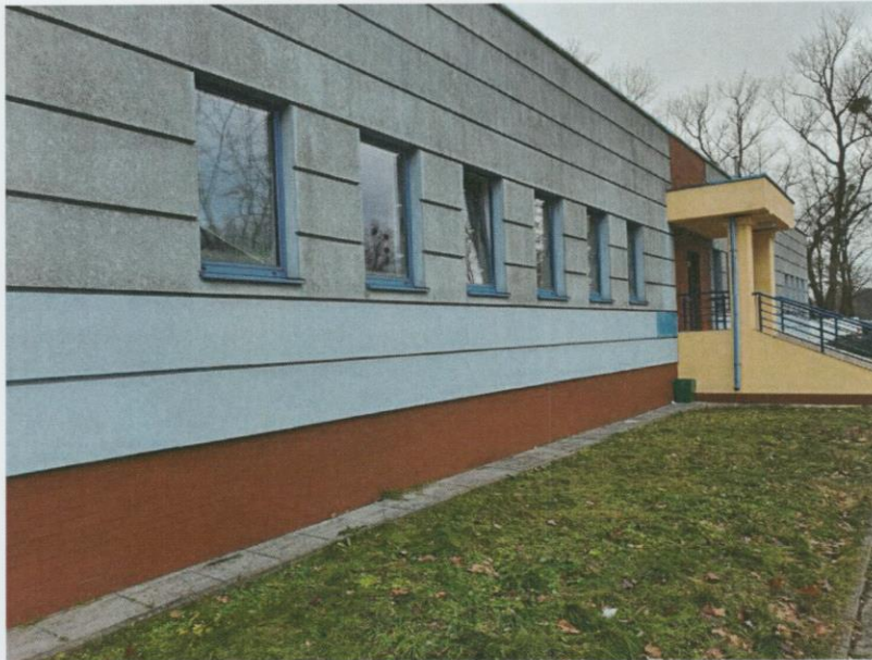
Widoczna mocno ubrudzona elewacja z widocznymi próbami napraw.
