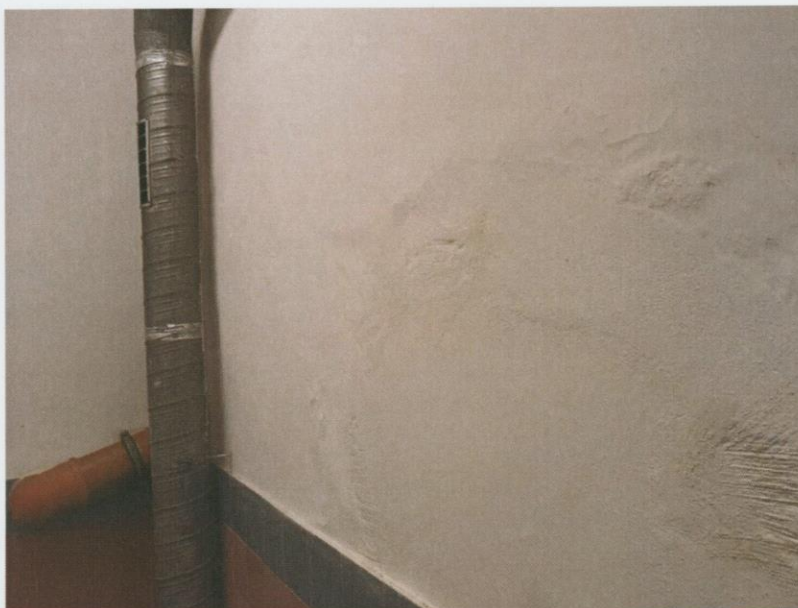
Zniszczona wyprawa tynkarska i malatura.
