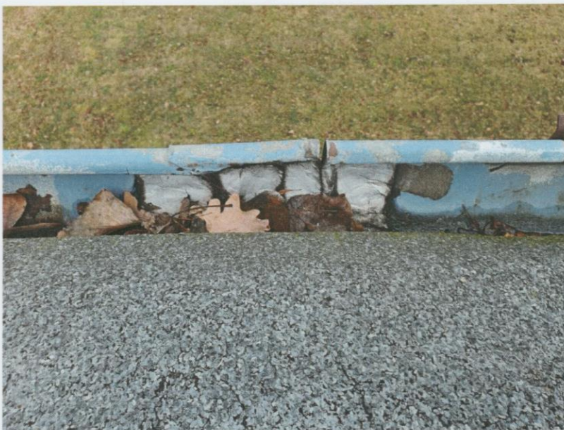
Do wymiany rynna wzdłuż całego okapu wyższego dachu.
