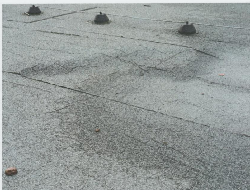
Pęcherz i spękanie papy na niższym dachu.
