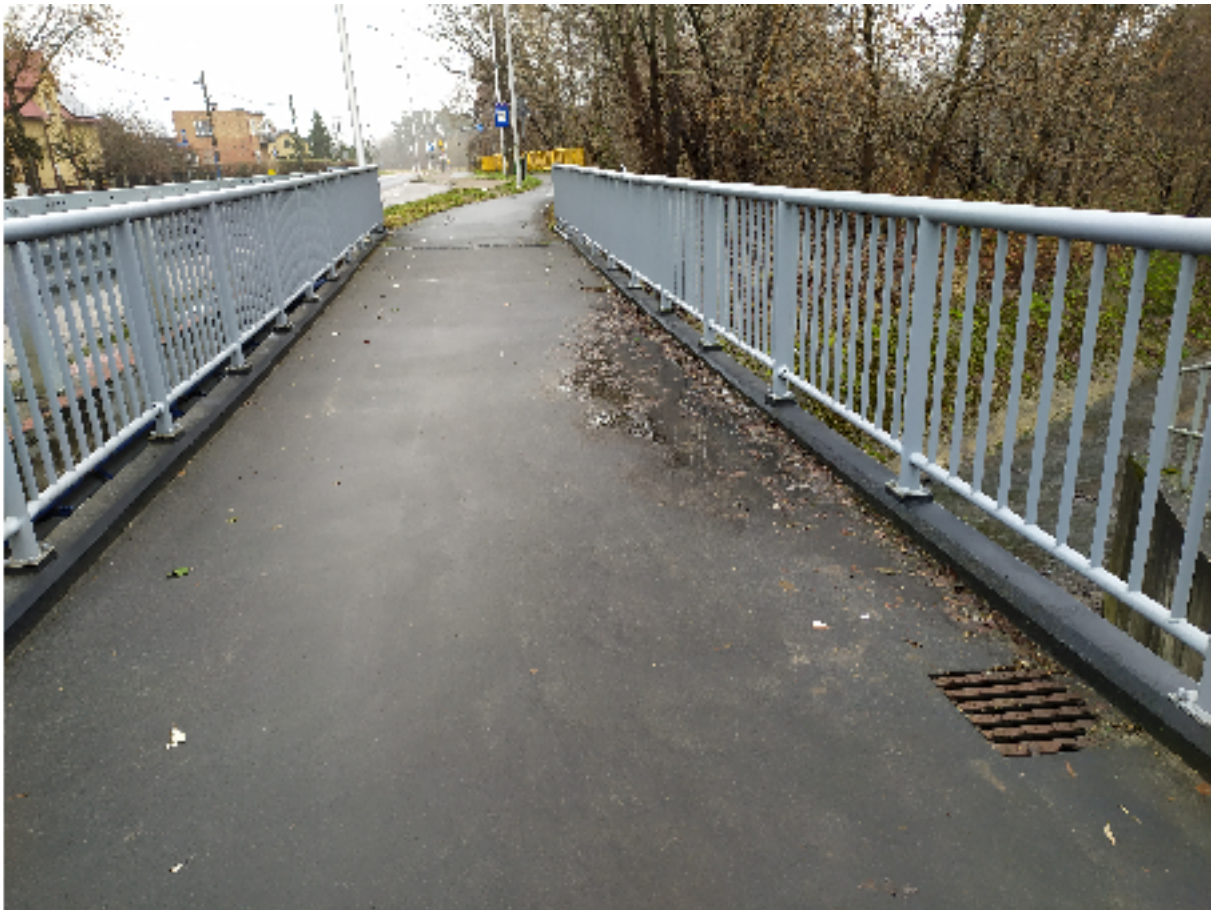
Fot. 1. Brak odpowiednich spadków uniemożliwiający swobodny odpływ wody opadowej z nawierzchni do wpustów (miejscowe zniżenie konstrukcji ustroju niosącego).
