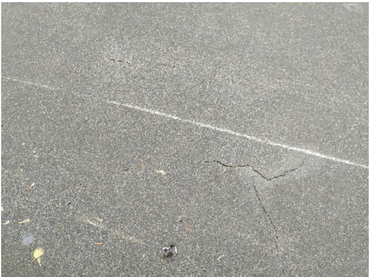
Fot. 2. Rysy (pęknięcia) w nawierzchni z żywic.
