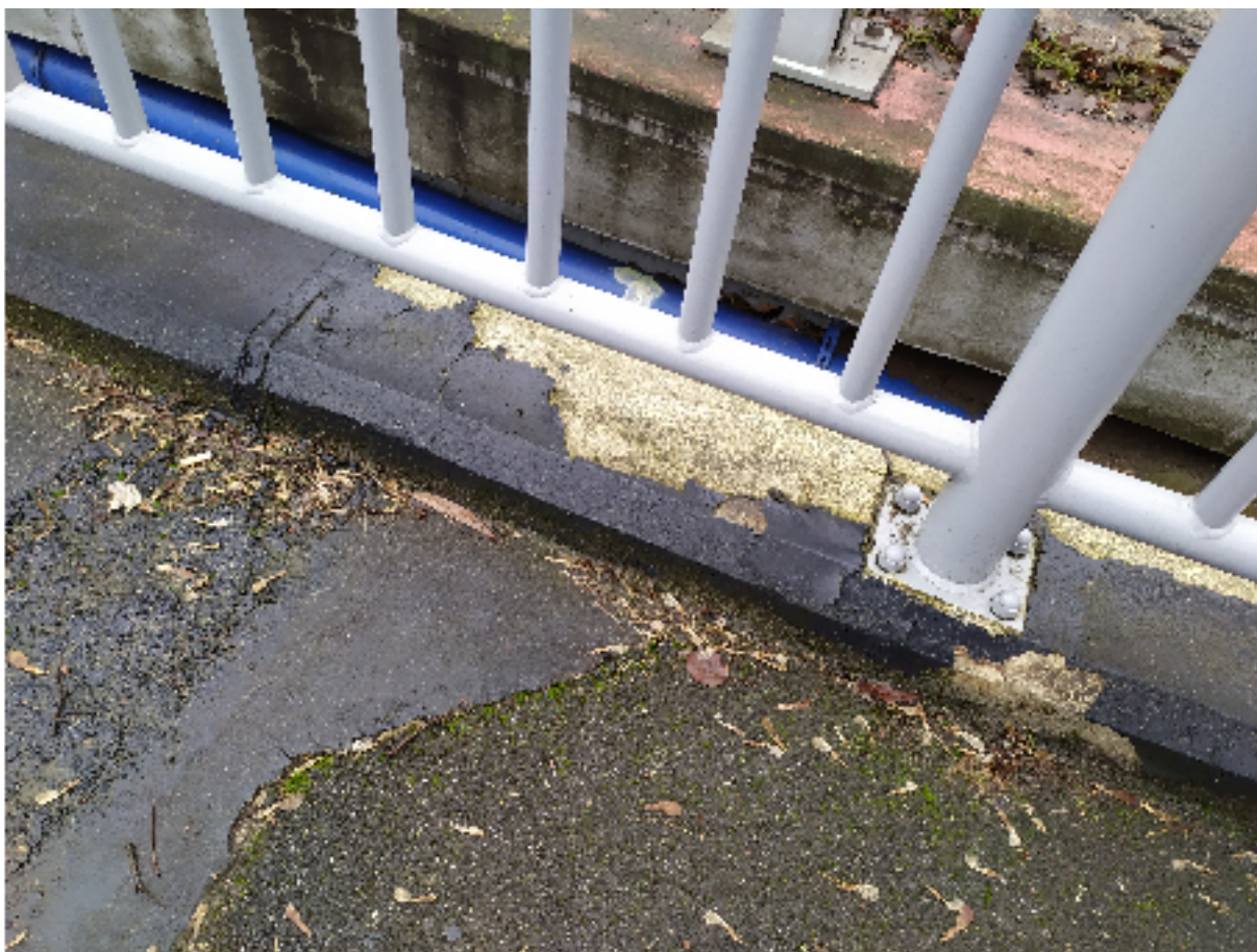
Fot. 3. Miejscowy brak przylegania nawierzchni z żywic do konstrukcji ustroju niosącego i belek podporęczowych.
