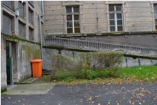
Fotografia 1: Niedrożny odpływ wody deszczowej przy budynku A (źródło: materiał własny).
