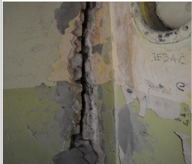
Fotografia 2: Odspajająca się klatka schodowa dobudowana od północnej części budynku A (źródło: materiał własny)
