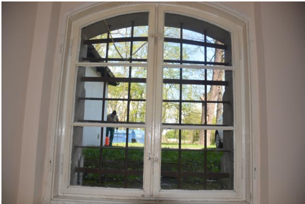
Fotografia 3: Okno skrzynkowe (najprawdopodobniej oryginalne) w budynku A z wymontowanym jednym kompletem skrzydeł (źródło - materiał własny)
