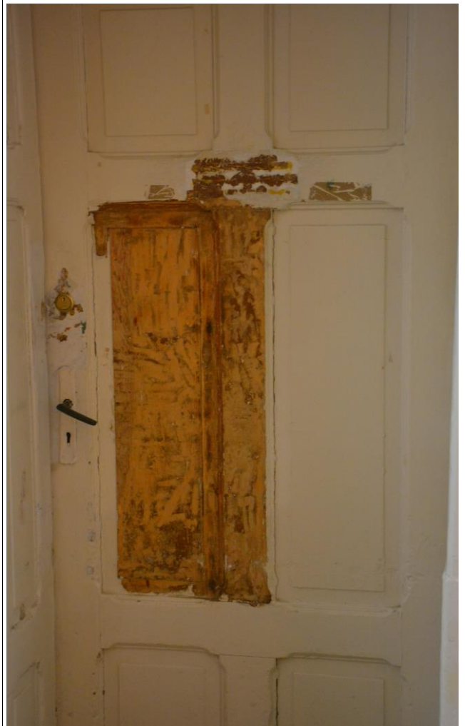
Fotografia 4: Zachowane stare drzwi wymagające pilnej konserwacji - budynek A (źródło: materiał własny).
