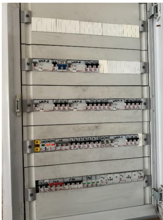
WIDOK ISTNIEJĄCEJ ROZDZIELNICY "RG" BUDYNKU KLUBOWEGO
