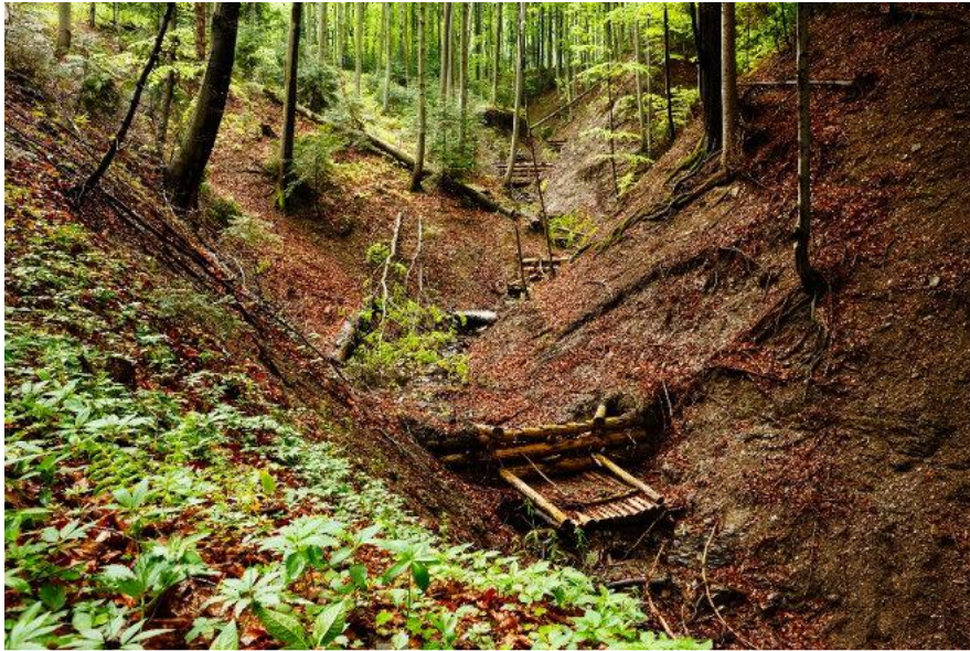
Niewielkie zapory przeciwrumowiskowe seryjnie rozłożone w wyerodowanym wąwozie na cieku okresowym. Źródło: Archiwum CKPŚ
