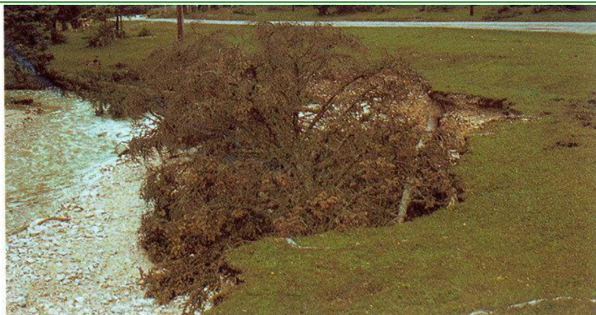
Powalony świerk zabezpieczający podmyty brzeg (Begemann i Schiechl 1999)
