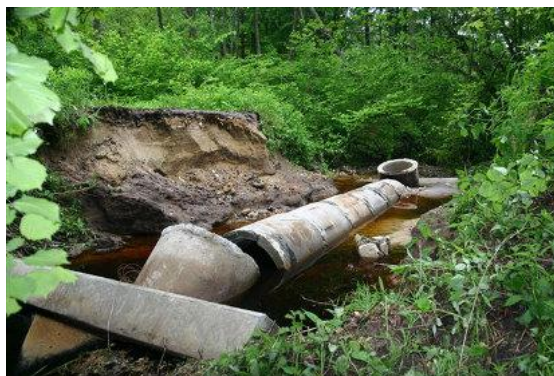
Straty powodziowe w 1997 r. – rozmyty przepust o zbyt małym świetle. W tym wypadku użyto zbyt małego przekroju do wykonania przepustu, jednak odpowiednie umocnienie budowli i umożliwienie przelania się wody górą przez przelew górny/bród nie dopuściłoby do takich zniszczeń. Źródło: Archiwum CKPŚ.
