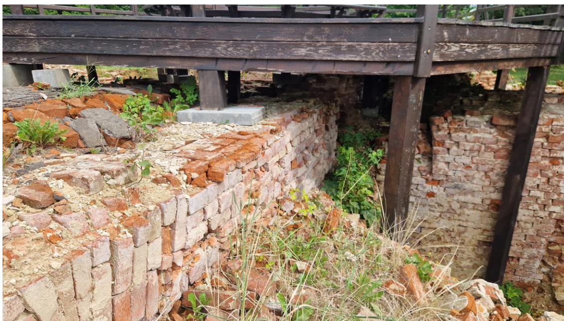
Fot. Taras T3 – widok od strony tarasu zachodniej. Stan zachowania na 2024 r.
