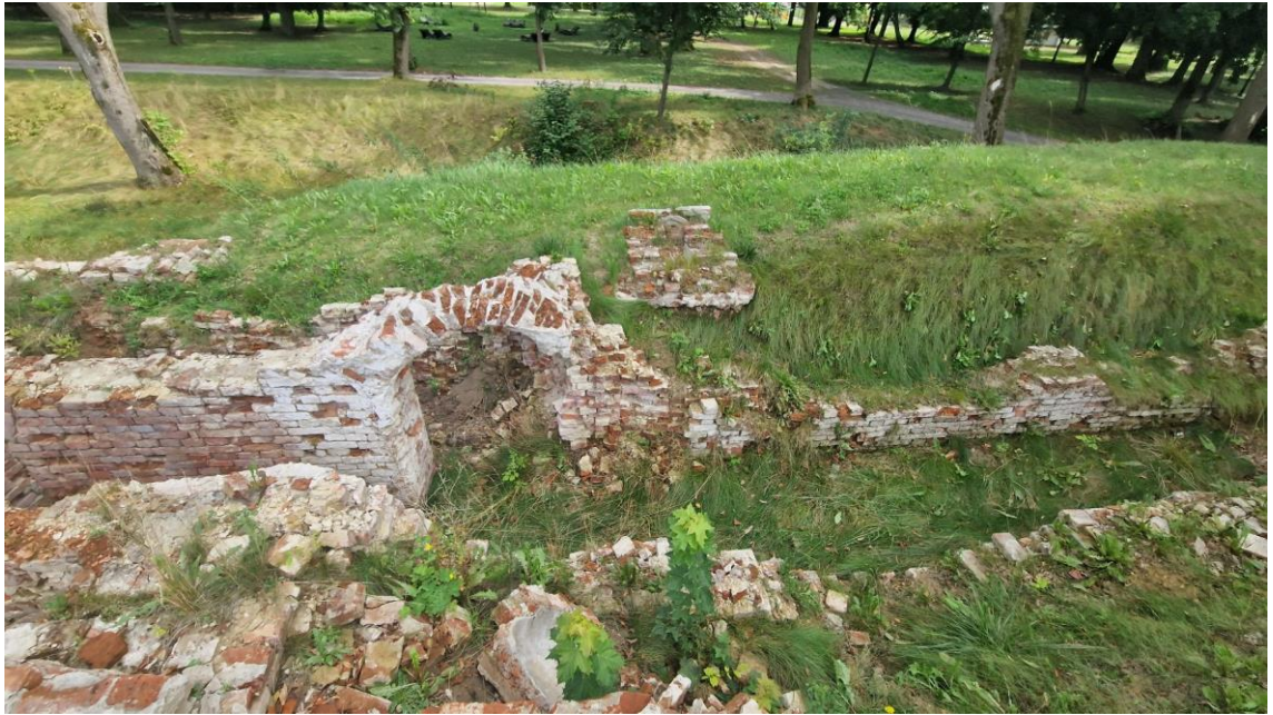
Fot. Przejście -1.1. Stan zachowania na 2024 r.
