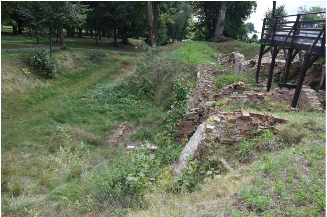
Fot. Obszar tarasów T1 i T2 widok od strony północnej. Stan zachowania na 2024 r.
