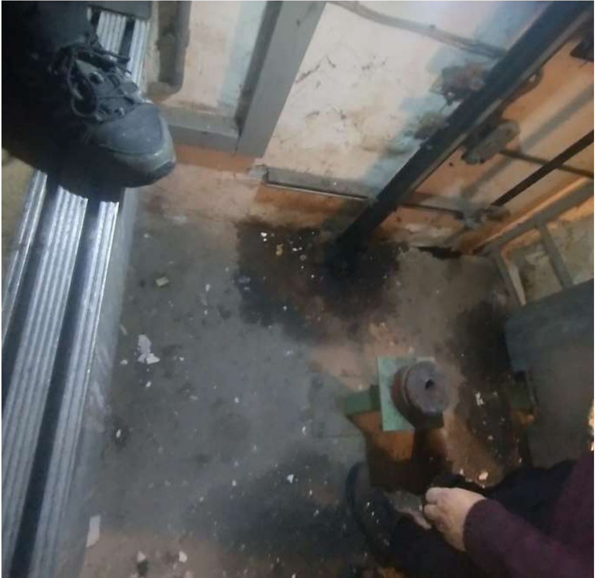
Płyta dolna podszybia nosi ślady dużej wilgoci oraz wycieków, brak izolacji. Brak widocznych spękań.
