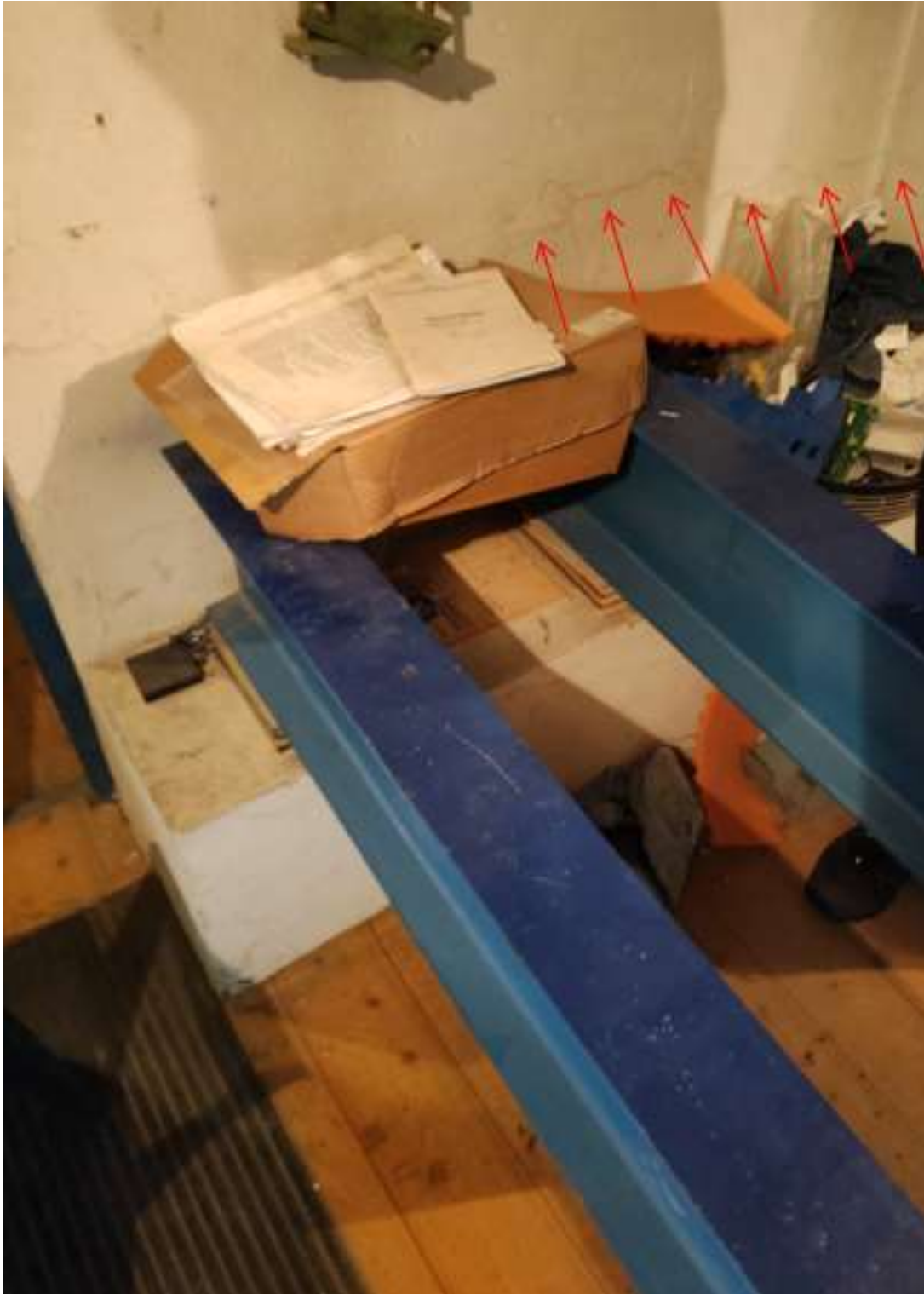
Widoczne zarysowania ściany nadszybia zlokalizowanej przy podwalinie.
