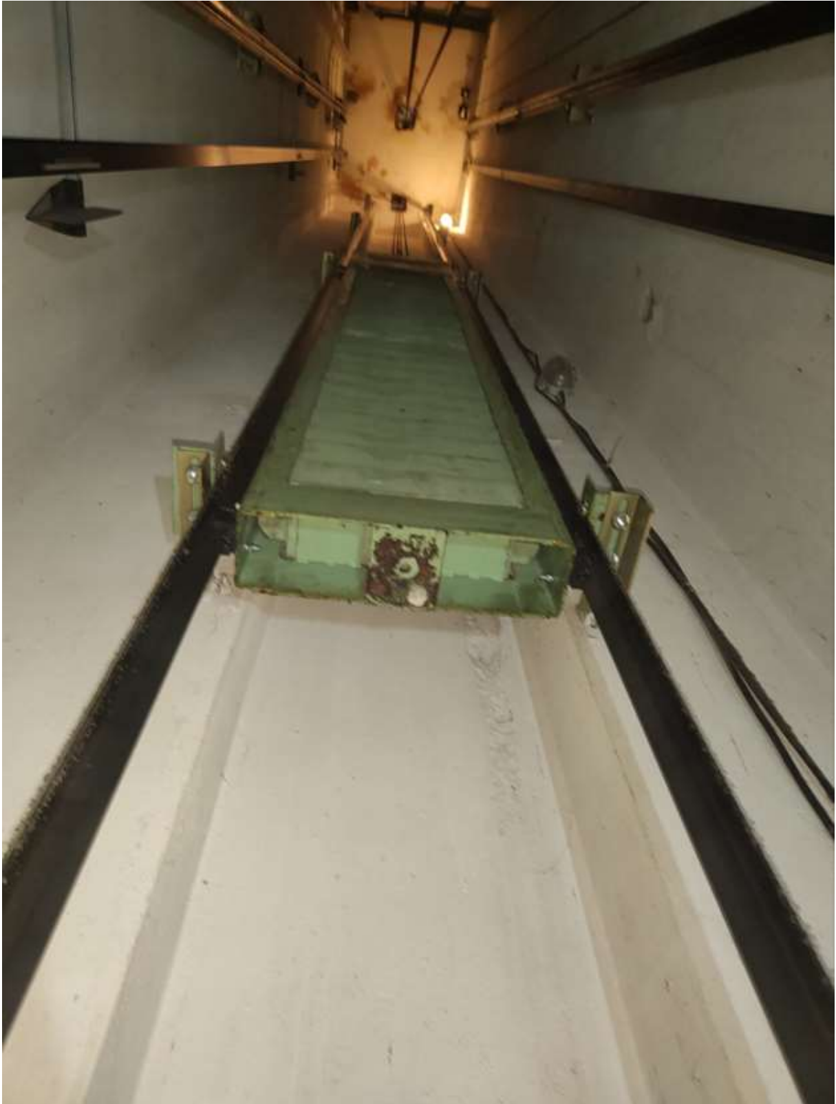
Widok prawidłowo pracującej przeciwwagi, prostoliniowość prowadnic, brak hałasu podczas pracy windy. Brak widocznych uszkodzeń.
