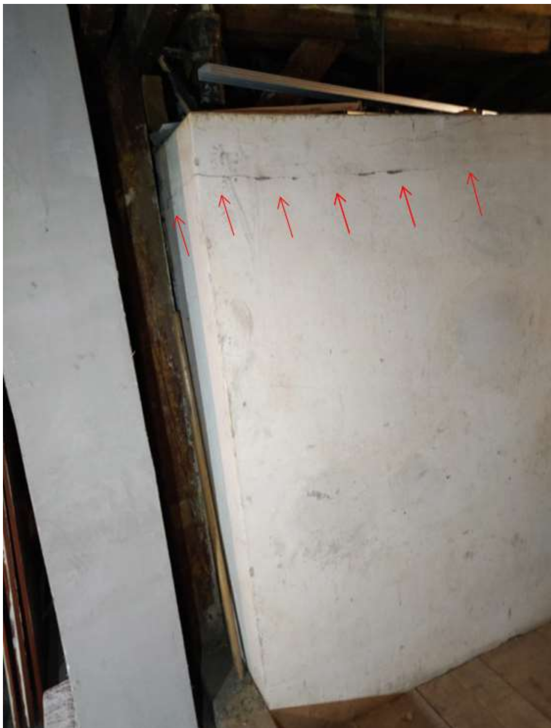
Zarysowania ścian nadszybia wynikające z błędu połączenia konstrukcji więźby dachowej.
