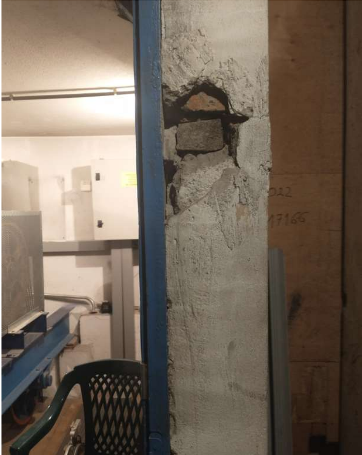
Uszkodzenia ściany przez którą przechodzi miecz podpierający paterw konstrukcji dachu.
