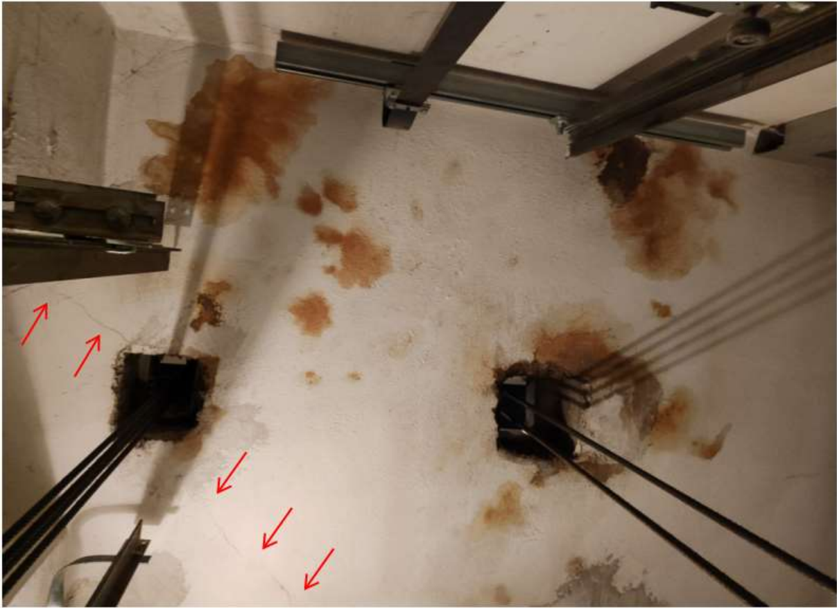
Widoczne ślady korozji zbrojenia płyty stropowej nadszybia oraz zarysowania przy otworze.
