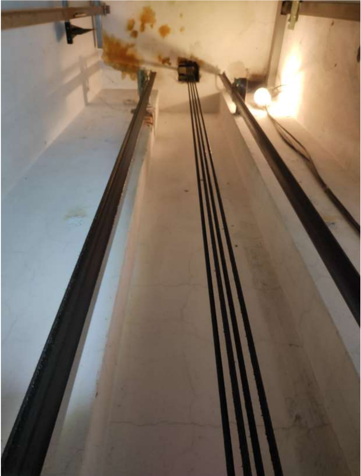
Liczne spękania ścian szybu dźwigowej w kształcie pajęczyn o szerokości nie przekraczającej 0,5mm.
