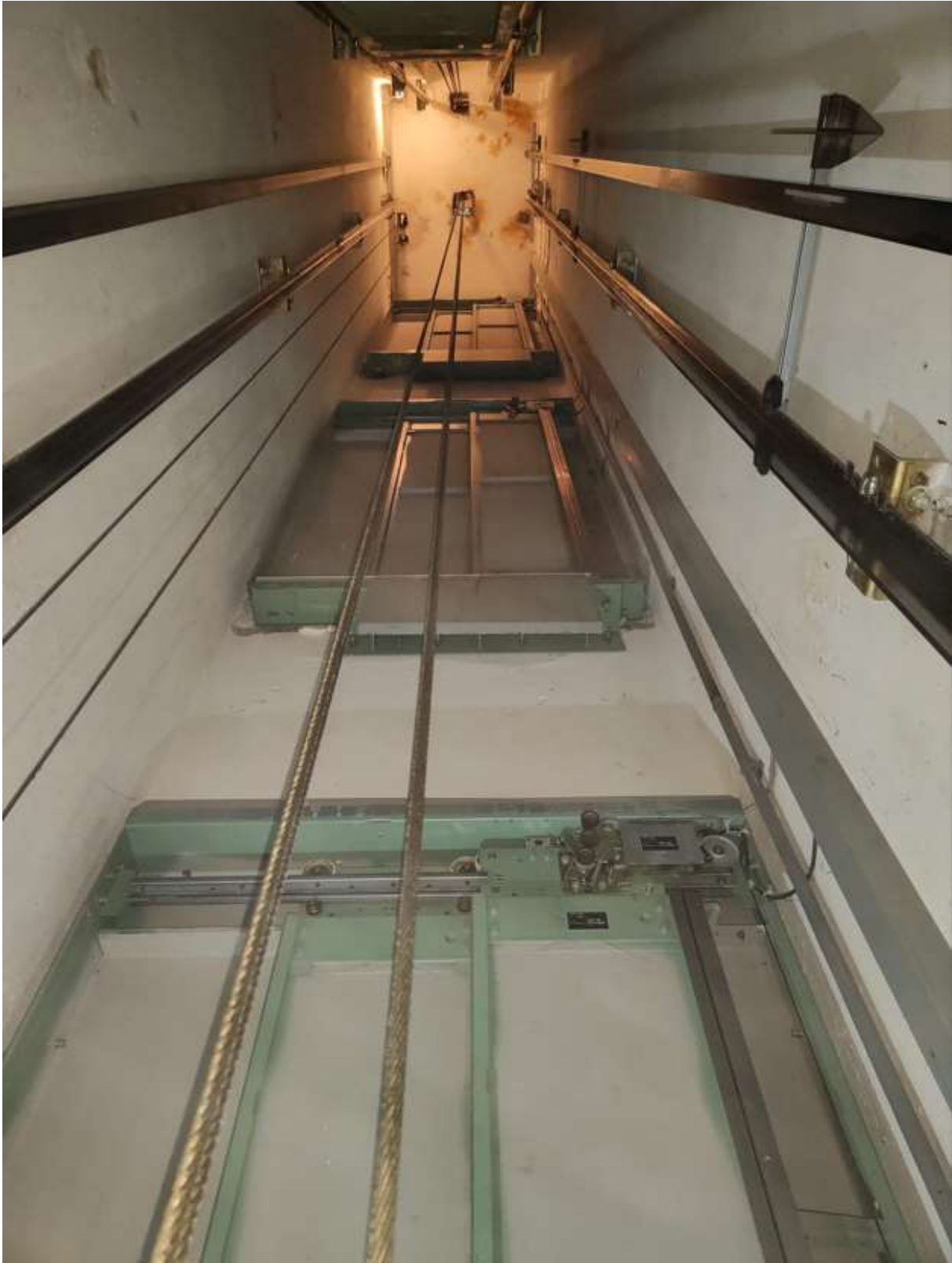
Widok zamocowania otworów drzwiowych - brak widocznych uszkodzeń konstrukcji.
