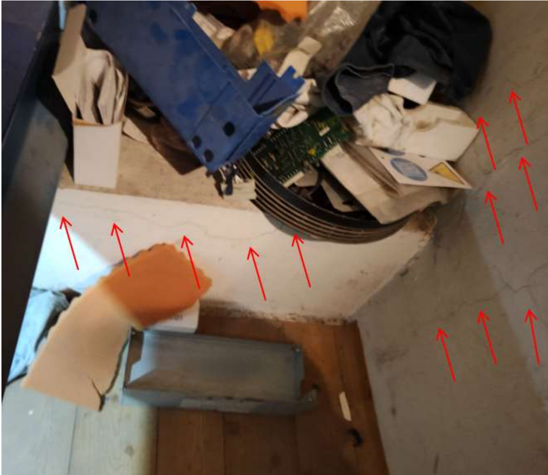
Widoczne zarysowania ściany nadszybia zlokalizowanej przy podwalinie na zewnątrz belek od strony ściany
