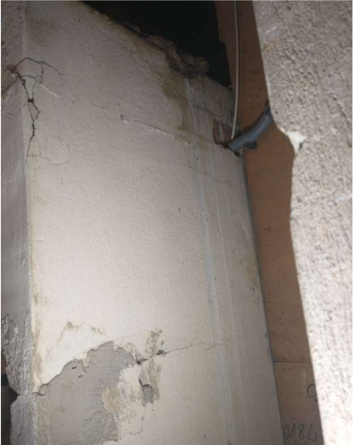
Spękania i widoczne naprawy ścianki nadszybia.
