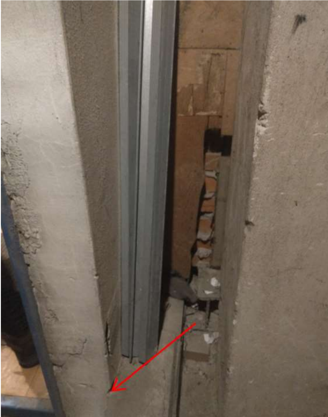
Brak zachowania dylatacji poziomej pomiędzy drewnianą belką - podwaliną podpierającą słupy dachu a ścianami nadszybia.
