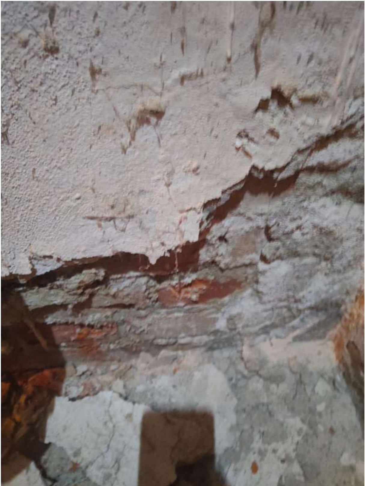
Korozja tynku ścian podszybia. Widoczne ślady naprawy podszybia. Brak izolacji, widoczna wilgoć.
