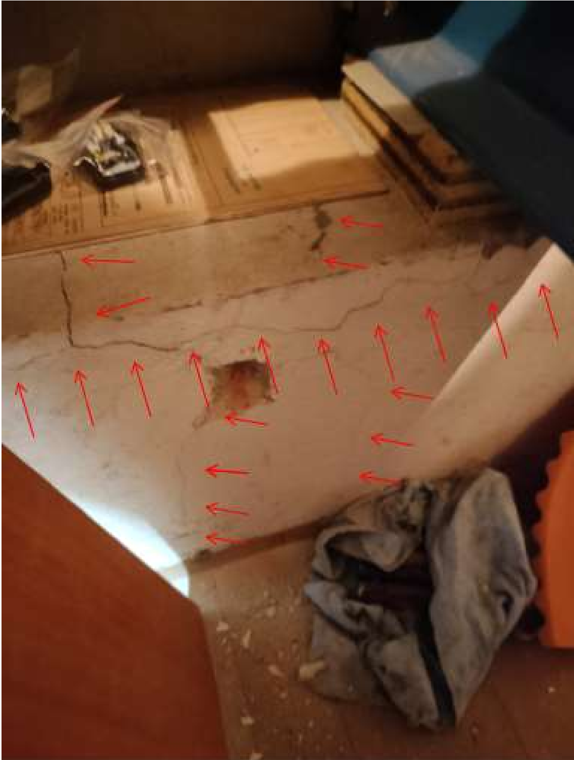
Widoczne zarysowania podwaliny i ubytki tynku pomiędzy belkami I240. Pęknięcia do 1,5mm.
