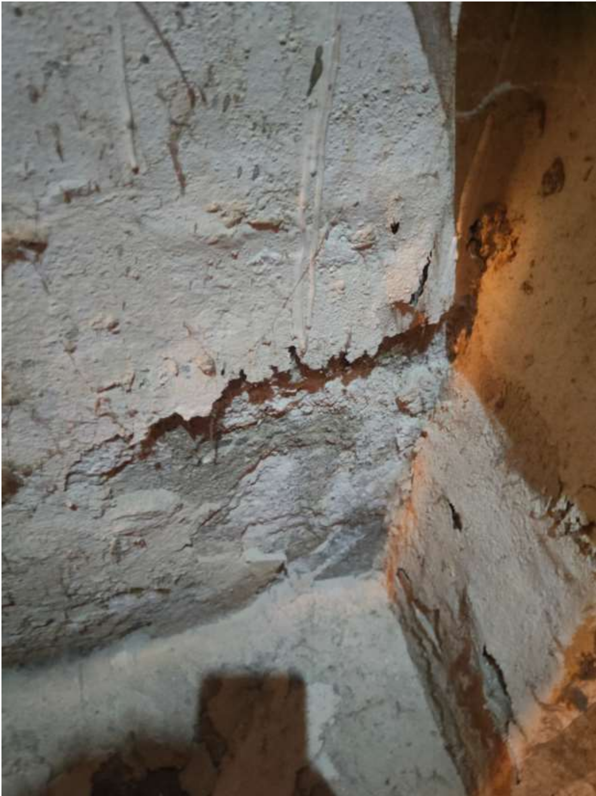
Zdegradowany tynk ścian podszybia zwłaszcza na prawej ścianie szybu windowego. Brak izolacji widoczna wilgoć.
